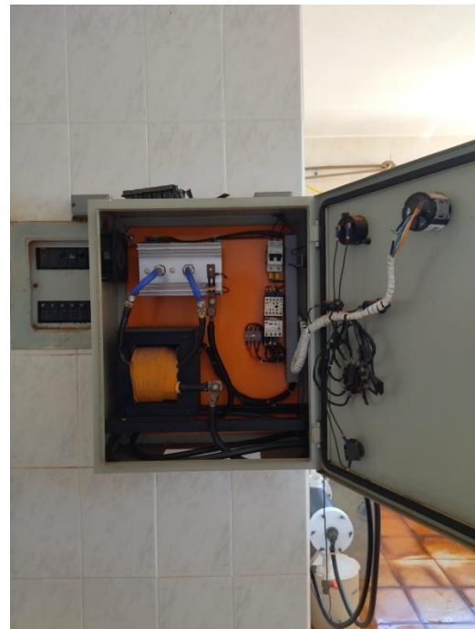
Foto 27: Quadro de comando (gerador de cloro).
