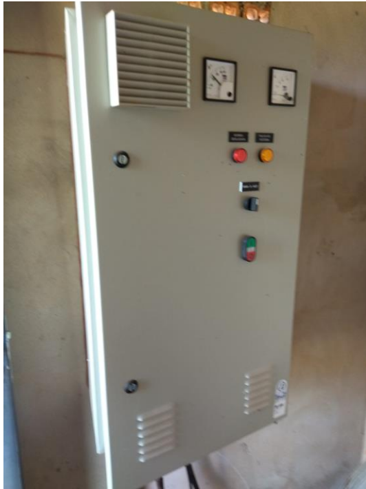
Foto 61: Quadro de comando
