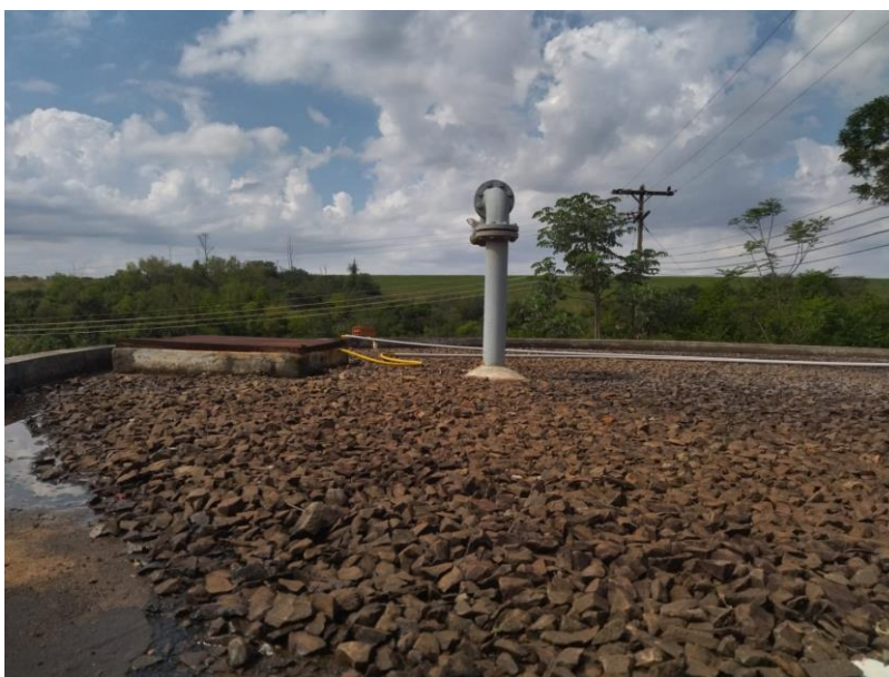
Foto 96: Tampas de inspeção não apresentam boas condições.
