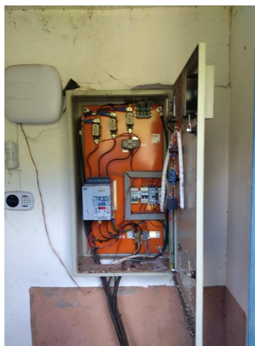
Foto 73: Quadro de comando.
