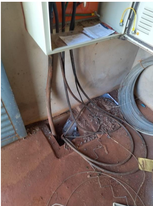
Foto 63: Fiação elétrica expostas.
