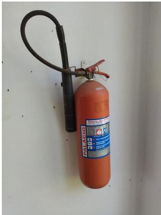
Foto 24: Extintor de incêndio.
