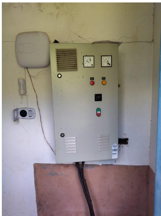
Foto 72: Quadro de comando
