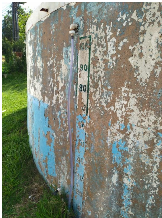
Foto 94: Medidor de nível
