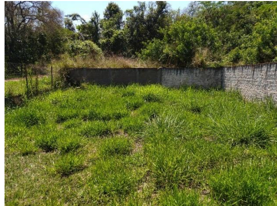
Foto 50: Falta de limpeza e capina.
