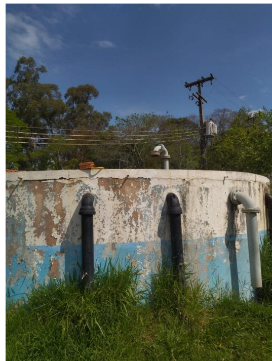
Foto 95: Estravisor sem tela de proteção.
