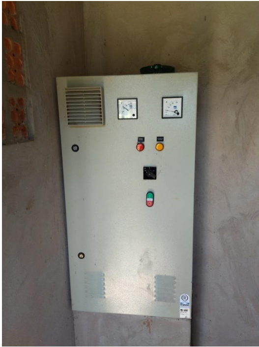
Foto 79: Quadro de comando.
