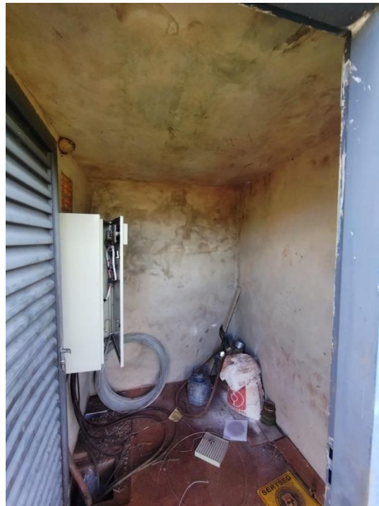
Foto 64: Ausencia de limpeza, iluminação, conservação.
