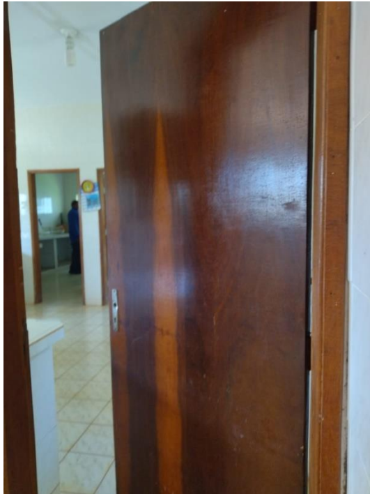
Foto 07: Entrada não possui identificação.
