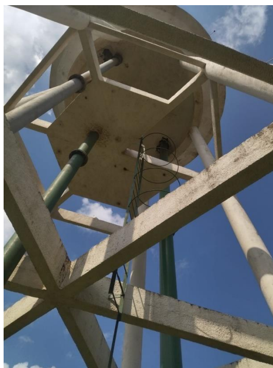
Foto 83: Escada e guarda corpo inadequados.
