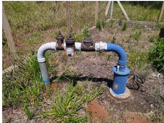
Foto 76: Ausencia de tomada de coleta.
