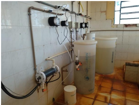
Foto 22: Gerador de cloro (limpeza). manutenção).
