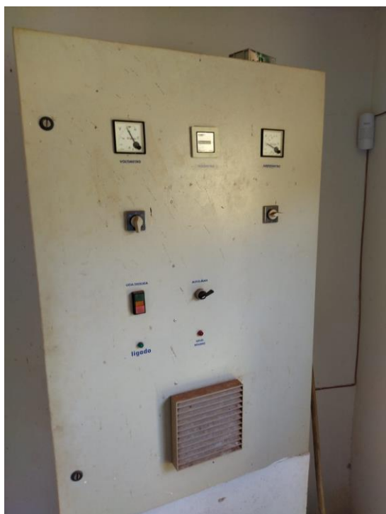
Foto 40: Quadro de comando.
