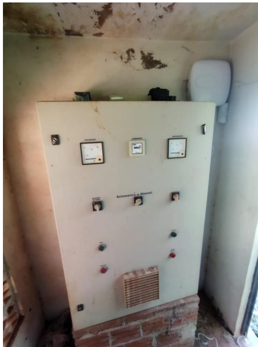
Foto 31: Quadro de comando.
