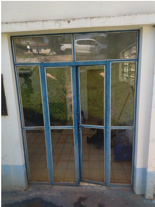
Foto 20: Falta de identificação U.T.
