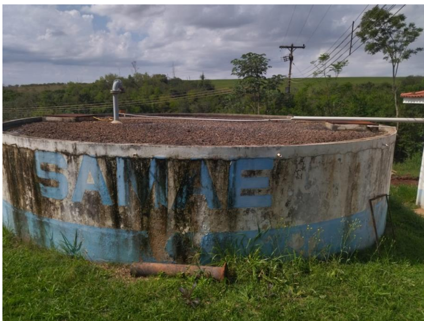
Foto 91: Sem identificação, não apresenta boas condições estruturais.
