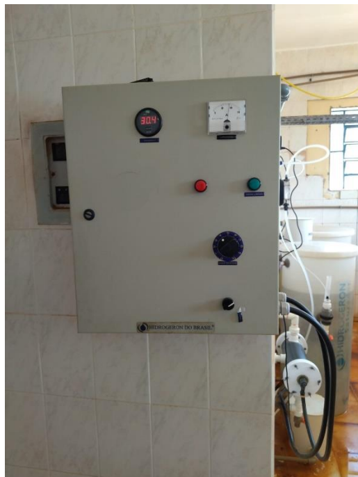
Foto 26: Quadro de comando.
