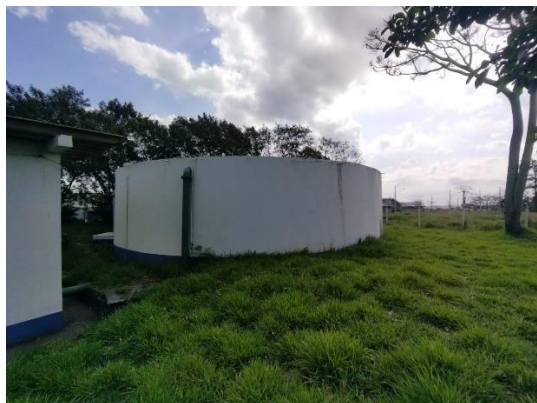
Foto 85: Reservatório Apoiado (600 m 3 ).
