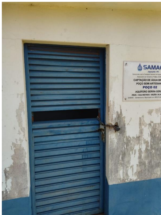
Foto 37: Necessidade de reparos estruturais.
