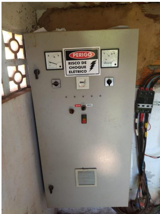
Foto 52: Quadro de comando.
