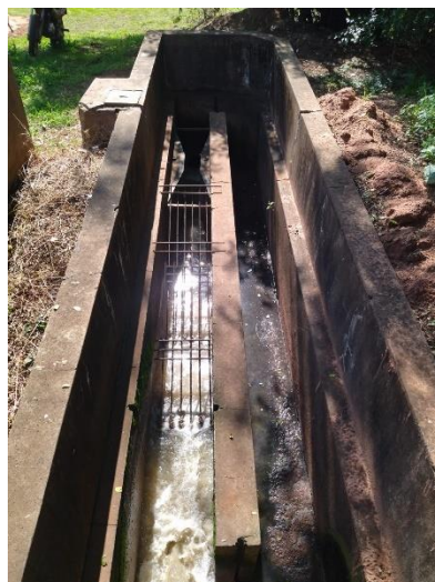
Foto 110: Grades enferrujadas em estado de decomposição.
