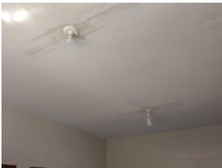
Foto 06: Iluminação sem funcionamento.
