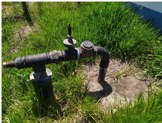
Foto 46: Ausencia de tomada de coleta.
