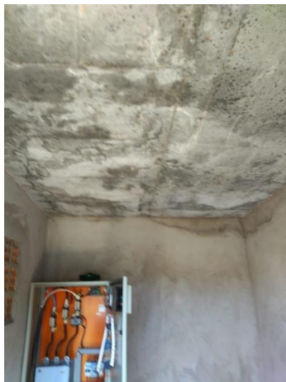
Foto 78: Indícios de infiltrações na estrutura interna, falta de iluminação interna.
