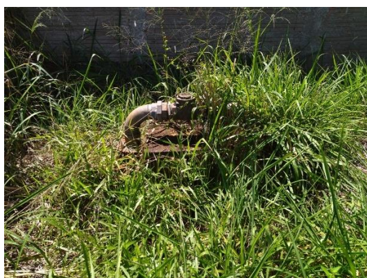
Foto 56: Instalações do poço 04
