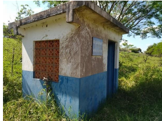
Foto 66: Ausência de iluminação externa.
