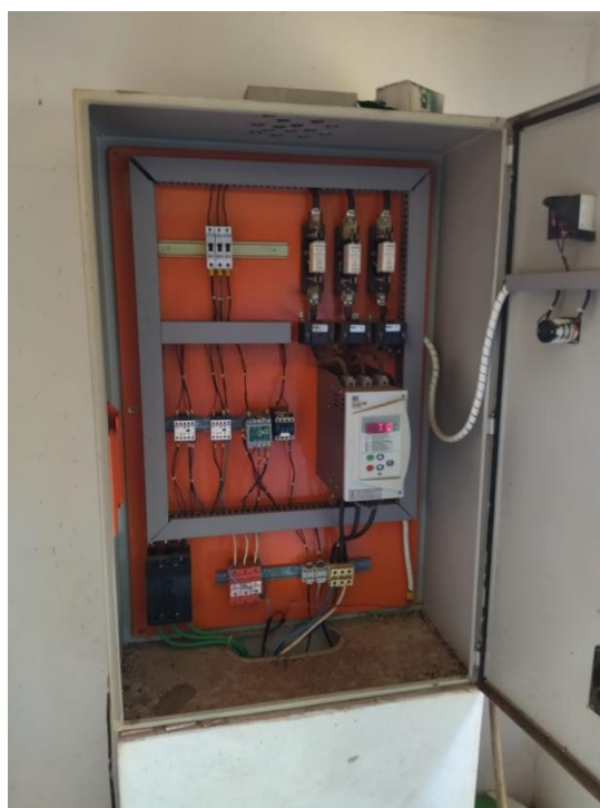
Foto 41: Quadro de comando.
