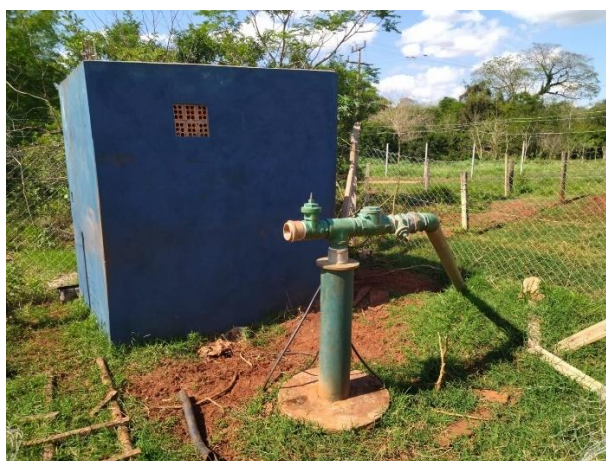
Foto 60: Instalações poço 06 (falta de tomada de coleta de água bruta).
