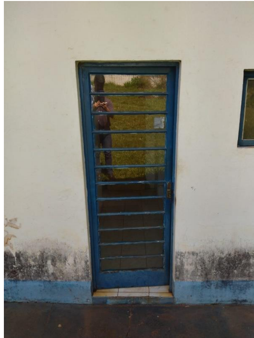
Foto 21: Falta de Identificação U.T.
