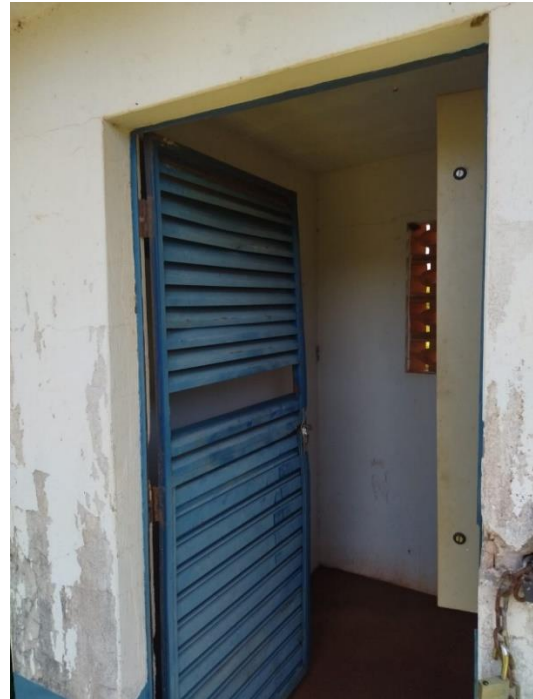
Foto 38: Porta de acesso ao abrigo.
