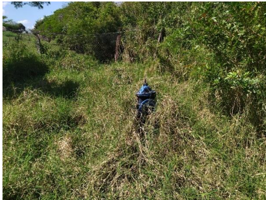
Foto 67: Instalações poço inacessíveis.
