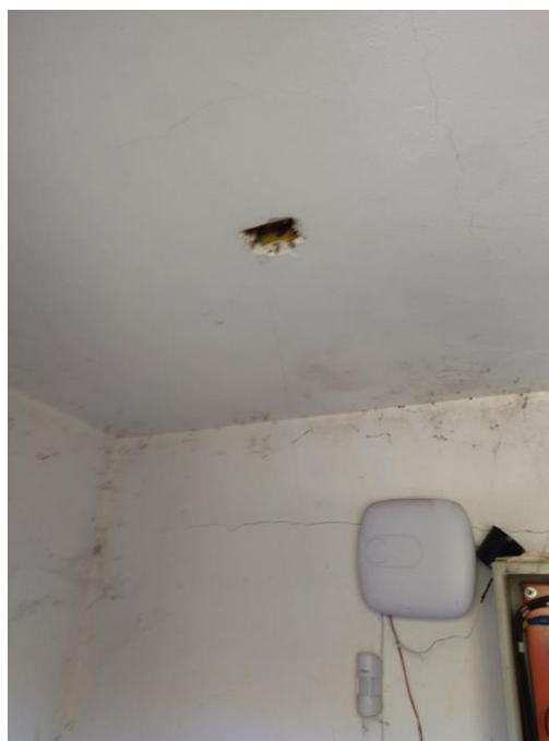
Foto 71: Falta de iluminação interna.
