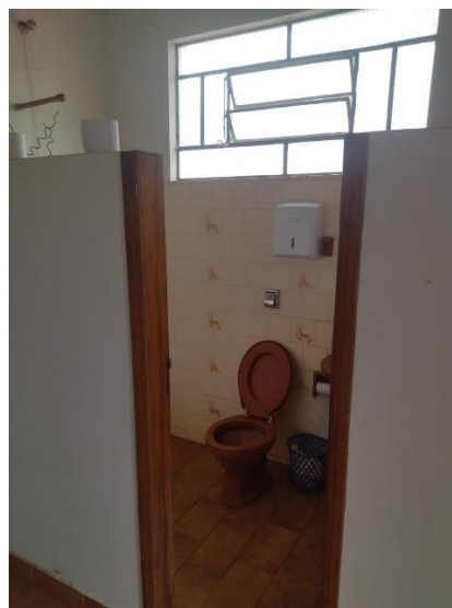
Foto 05: Falta de Acessibilidade Sanitários.
