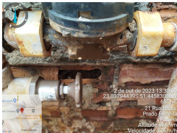
Foto 49 - Hidrômetro do ponto 03
