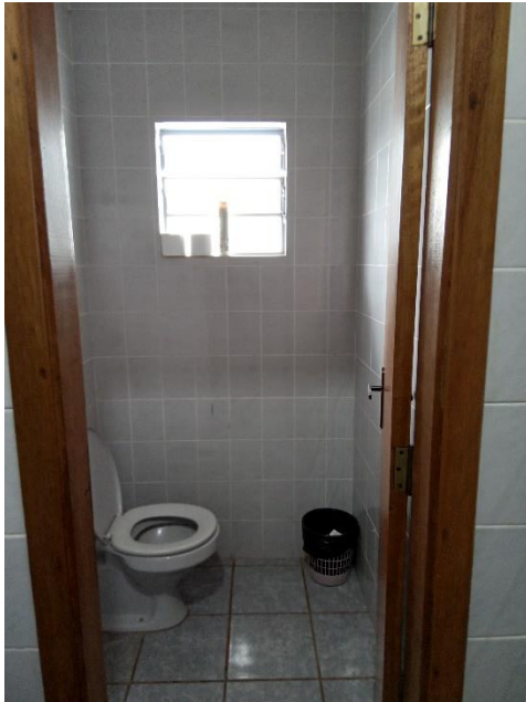
Foto 3 – Banheiro sem acessibilidade
