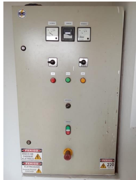
Foto 20 – Quadro de comando (fechado)
