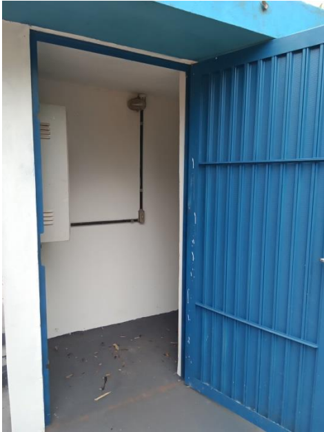
Foto 25 – Interior da casa de comando
