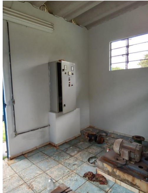
Foto 31 – Interior da casa de comando
