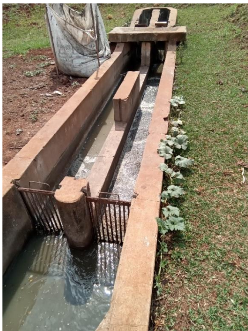
Foto 62 – Gradeamento da calha Pashall
