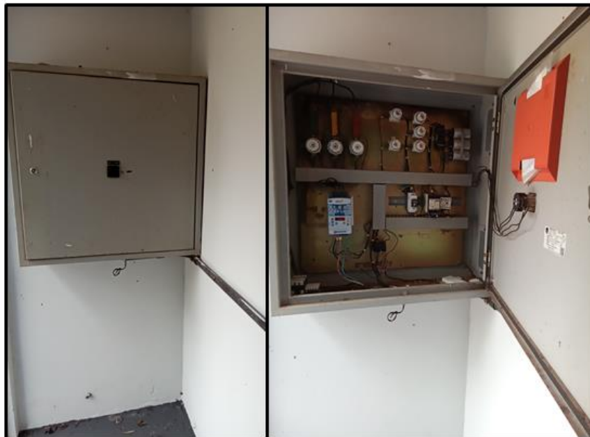
Foto 27 – Quadro de comando (fechado/aberto)
