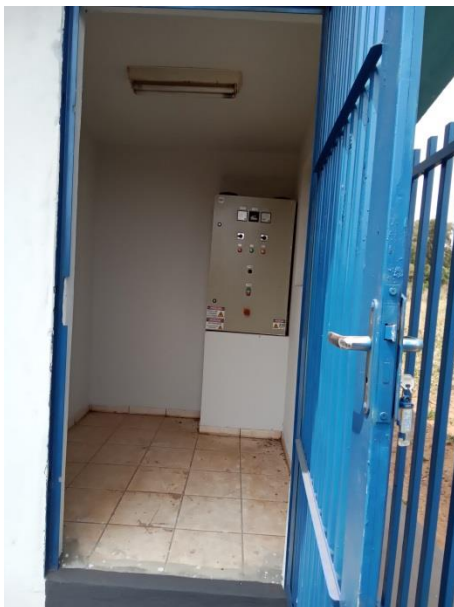
Foto 19 – Interior da casa de comando
