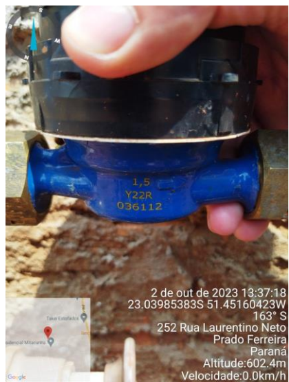
Foto 47 - Hidrômetro do ponto 02
