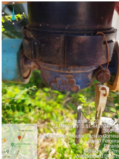
Foto 45 - Hidrômetro do ponto 1
