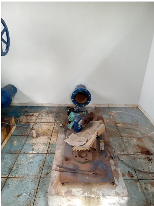
Foto 37 – Ausência bomba reserva
