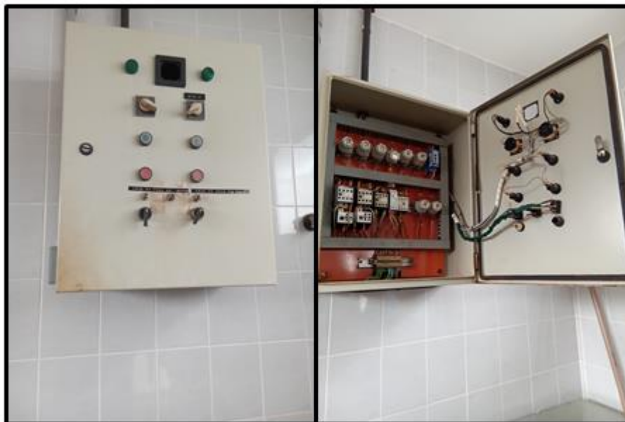
Foto 16 – Quadro de energia
