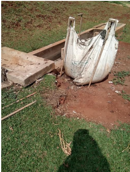
Foto 64 – Resíduos de limpeza de gradeamento dispostos de forma inadequada
