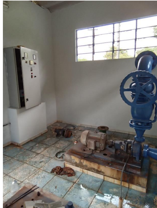
Foto 36 – Elevatória da mina 01
