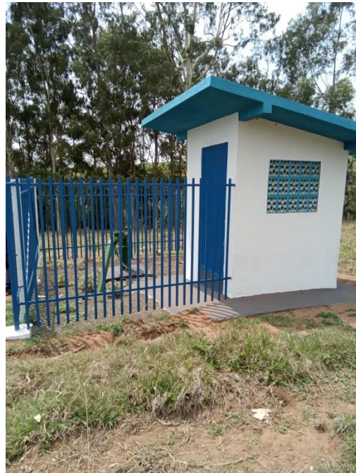
Foto 22 – Ventilação da casa de comando
