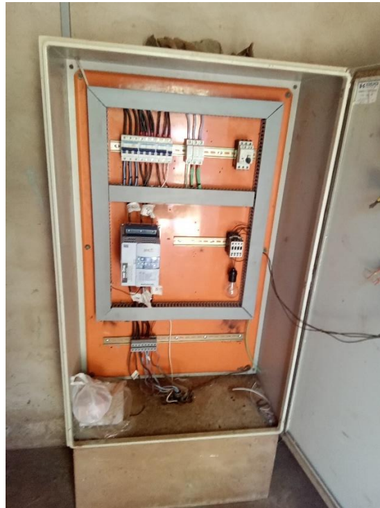
Foto 19 – Painel de comando
