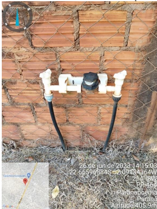
Foto 34 - Hidrômetro P02 – Localização
