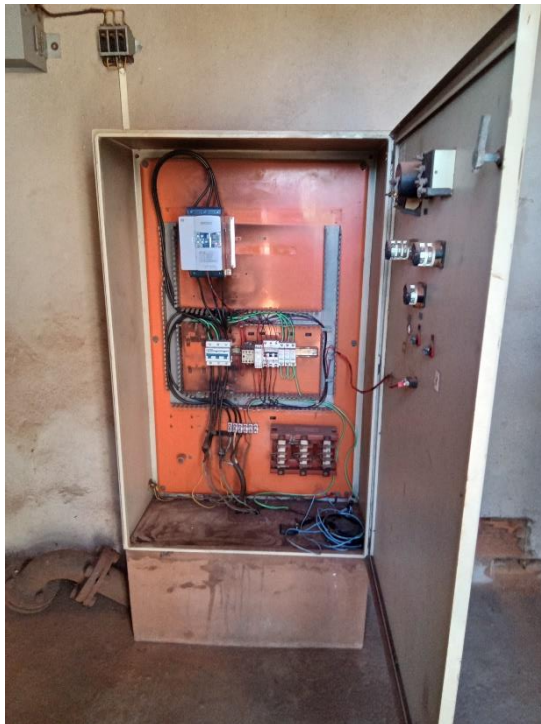
Foto 22 – Painel de comando
