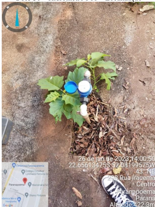
Foto 30 – Hidrômetro P01 – Localização
