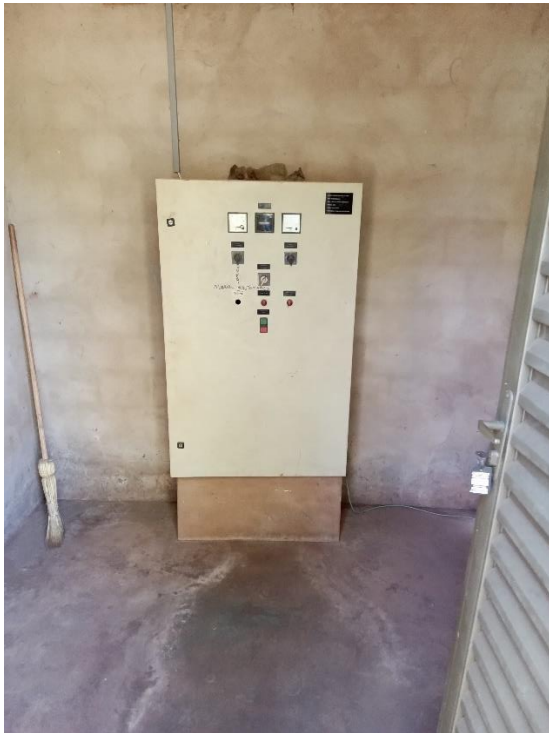
Foto 18 – Painel de comando
