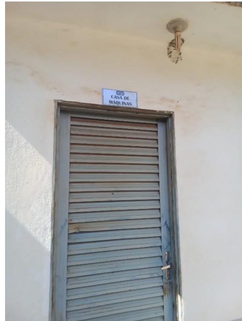
Foto 40 – Casa de máquinas
