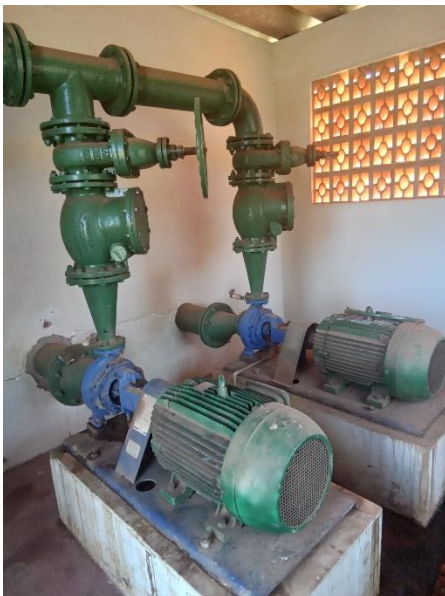
Foto 66 – Elevatória da mina
