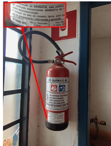
Foto 24 – Extintor (vencimento setembro/2024)
