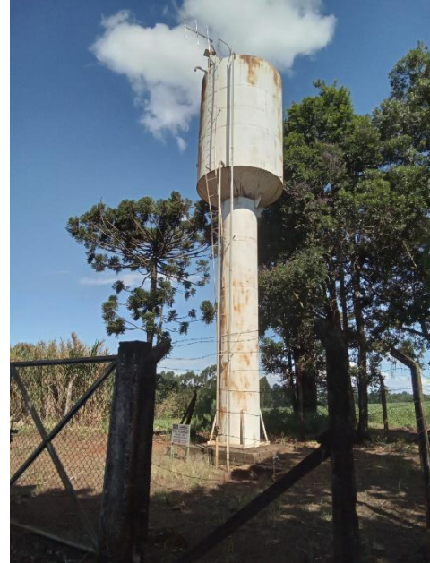
Foto 85 – Escada sem guarda corpo
