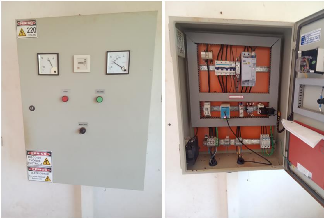
Foto 57 – Quadro de comando (fechado/aberto)
