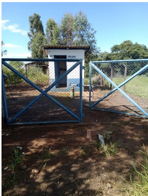
Foto 49 - Poço Vila Rural 001
