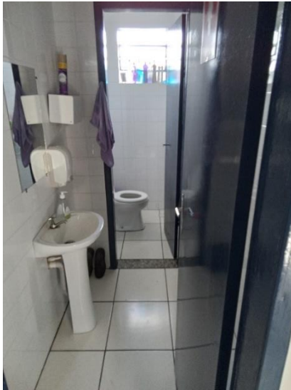
Foto 5 – Banheiro sem acessibilidade
