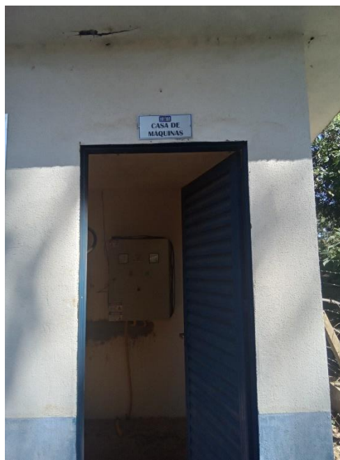
Foto 46 – Casa de máquinas
