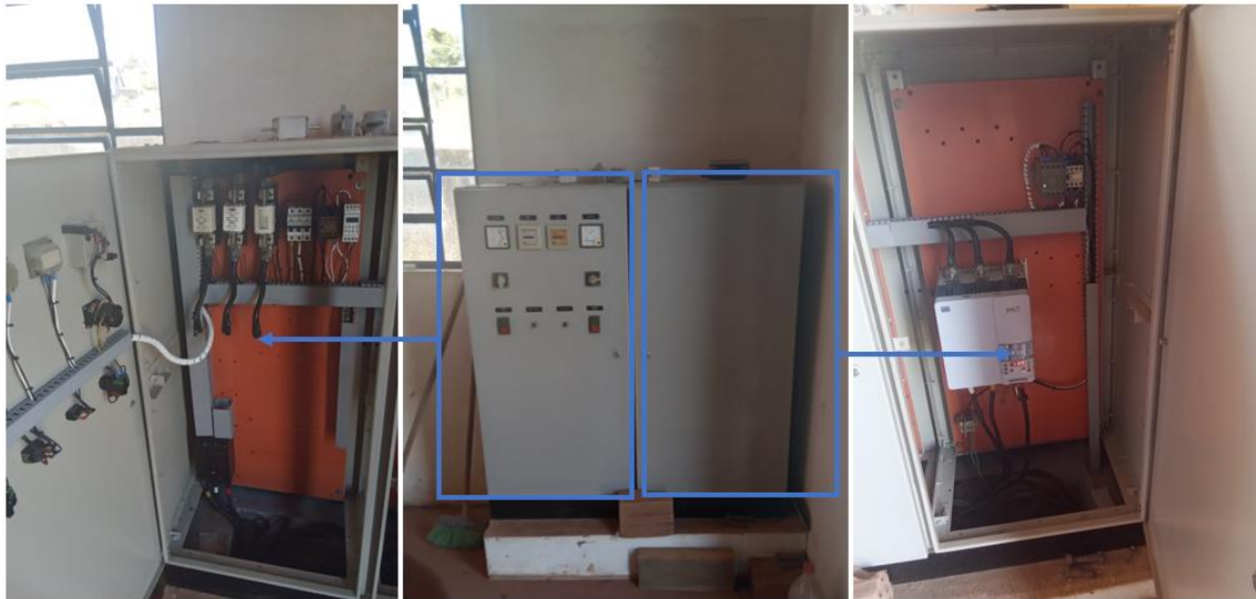
Foto 68 – Quadro de comando da (aberto/fechado/aberto) - mina
