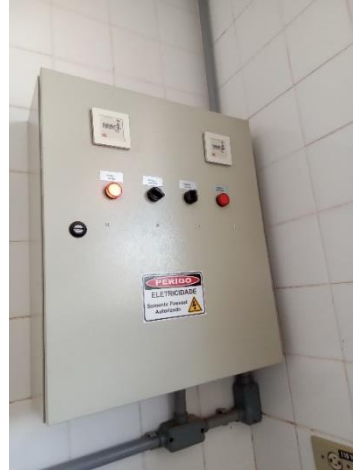
Foto 72 – Quadro de comando das dosadoras
