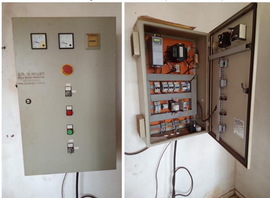
Foto 25 – Quadro de comando (fechado/aberto)
