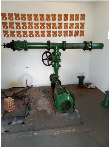
Foto 64 – Elevatória da SEDE
