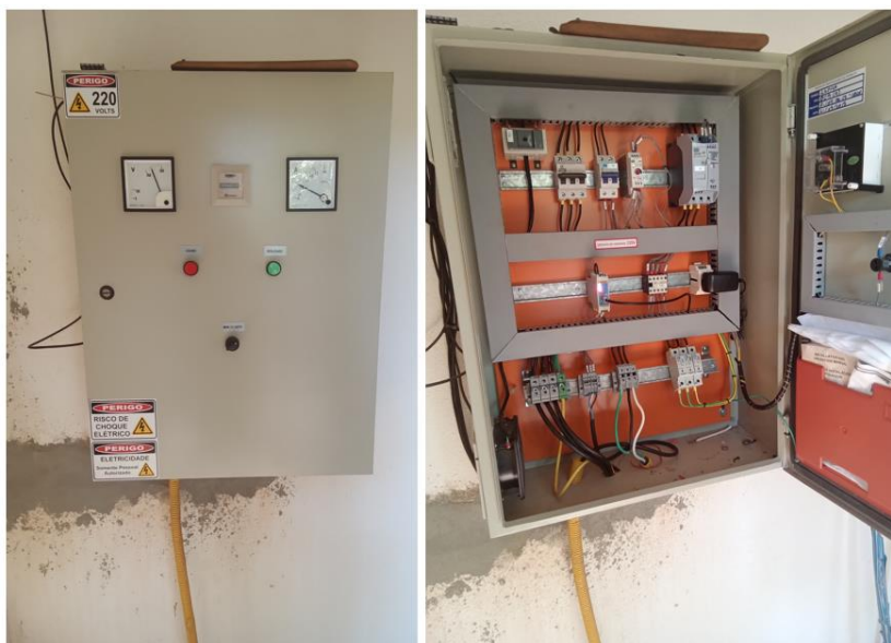
Foto 48 – Quadro de comando (fechado/aberto)
