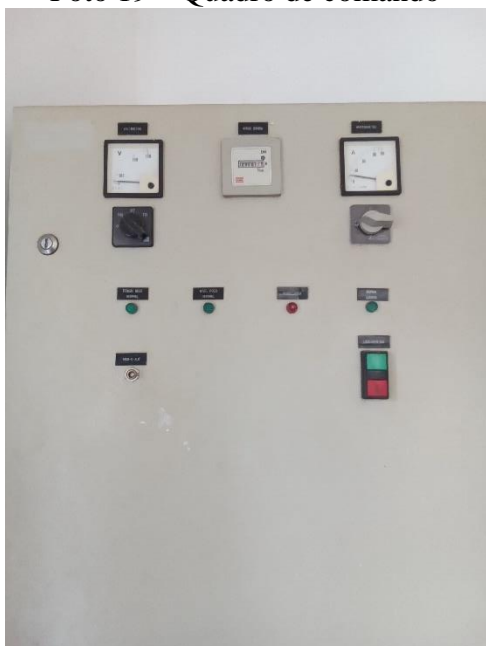
Foto 19 – Quadro de comando
