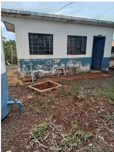
Foto 23 – Abrigo do quadro de comando
