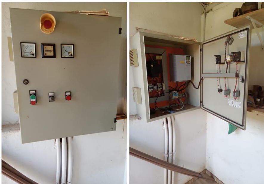
Foto 54 – Quadro de comando (fechado/aberto)
