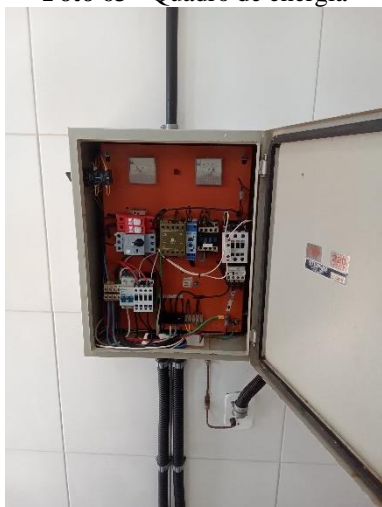
Foto 63 - Quadro de energia
