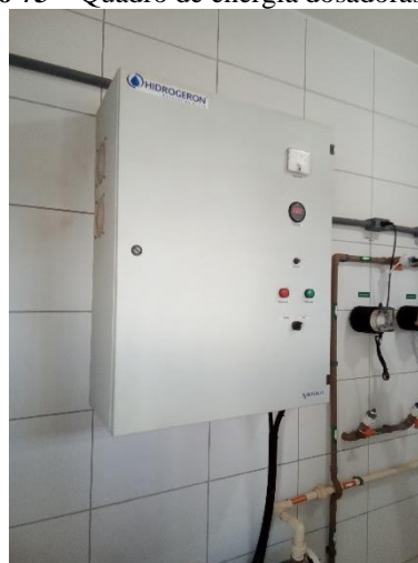
Foto 73 – Quadro de energia dosadoras sede
