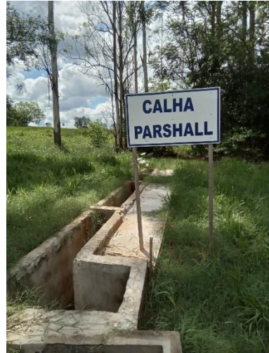
Foto 117 – Calha Parshall saída
