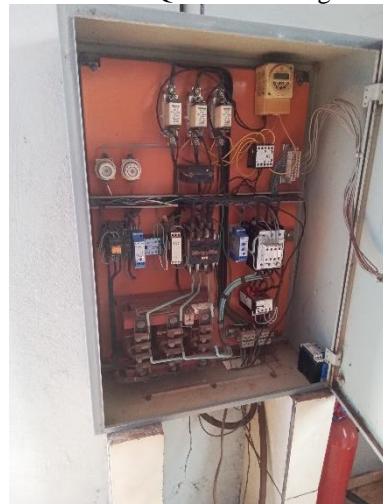
Foto 55 - Quadro de energia
