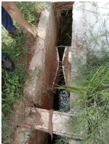
Foto 118 - Calha Parshall saída
