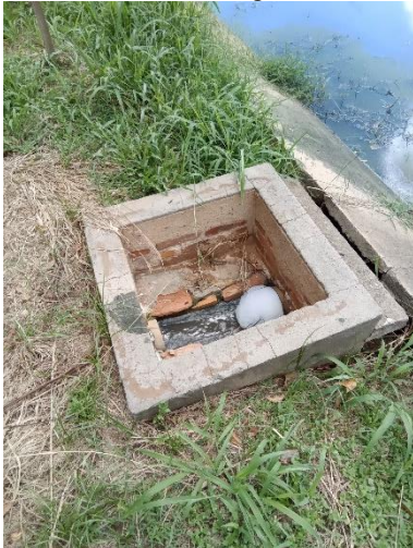
Foto 116 – Entrada lagoa facultativa
