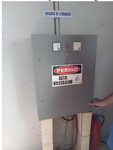
Foto 54 – Quadro de energia
