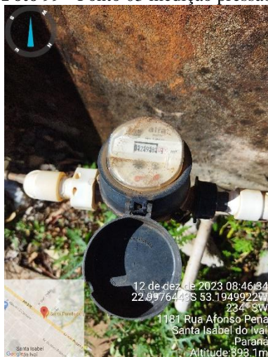
Foto 99 - Ponto 03 medição pressão
