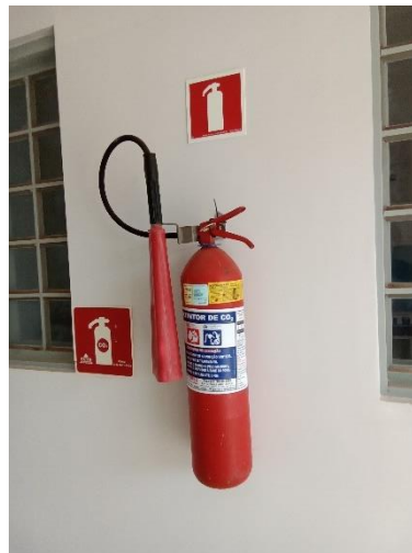
Foto 23 – Extintor Casa de Comando
