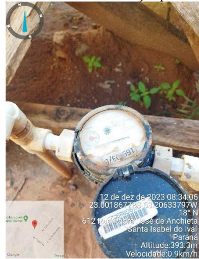
Foto 96 - Ponto 02 medição pressão
