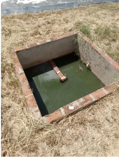
Foto 112 – Entrada lagoa anaeróbia 2
