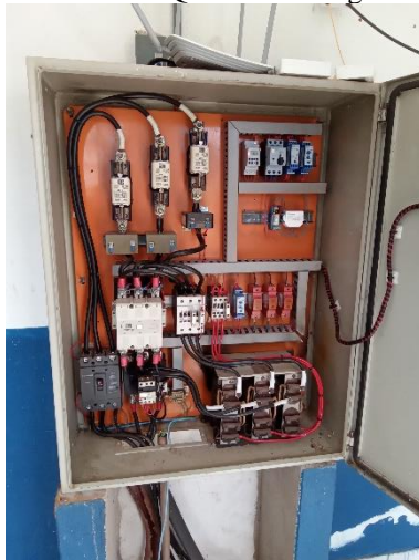
Foto 34 - Quadro de energia
