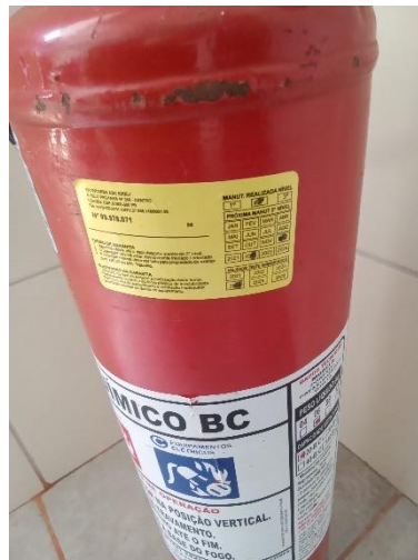
Foto 48 – Extintor validade vencido
