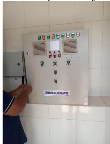
Foto 44 – Quadro de energia
