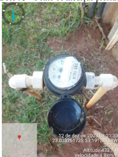
Foto 93 – Ponto 01 medição pressão
