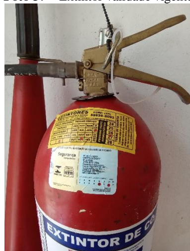
Foto 37 – Extintor validade vigente
