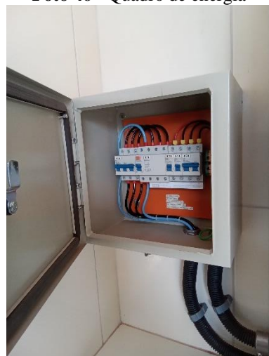
Foto 46 - Quadro de energia
