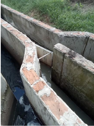
Foto 106 – Medição de nível calha parshall
