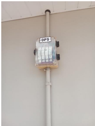
Foto 47 – Dispositivo de proteção contra surtos - DPS
