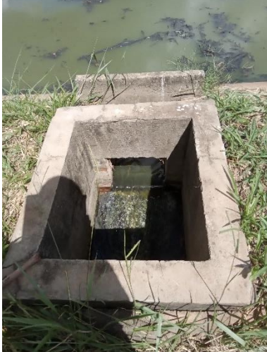
Foto 114 – Saída lagoa anaeróbia 2
