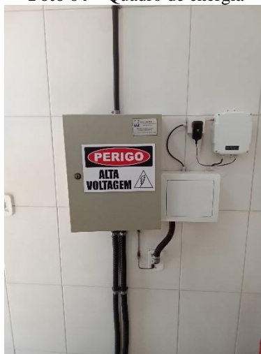
Foto 64 – Quadro de energia
