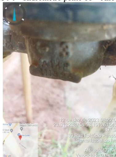
Foto 94 – Hidrômetro ponto 01 – Ano 2014
