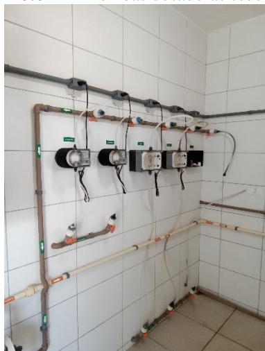
Foto 74 – Bombas dosadoras sede
