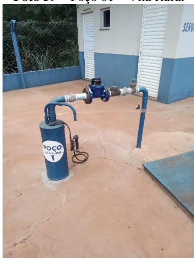
Foto 59 – Poço 01 – Vila Rural
