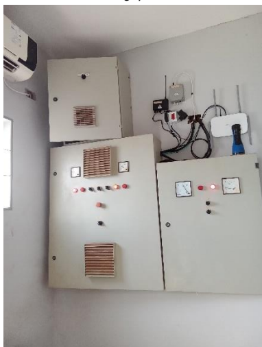
Foto 24 – Quadros de energia comuns aos poços 1, 4 e 7
