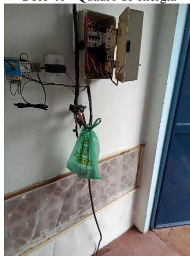
Foto 46 - Quadro de energia
