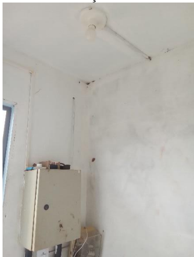
Foto 60 – Iluminação casa de comando
