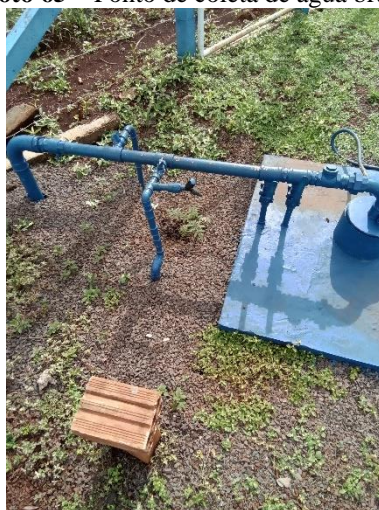
Foto 65 – Ponto de coleta de água bruta
