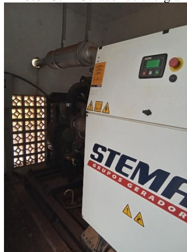
Foto 135 – Gerador de energia
