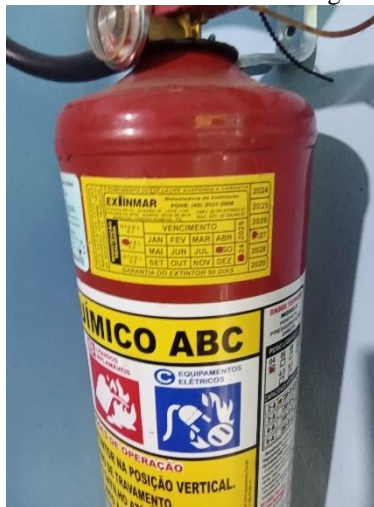
Foto 85 – Extintor validade vigente
