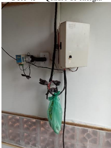
Foto 45 – Quadro de energia
