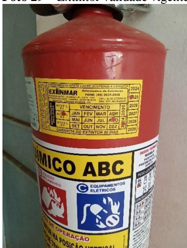
Foto 29 – Extintor validade vigente
