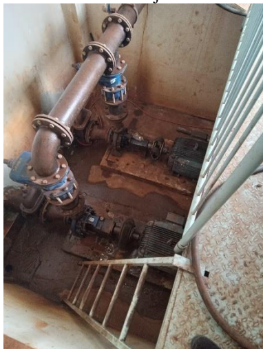
Foto 136 – Acesso conjunto motobomba
