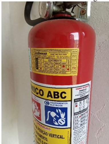
Foto 68 – Extintor validade vigente
