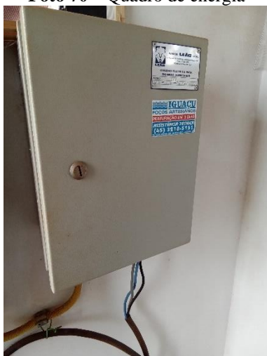
Foto 70 – Quadro de energia
