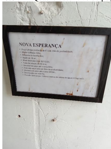
Foto 57 – Quadro descritivo do poço
