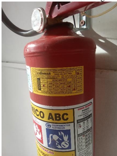
Foto 51 – Extintor validade vigente
