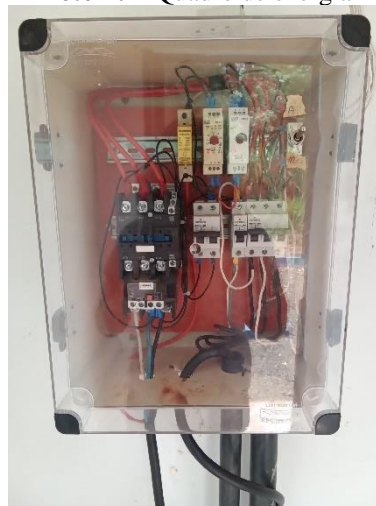
Foto 20 – Quadro de energia
