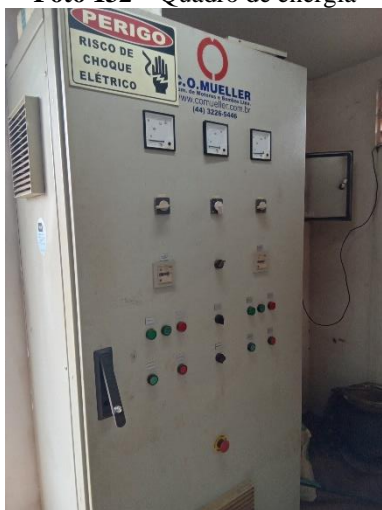
Foto 132 – Quadro de energia
