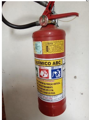
Foto 137 – Extintor com validade vigente
