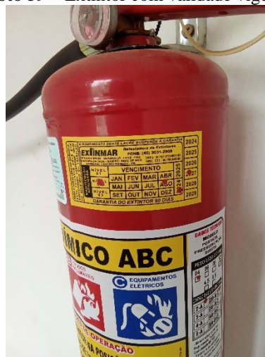
Foto 59 – Extintor com validade vigente
