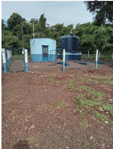
Foto 142 – Acesso elevatória Sanga Alegre
