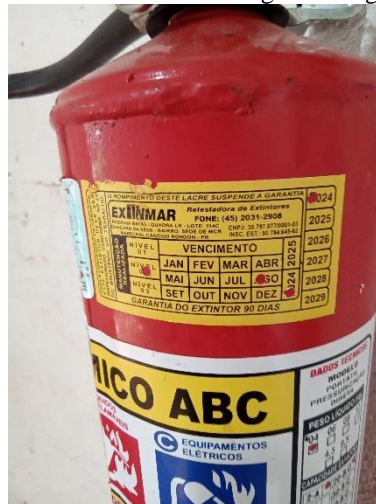
Foto 139 – Extintor validade vigente Sanga Alegre
