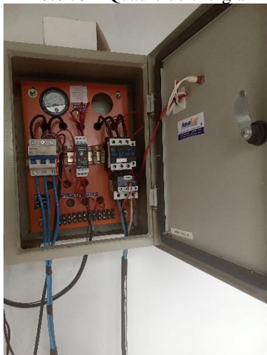
Foto 53 – Quadro de energia
