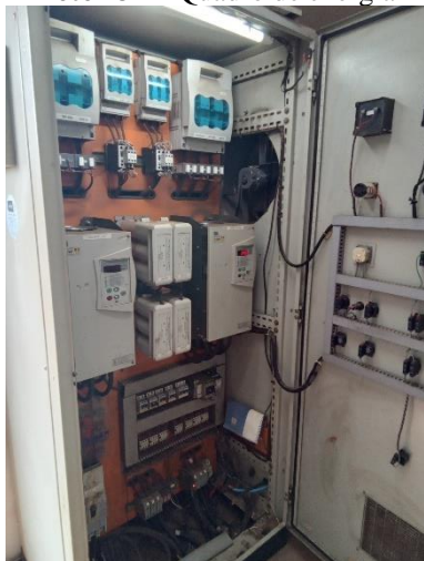
Foto 134 – Quadro de energia
