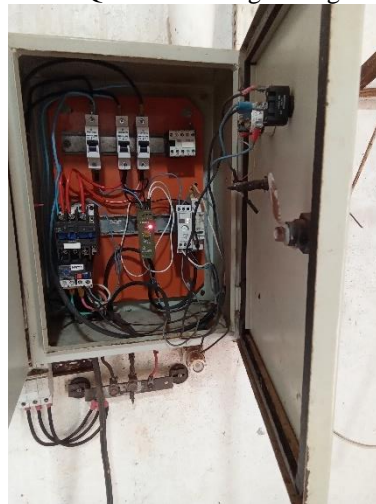
Foto 141 - Quadro de energia Sanga Alegre
