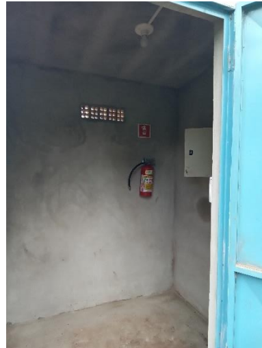
Foto 34 – Casa de comando iluminação e extintor
