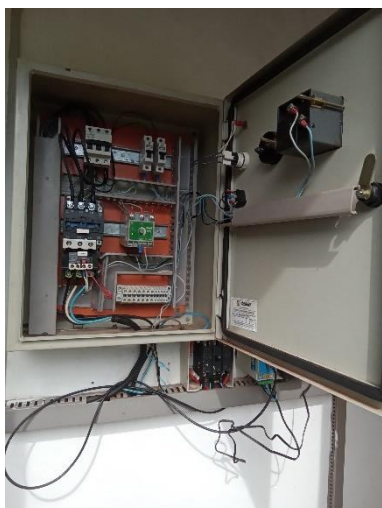
Foto 78 – Quadro de energia
