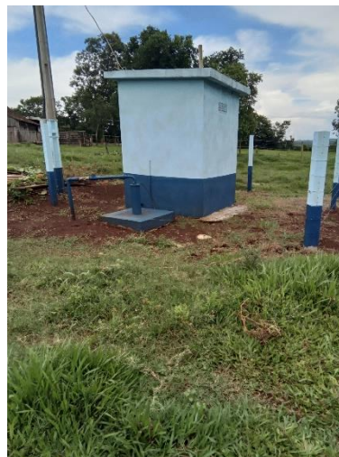
Foto 38 – Cercamento incompleto (falta alambrado e portão)
