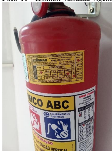
Foto 44 – Extintor validade vigente
