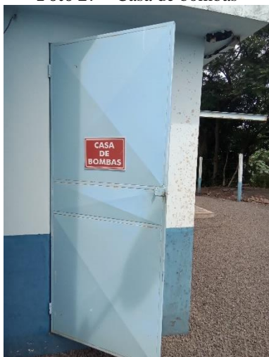
Foto 27 – Casa de bombas
