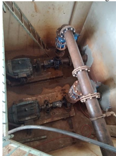
Foto 131 – Conjunto motobomba Sanga Mineira
