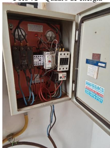
Foto 71 - Quadro de energia
