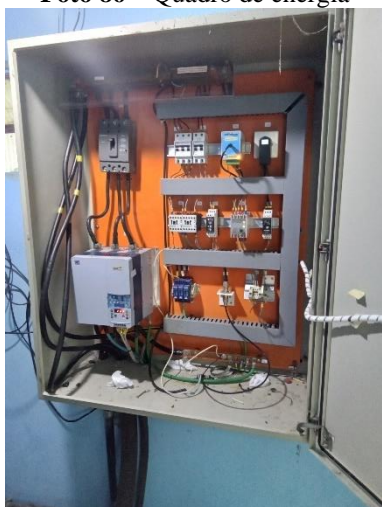
Foto 86 – Quadro de energia
