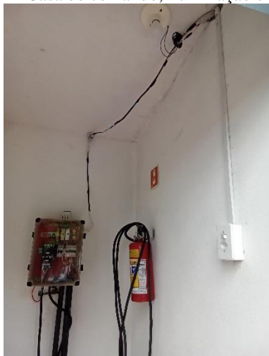
Foto 19 – Casa de comando, iluminação e extintor
