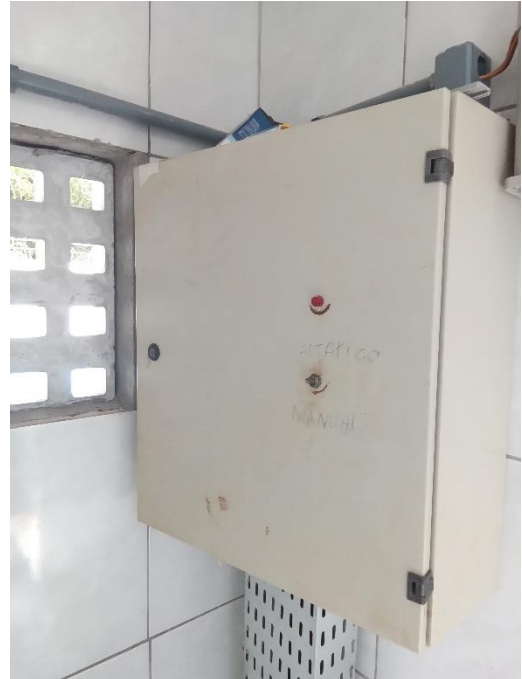
Foto 100 – Quadro de comando
