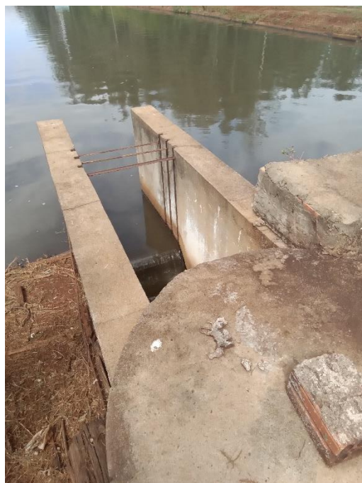
Foto 175 – Dispositivo de saída lagoa facultativa
