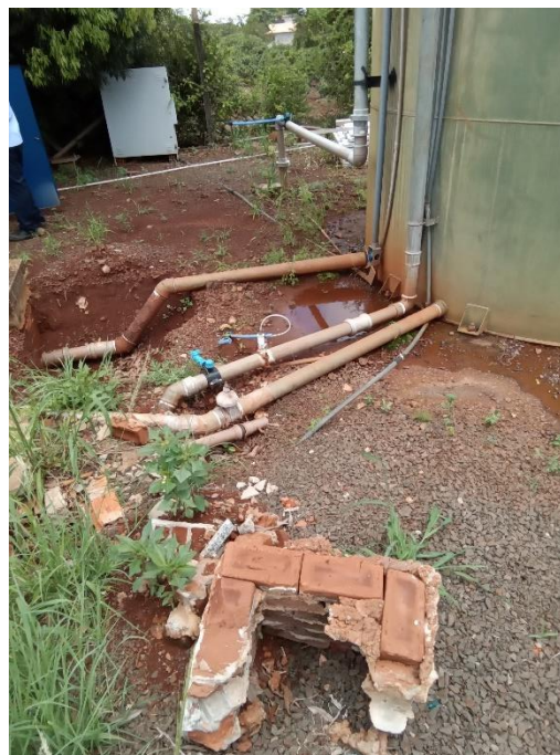
Foto 118 – Sinais de vazamento
