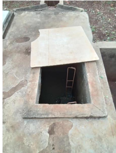
Foto 165 – Acesso caixa detentora (sem tampa e cadeado)
