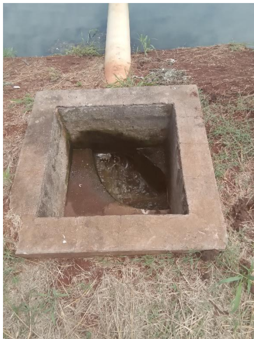
Foto 192 – Entrada lagoa anaeróbia 1
