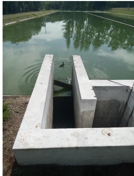
Foto 181 – Dispositivo de saída lagoa facultativa
