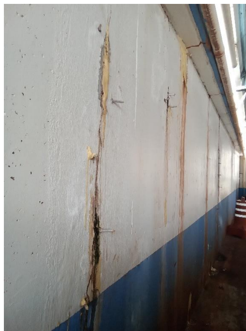
Foto 115 – Sinais de vazamento
