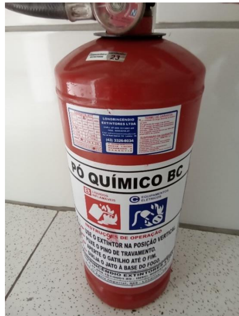
Foto 53 – Extintor de incêndio
