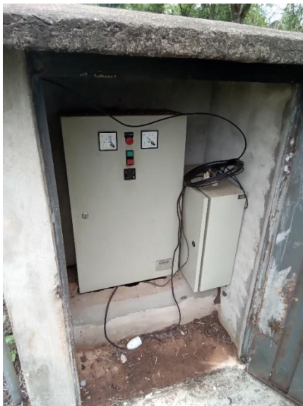
Foto 44 – Quadro de comando
