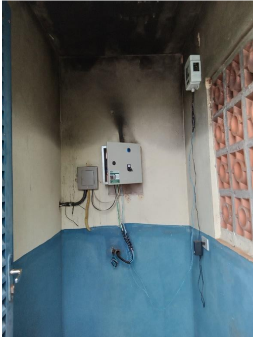
Foto 92 – Quadro de comando
