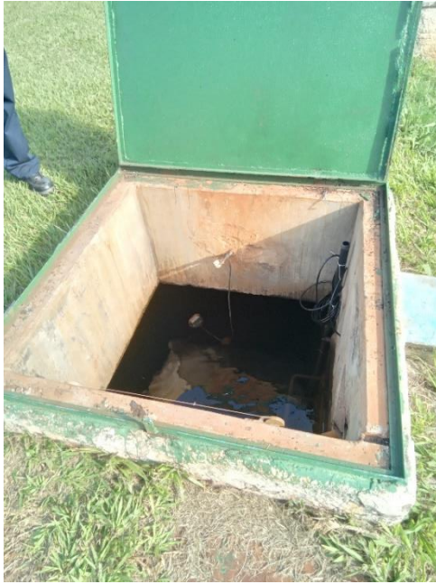
Foto 110 – Caixa de inspeção
