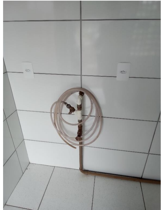
Foto 97 – Tomada para coleta de água
