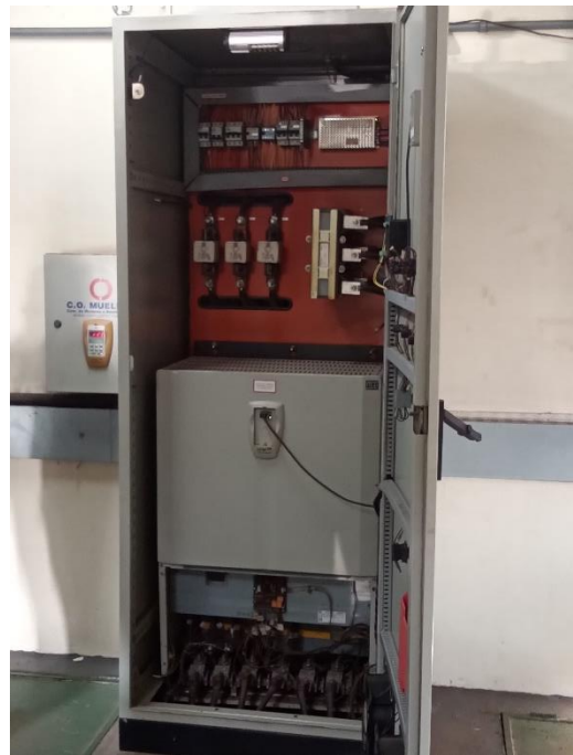
Foto 132 – Quadro de comando aberto
