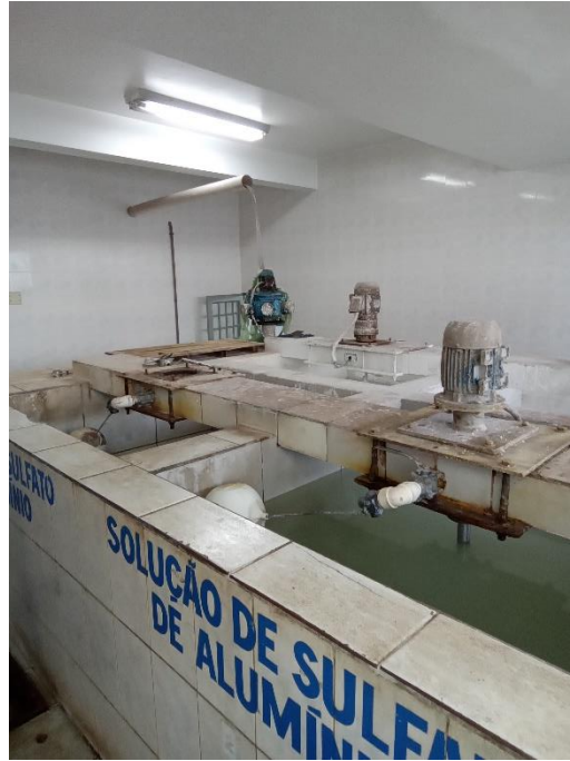
Foto 72 – Tanque com solução de sulfato de alumínio
