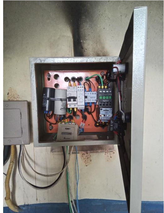
Foto 93 – Quadro de comando aberto
