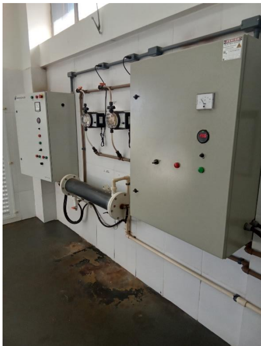
Foto 79 – Quadro de comando
