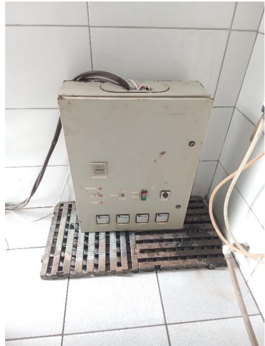
Foto 108 – Quadro de comando
