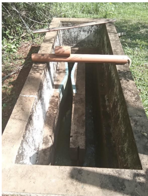
Foto 182 – Calha Parshall e caixa de areia
