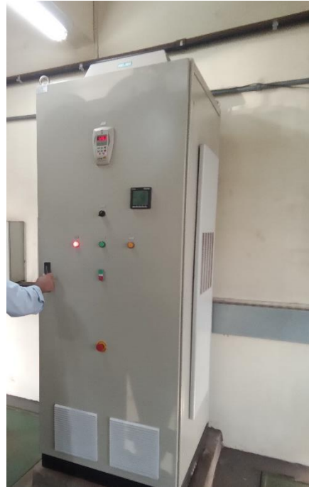
Foto 130 – Quadro de comando
