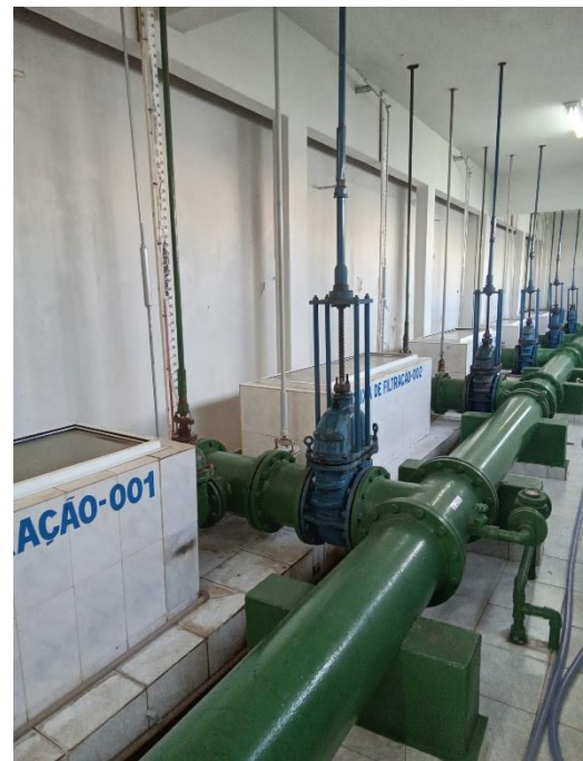
Foto 71 – Tanque de filtração
