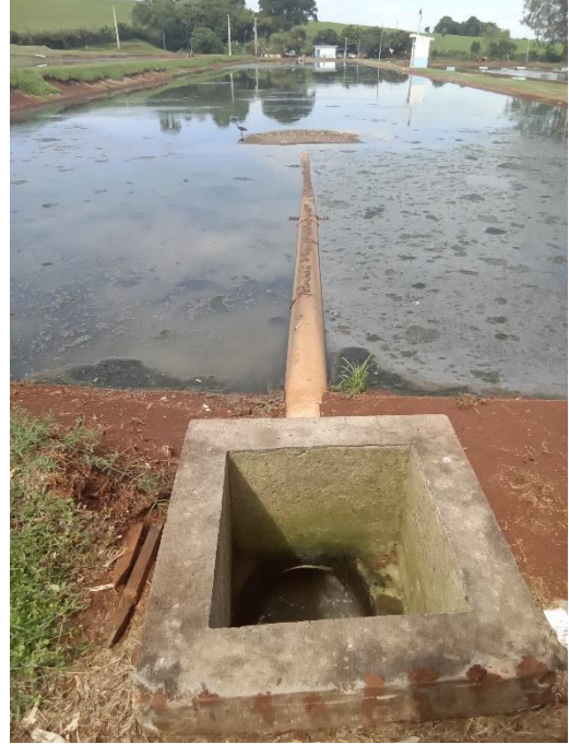
Foto 172 – Entrada lagoa anaeróbia 2
