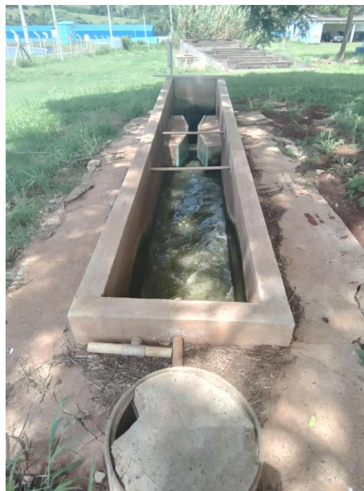
Foto 199 – Calha parshall saída da ETE
