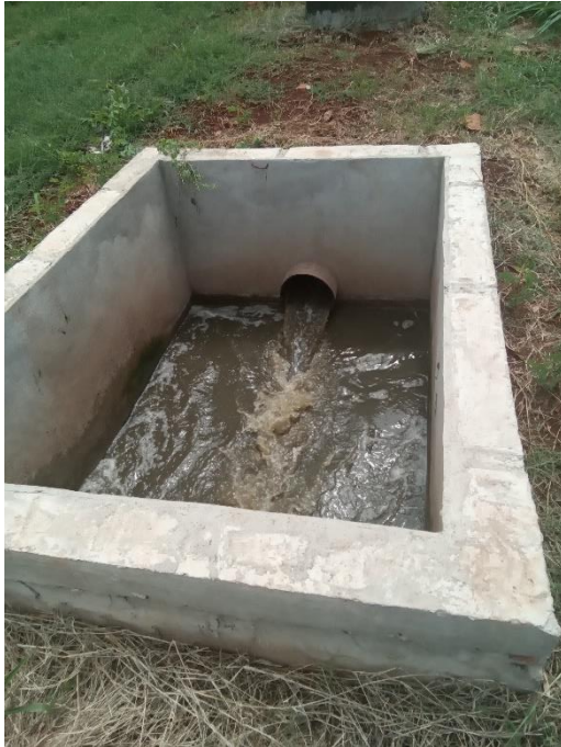
Foto 186 – Caixa de passagem
