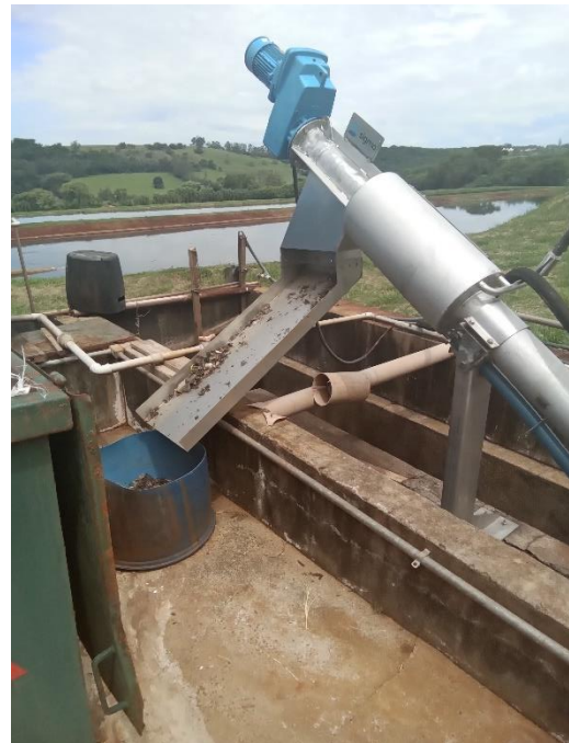
Foto 189 – Sistema de limpeza gradeamento
