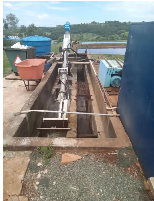
Foto 187 – Calha Parshall, gradeamento, sistema de limpeza gradeamento e desarenador
