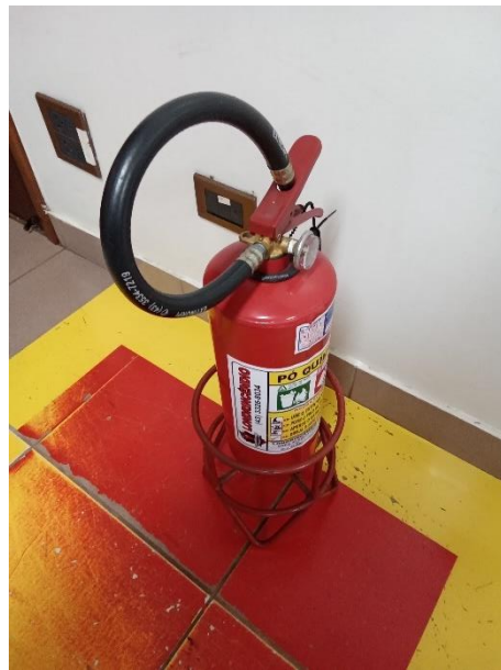
Foto 10 – Extintor de incêndio
