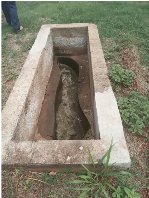
Foto 188 – Lagoa facultativa (by pass)
