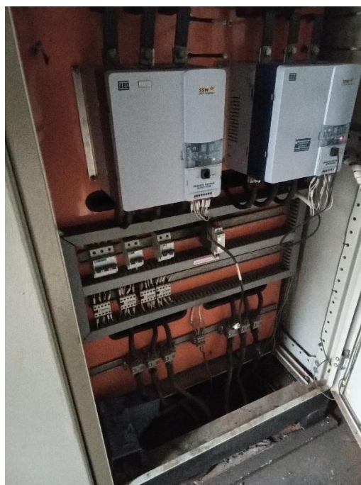
Foto 163 – Quadro de comando aberto
