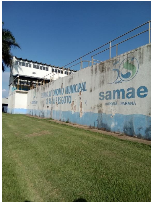
Foto 123 – Sinalização de uso para abastecimento público
