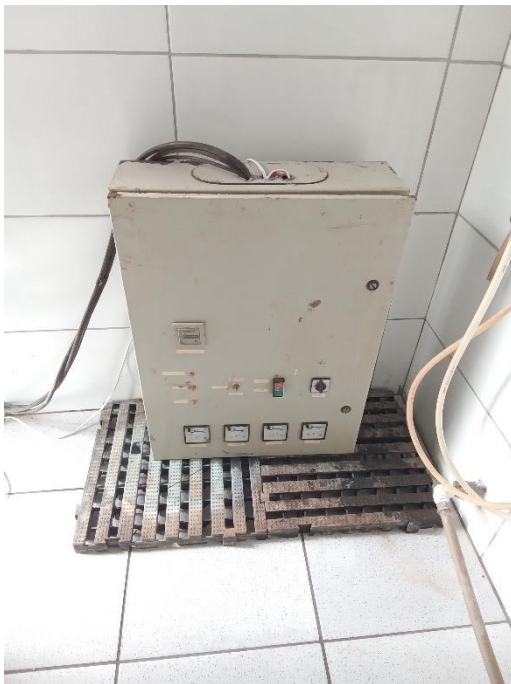
Foto 58 – Quadro de comando
