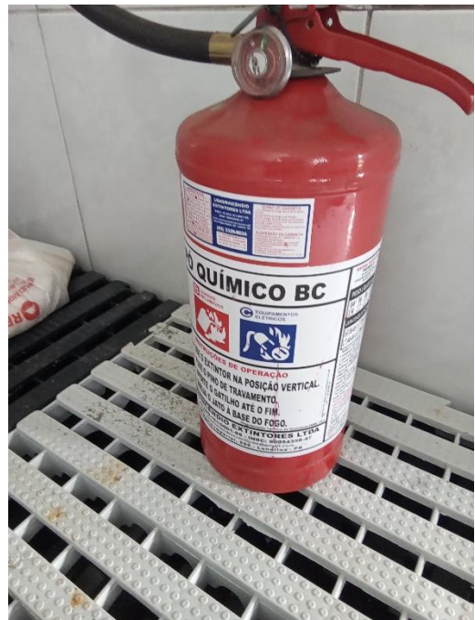
Foto 86 – Extintor de incêndio
