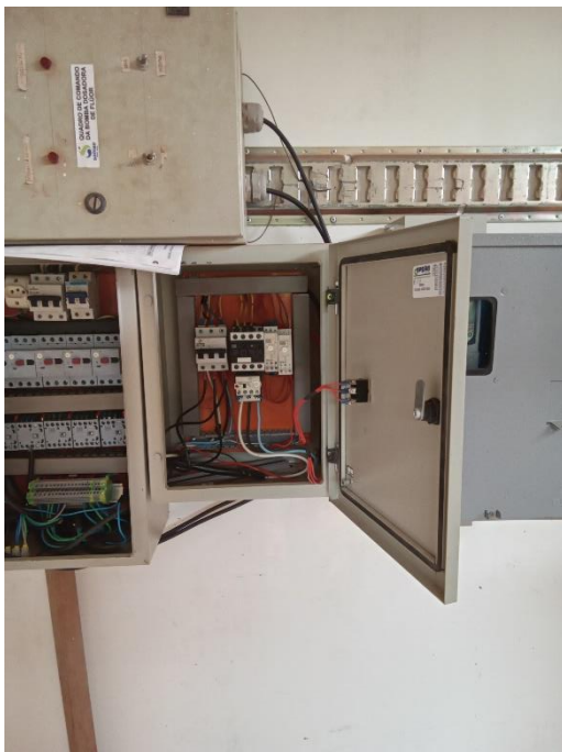
Foto 208 – Quadro de comando aberto
