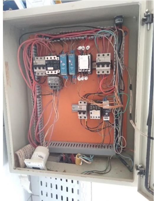
Foto 40 – Quadro de comando aberto
