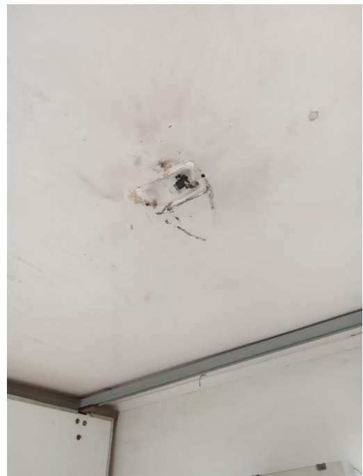
Foto 209 – Local sem iluminação
