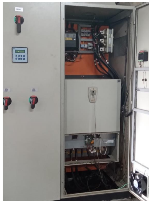
Foto 134 – Quadro de comando aberto
