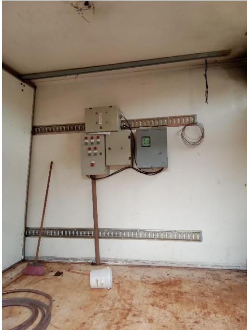
Foto 206 – Quadro de comando
