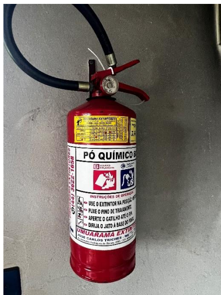
Foto 54 – Extintor casa de comando poço 4 (validade agosto/2024)
