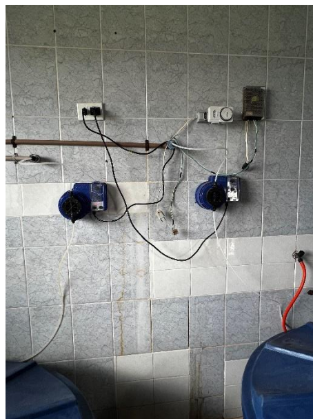
Foto 24 – Bombas dosadoras UTA 02
