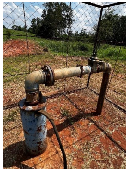
Foto 32 - Falta de macromedidor e tomada de água bruta poço 1
