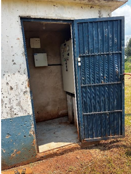
Foto 40 – Falta de identificação casa de comando poço 2
