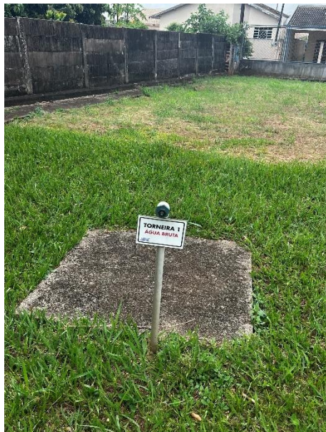
Foto 51 – Captação água bruta poço 4
