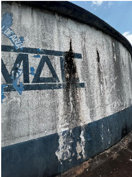
Foto 60 – Sinal de vazamento
