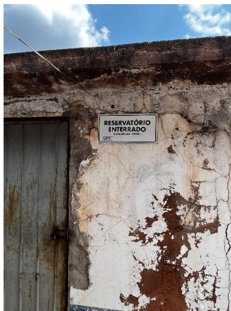
Foto 69- Identificação REN unidade de tratamento
