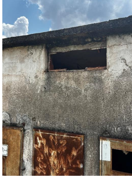
Foto 34 – Falta de tela casa de comando
