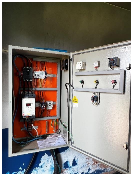
Foto 53 – Quadro de comando poço 4
