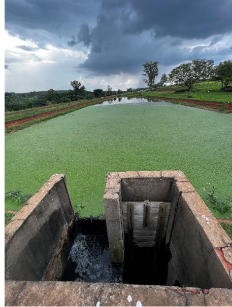
Foto 94 – Saída lagoa anaeróbia 01 não está afogada
