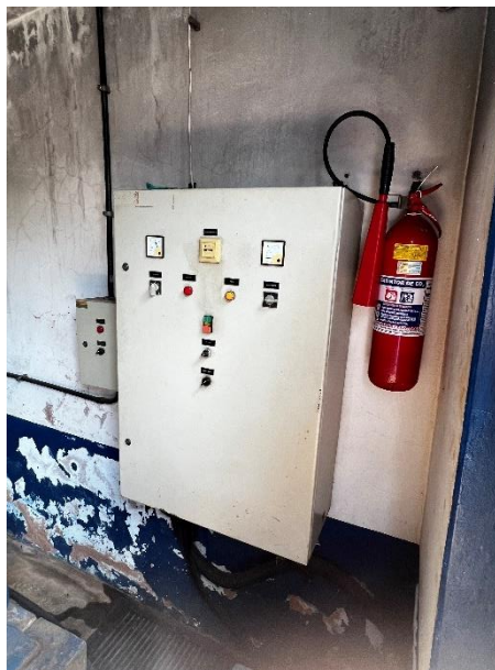
Foto 46 – Frente do quadro de comando poço 3
