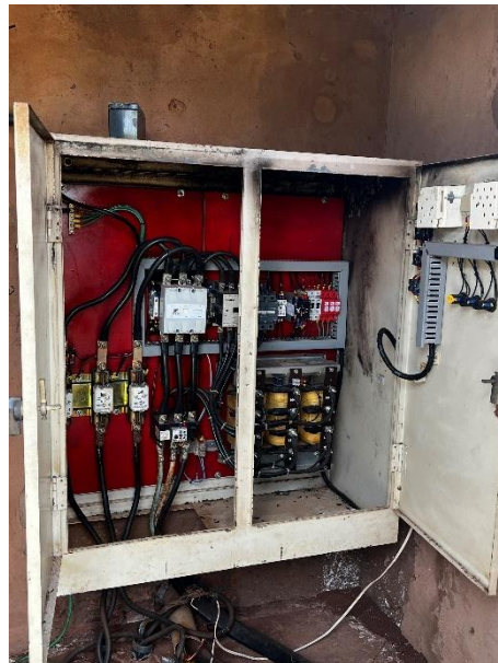
Foto 36 – Quadro de comando poço 1
