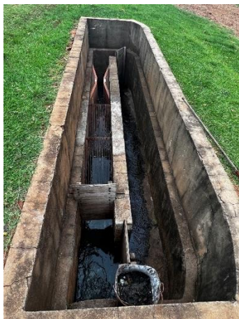
Foto 89 – Gradeamento, desarenador e calha Parshall entrada ETE
