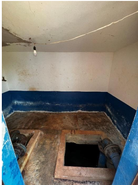
Foto 70 – Sem tampas reservatório enterrado
