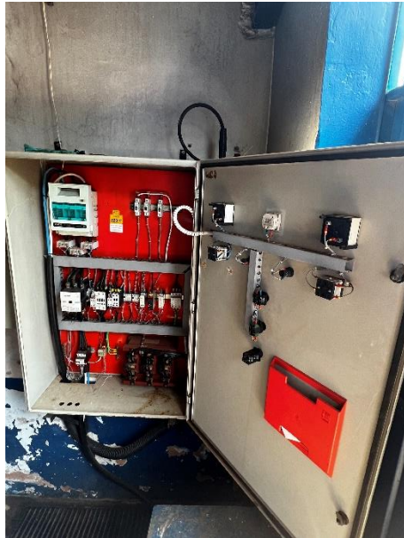
Foto 47 – Quadro de comando poço 3
