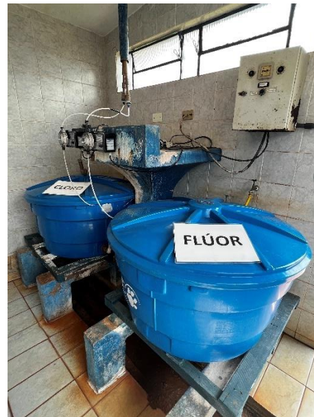
Foto 28 – Unidade de tratamento 01
