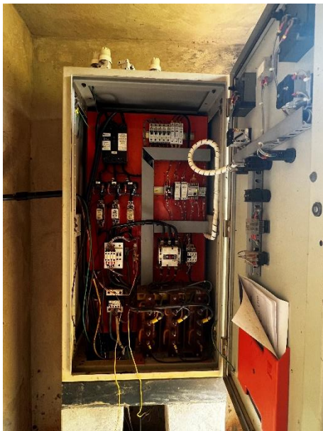
Foto 42 – Quadro de comando poço 2
