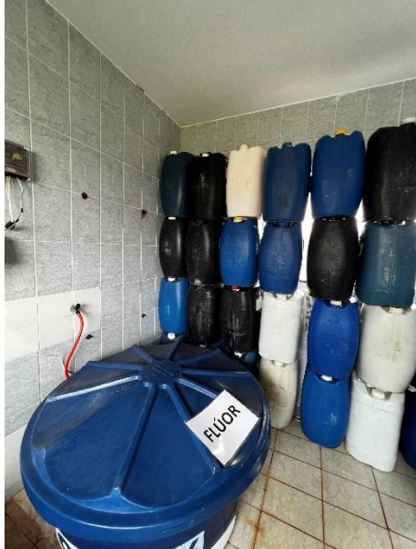
Foto 25 – Estoque de produtos químicos junto com UTA 02
