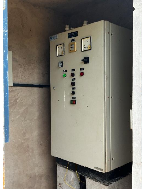
Foto 41 – Frente do quadro de comando poço 2
