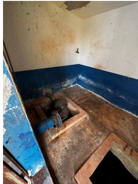
Foto 71 – Interna cobertura REN unidade de tratamento
