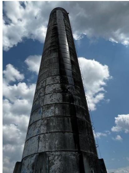
Foto 66 – Sinal de vazamentos REL Praça Central
