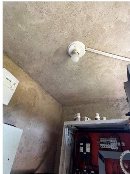
Foto 43 – Iluminação casa de comando poço 2
