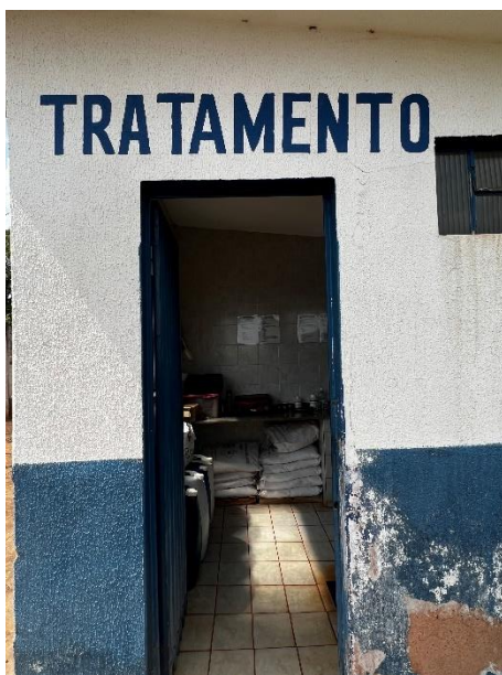
Foto 15 – Local inadequado para funcionamento do laboratório
