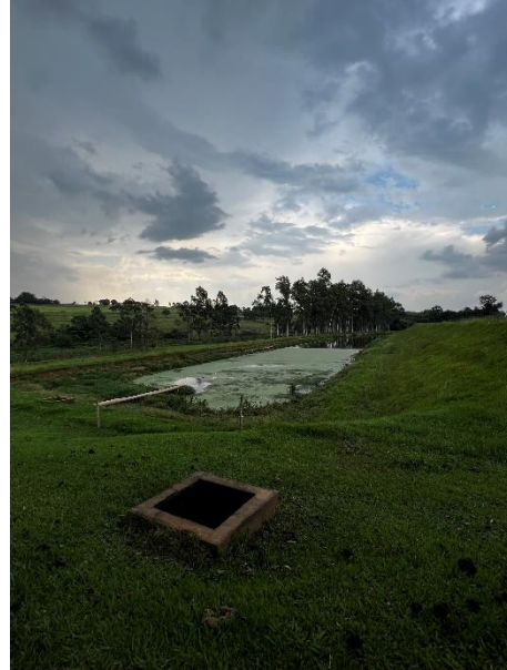
Foto 98 – Lagoa facultativa 02 – assoreamento, danos estruturais, vegetação dentro da lagoa e eutrofização
