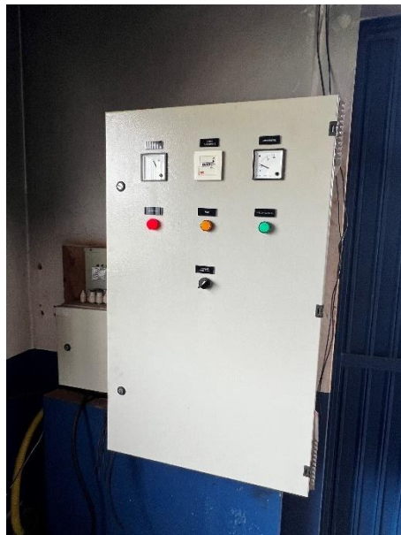
Foto 52 – Frente do quadro de comando poço 4
