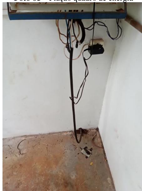
Foto 61 – Fiação quadro de energia
