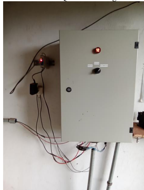
Foto 36 – Quadro de energia
