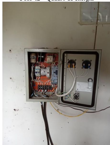
Foto 42 – Quadro de energia
