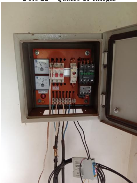
Foto 21 – Quadro de energia
