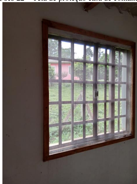
Foto 22 – Tela de proteção casa de comando
