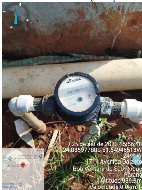
Foto 106 – Ponto 3 medição de pressão
