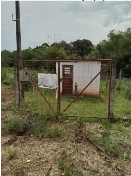
Foto 39 – Acesso e identificação poço Cristo Rei
