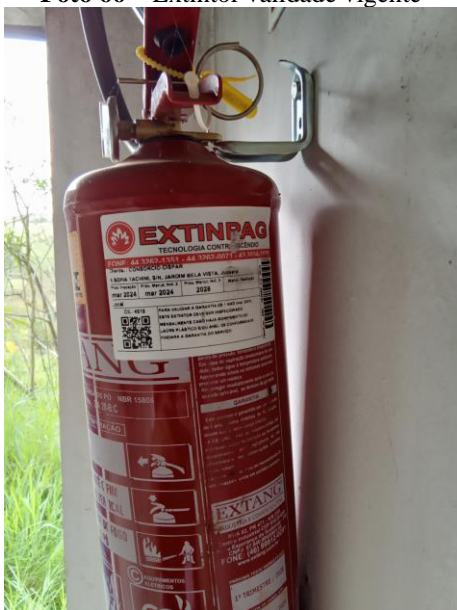
Foto 66 – Extintor validade vigente
