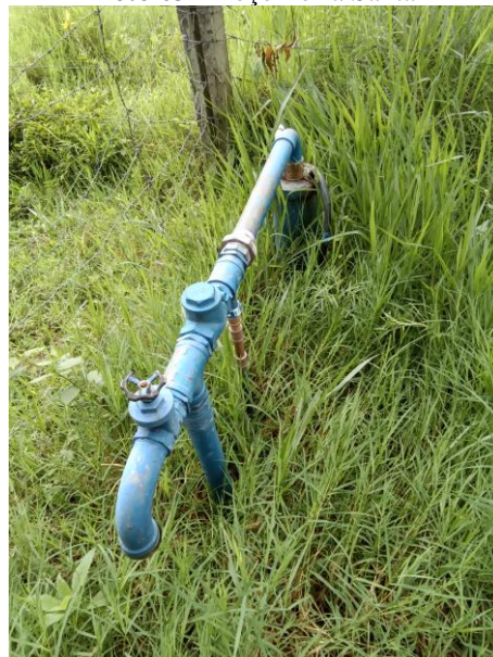
Foto 63 – Poço Terra Santa
