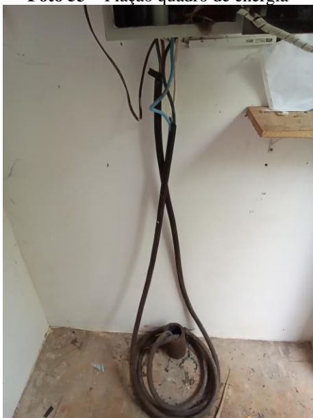
Foto 53 – Fiação quadro de energia
