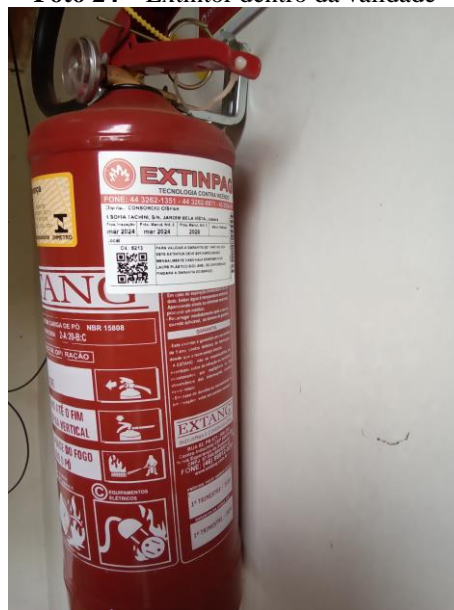
Foto 24 – Extintor dentro da validade
