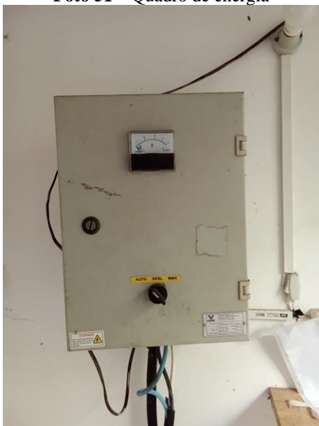
Foto 51 – Quadro de energia
