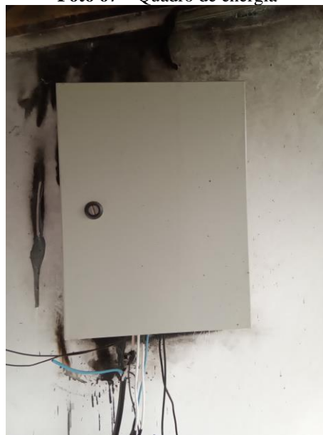
Foto 67 – Quadro de energia
