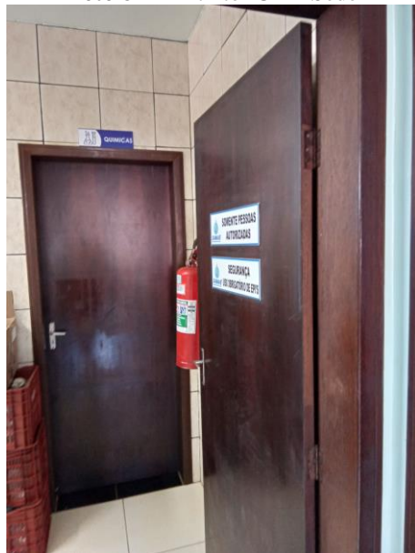
Foto 81 – Extintor UTA Sede
