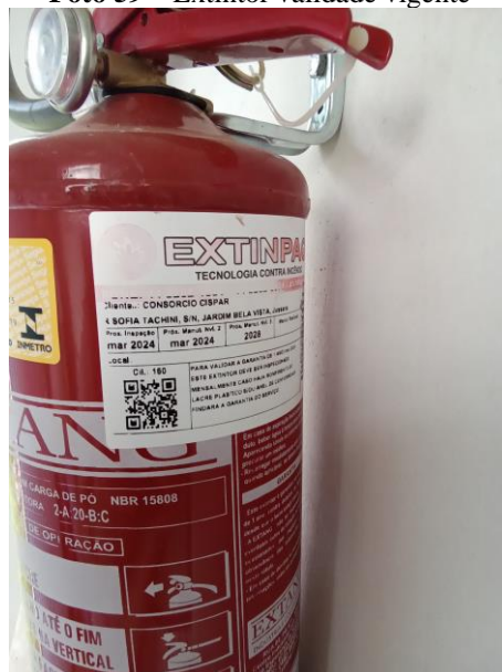
Foto 59 – Extintor validade vigente
