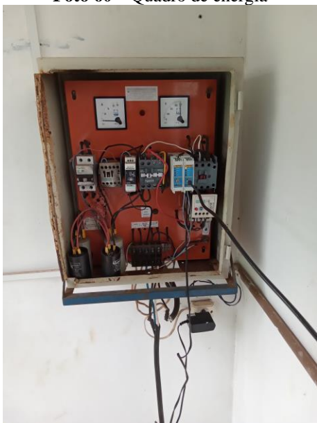
Foto 60 – Quadro de energia
