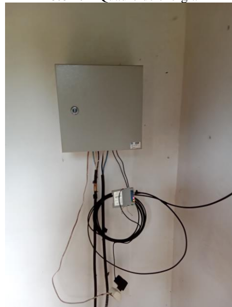
Foto 20 – Quadro de energia
