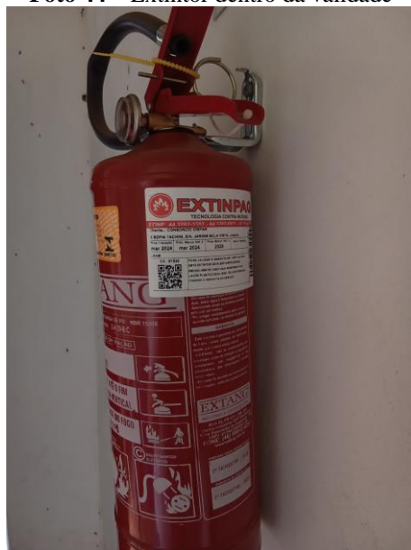
Foto 44 – Extintor dentro da validade
