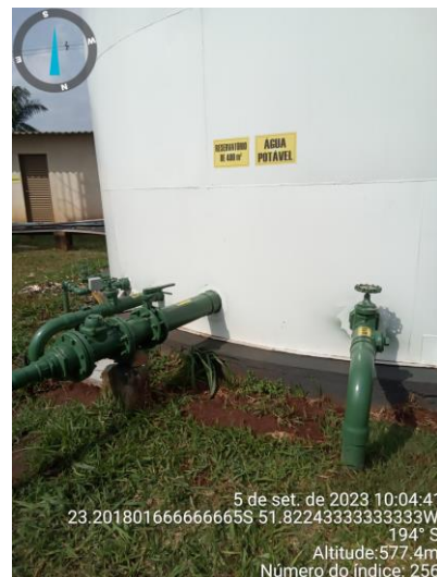
Foto 53 - Tubulações do reservatório
