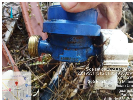
Foto 60 - Hidrômetro do ponto 2
