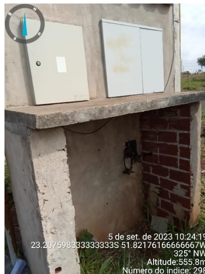
Foto 41 - Quadro de energia do poço 05
