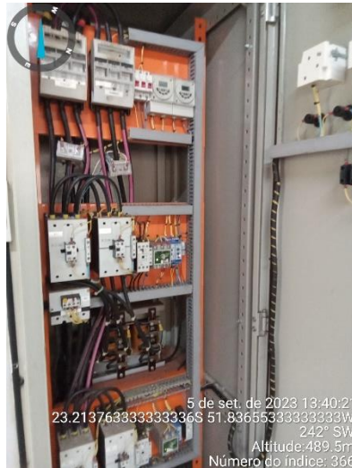
Foto 47 - Interior do quadro de energia
