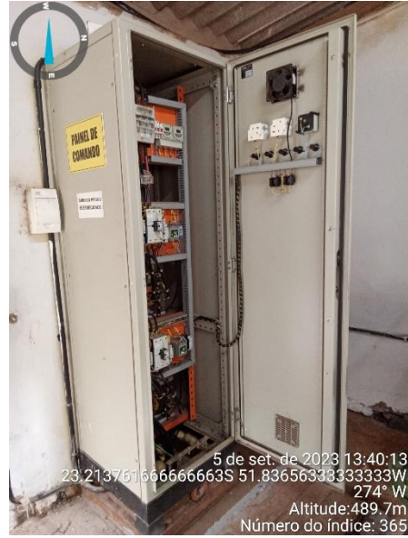
Foto 46 - Quadro de energia
