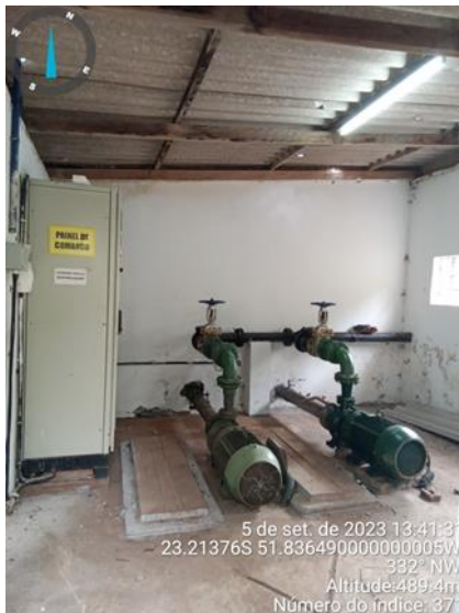
Foto 48 – Elevatória da mina 01
