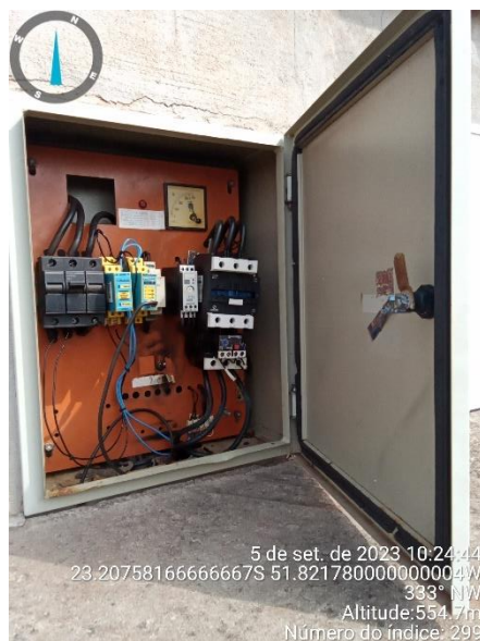
Foto 42 - Quadro de energia do poço 05 (aberto)
