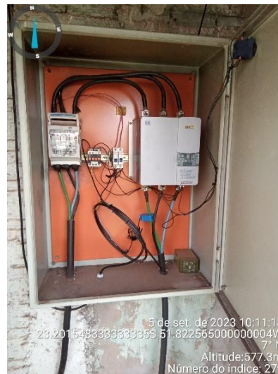
Foto 22 - Quadro de energia (aberto)
