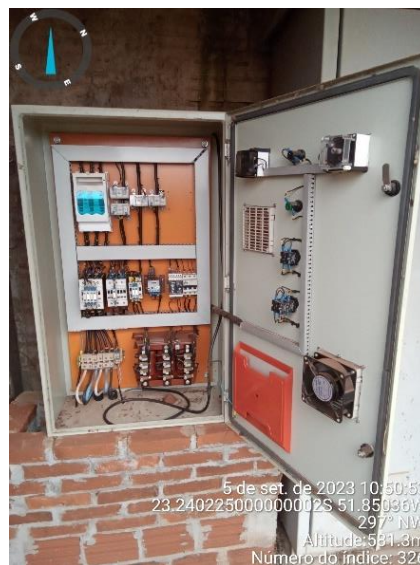
Foto 32 - Quadro de comando do poço 03 (aberto)
