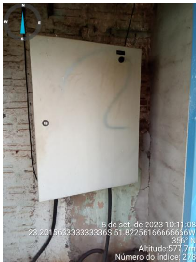
Foto 21 - Quadro de energia (fechado)
