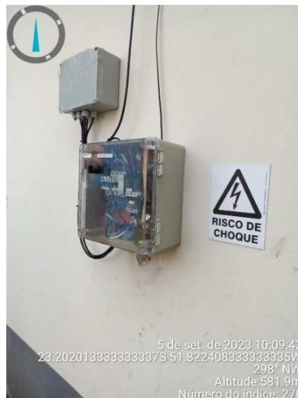
Foto 25 - Quadro de comando do poço 02
