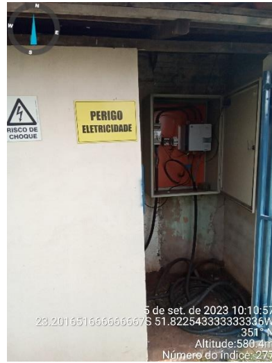
Foto 20 - Interior da casa de comando
