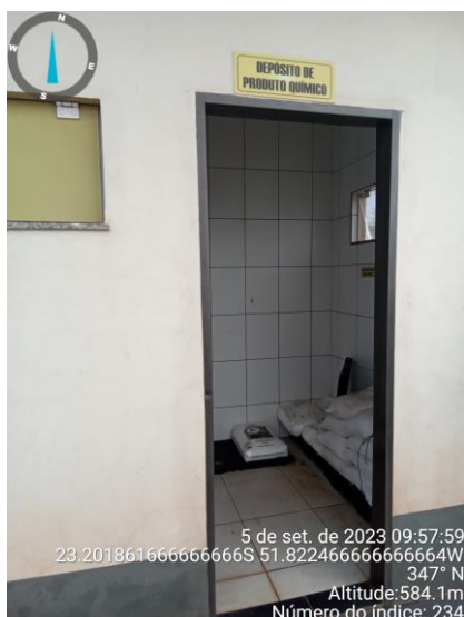
Foto 10 - Depósito de produtos químicos
