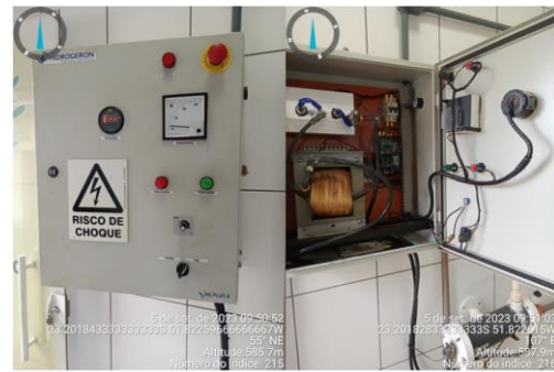
Foto 15 - Quadro de energia (aberto/fechado)
