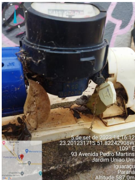
Foto 58 - Hidrômetro do ponto 1
