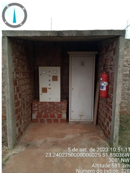
Foto 31 - Quadro de comando do poço 03
