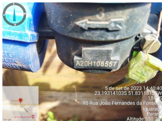
Foto 61 - Identificação do hidrômetro do ponto 3
