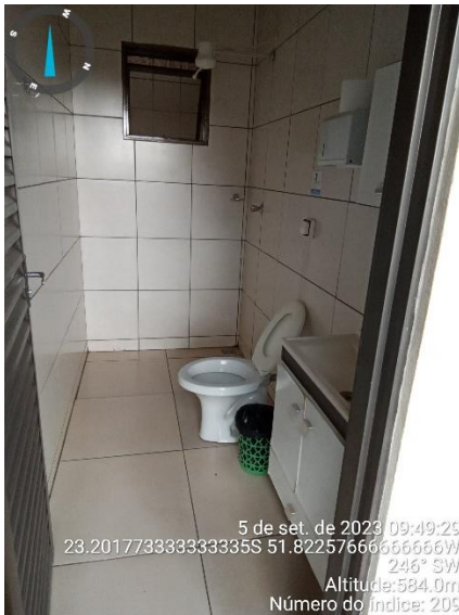
Foto 3 - Banheiro sem acessibilidade
