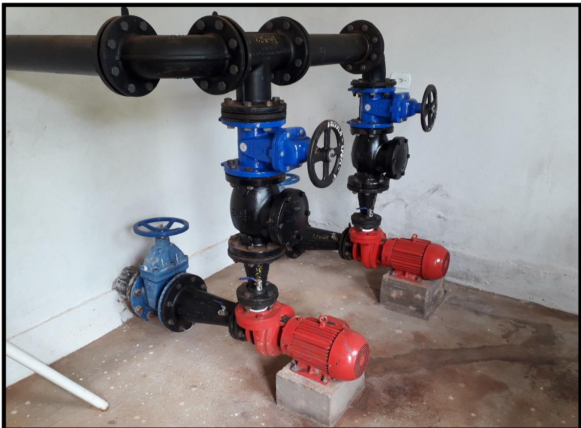
Imagem 11: Estação Elevatória de água tratada
