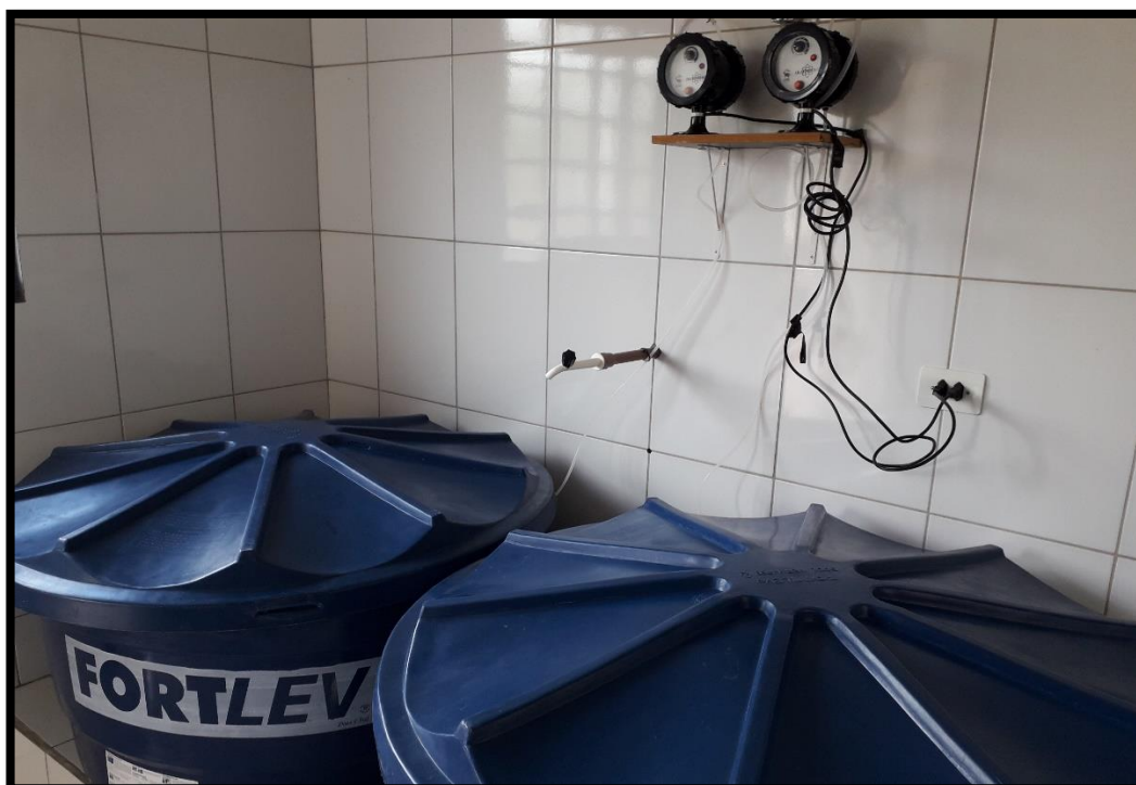
Imagem 7: Unidade de tratamento
