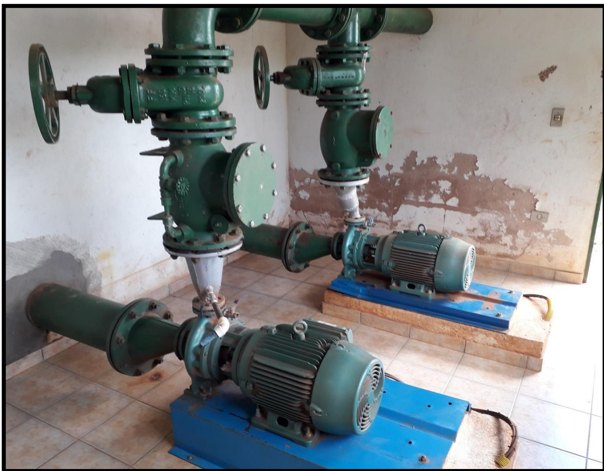
Imagem 9: Estação Elevatória de água bruta
