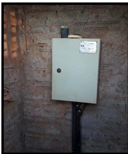
Imagem 2: Quadro de comando do poço
