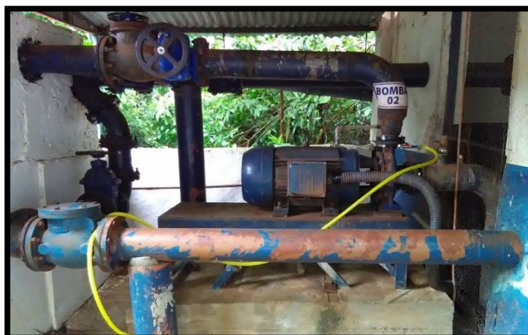
Imagem 11: Conjunto moto-bomba 02 da elevatória da captação
