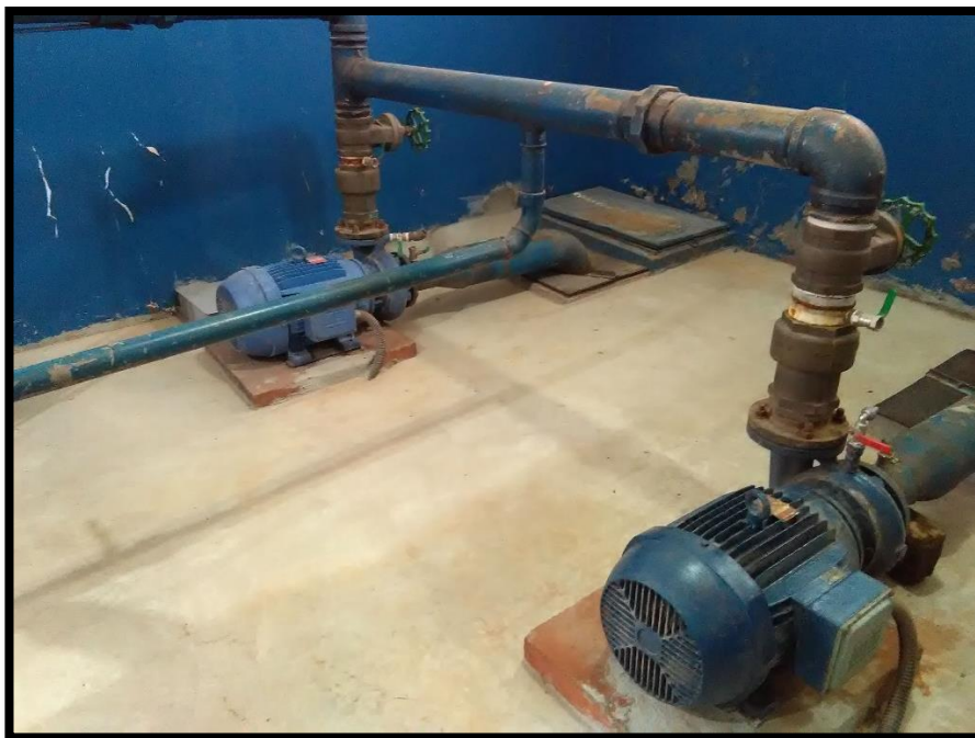
Imagem 14: Conjuntos moto-bombas da elevatória de água tratada
