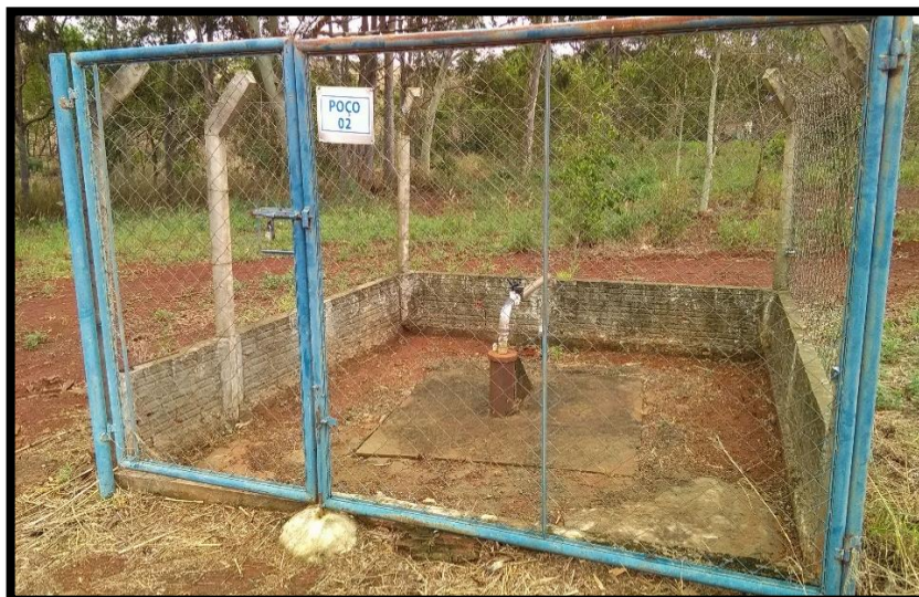
Imagem 03: Barrilete do poço 2
