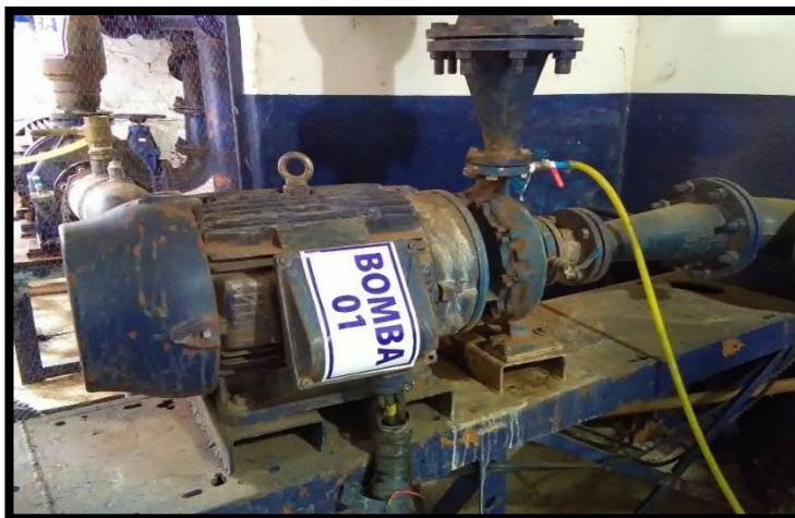
Imagem 10: Conjunto moto-bomba 01 da elevatória da captação
