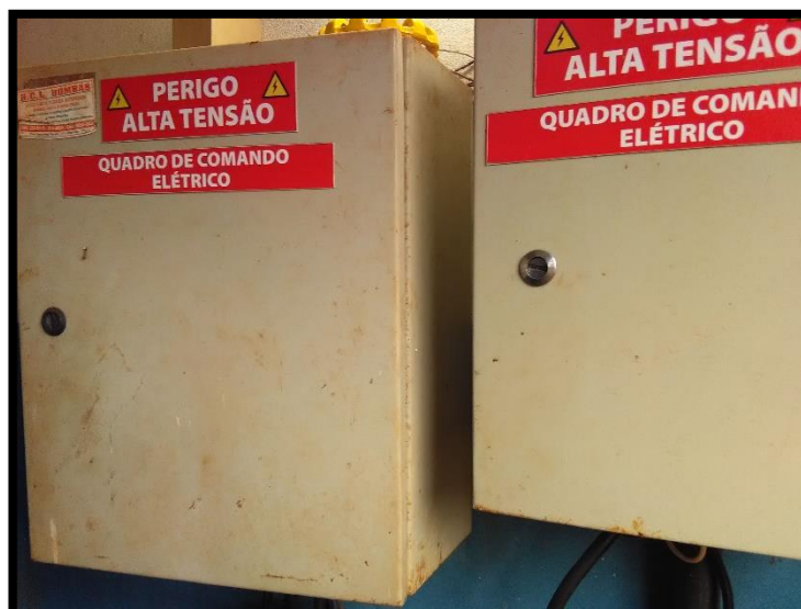
Imagem 04: Quadros de comando dos poços 1 e 2
