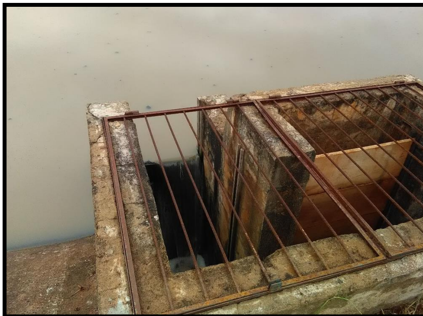
Imagem 25: Dispositivo de saída da lagoa facultativa
