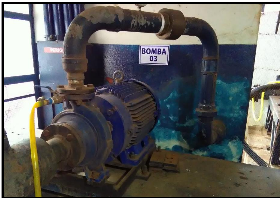
Imagem 12: Conjunto moto-bomba 03 da elevatória da captação
