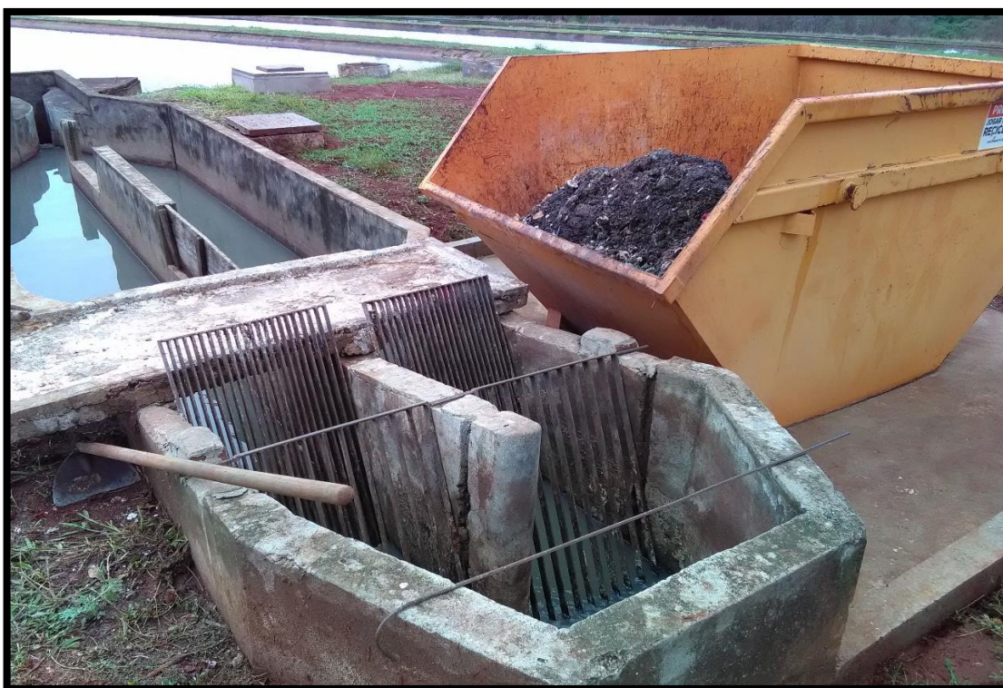
Imagem 22: Gradeamento, caixa de areia e medidor de vazão
