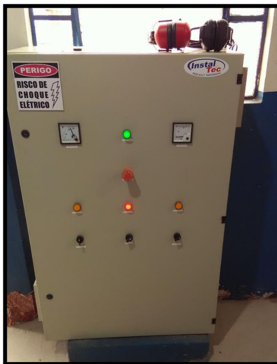
Imagem 15: Quadro de comando da elevatória de água tratada
