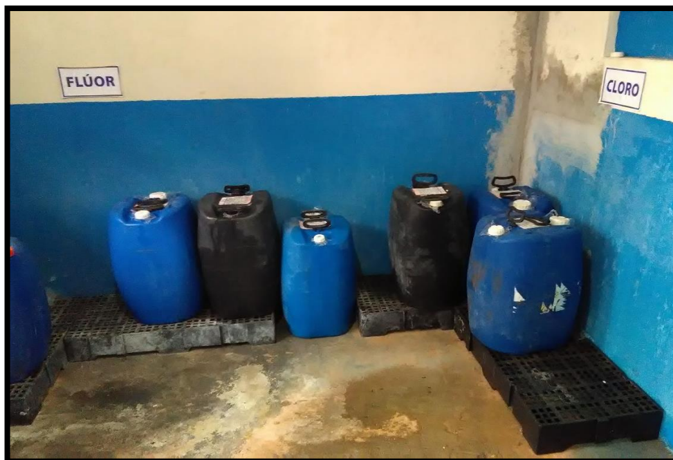
Imagem 06: Depósito de produtos químicos
