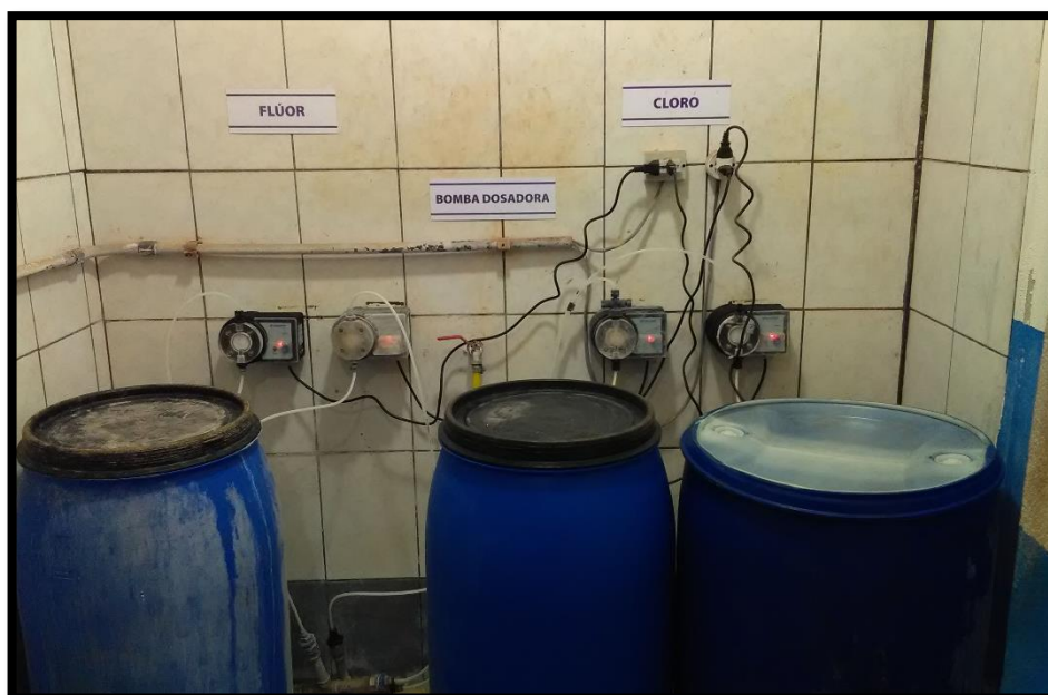
Imagem 05: Unidade de tratamento da sede
