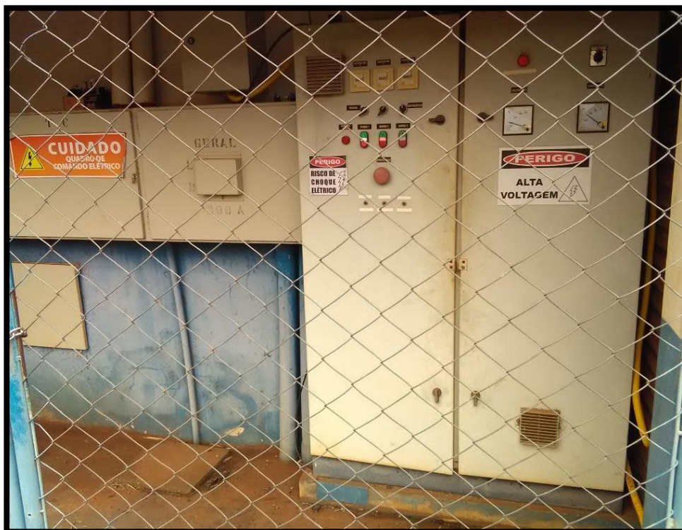
Imagem 13: Quadro de comando da elevatória da captação
