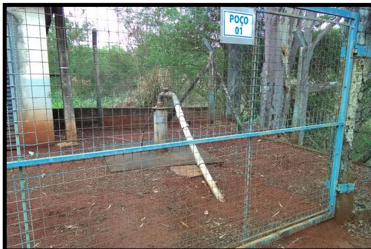
Imagem 02: Barrilete do poço 1
