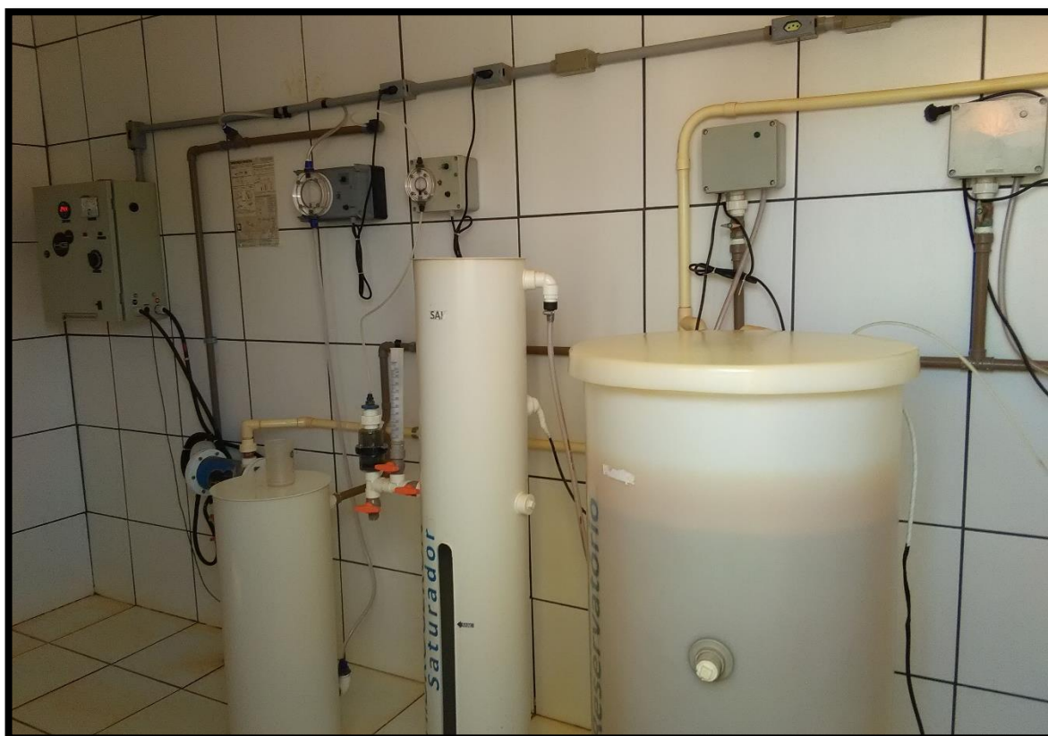
Imagem 5: Dosadora e reservatórios de cloro e fluor
