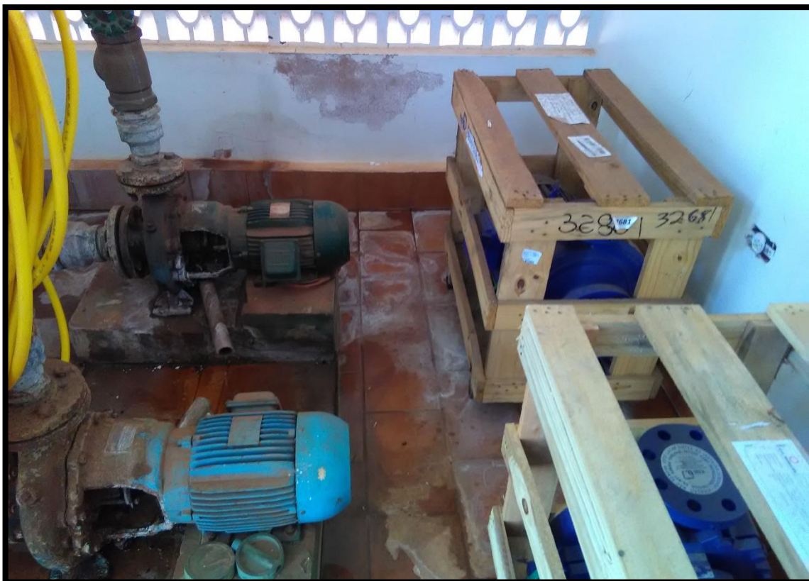
Imagem 6: conjunto moto bombas da Estação elevatória
