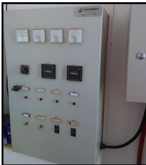
Imagem 7: quadro de comando da Estação elevatória
