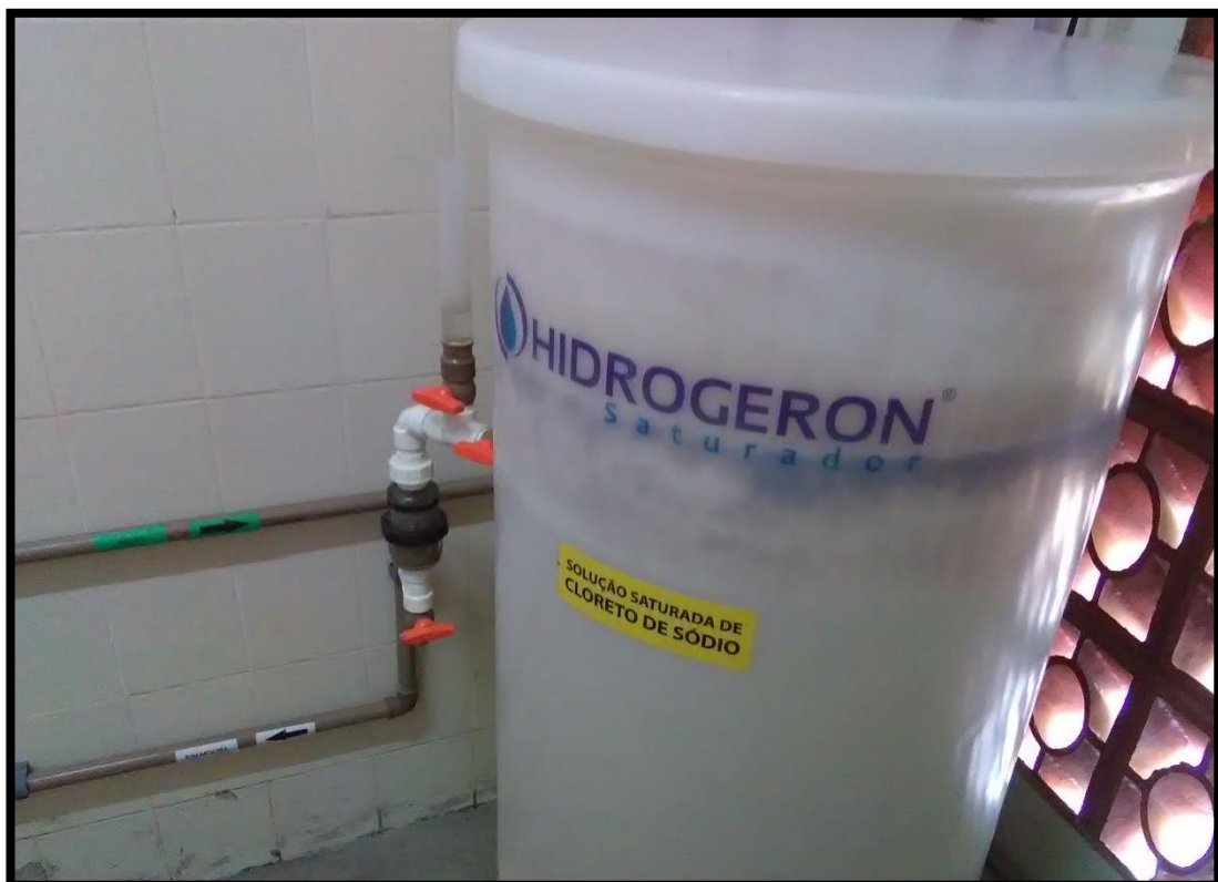
Imagem 02: Reservatório de solução de cloro
