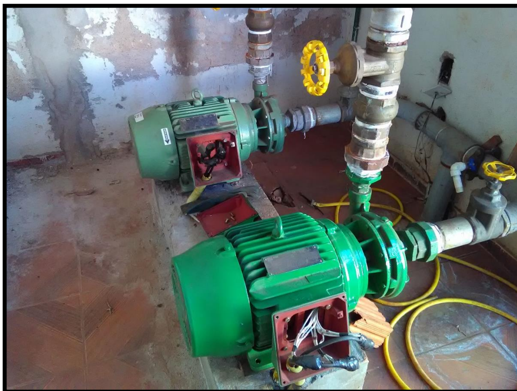
Imagem 04: Estação elevatória de água tratada 2
