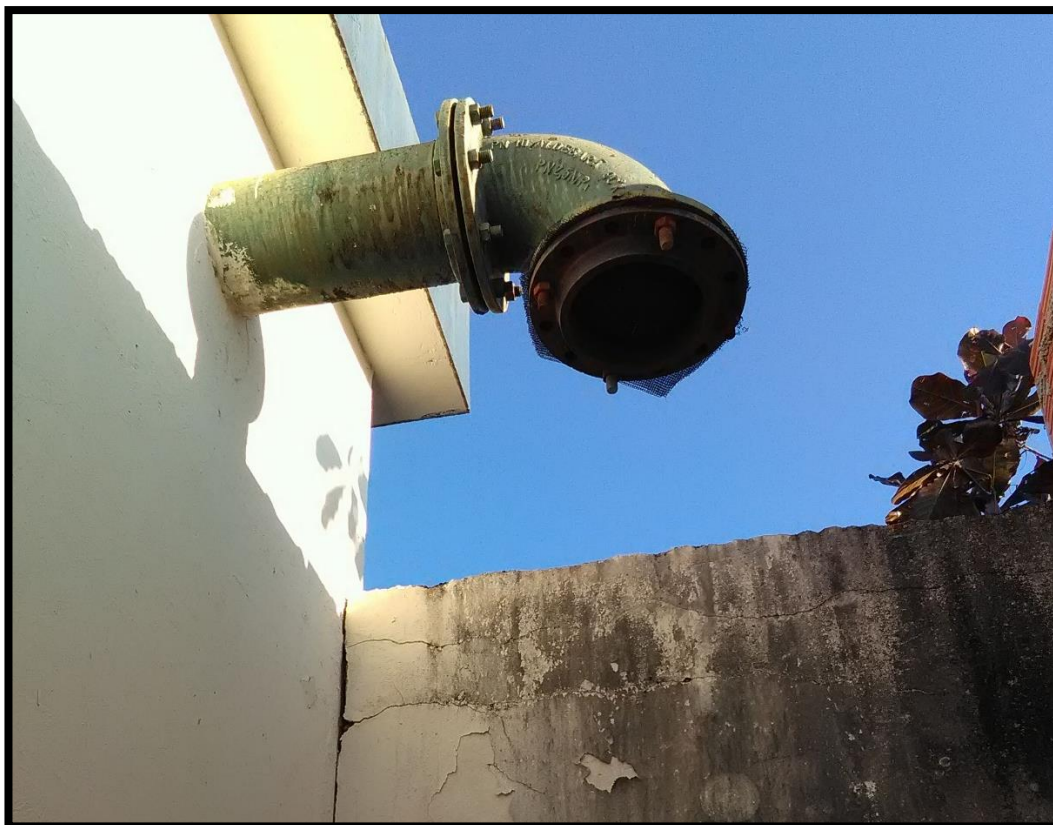
Imagem 03: Tubo extravasor do reservatório semienterrado 3
