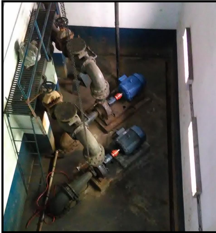
Imagem 01: Estação elevatória de água bruta
