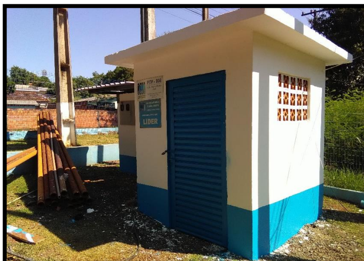
Imagem 2: Abrigo do quadro de comando do PTP 08
