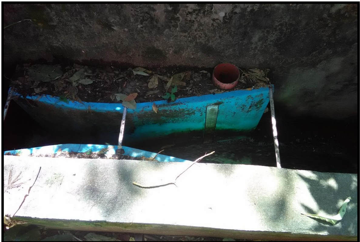
Imagem 28: Calha Parshall de saída
