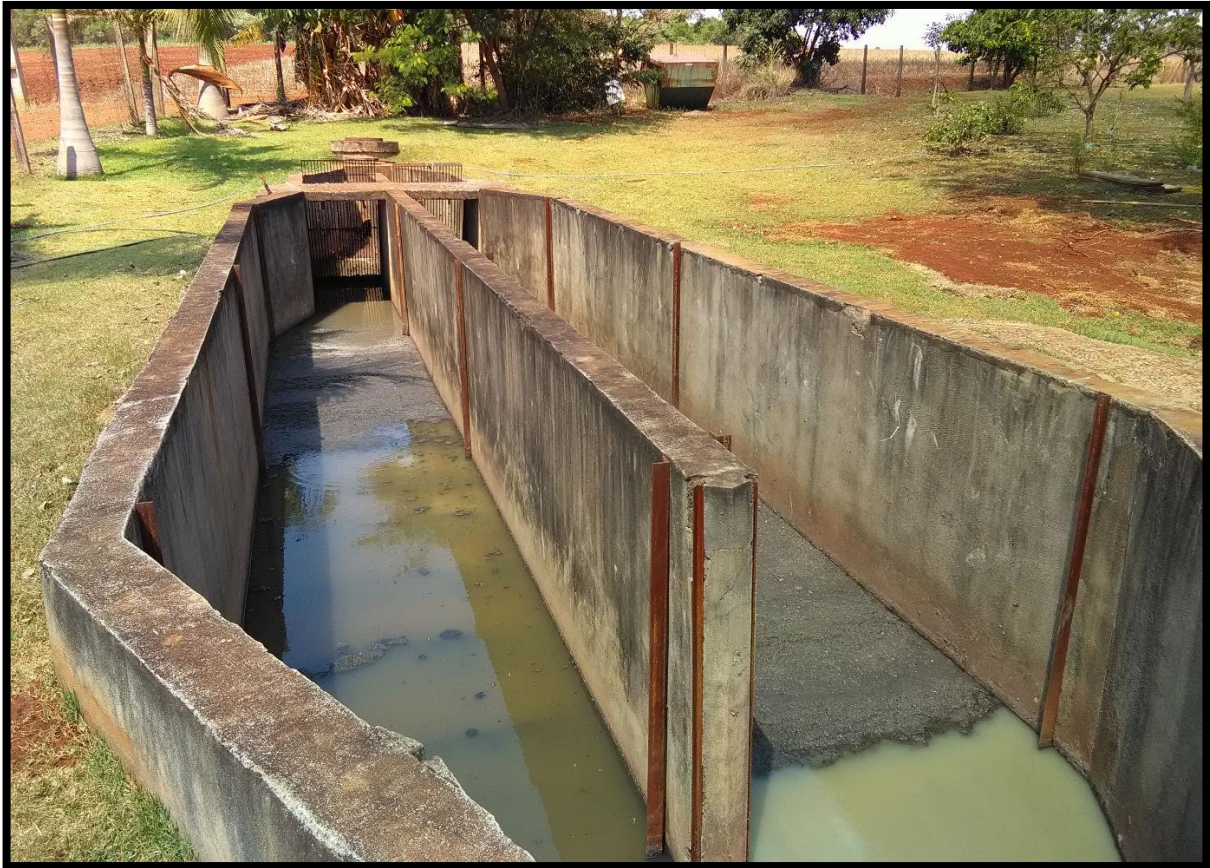
Imagem 23: Gradeamento e Caixa de areia
