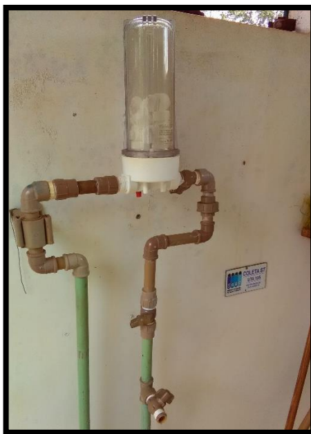
Imagem 29: UTA 105 (Distrito Novo Horizonte)
