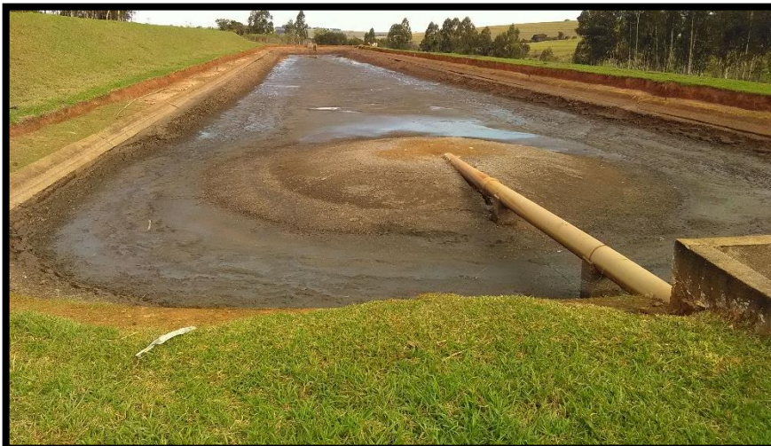
Imagem 23: Lagoa anaeróbia 2 drenada para remoção de lodo
