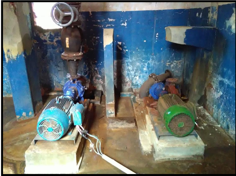
Imagem 11: Conjunto moto-bombas da elevatória da mina
