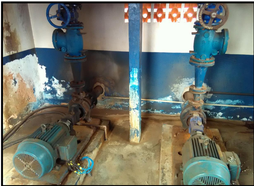
Imagem 13: Conjunto moto-bombas da elevatória do reservatório enterrado
