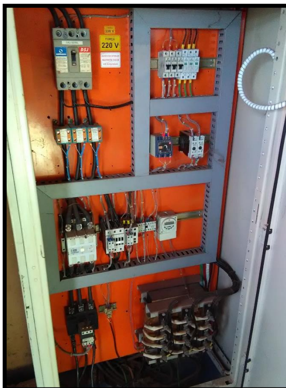
Imagem 16: Quadro de comando da estação do reservatório enterrado
