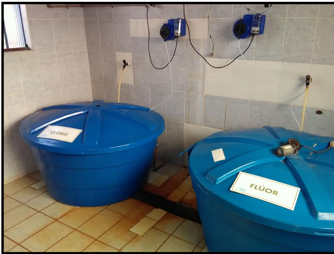
Imagem 06: Bombas dosadoras e reservatório de solução
