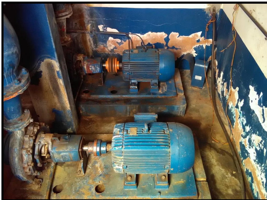
Imagem 15: Conjunto moto-bombas da elevatória do reservatório semienterrado
