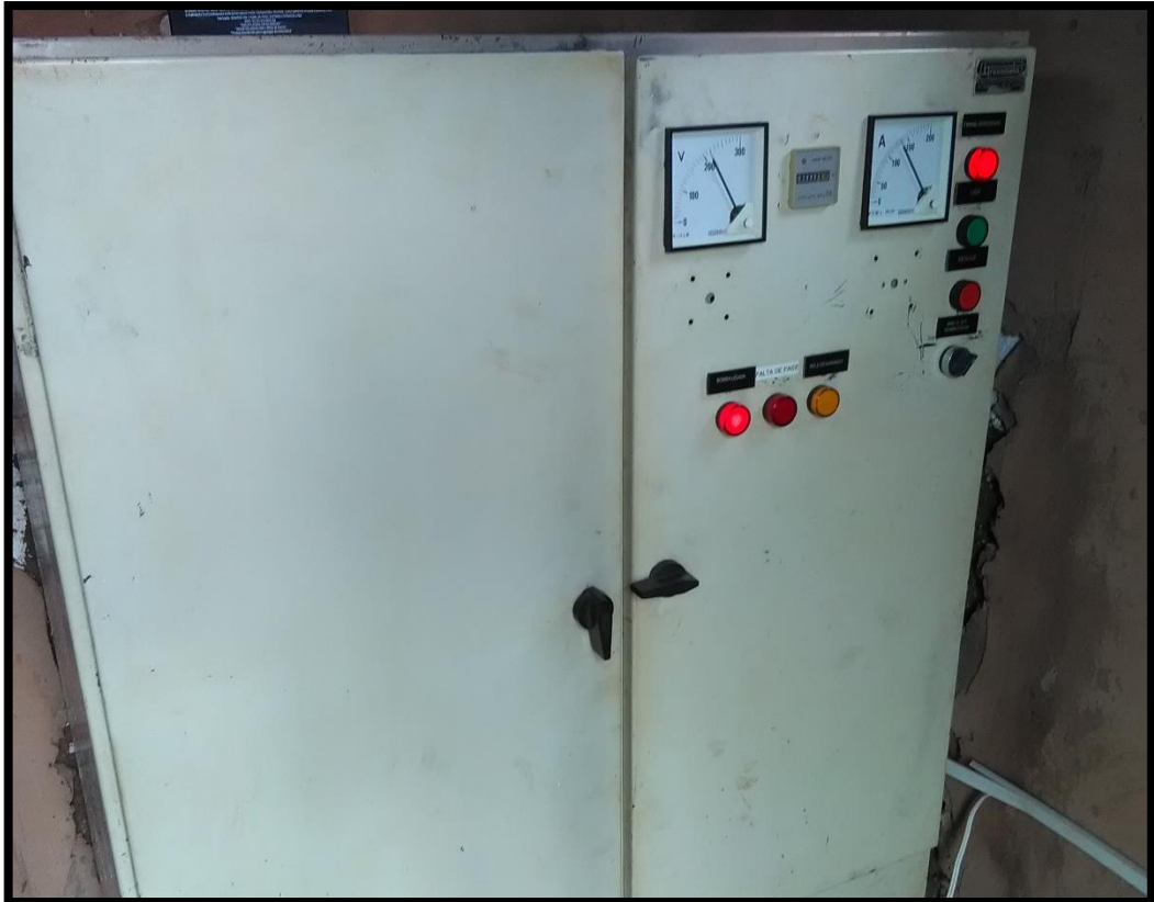
Imagem 02: Quadro de comando do poço 1
