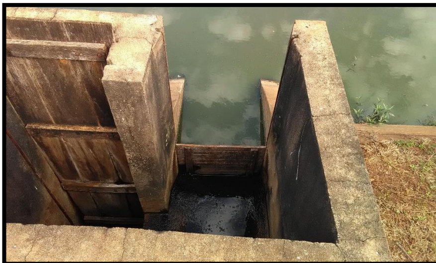
Imagem 25: Dispositivo de saída da lagoa facultativa
