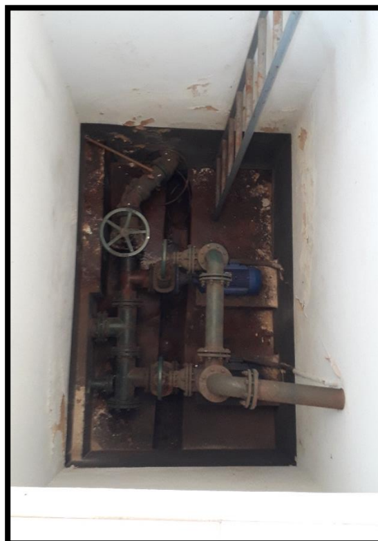
Imagem 9: conjunto moto bombas da Estação elevatória de água tratada
