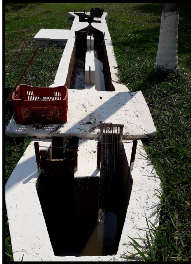
Imagem 20: Gradeamento, Caixa de areia e Medidor de vazão
