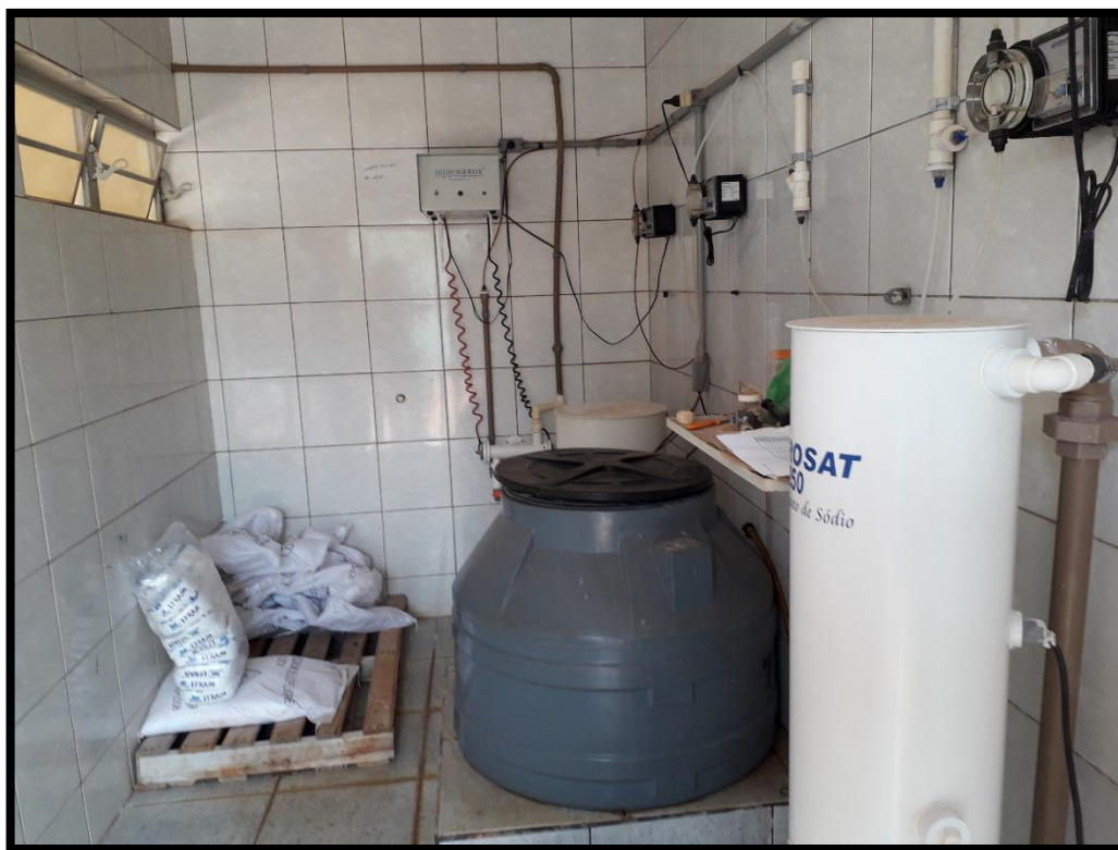
Imagem 6: Unidade de tratamento de Água
