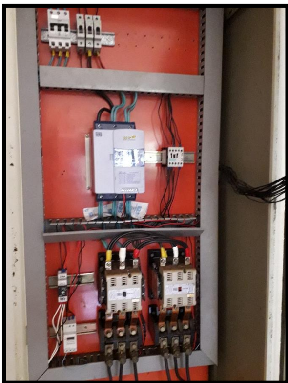
Imagem 8: quadro de comando da Estação elevatória da mina Messias
