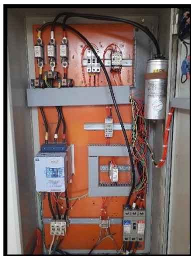
Imagem 2: Quadro de comando do Poço 1
