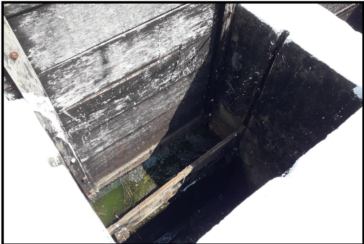
Imagem 23: Dispositivo de saída da Lagoa Facultativa
