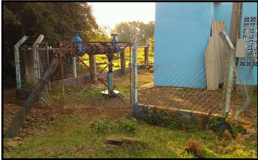
Imagem 01: Barrilete do poço
