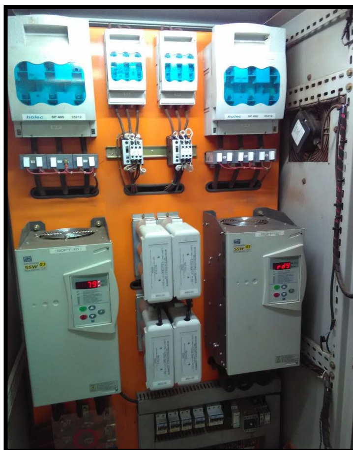
Imagem 13: Quadro de comando da mina
