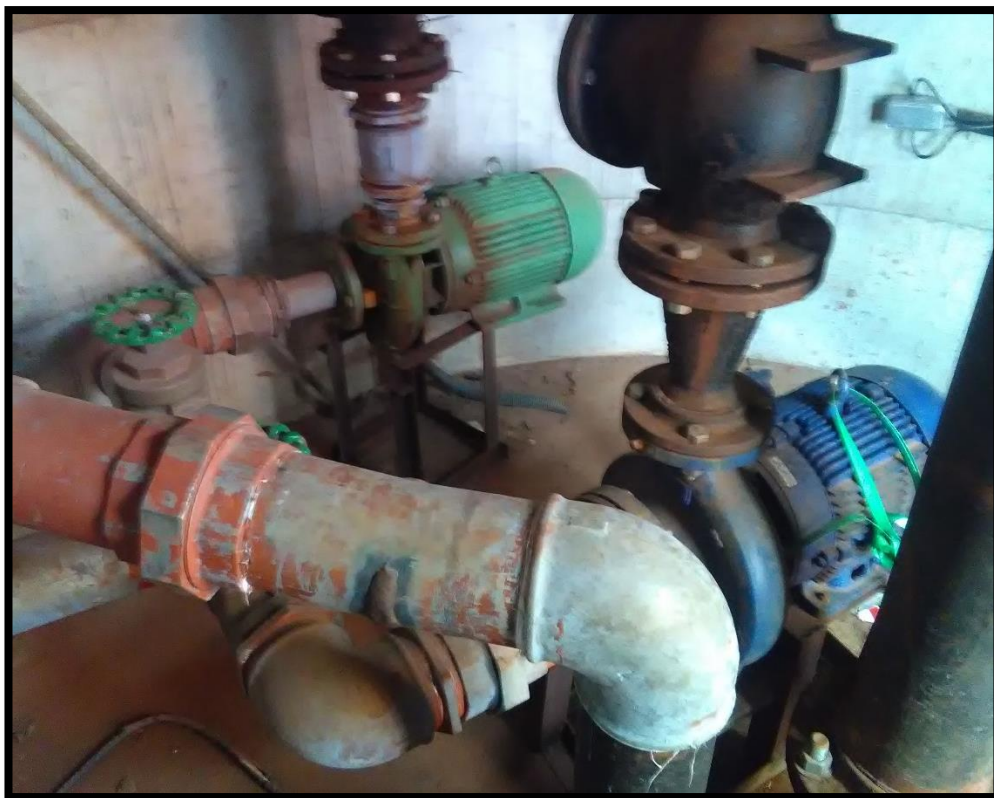
Imagem 14: Conjunto moto-bombas da elevatória do reservatório elevado
