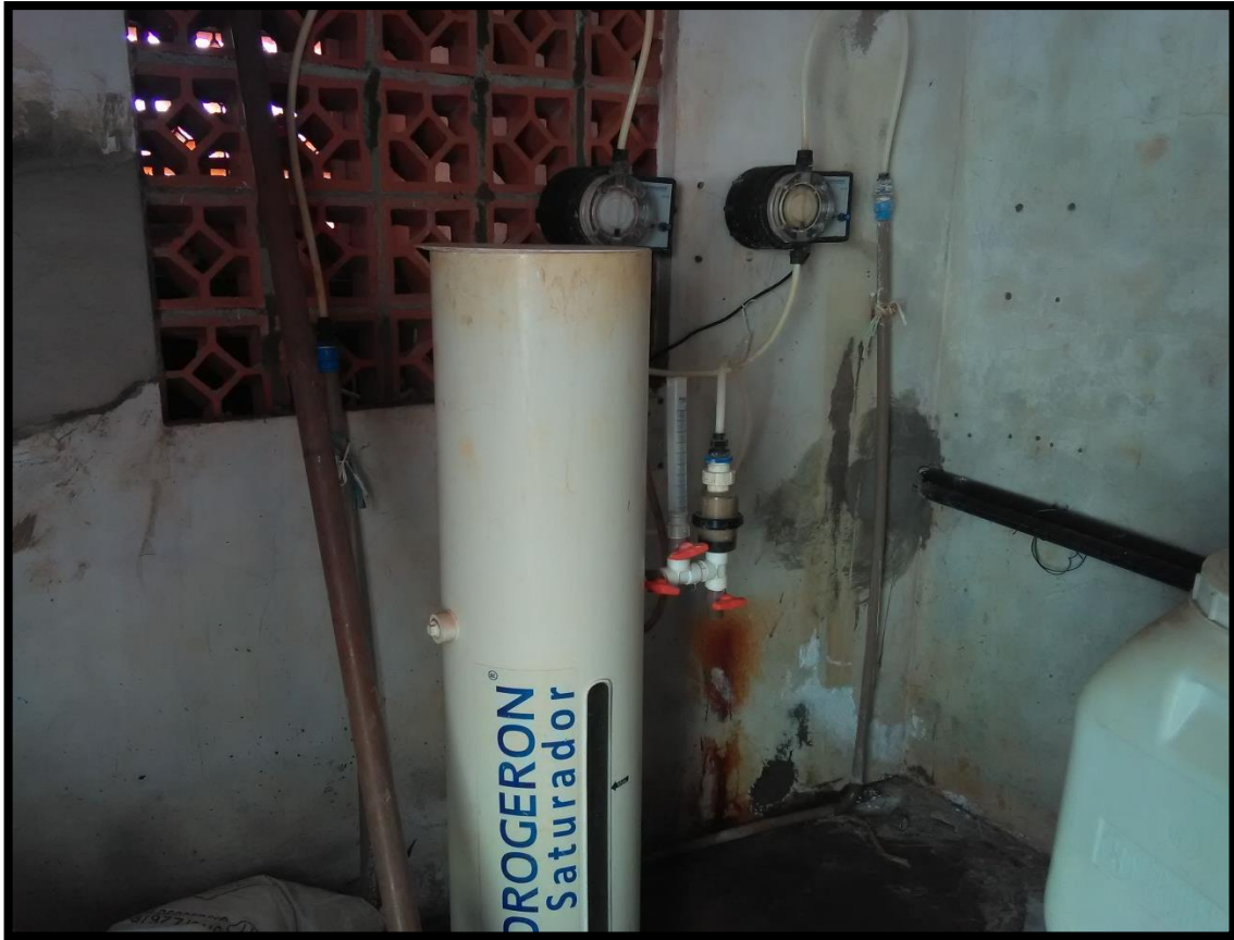
Imagem 05: Bombas dosadoras e reservatório saturador
