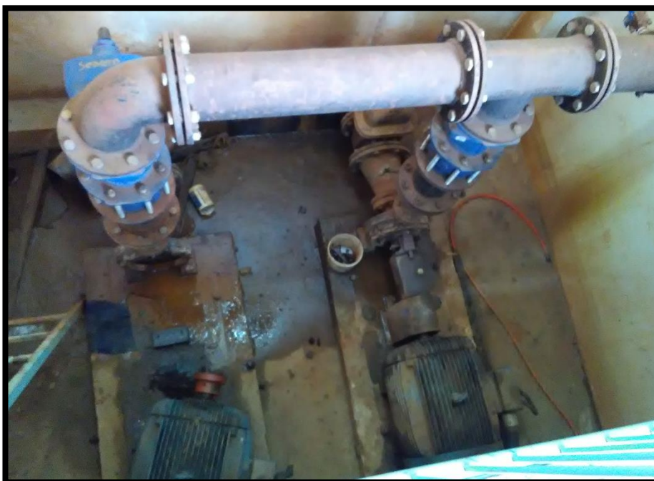
Imagem 12: Conjunto moto-bombas da elevatória
