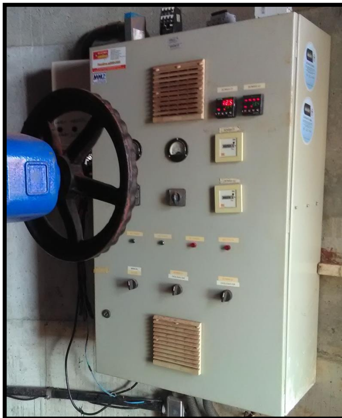
Imagem 15: Quadro de comando da estação do reservatório elevado
