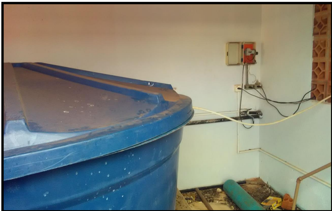
Imagem 06: Reservatório de solução de cloro
