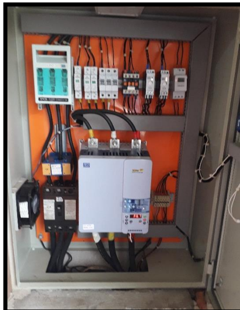
Imagem 3: Quadros de comando do Poço 2
