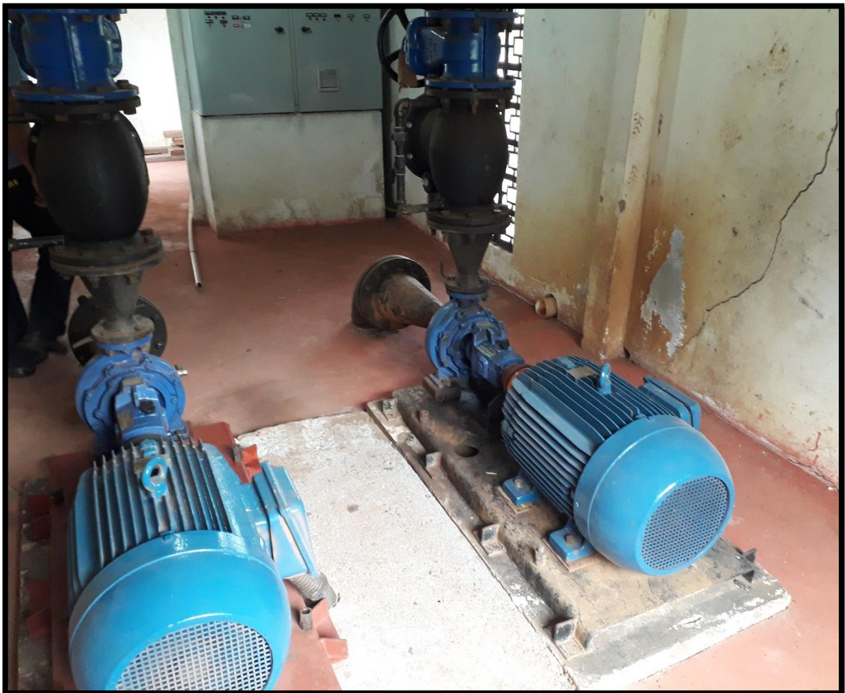
Imagem 12: conjunto moto bombas da Estação elevatória da mina e poço 2
