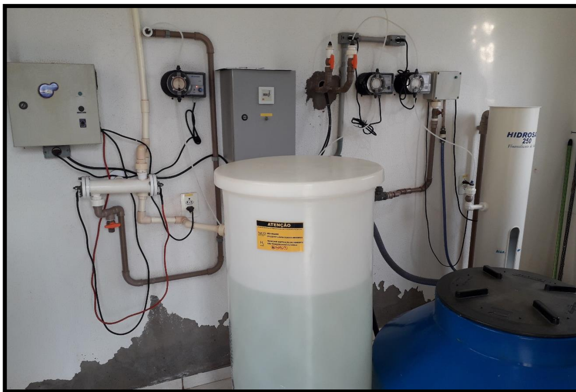
Imagem 11: Dosadora e quadro
