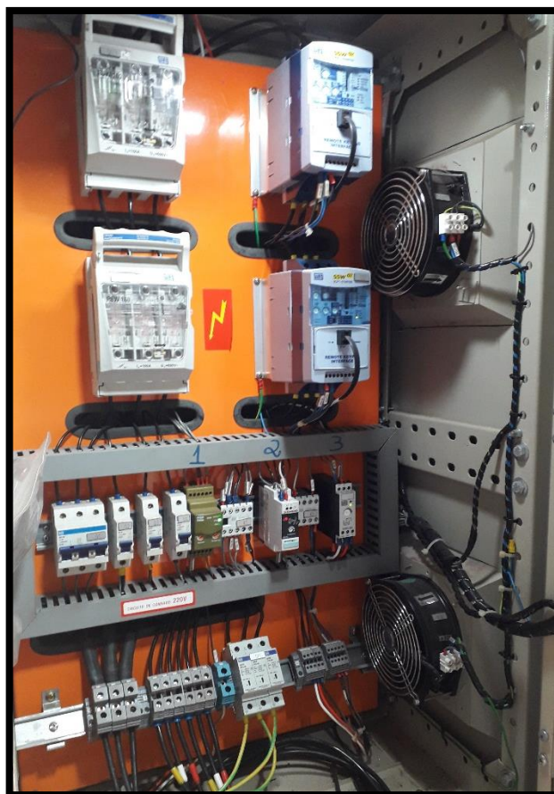
Imagem 15: quadro de comando da Estação elevatória da mina Japurá
