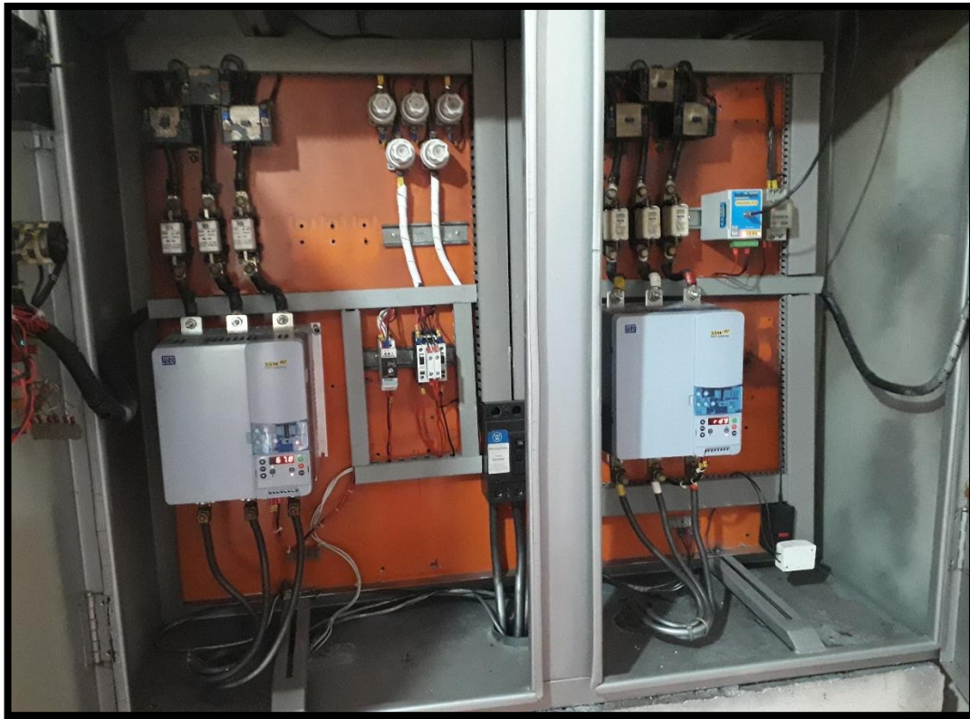
Imagem 13: quadro de comando da Estação elevatória da mina e poço 2
