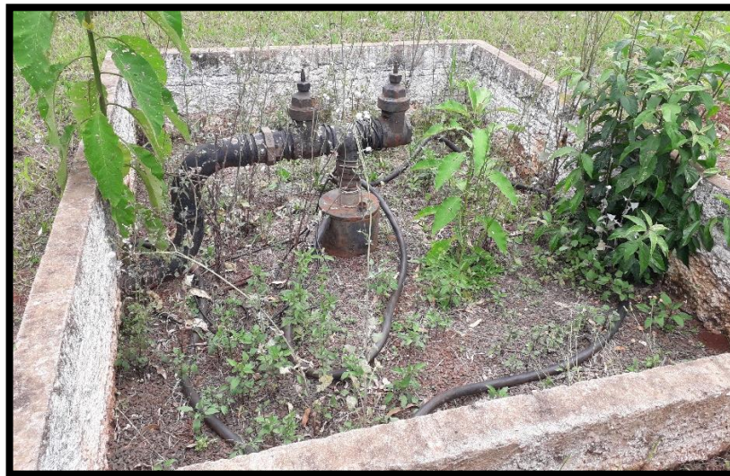
Imagem 2: Barrilete do poço 2
