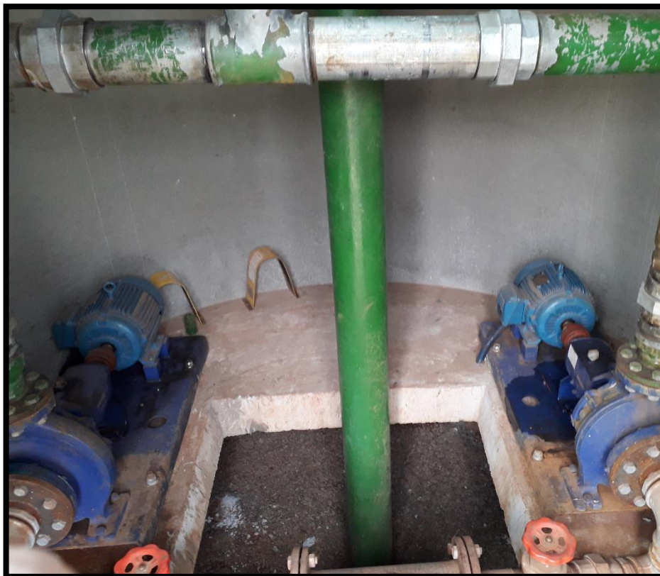
Imagem 14: conjunto moto bombas da Estação elevatória do reservatório elevado
