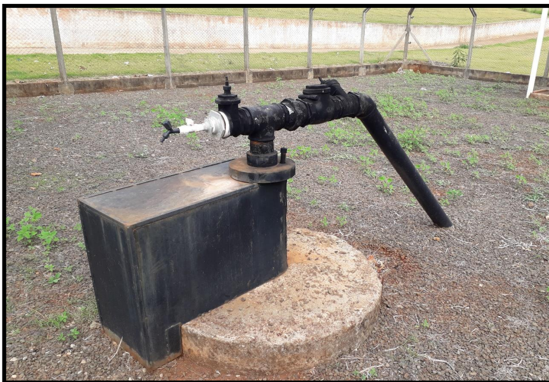
Imagem 4: Barrilete do poço 3
