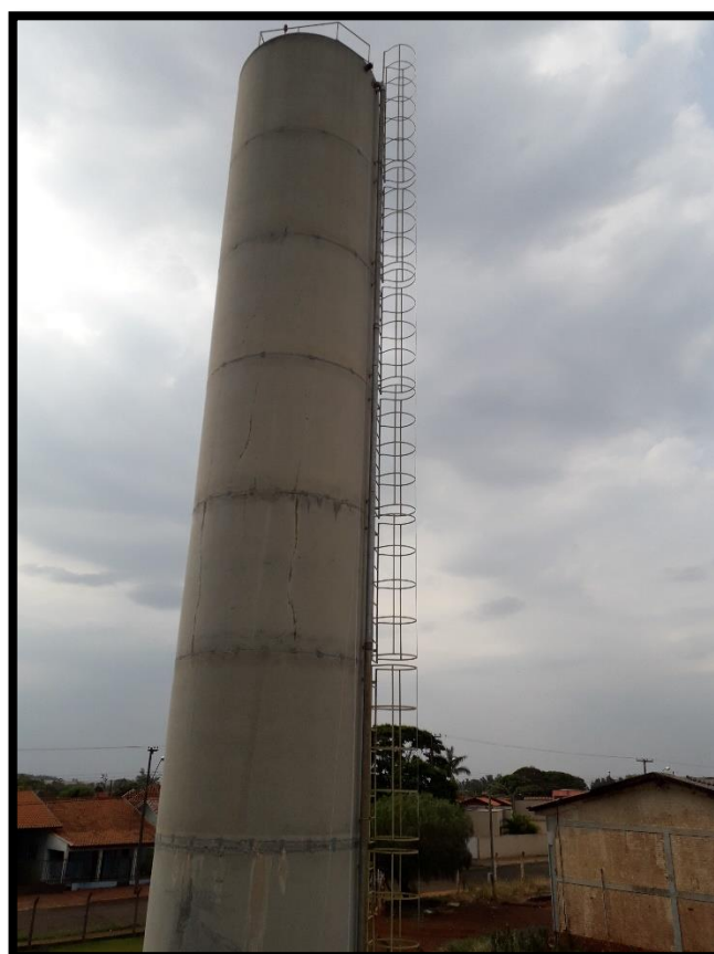
Imagem 9: Reservatório elevado de 100 m 3
