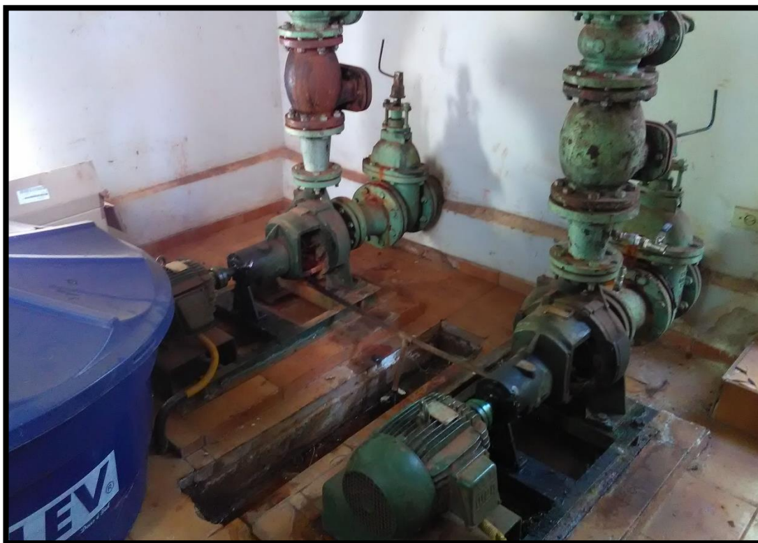
Imagem 11: Conjunto moto-bombas elevatória 01
