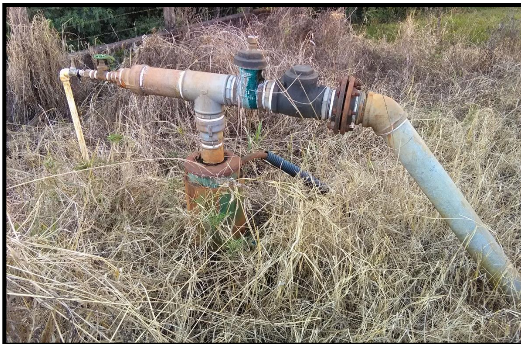
Imagem 01: Barrilete do poço
