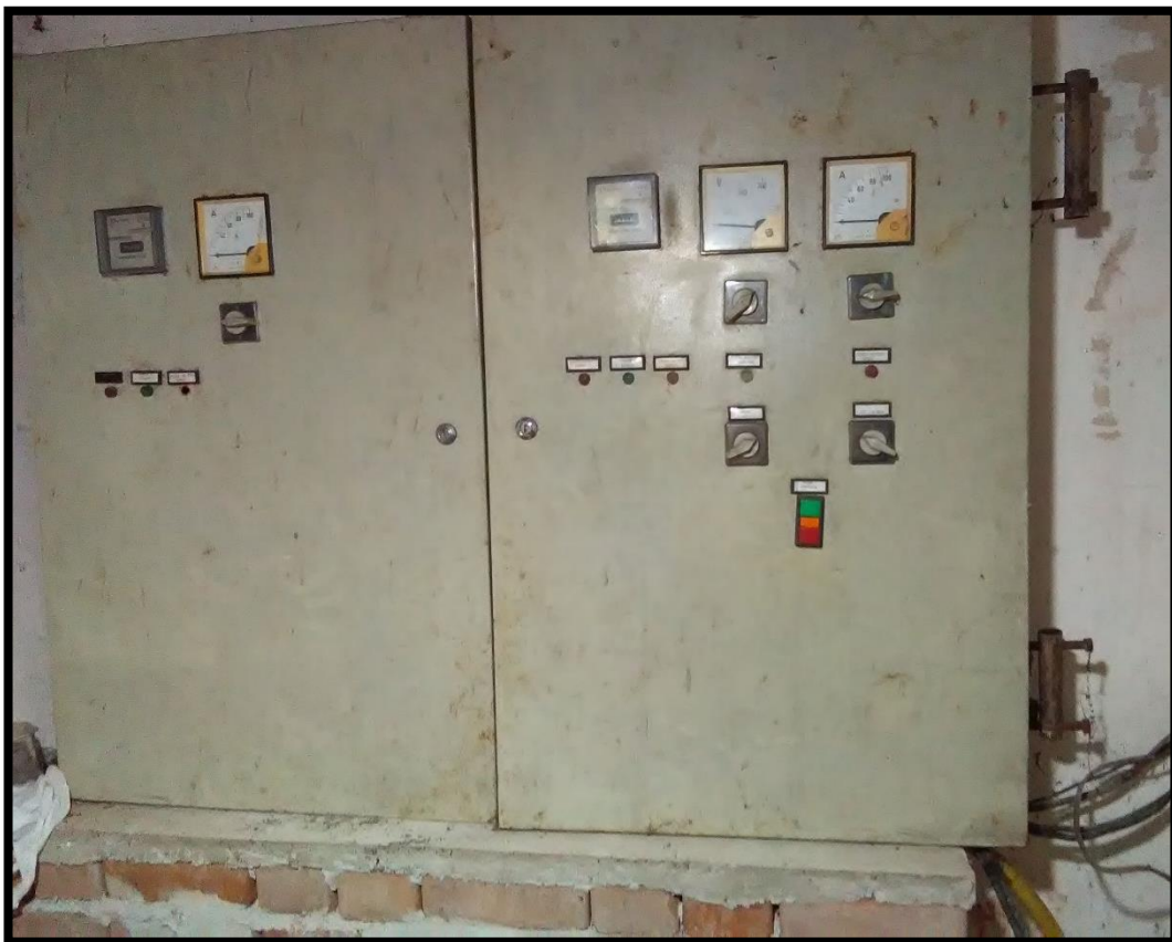
Imagem 14: Quadro de comando do distrito Terra Nova
