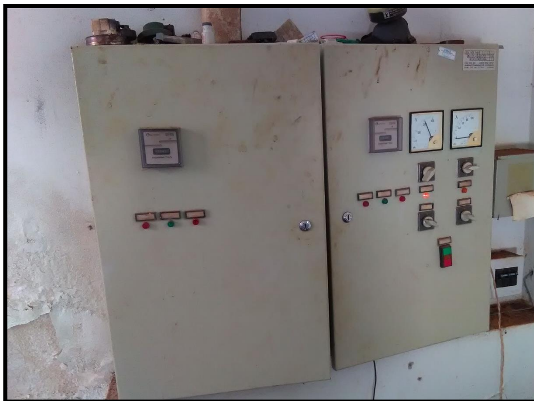
Imagem 12: Quadro de comando da sede
