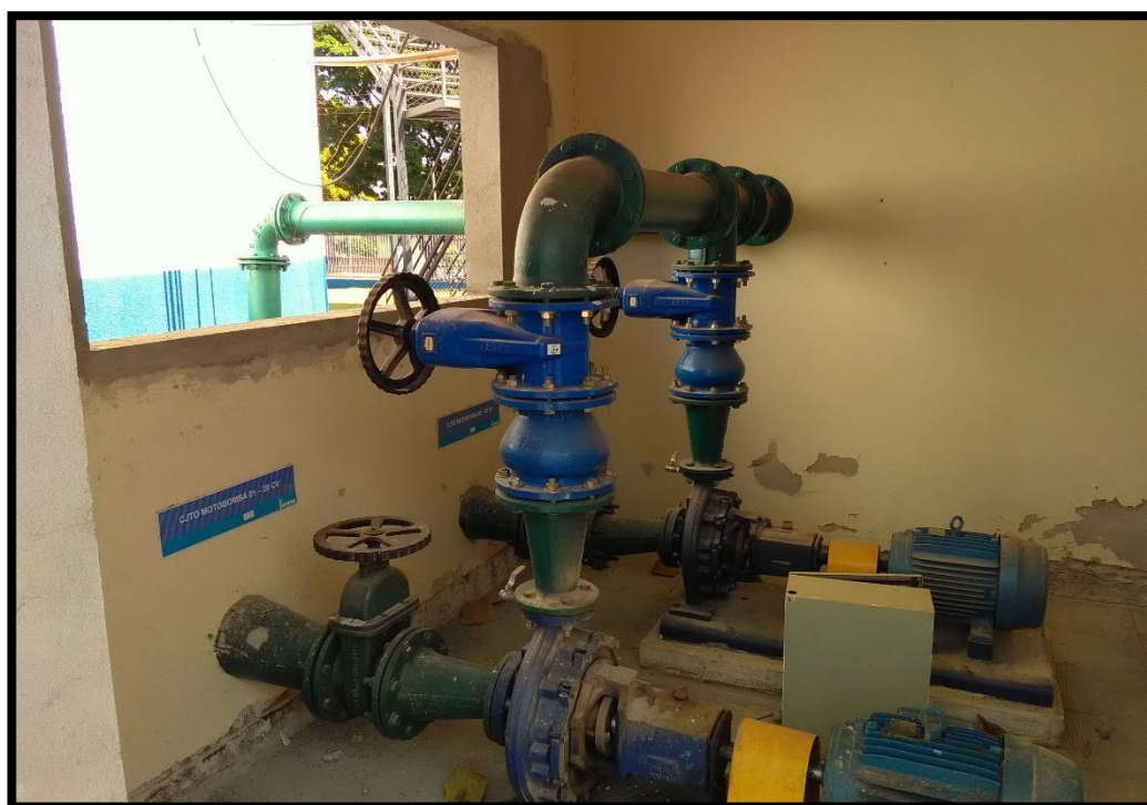
Imagem 14: conjunto moto bombas da Estação elevatória de água bruta
