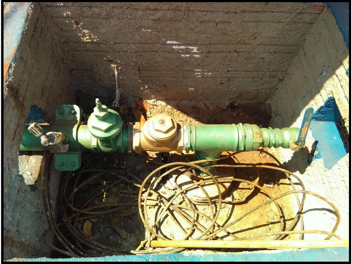
Imagem 5: Barrilete do poço 3
