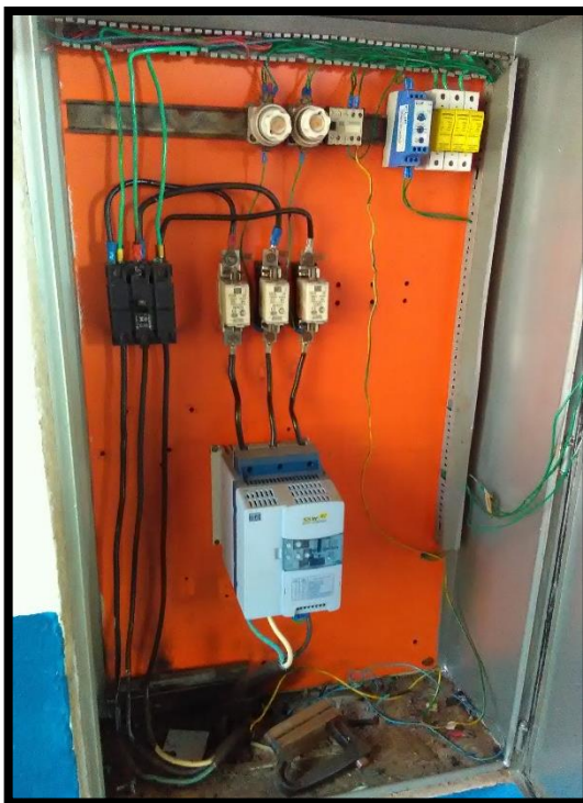
Imagem 9: Quadro de comando do poço 1
