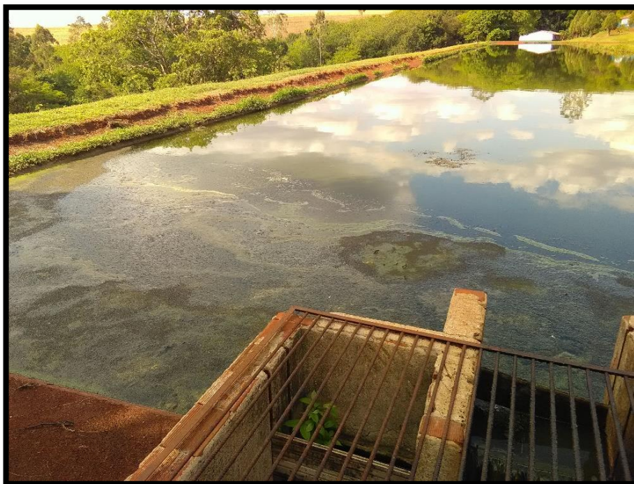
Imagem 24: Dispositivo de saída da Lagoa Facultativa
