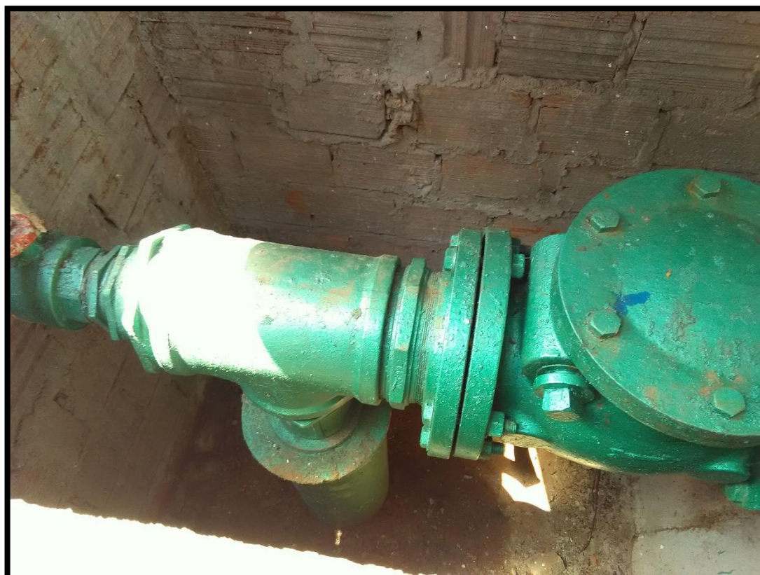
Imagem 2: Barrilete do poço 5
