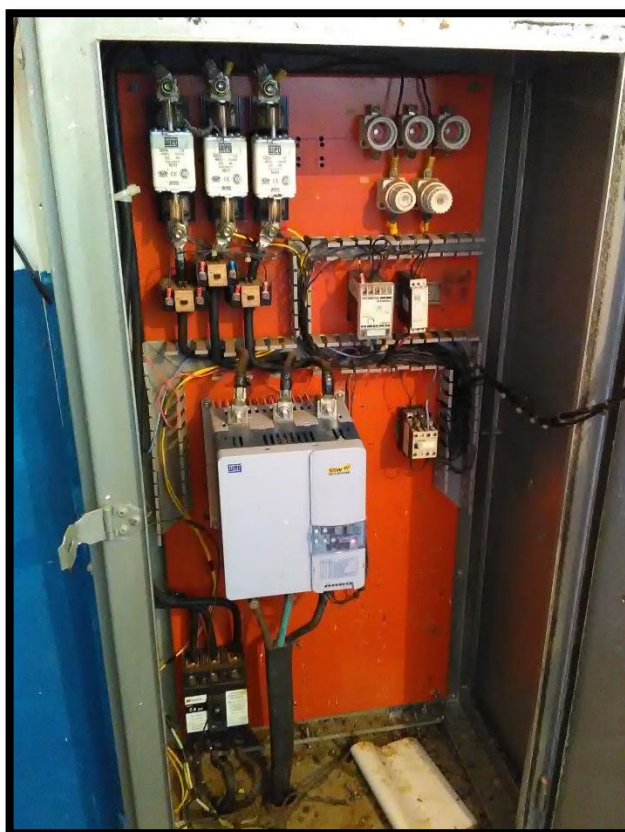
Imagem 3: Quadro de comando do poço 5
