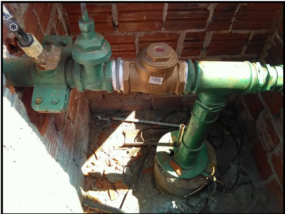
Imagem 8: Barrilete do poço 1
