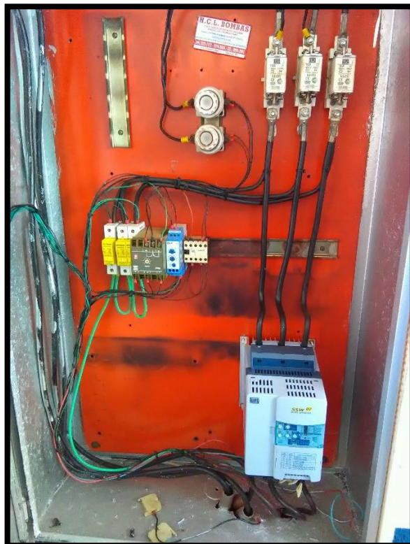
Imagem 6: Quadro de comando do poço 3
