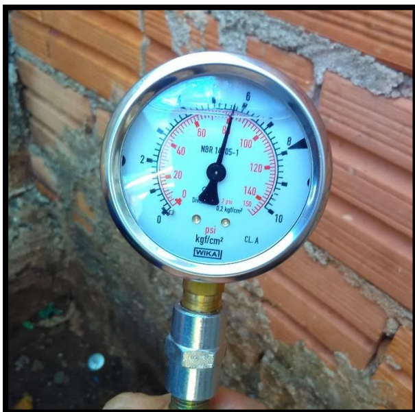
Imagem 13: Medição de pressão na Rua Mato Grosso
