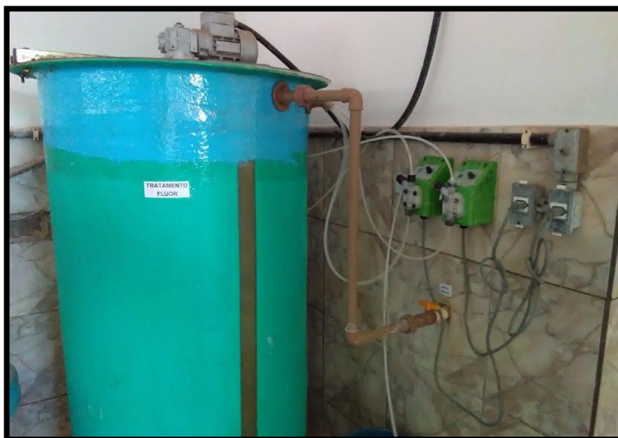
Imagem 9: Dosadora e tratamento de flúor
