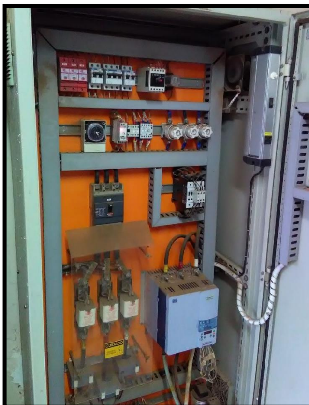
Imagem 2: Quadro de comando do Poço Barro Preto
