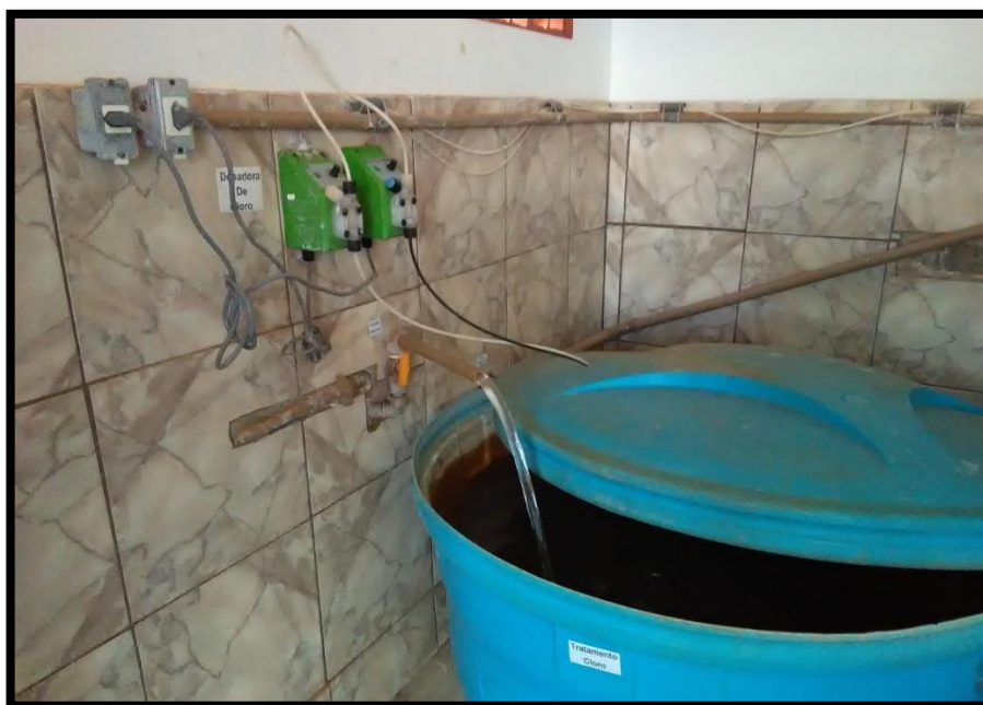
Imagem 8: Dosadora e tratamento de cloro
