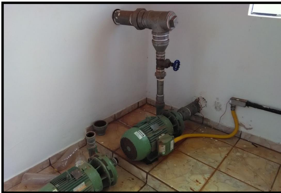
Imagem 11: Conjunto moto bombas
