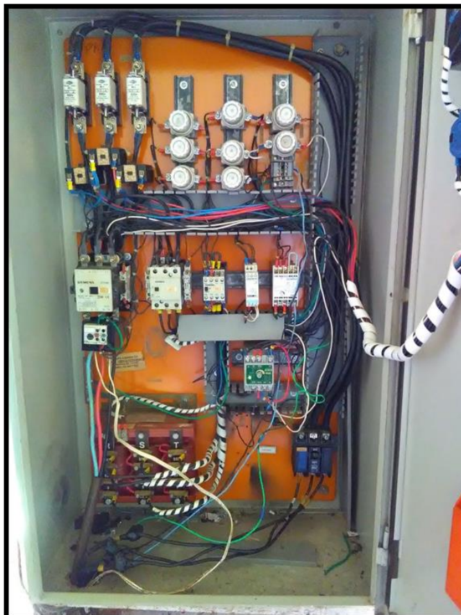
Imagem 7: Quadro de comando do poço do Sistema Horizonte
