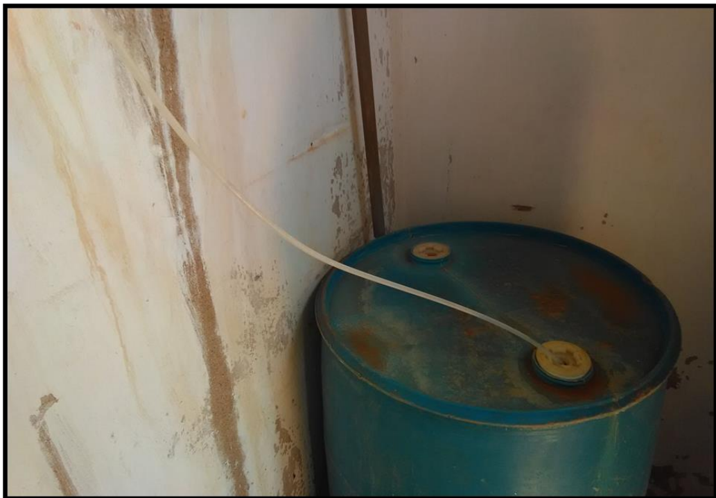
Imagem 16: reservatório de diluição de cloro da unidade de tratamento do Sistema Avanci
