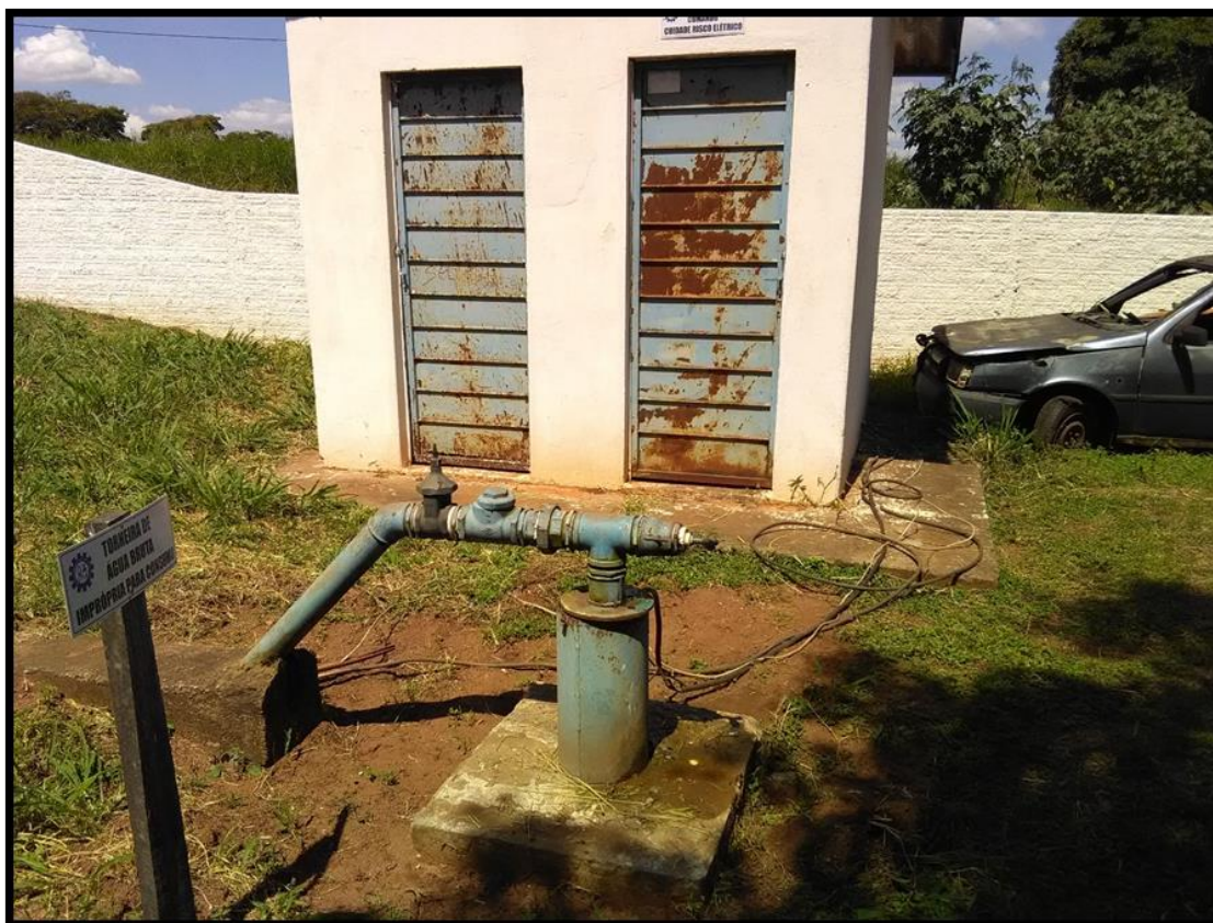
Imagem 9: Barrilete do Poço Milton
