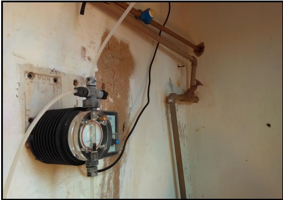
Imagem 15: Dosadora de cloro da unidade de tratamento do Sistema Avanci
