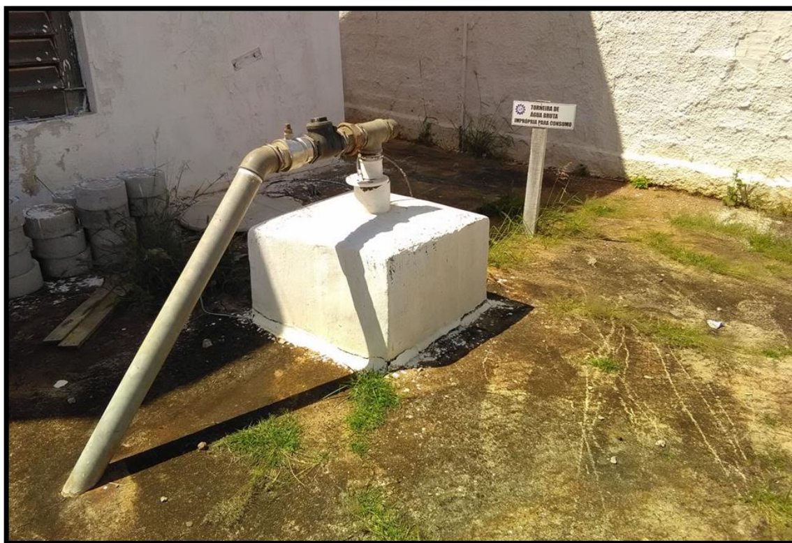
Imagem 11: Barrilete do Poço Caixa Velha
