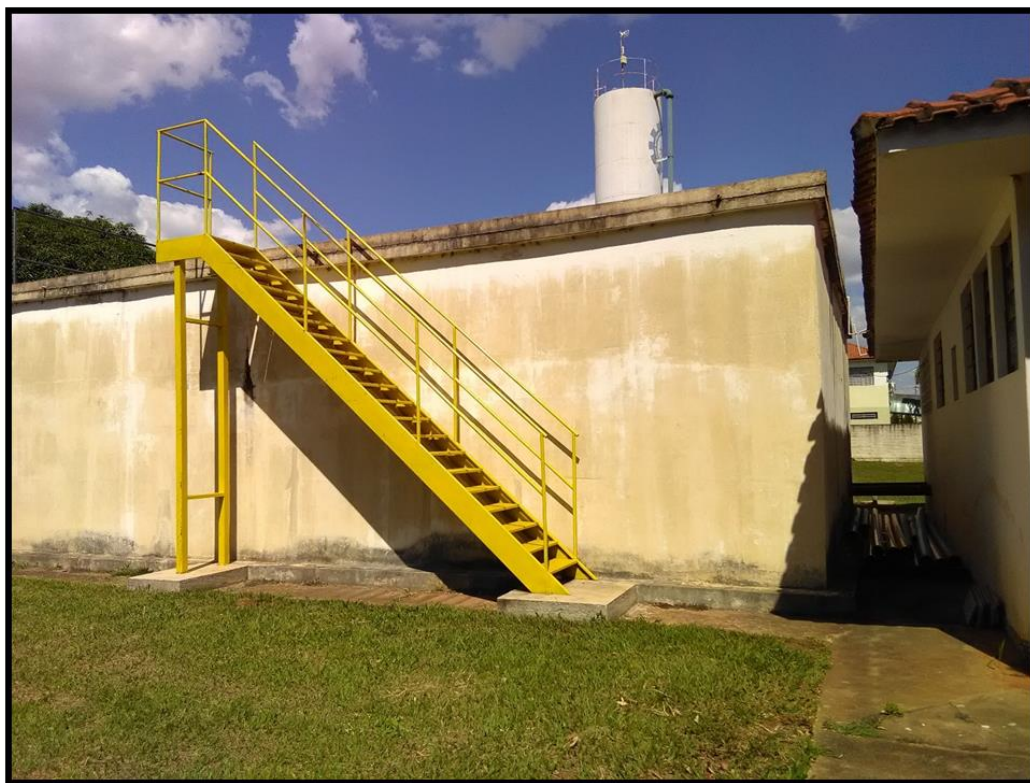
Imagem 20: Reservatório apoiado do Sistema Sede
