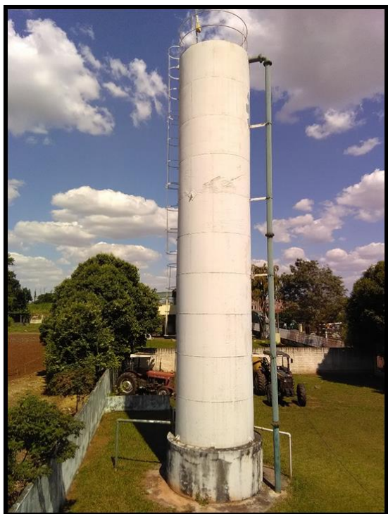
Imagem 22: Reservatório elevado do Sistema Sede
