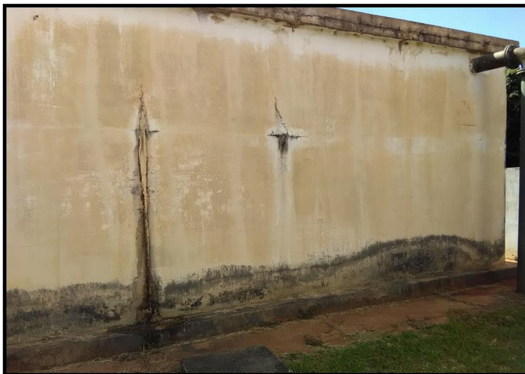
Imagem 21: Reservatório apoiado do Sistema Sede
