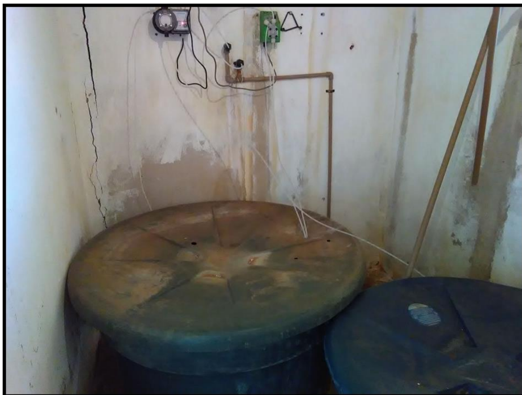
Imagem 17: Unidade de tratamento do sistema Horizonte
