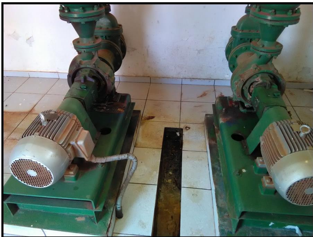
Imagem 26: Conjuntos moto bombas da Estação Elevatória de Água
