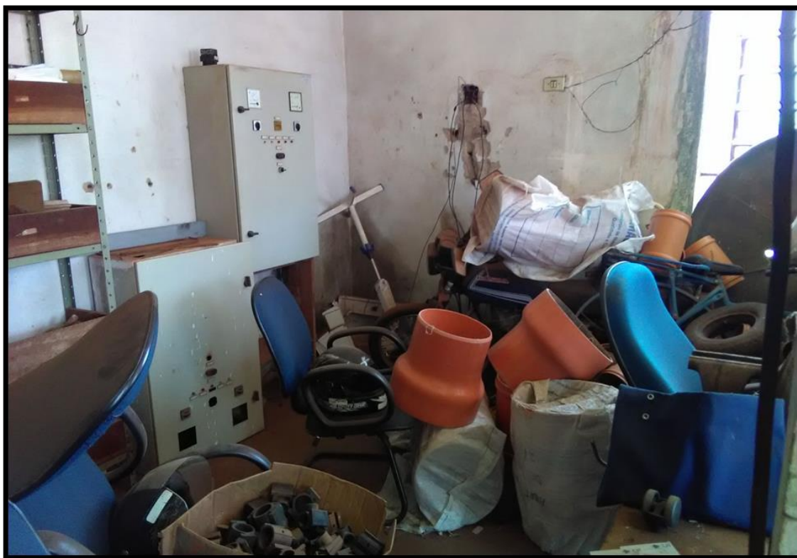
Imagem 12: Quadro de comando do Poço Caixa Velha
