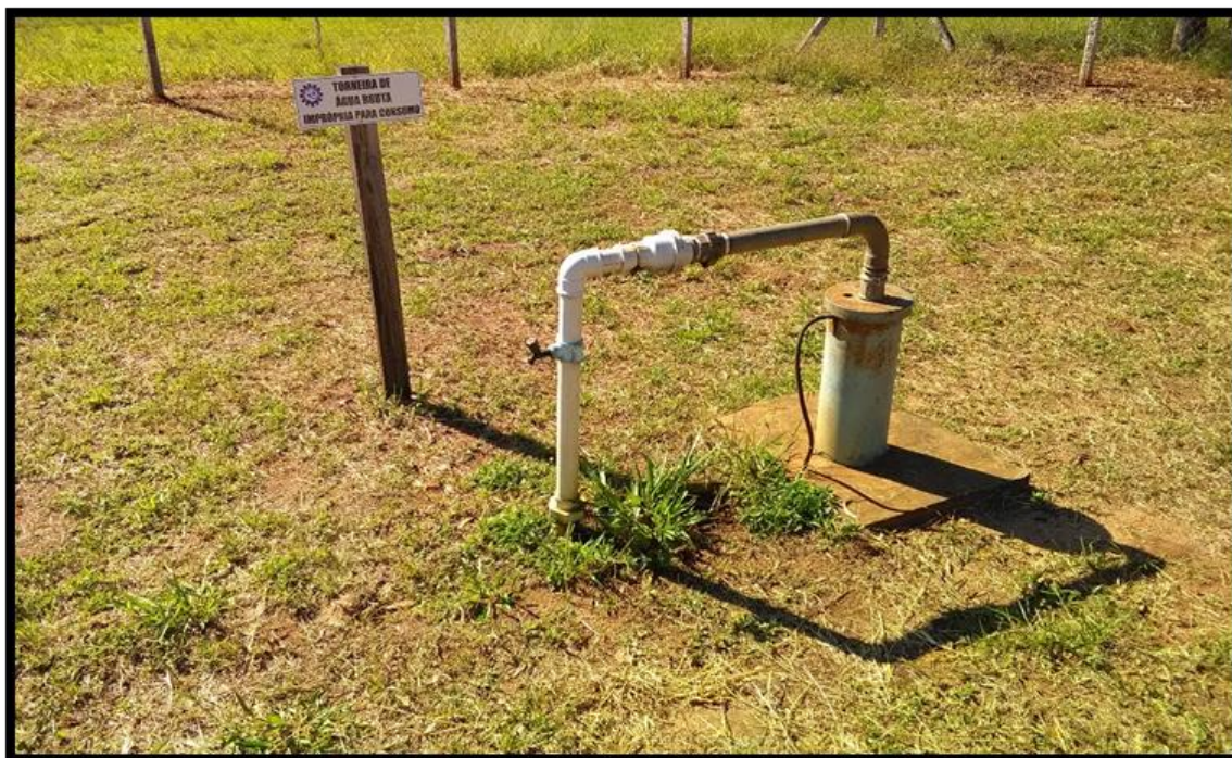
Imagem 4: Poço do Sistema Avanci
