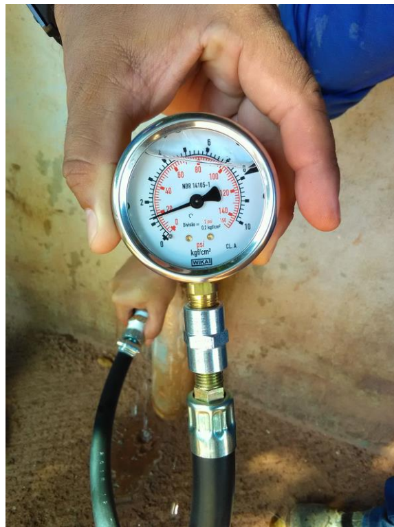
Imagem 32: Medição de pressão no SAMAE
