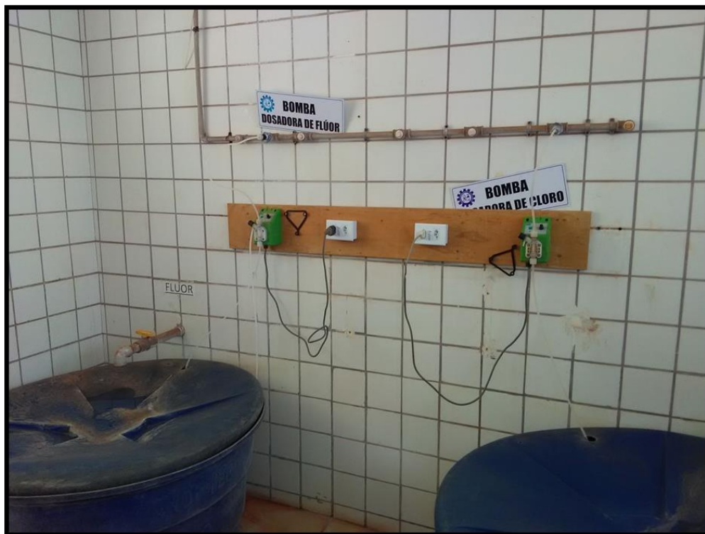
Imagem 19: Unidade de tratamento do sistema Sede
