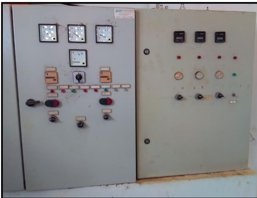
Imagem 27: Quadro de comando da Estação Elevatória de Água
