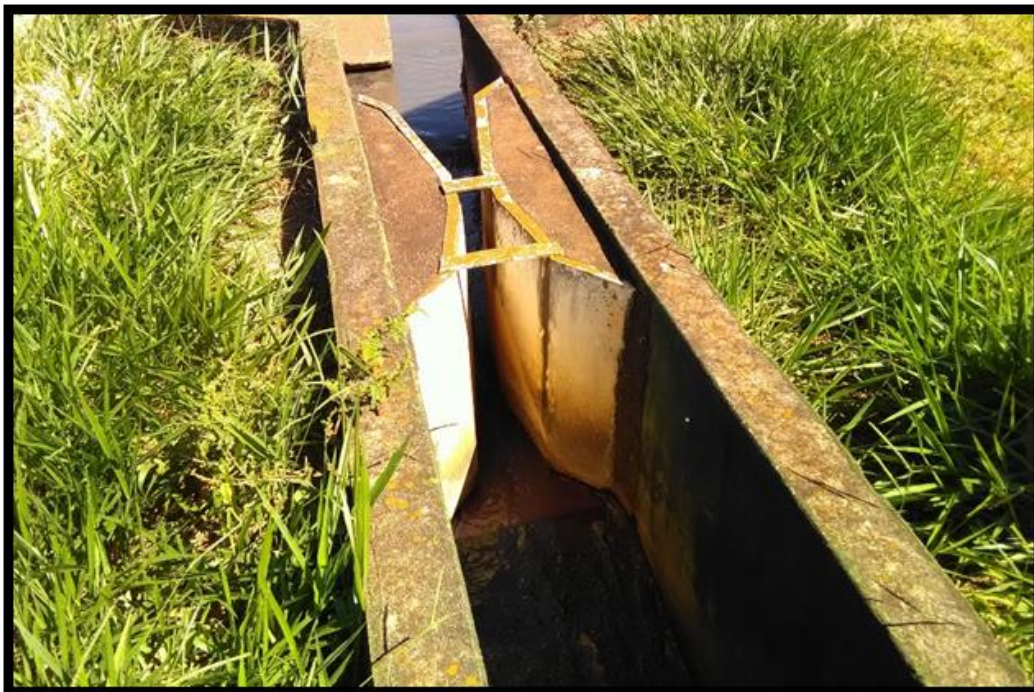
Imagem 37: Medidor de Vazão
