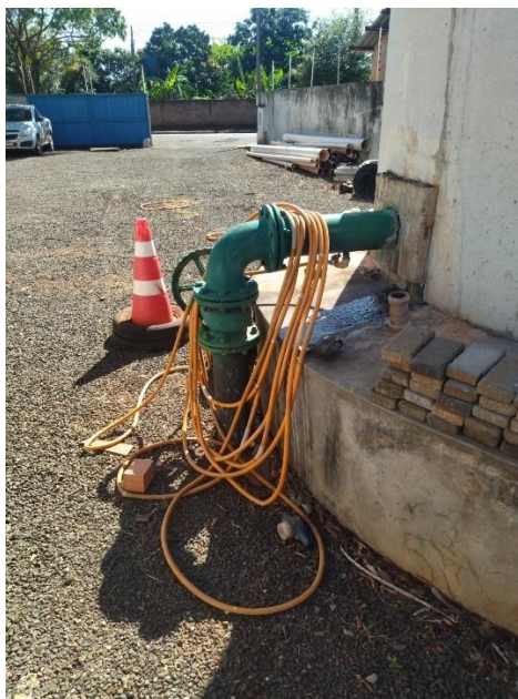
Foto 73: Tubulação de saída de água para a rede de distribuição.
