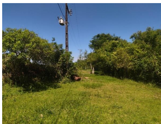
Foto 53: Falta de isolamento adequado.
