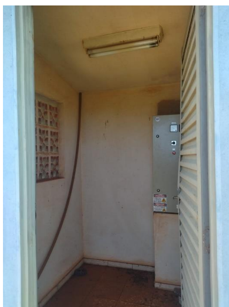
Foto 39: Falta de iluminação.
