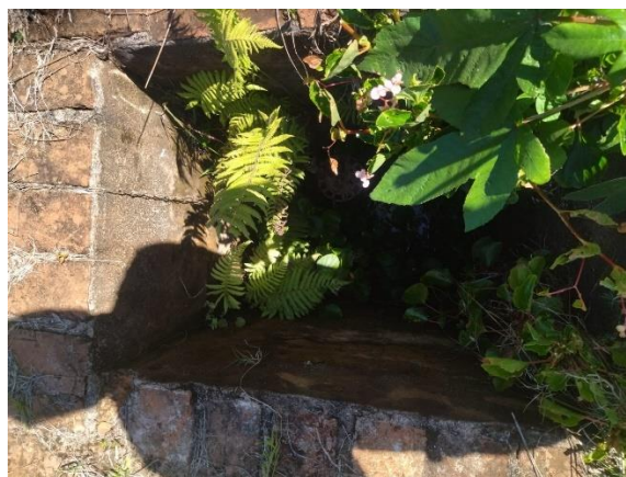
Foto 62: Caixa de registro.
