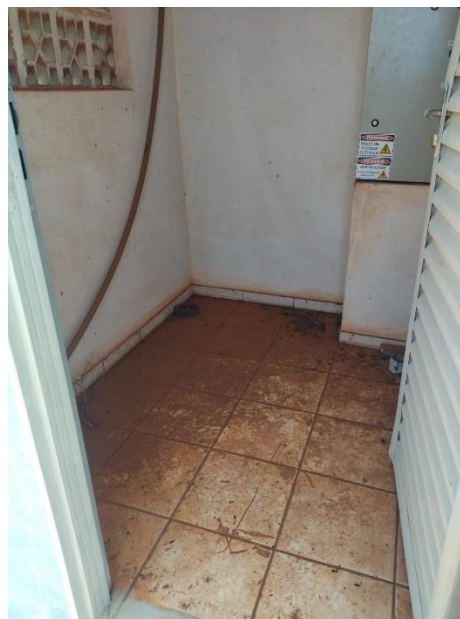
Foto 38: Falta de limpeza interna
