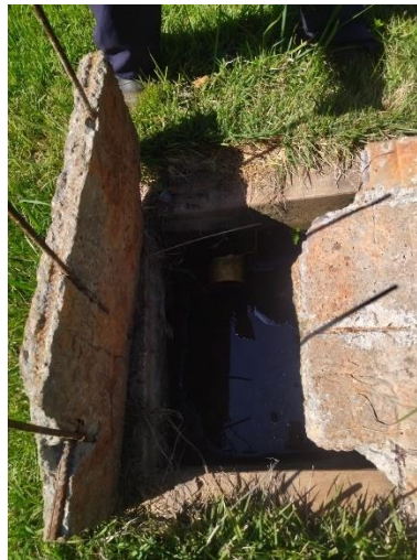
Foto 69: Extravasor sem telas de proteção e tampa inadequada.
