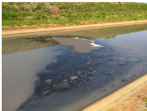
Foto 109: Excesso de lodo na entrada lagoa facultativa.
