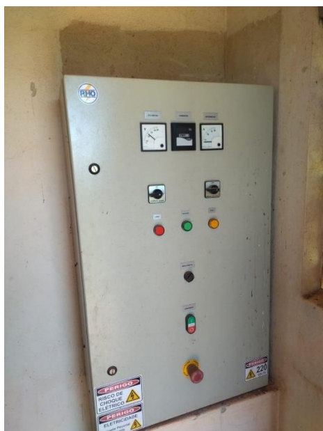
Foto 37: Quadro de comando.
