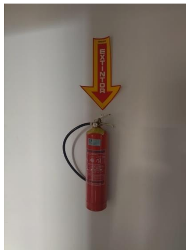
Foto 09: Localização do extintor (corredor).
