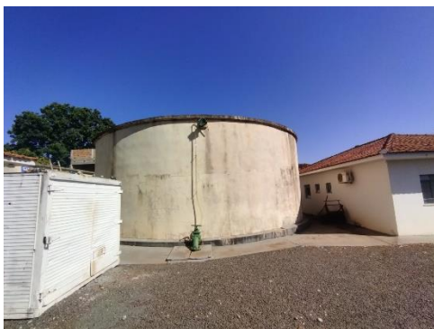
Foto 80: Falta de identificação adequada.
