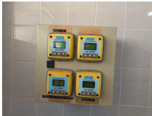
Foto 78: Painel de visualização dos macromedidores (poço 01, 02, 03 e mina).
