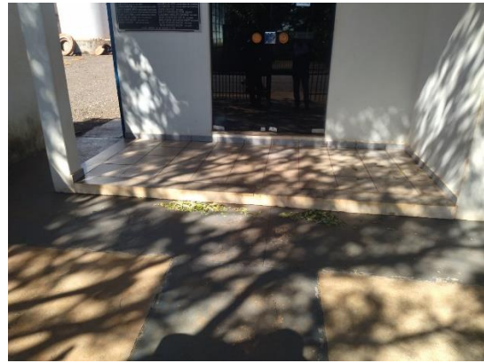
Foto 02: Falta de acessibilidade (rampa).
