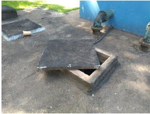
Foto 67: Tampas de inspeção inadequadas.
