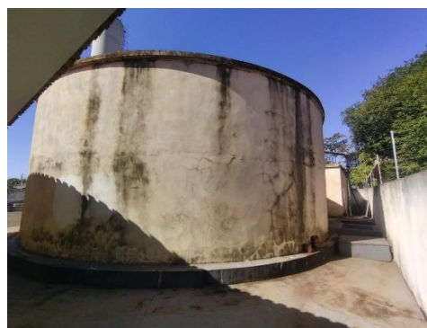
Foto 81: Falta de pintura.
