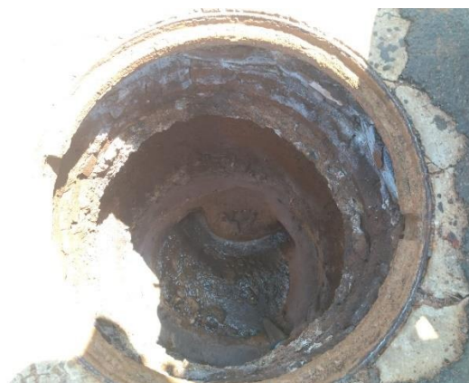
Foto 90: Pv de esgoto aberto.
