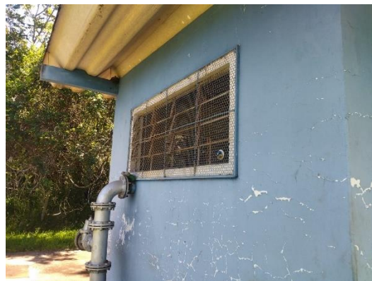
Foto 64: Janelas com proteção e ventilação.
