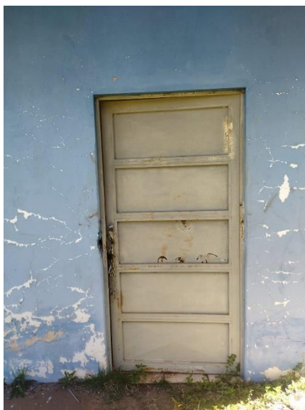
Foto 57: Necessidade de reparos estruturais.
