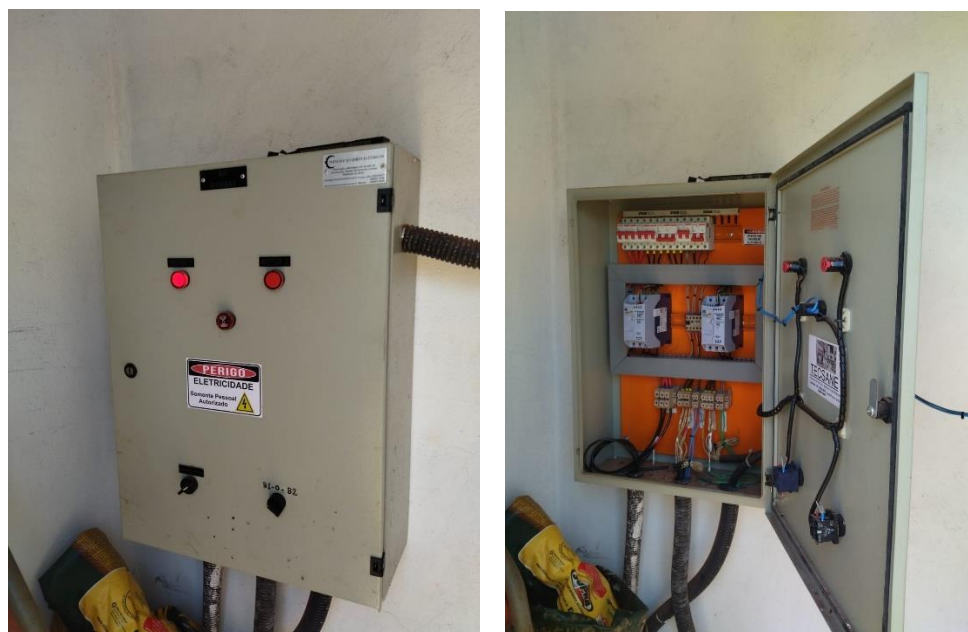
Foto 99: Quadro de Comando. Foto 100: Falta de diagrama unifilar.
