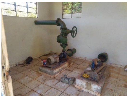
Foto 63: Falta de conjunto moto bomba reserva.
