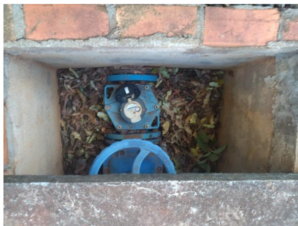
Foto 70: Macromedidor de saída (reservatório/mina 01).
