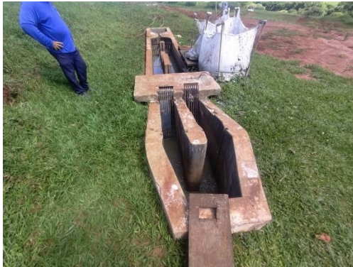
Foto 105: Tratamento primário (gradeamento e desarenador).
