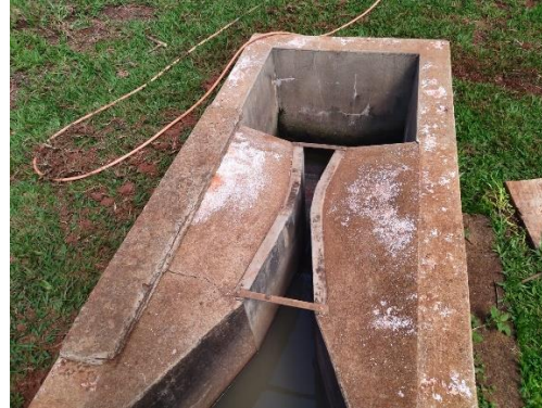
Foto 106: Calha Parshall (entrada).
