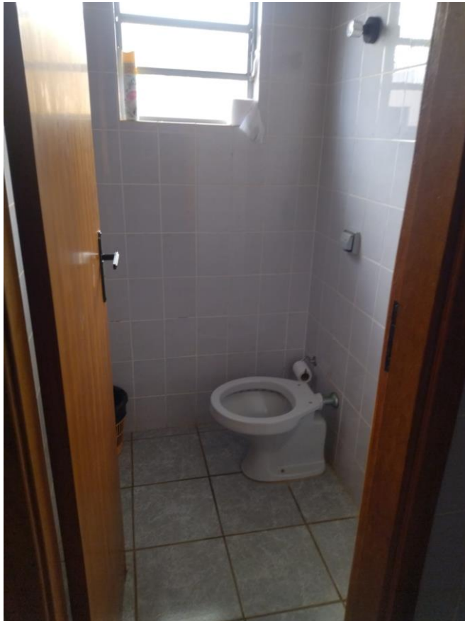
Foto 03: Falta de acessibilidade no banheiro.
