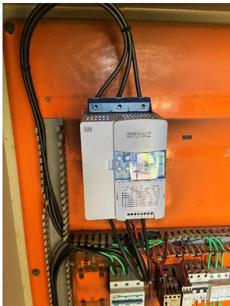
Foto 36 – Painel de Controle
