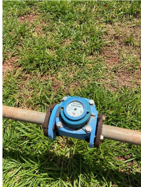
Foto 43 – Medidor de Vazão.
