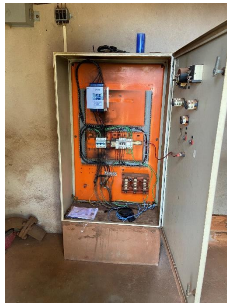
Foto 37 – Painel de Controle
