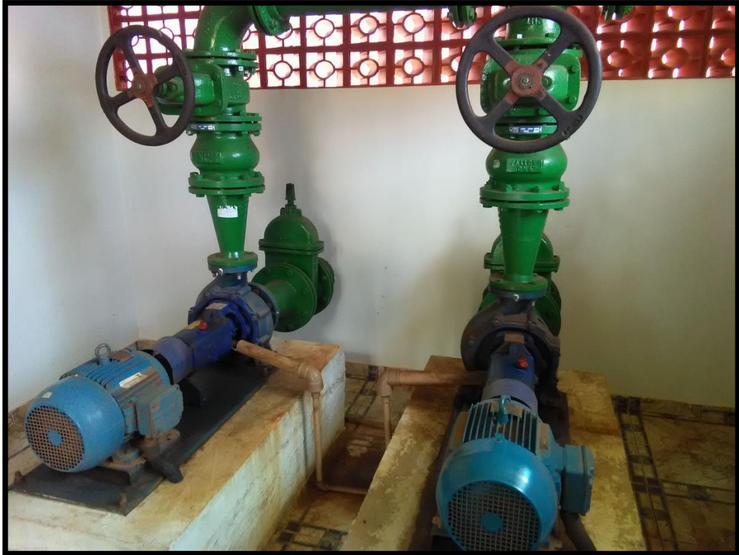
Imagem 13: Estação Elevatória – conjunto motobomba
