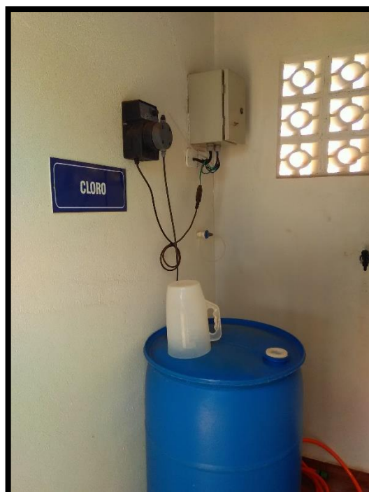
Imagem 16: Unidade de tratamento simplificado do Distrito
