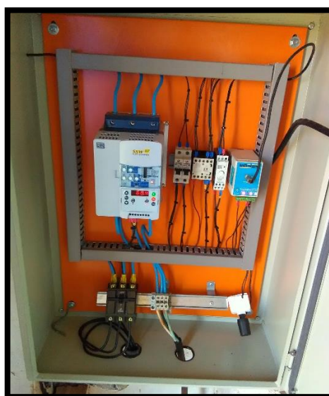
Imagem 6: Quadro de comando do poço 2
