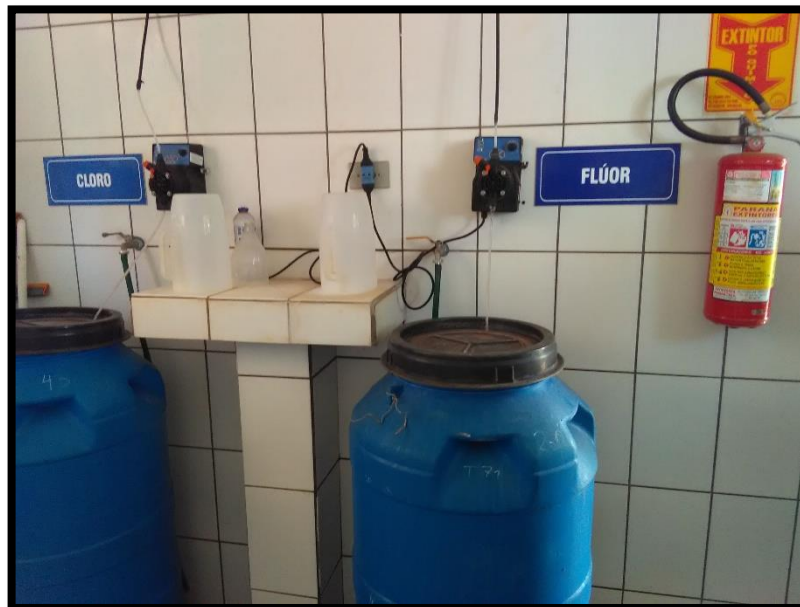
Imagem 7: Unidade de tratamento de água da área urbana
