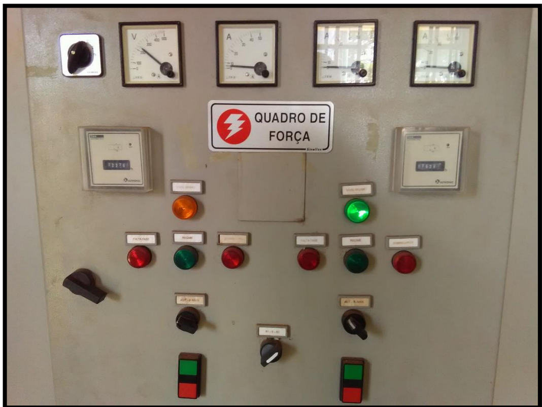
Imagem 14: Estação Elevatória – Quadro de Comando
