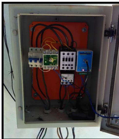
Imagem 4: Quadro de comando do poço 1
