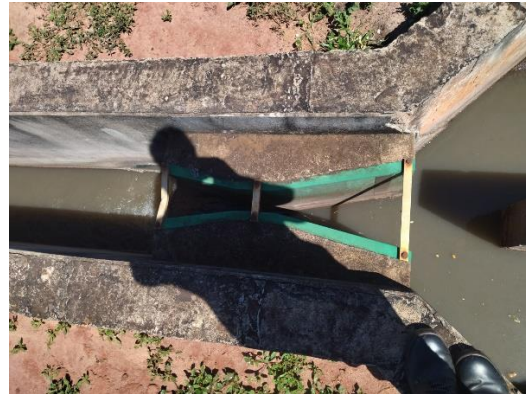
Foto 62: Calha Parshall Entrada.
