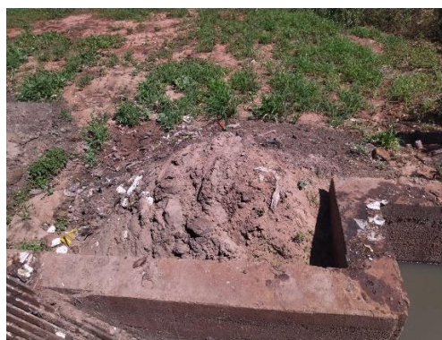
Foto 58: Armazenamento inadequado de lodo.
