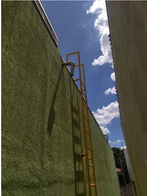
Foto 44: Falta de guarda-corpo.
