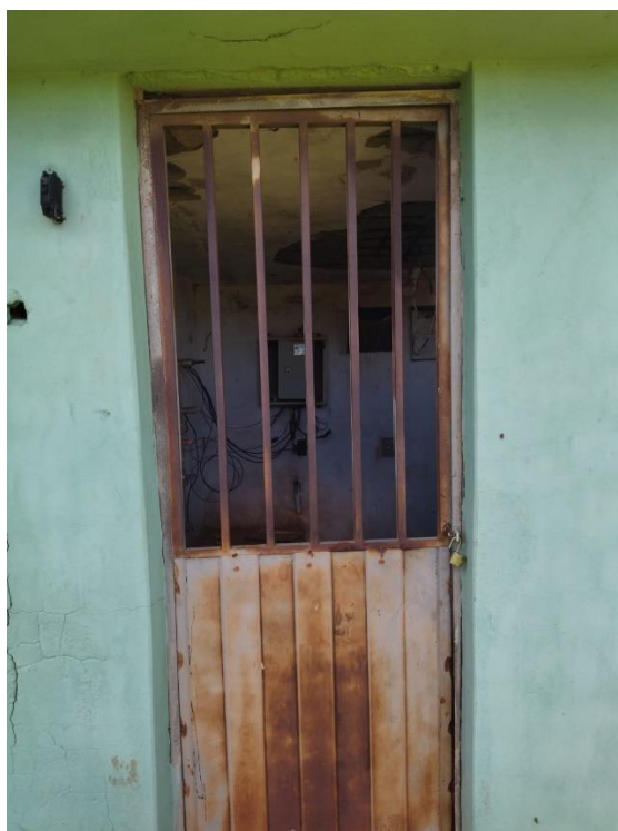
Foto 26: Ausência de diagrama unifilar, fiação exposta, acesso comprometido.
