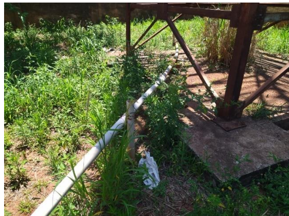
Foto 25: Ancoragem da tubulação inadequada.
