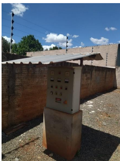
Foto 51: Cobertura do quadro de comando de recalque do RAP para o REL inadequada.
