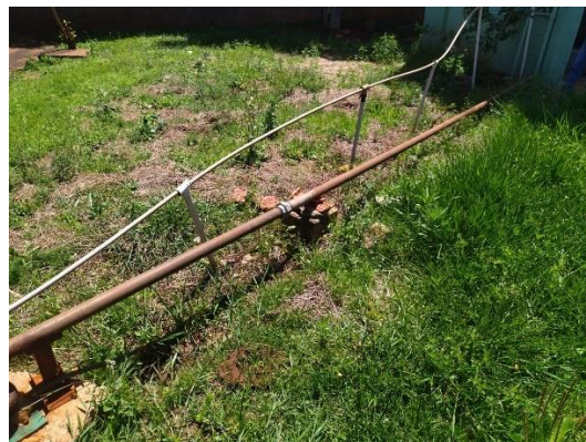
Foto 21: ancoragem do poço inadequada.
