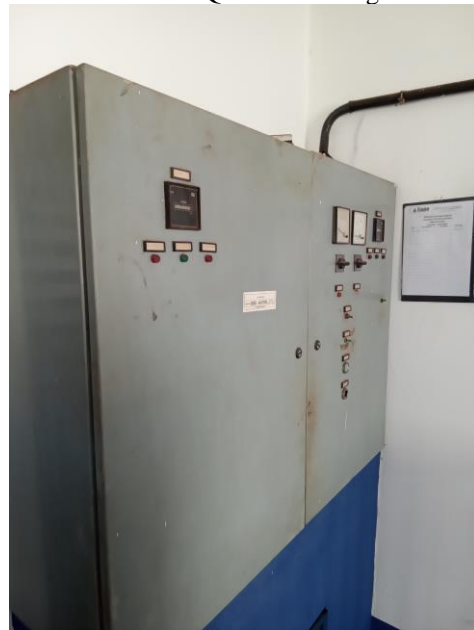
Foto 50 – Quadro de energia
