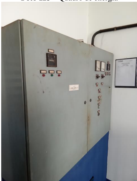
Foto 123 – Quadro de energia
