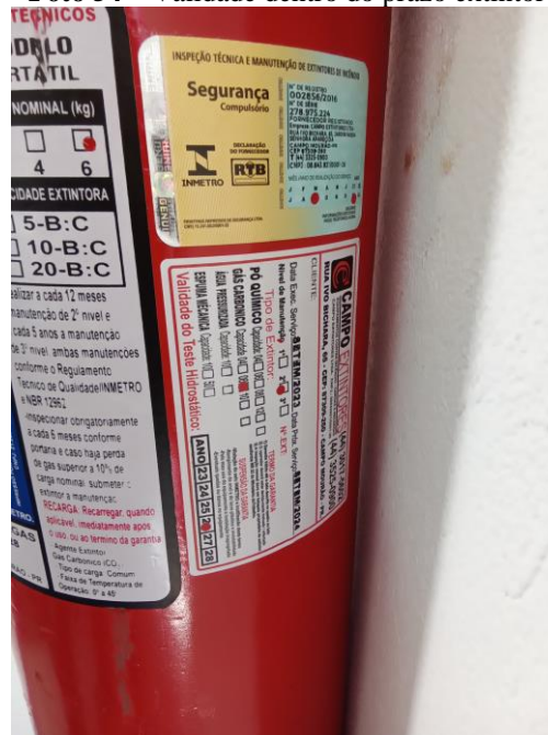
Foto 54 – Validade dentro do prazo extintor
