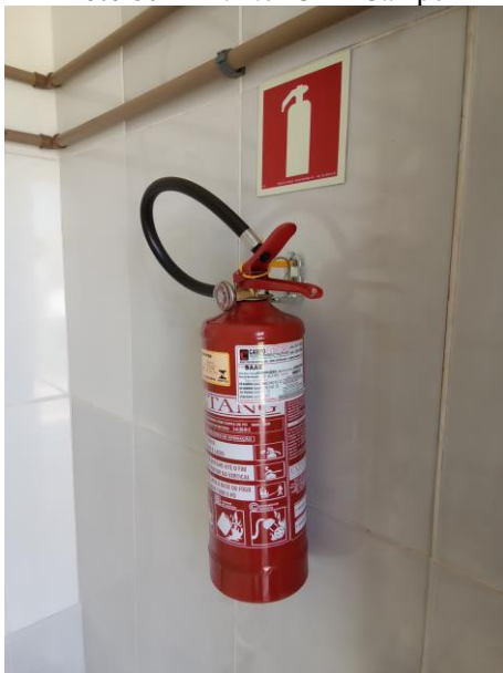
Foto 86 – Extintor UTA Campo
