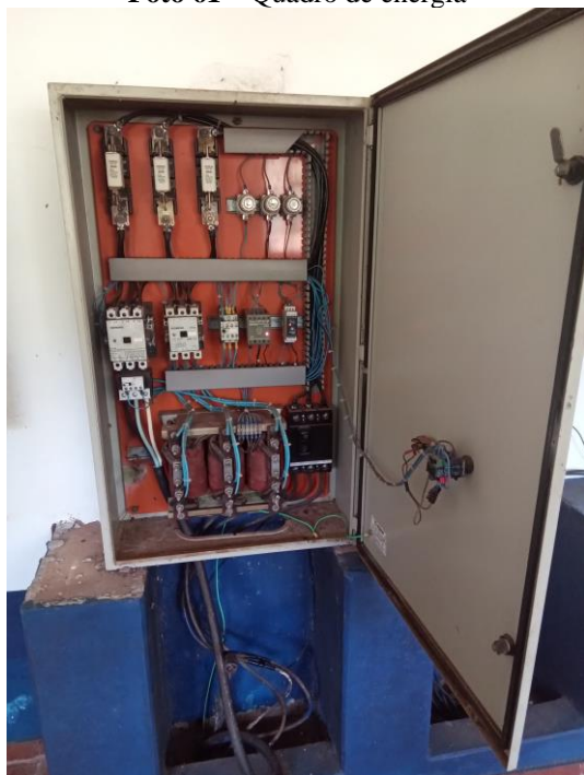
Foto 61 – Quadro de energia
