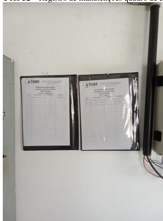
Foto 52 – Registro de manutenções quadro de energia
