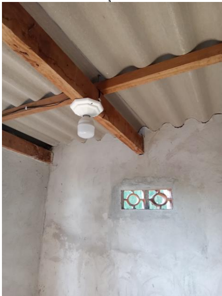
Foto 32 – Iluminação e abertura telada
