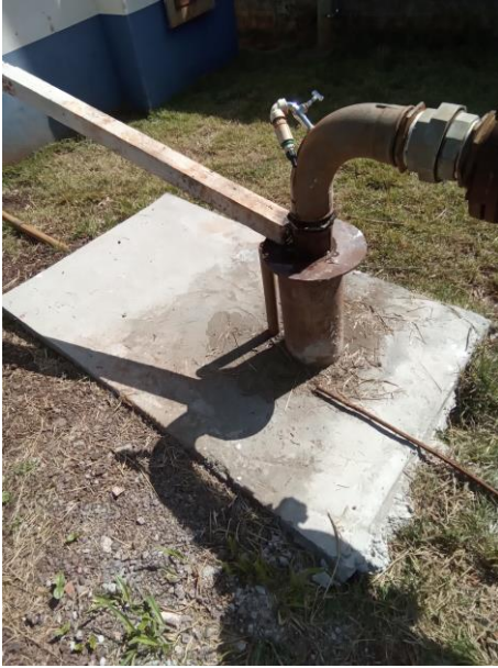
Foto 76 – Torneira de coleta água bruta
