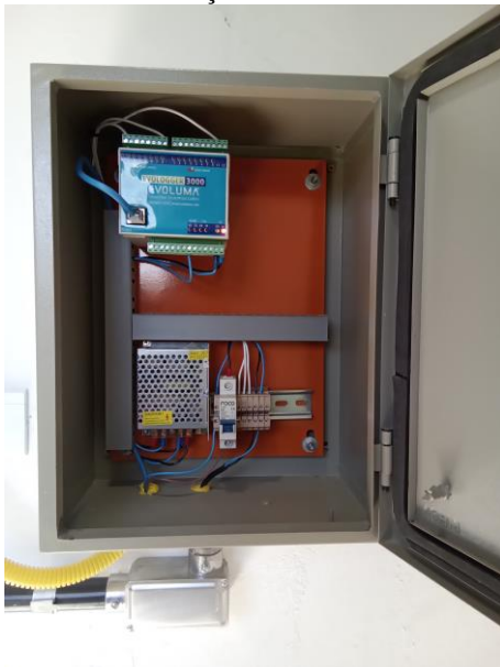
Foto 117 – Automação reservatórios sistema 02
