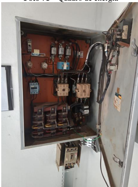
Foto 71 – Quadro de energia
