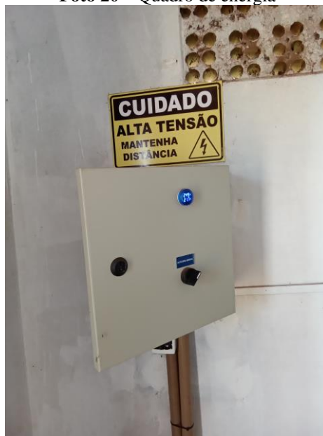
Foto 20 – Quadro de energia
