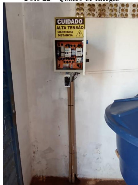
Foto 22 - Quadro de energia
