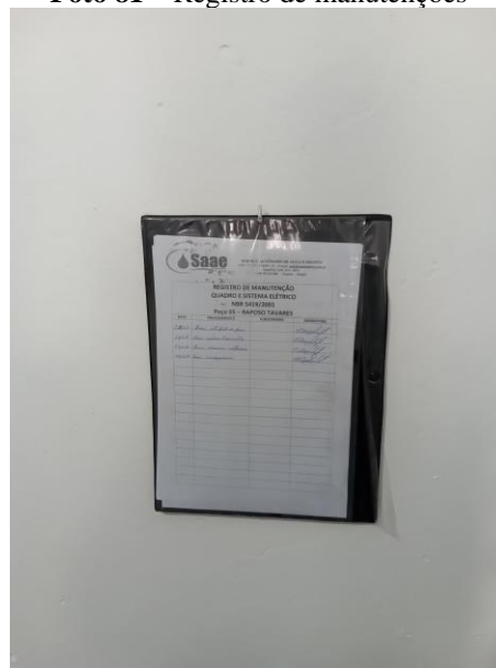
Foto 81 – Registro de manutenções
