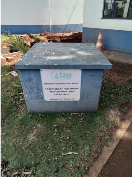
Foto 47 – Identificação poço 6 SAAE
