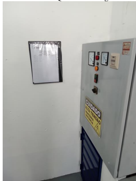
Foto 79- Quadro de energia
