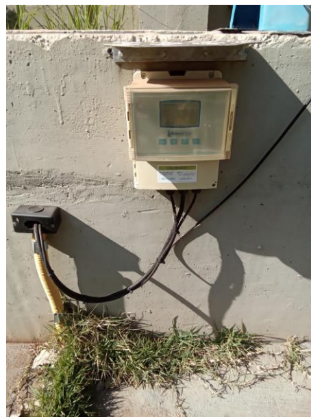
Foto 127 – Medidor de vazão EEE Centro Cívico
