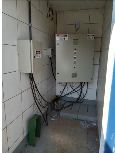
Foto 25 – Casa de comando poço São José 3
