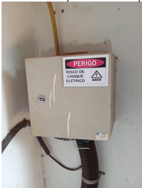
Foto 81 – Frente quadro de comando poço Mauá
