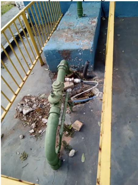
Foto 42 – Poço Praça Ipiranga
