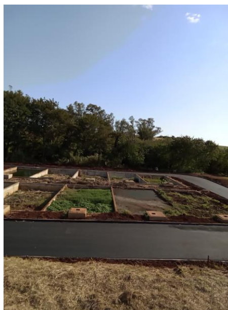
Foto 139 – Leito de secagem – ETE Norte
