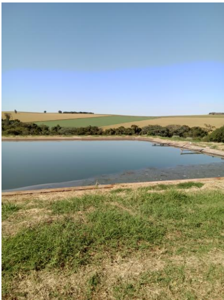
Foto 142 – Lagoa anaeróbia ETE Sul
