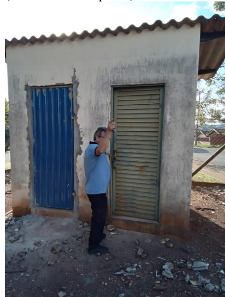
Foto 79 – Casa de comando poço Mauá (necessitando reparos)
