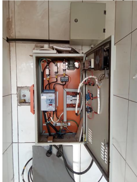
Foto 39 – Quadro de comando poço São Paulo
