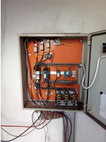
Foto 60 –Quadro de comando poço José Richa
