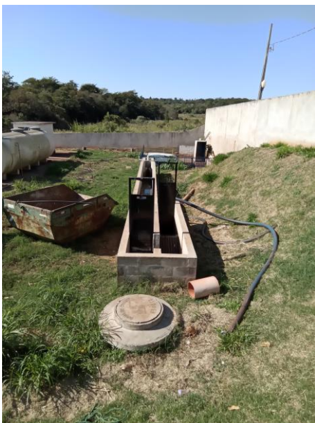
Foto 146 – Gradeamento grosseiro, medidor de vazão e desarenador ETE França
