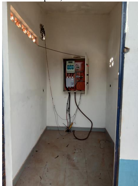
Foto 73 – Casa de comando poço Floresta (fios soltos e limpeza)
