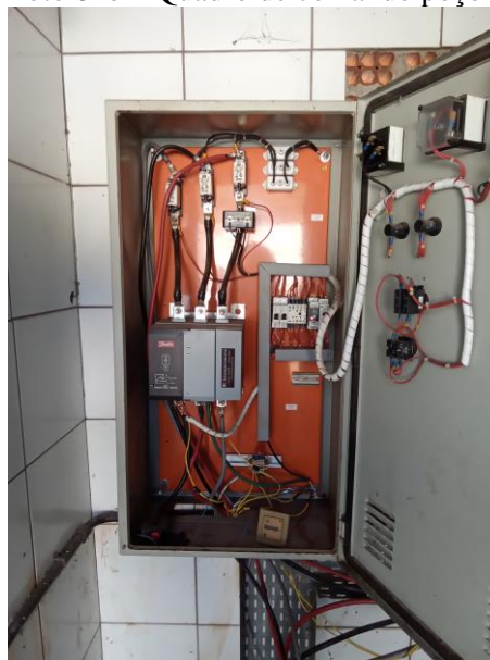
Foto 82b – Quadro de comando poço Mauá
