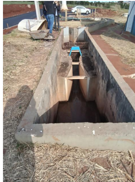
Foto 131 – Calha Parshall entrada ETE Norte
