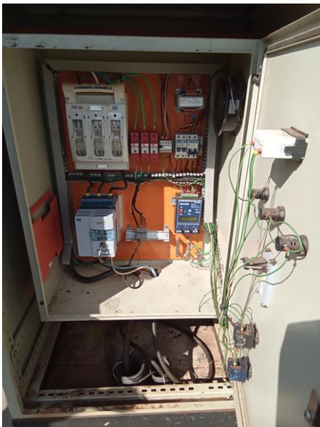
Foto 124 – Quadro de comando EEE Norte
