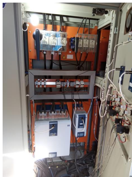
Foto 129 – Quadro de comando EEE Centro Cívico
