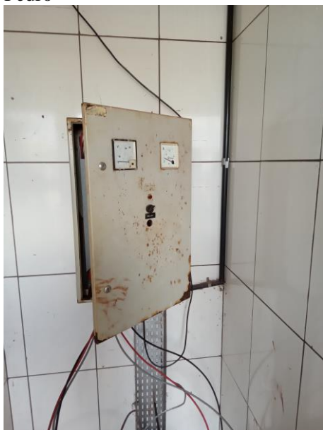
Foto 68 – Frente do quadro de comando poço São Pedro
