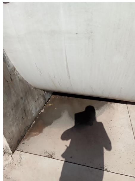
Foto 151 – Vazamento reator ETE França
