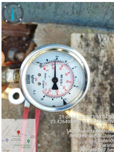
Foto 113 – Pressão Hidrômetro 01 – P=26 psi - 18,60 mca
