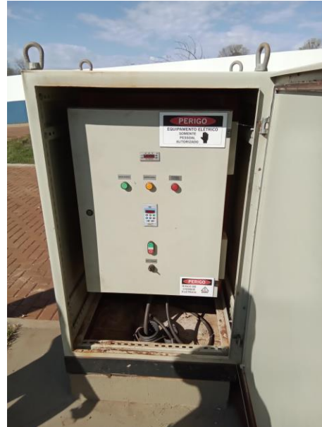
Foto 123 – Frente do quadro de comando EEE Norte (material limpeza EEE)
