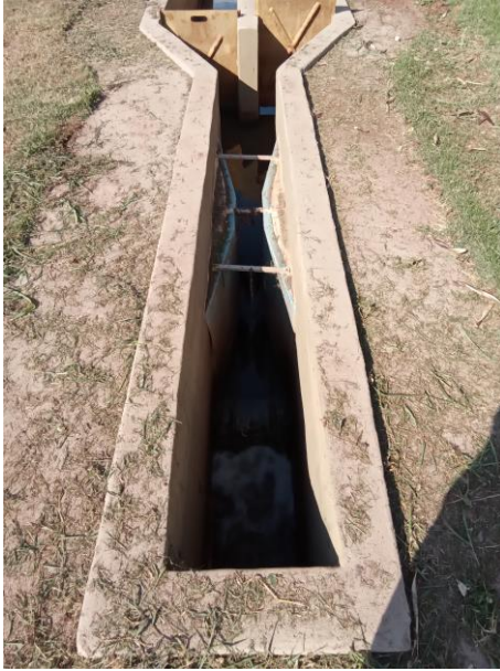
Foto 122 – Calha Parshall EE Norte
