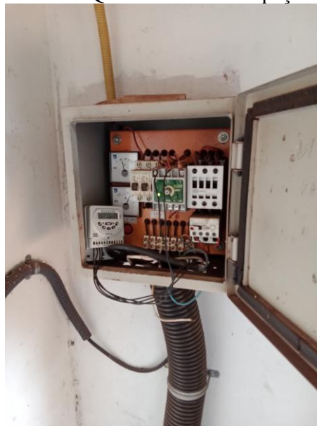
Foto 82 – Quadro de comando poço Mauá
