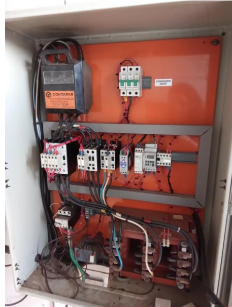
Foto 65 – Quadro de comando 01 poços Vale Azul
