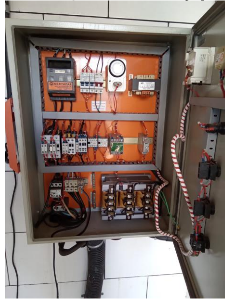
Foto 49 – Quadro de comando poço Paulista
