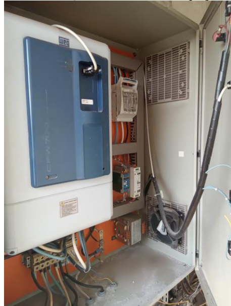
Foto 23 – Quadro de comando poço São José 3
