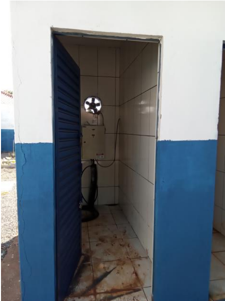
Foto 32 – Casa de comando poço Juraci – Terra Azul
