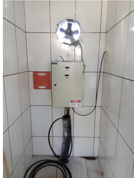
Foto 33 – Frente do quadro de comando poço Juraci – Terra Azul
