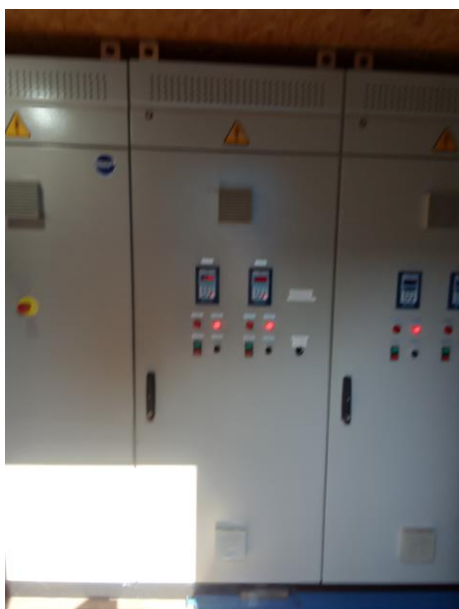
Foto 128 – Frente do quadro de comando EEE Centro Cívico
