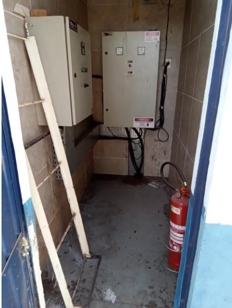
Foto 56 – Casa e frente dos quadros de comando poço Nova Sarandi 2
