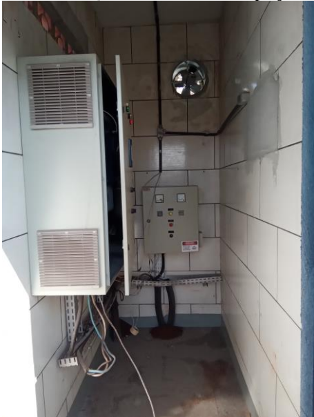
Foto 22 – Quadro de comando poço São José 3
