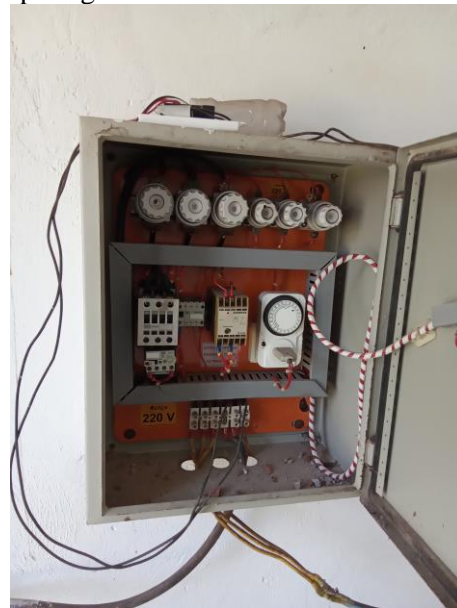
Foto 45 – Quadro de comando poço praça Ipiranga
