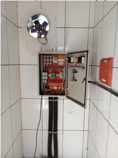
Foto 30 – Quadro de comando poço Montreal
