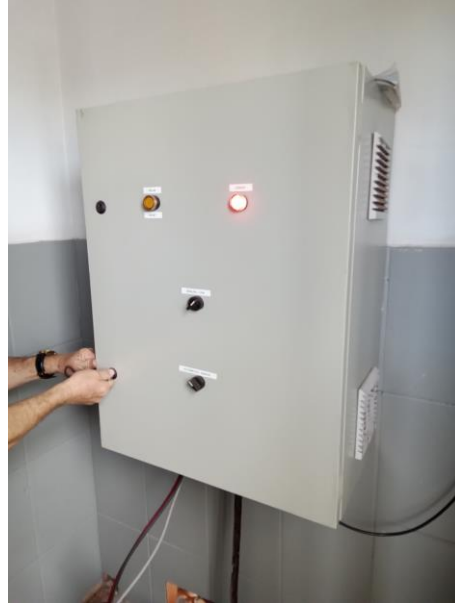
Foto 53 – Frente quadro de comando poço Vitória
