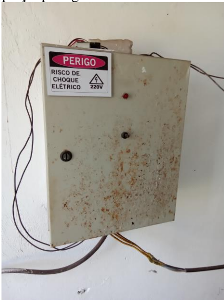
Foto 44 – Frente do quadro de comando poço praça Ipiranga
