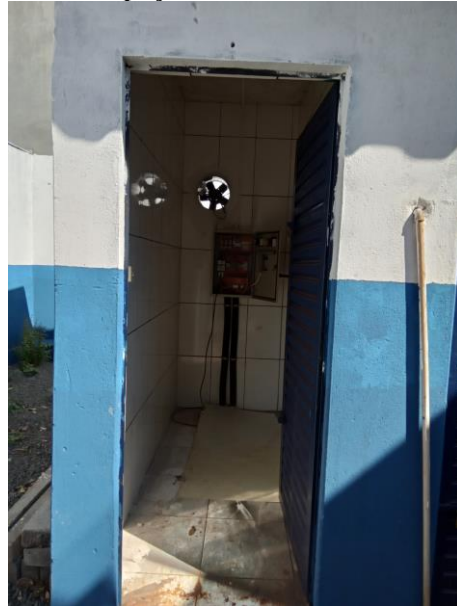
Foto 29 – Falta de identificação casa de comando poço Montreal
