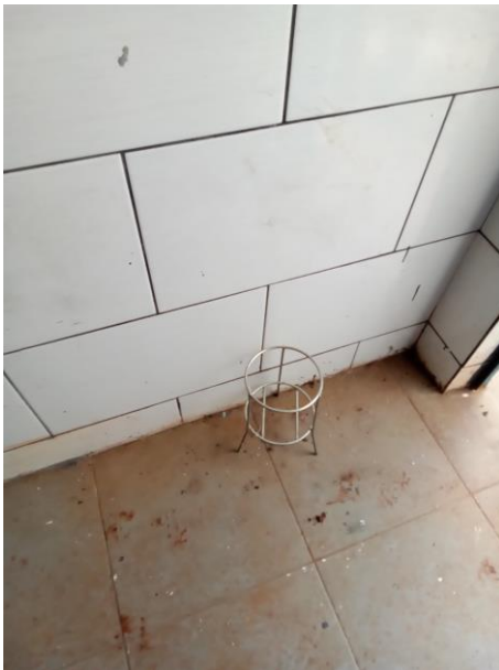
Foto 50 – Falta de extintor casa de comando poço Paulista
