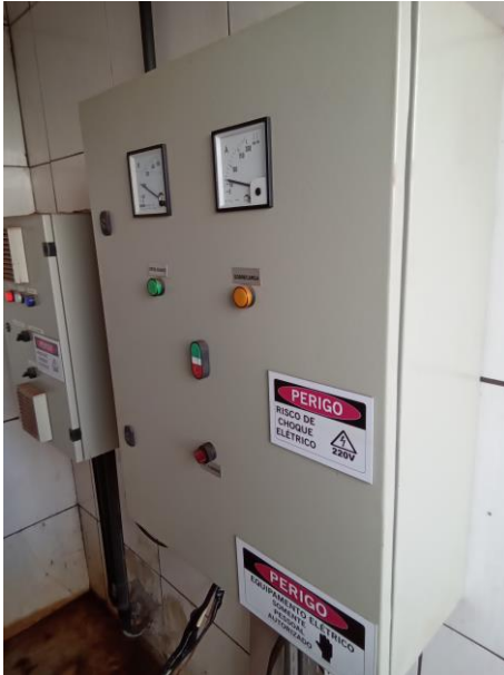
Foto 64 – Frente do quadro de comando poços Vale Azul
