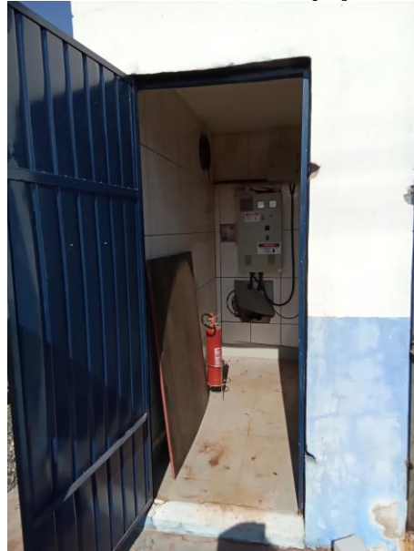
Foto 37 – Casa de comando poço São Paulo
