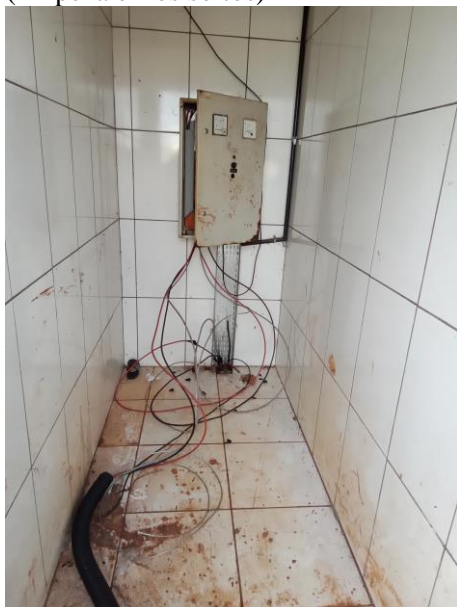
Foto 70 – Casa de comando poço São Pedro (limpeza e fios soltos)
