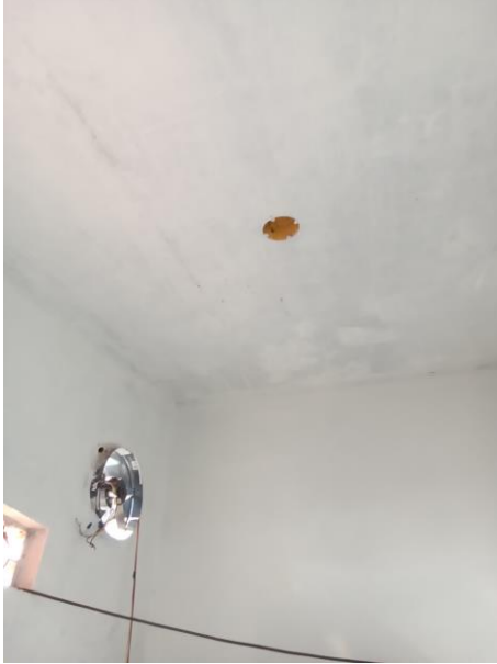
Foto 76 – Sem iluminação poço casa de comando poço Floresta
