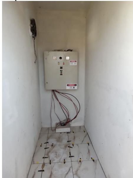
Foto 19 – Frente do quadro de comando poço Tropical
