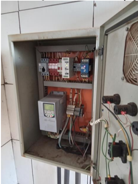
Foto 66 – Quadro de comando 02 poços Vale Azul
