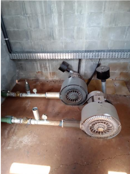
Foto 148 – Elevatória ETE França
