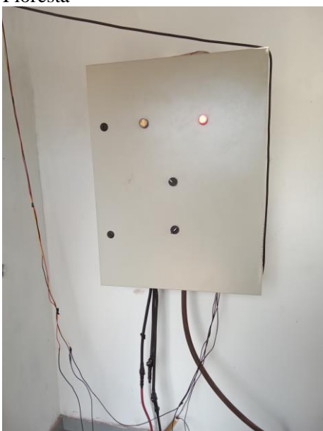
Foto 74 – Frente do quadro de comando poço Floresta
