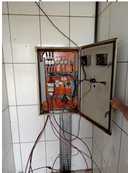
Foto 69 – Quadro de comando poço São Pedro
