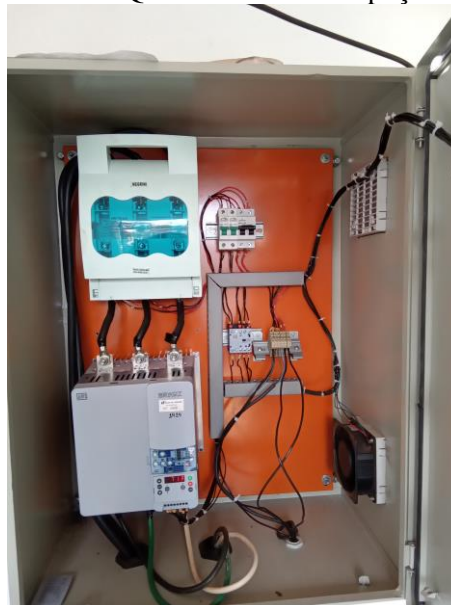
Foto 75 - Quadro de comando poço Floresta
