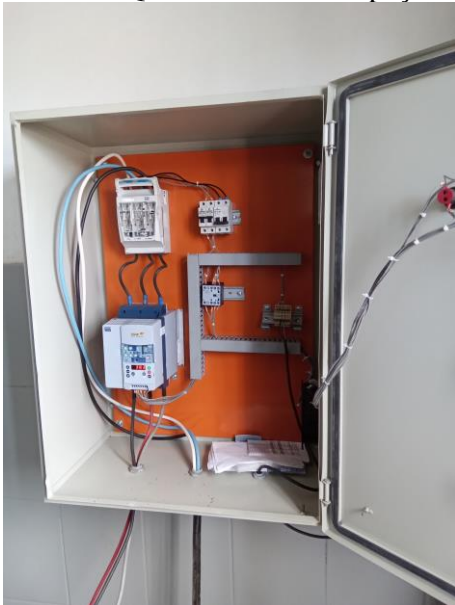
Foto 54 – Quadro de comando poço Vitória
