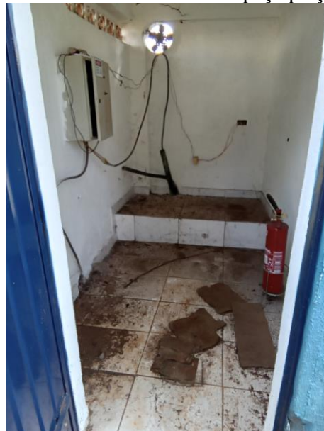
Foto 43 – Casa de comando poço praça Ipiranga
