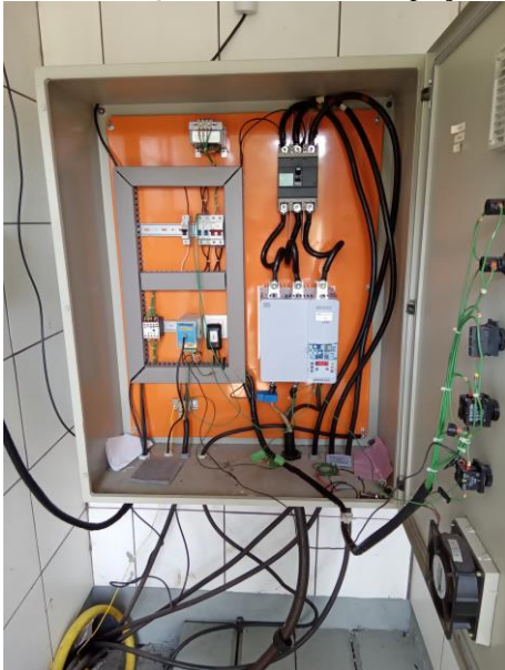
Foto 26 – Quadro de comando poço São José 3
