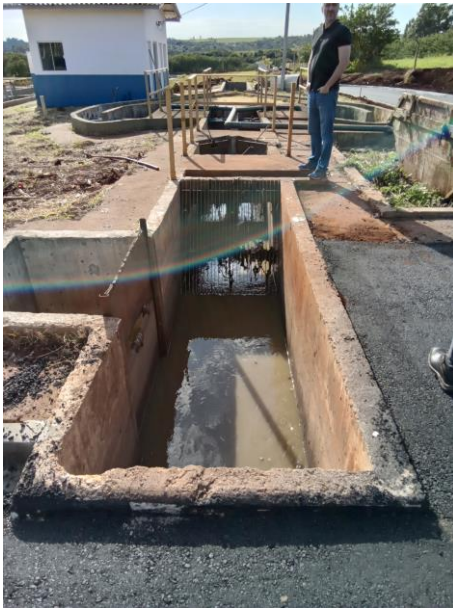
Foto 130 – Gradeamento ETE Norte
