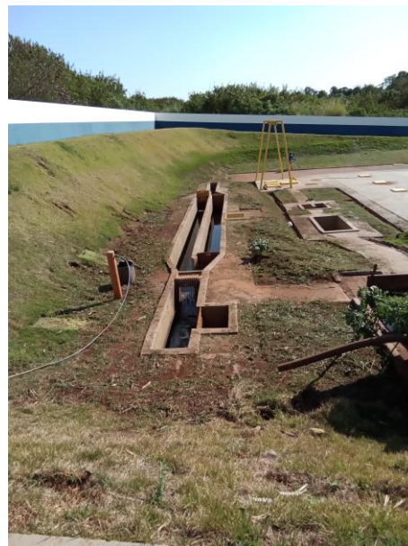
Foto 121 – Gradeamento, desarenador EEE Norte
