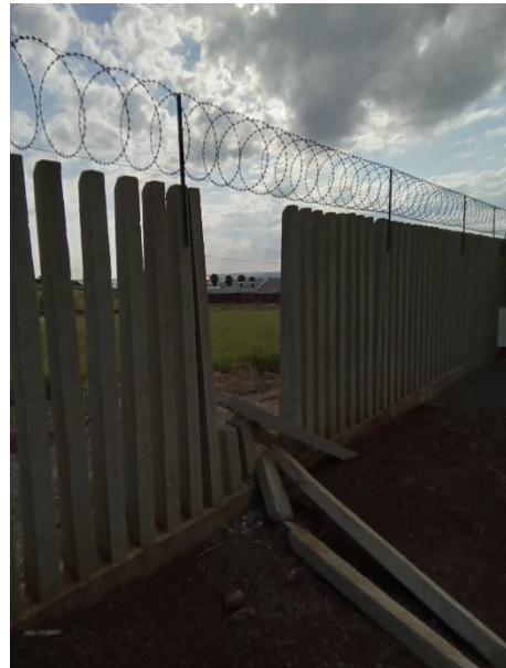
Foto 108 – Isolamento danificado REL Ecovaley
