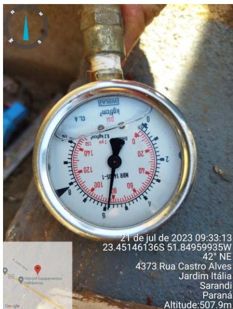
Foto 116 – Pressão Hidrômetro 02 – P=83 psi – 58,10 mca
