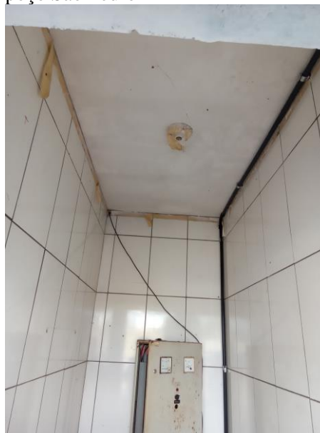
Foto 71 – Falta de iluminação casa de comando poço São Pedro
