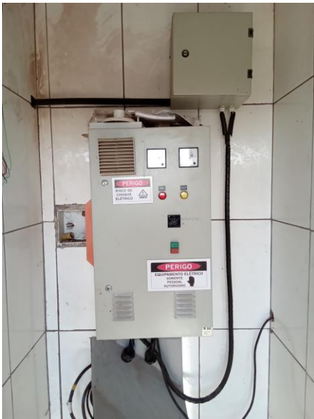
Foto 38 – Frente quadro de comando poço São Paulo
