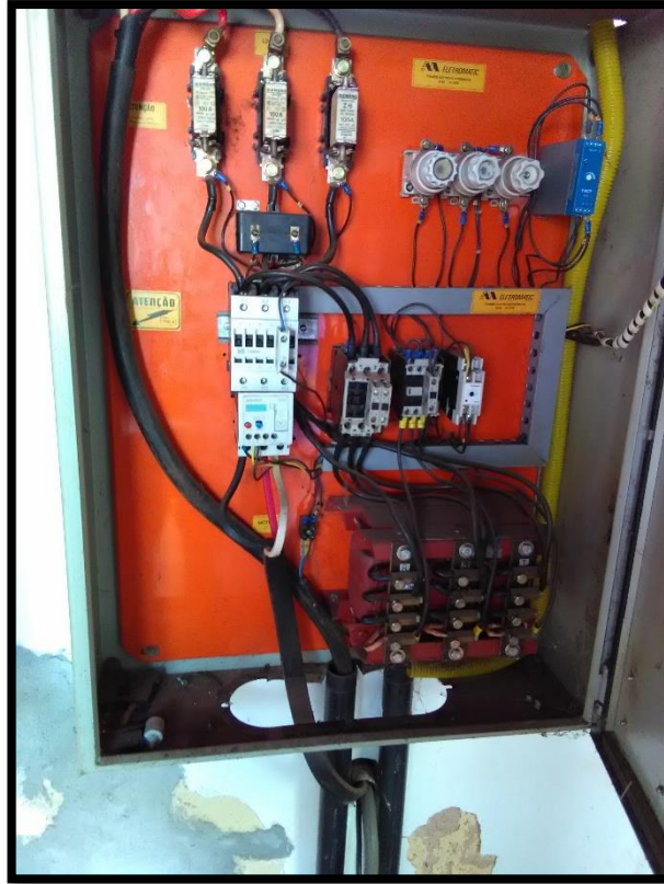
Imagem 22: Estação Elevatória de Água da Zona Sul – Quadro de Comando
