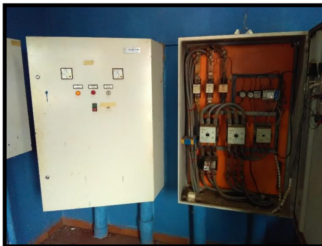
Imagem 24: Estação Elevatória de Água da Zona Norte – Quadro de Comando
