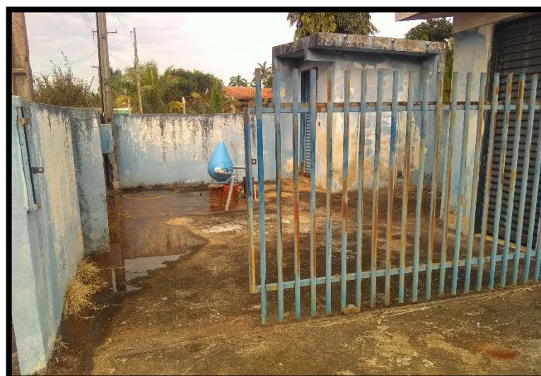
Imagem 37: Poço e unidade de tratamento do Conjunto Santa Ruth
