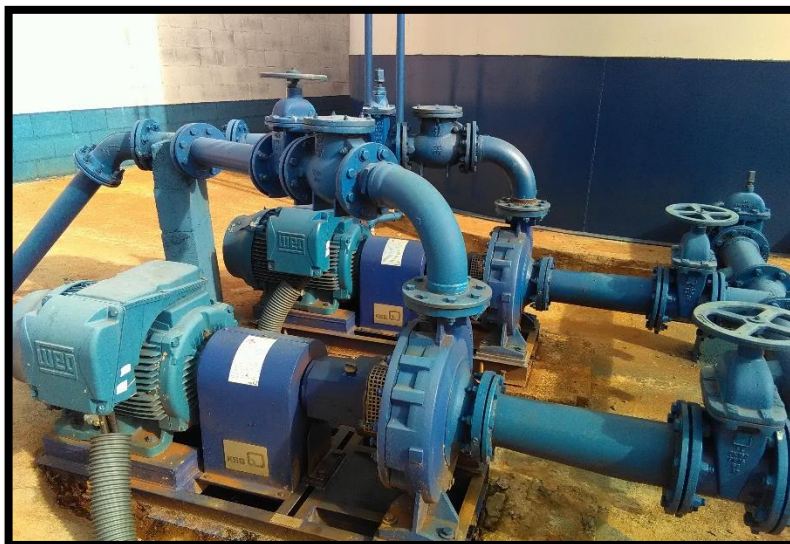
Imagem 30: Estação elevatória de água bruta do Setor Leste
