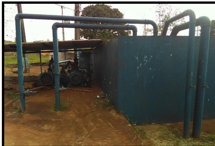
Imagem 20: Reservatório semienterrado de água bruta da Zona Norte
