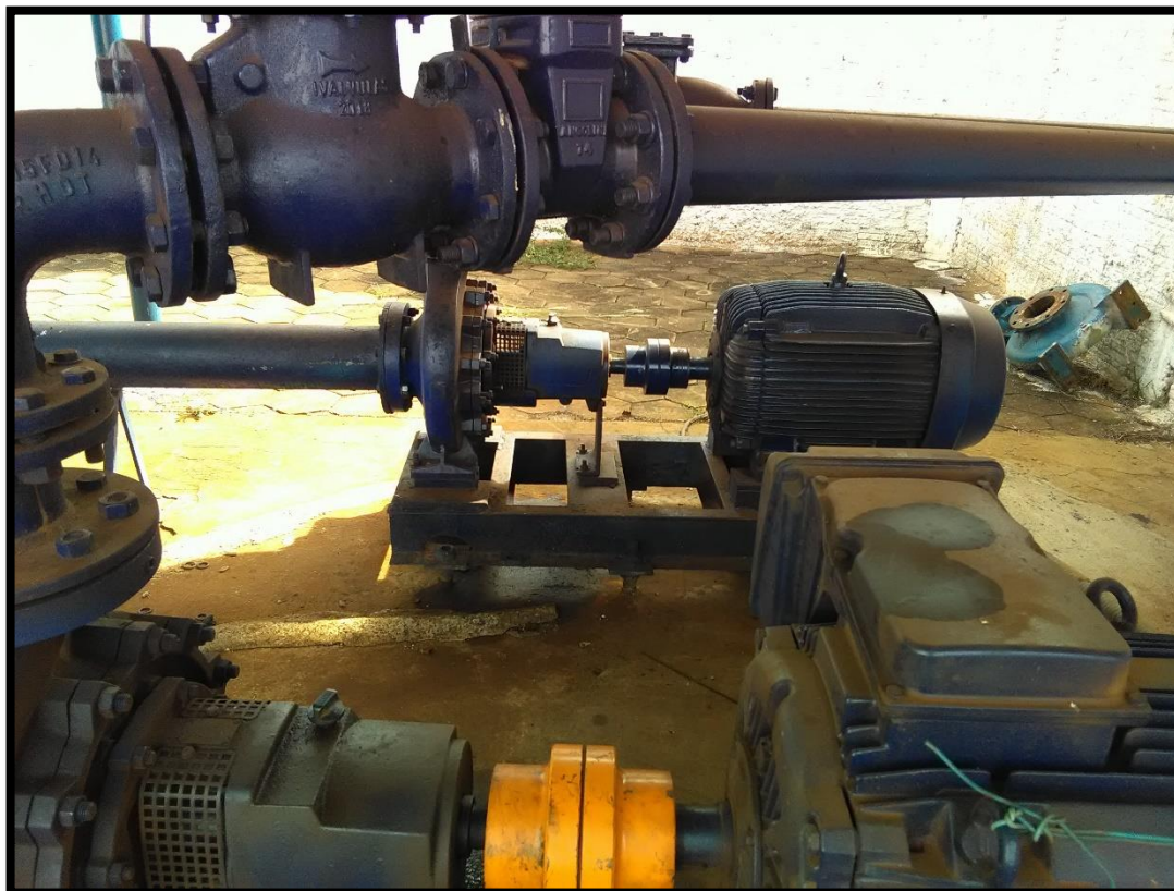
Imagem 21: Estação Elevatória de Água da Zona Sul
