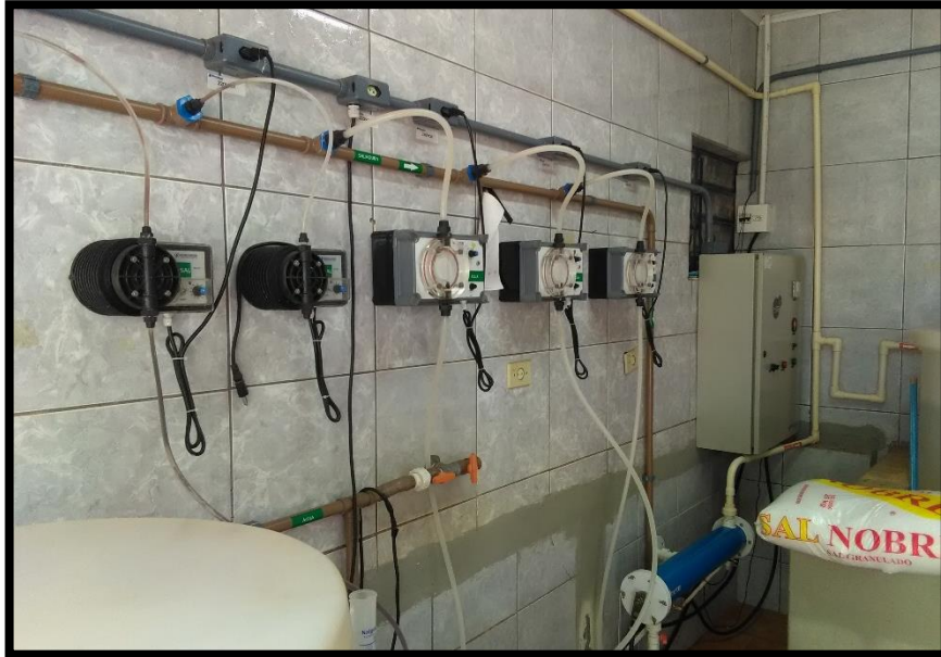
Imagem 12: Estação de tratamento simplificado – Dosadoras e reservatórios
