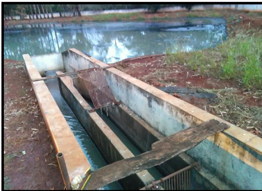
Imagem 46: ETE – Gradeamento, Desarenador e Calha Parshall
