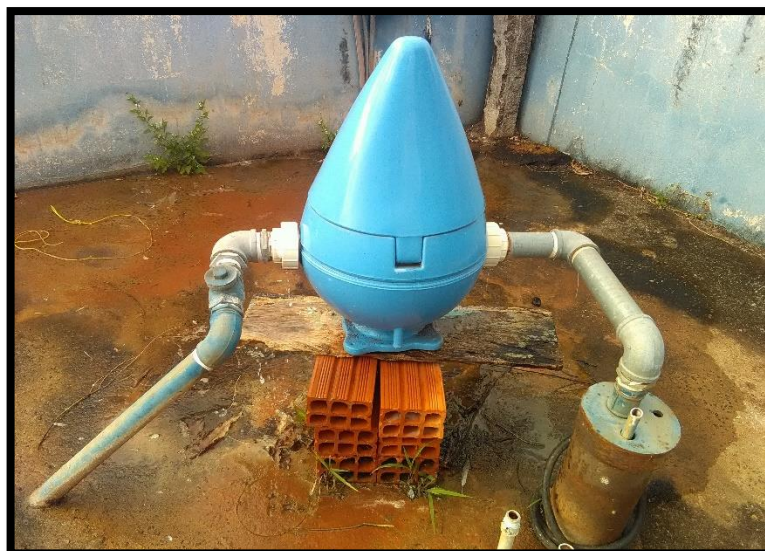
Imagem 36: Poço e unidade de tratamento do Conjunto Santa Ruth
