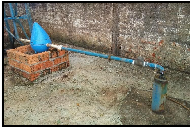
Imagem 42: Poço e unidade de tratamento do Conjunto Cachoeira
