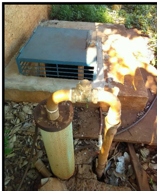
Imagem 21: Poço Planalto Chão
