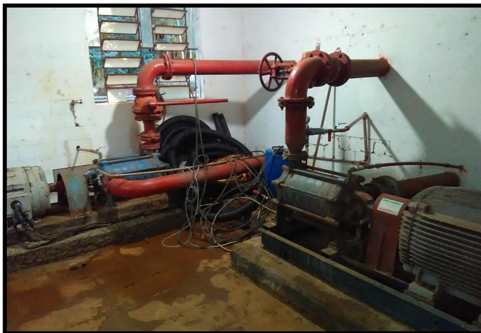
Imagem 81: Estação elevatória Mina 2 – conjunto motobombas
