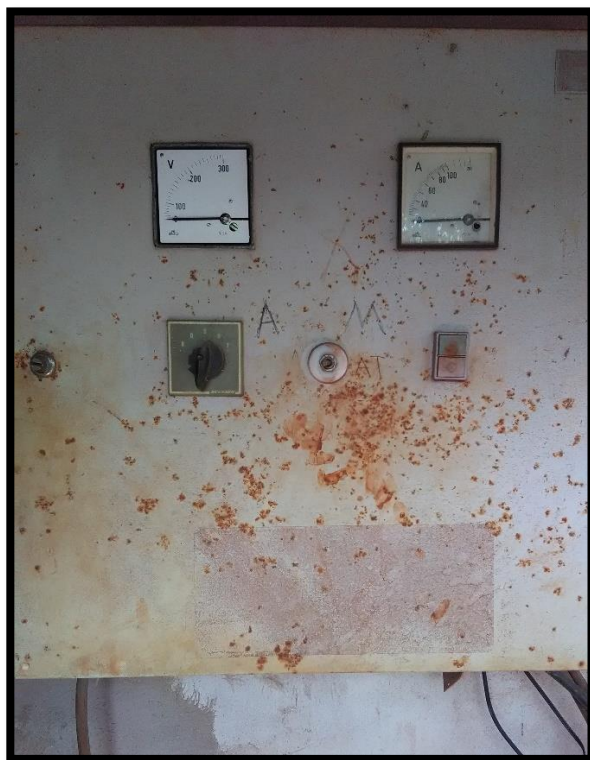
Imagem 9: Poço Jd. Custódio - quadro de comando
