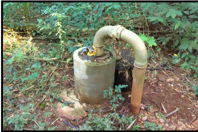
Imagem 32: Poço Adutora II
