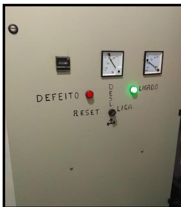
Imagem 82: Estação elevatória Mina 2 – quadro de comando
