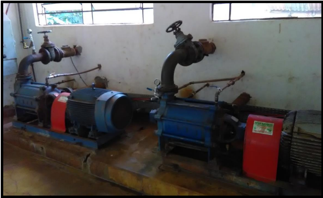
Imagem 79: Estação elevatória Mina 1 – conjunto motobombas
