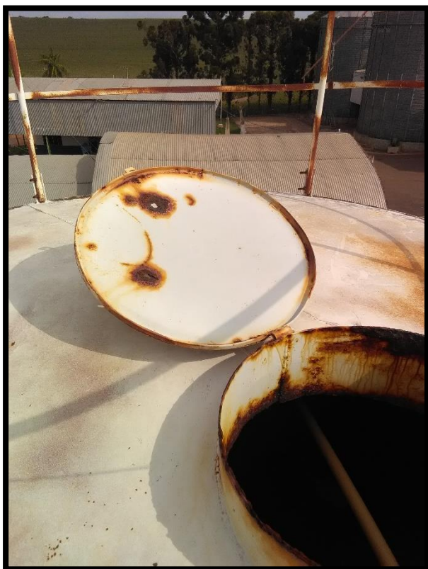
Imagem 57: Reservatório São Luiz
