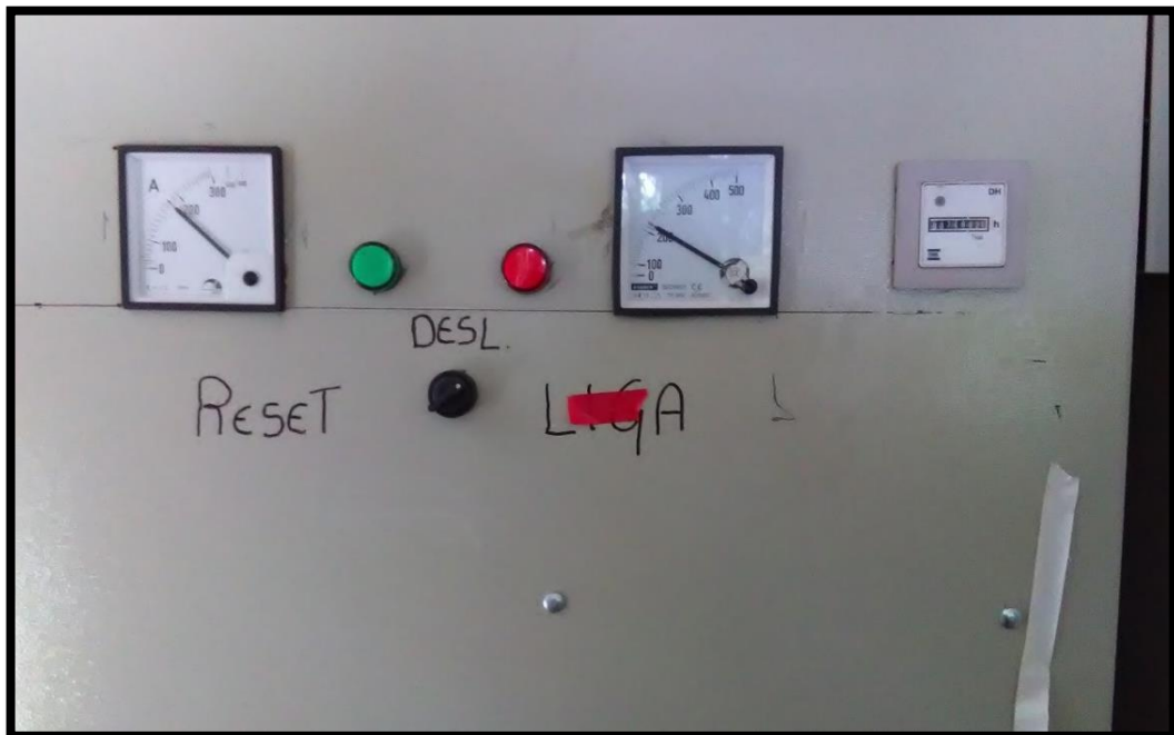
Imagem 80: Estação elevatória Mina 1 – quadro de comando
