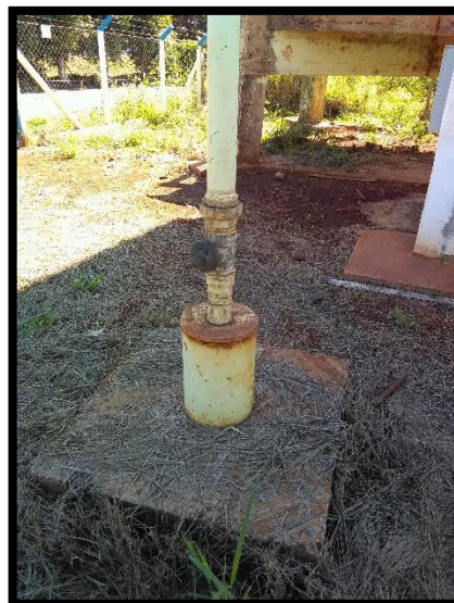
Imagem 24: Poço Minas Gás
