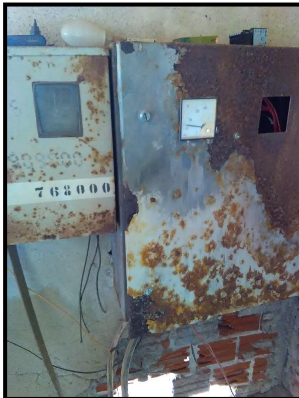
Imagem 7: Poço Dr. Emilio – quadro de comando
