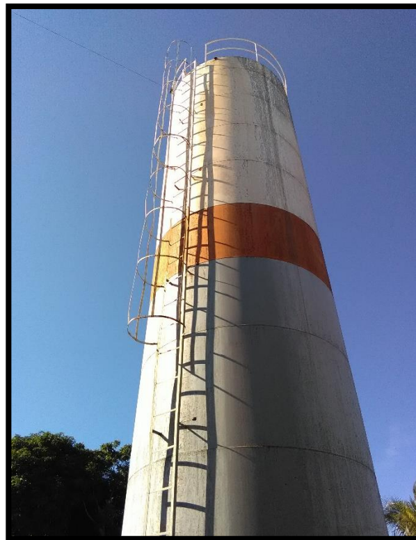
Imagem 64: Reservatório Planalto Escola
