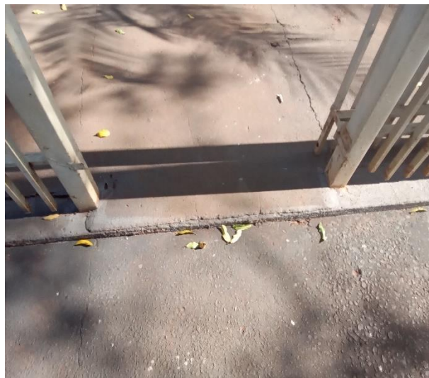
Foto 5 – Entrada necessitando corrigir saliência entrada
