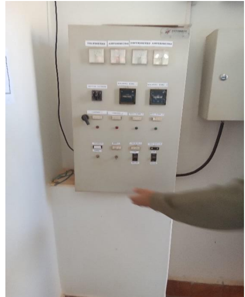
Foto 25 – Quadro de comando
