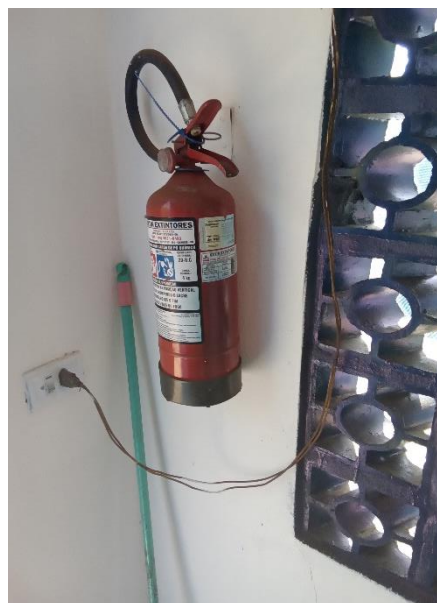
Foto 20 – Extintor de incêndio da casa de comando
