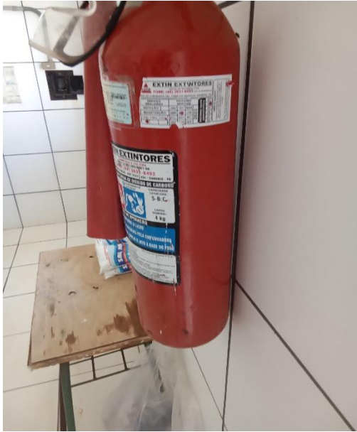
Foto 29 – Extintor de incêndio UTA
