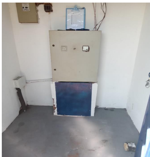
Foto 18 – Quadro de comando
