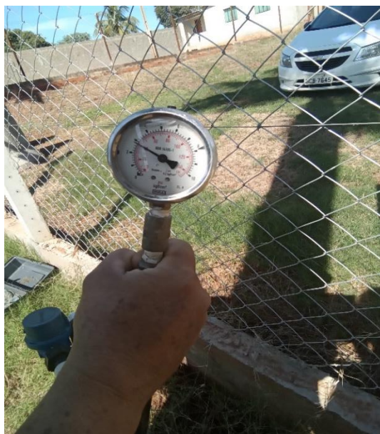
Foto 42 – Medição de pressão P01 (P = 28,9 m.c.a)
