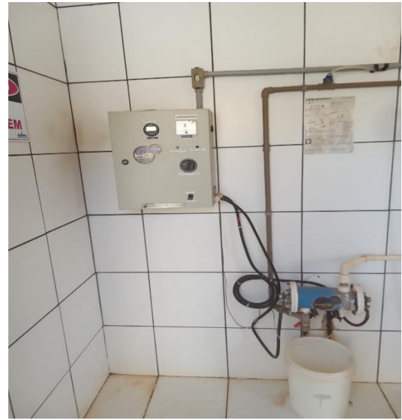
Foto 32 – Quadro de comando UTA
