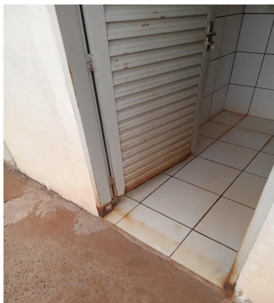
Foto 28 – Portas em condições inadequadas
