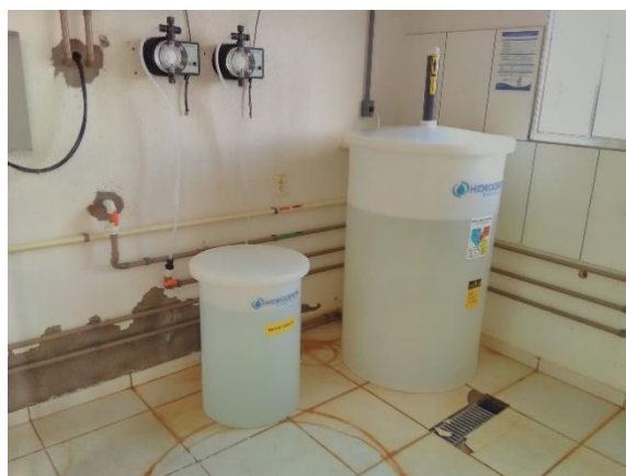
Foto 32 – Bombas dosadoras de cloro e fluor
