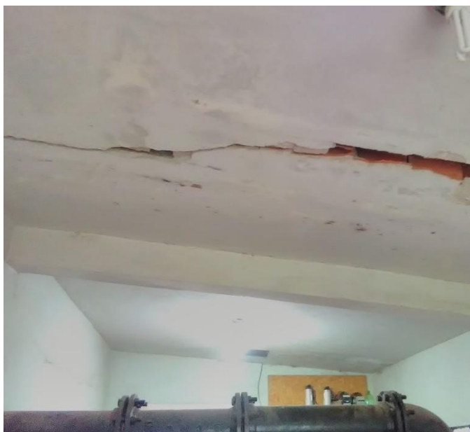
Foto 47 – Trinca na laje da unidade da estação elevatória de água bruta
