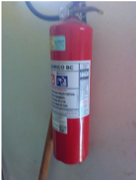
Foto 21 – Extintor casa de comando poço 02
