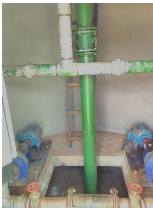
Foto 54 – conjunto moto bomba da elevatória de água tratada
