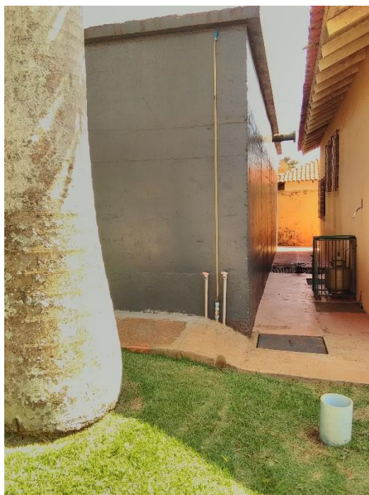
Foto 41 – Controle nível e ponto de coleta RAP 03
