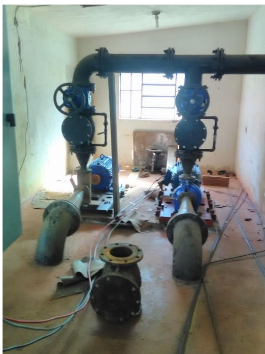
Foto 49 – Conjunto moto-bomba da elevatória de água bruta
