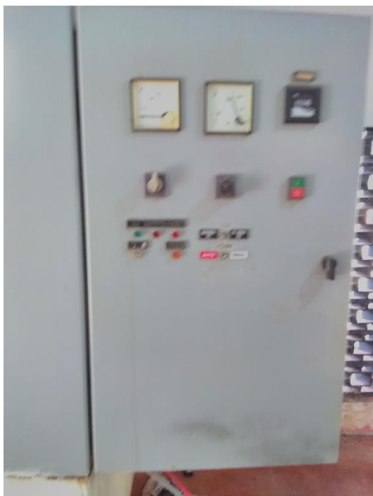
Foto 51 – Parcial da frente do quadro de comando da elevatória de água bruta
