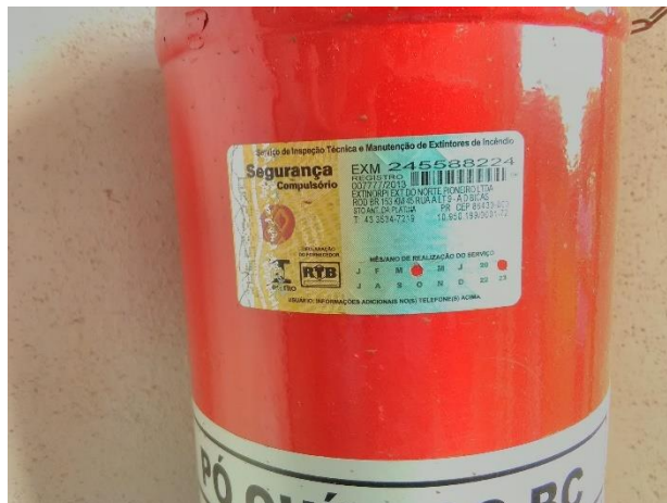
Foto 30 – Validade extintor casa de comando poço 03
