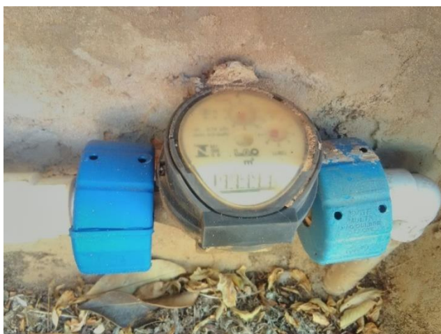
Foto 63 – Hidrômetro da Rua Ismael Modesto de Pinho, nº. 635
