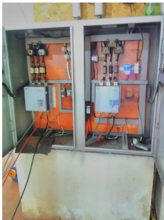
Foto 52 – Quadro de comando da elevatória de água bruta
