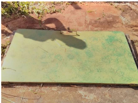
Foto 30 – Reservatório enterrado (minas e poço 02)
