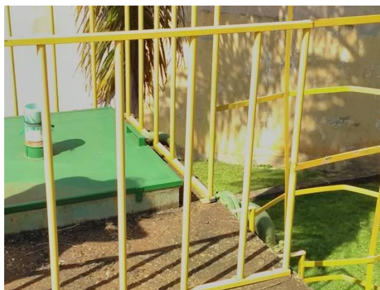
Foto 43 – Escada e guarda corpo RAP 02
