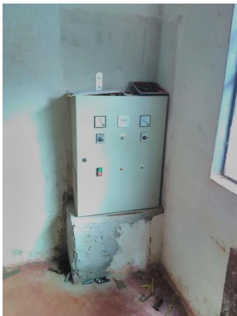
Foto 19 – Frente quadro poço 02
