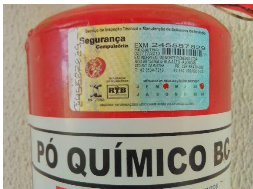
Foto 37 – Extintor próximo ao quadro de comando do tratamento (validade)
