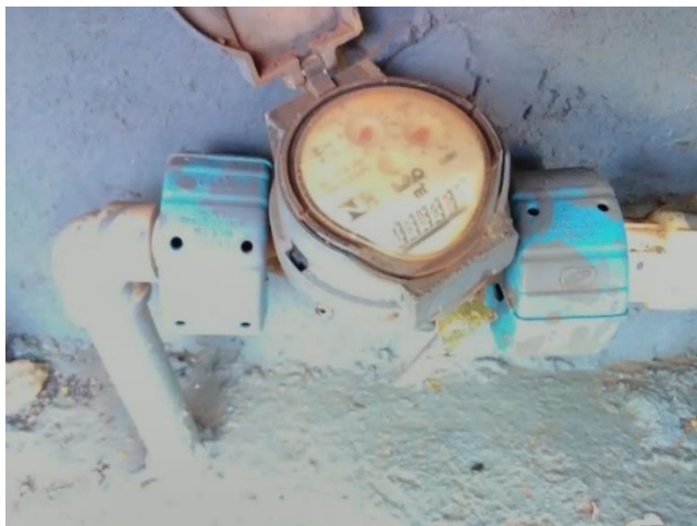
Foto 61 – Hidrômetro Rua José Mendes de Morais nº. 205
