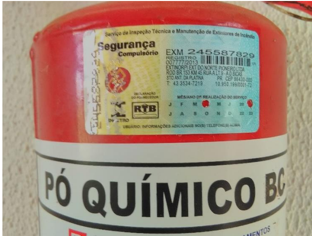
Foto 6 – Extintor na área administrativa
