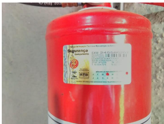
Foto 57 – Extintor da elevatória de água tratada
