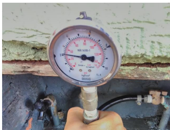
Foto 62 – Medição pressão na rede Hidrômetro Rua José Mendes de Morais nº. 205– P = 30 mca
