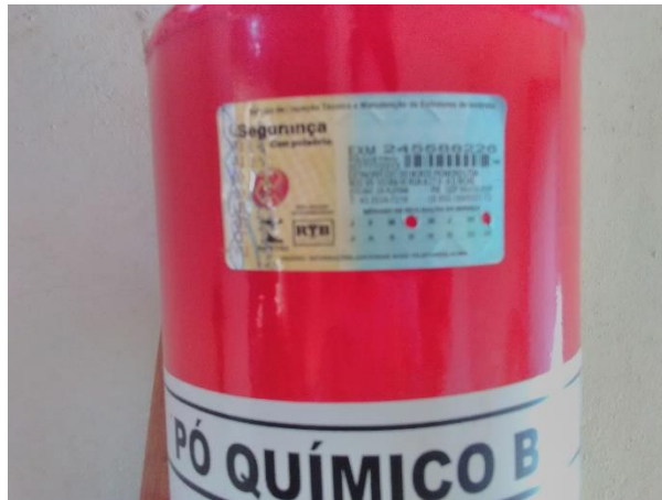
Foto 22 – Validade extintor casa de comando poço 02
