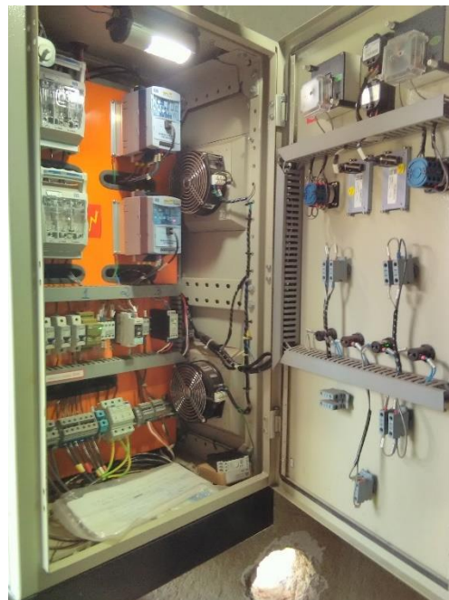
Foto 56 – Quadro de comando da elevatória de água tratada
