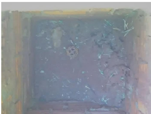
Foto 65 – Registro de ponta de descarga Rua Luiz Inácio Martins, s/n (Quadra 11 – Lote 06)
