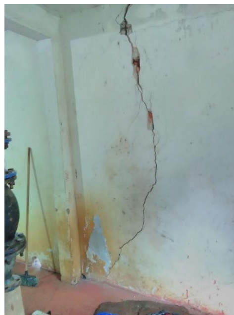
Foto 46 – Trinca na unidade da estação elevatória de água bruta
