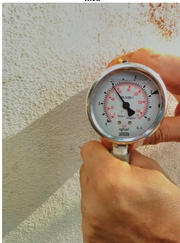
Foto 60 – Medição pressão na rede Rua Luiz Inácio Martins, s/n (Quadra 11 – Lote 06) P=56 mca
