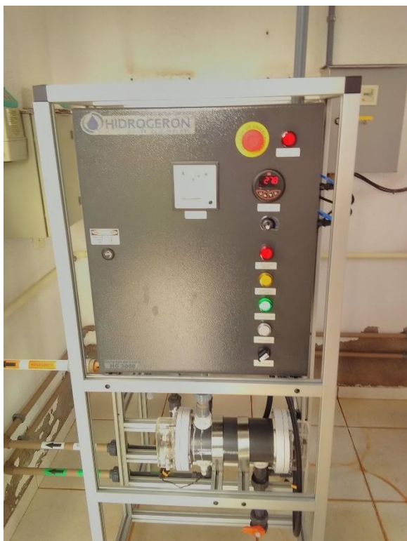
Foto 33 – Frente do quadro de comando da unidade de tratamento
