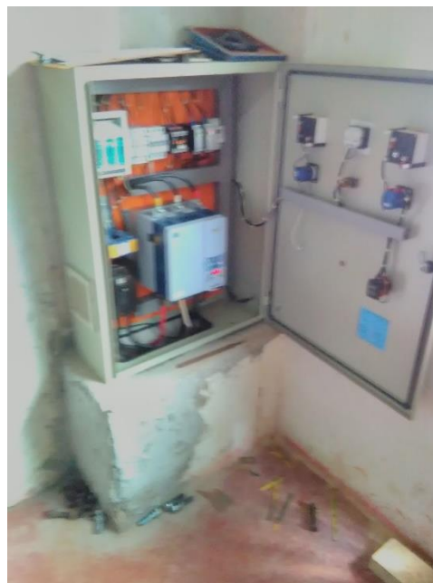
Foto 20 – Quadro de comando poço 02
