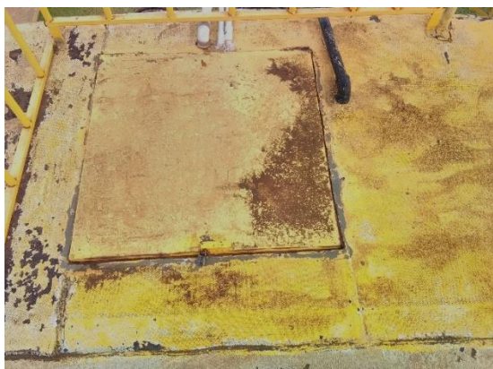
Foto 34 – Abertura de acesso RAP 02
