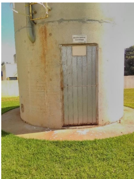
Foto 53 – Identificação da elevatória de água tratada
