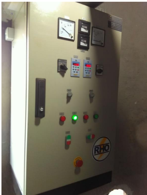
Foto 55 – Frente do quadro de comando da elevatória de água tratada
