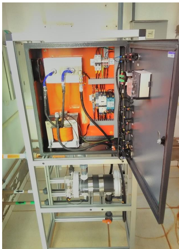
Foto 34 – Quadro de comando da unidade de tratamento
