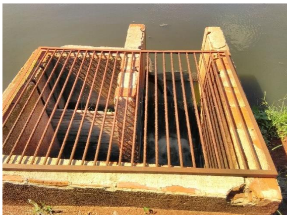
Foto 68 – Saída lagoa anaeróbia 01
