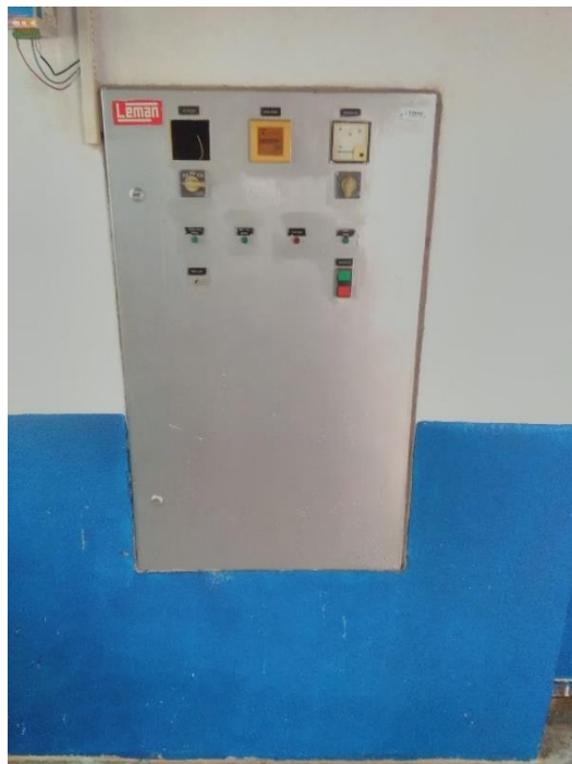
Foto 20 – Frente do quadro de comando poço 01
