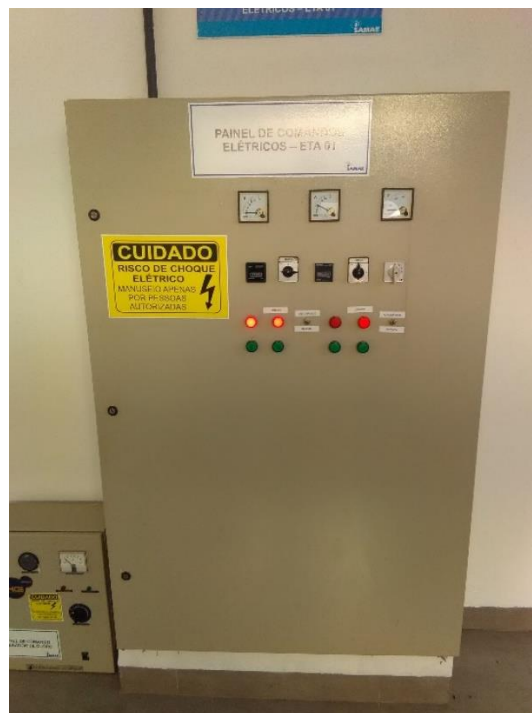
Foto 46 – Frente do quadro de comando elevatória
