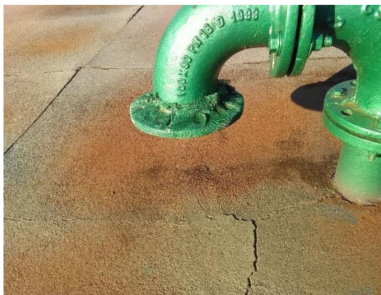
Foto 36 – Respiro reservatório elevado
