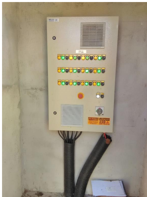
Foto 75 – Frente quadro ETE
