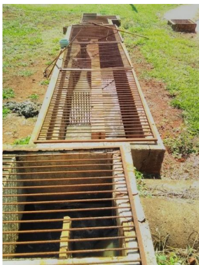
Foto 66 – Calha Parshall (entrada)
