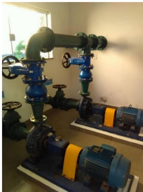
Foto 44 – Conjunto moto bomba elevatória
