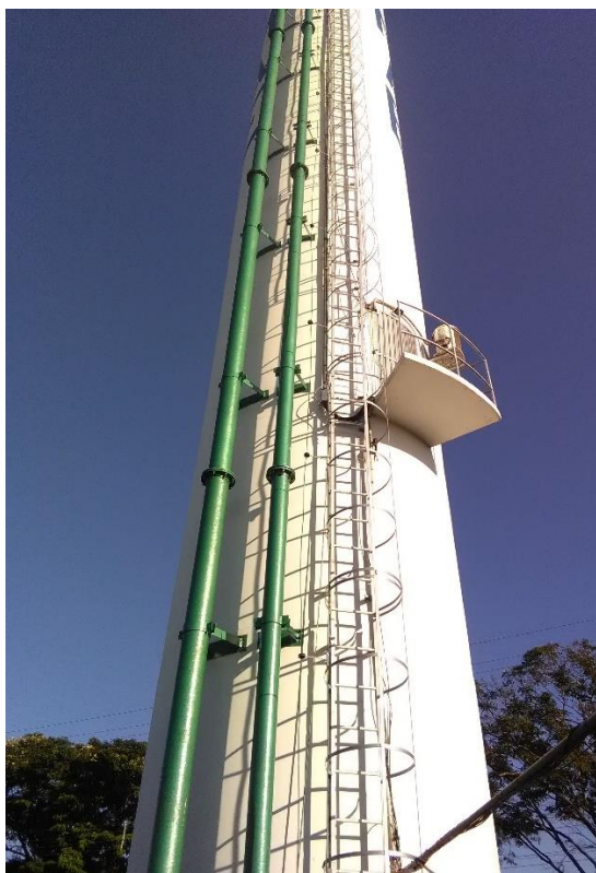
Foto 32 – Depósito e tubulações reservatório elevado
