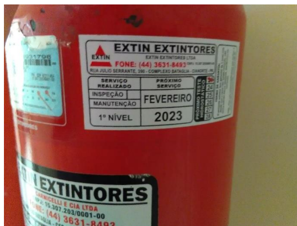
Foto 13 – Extintor no pátio de manutenção
