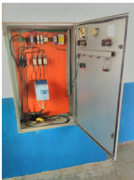
Foto 21 – Quadro de comando poço 01
