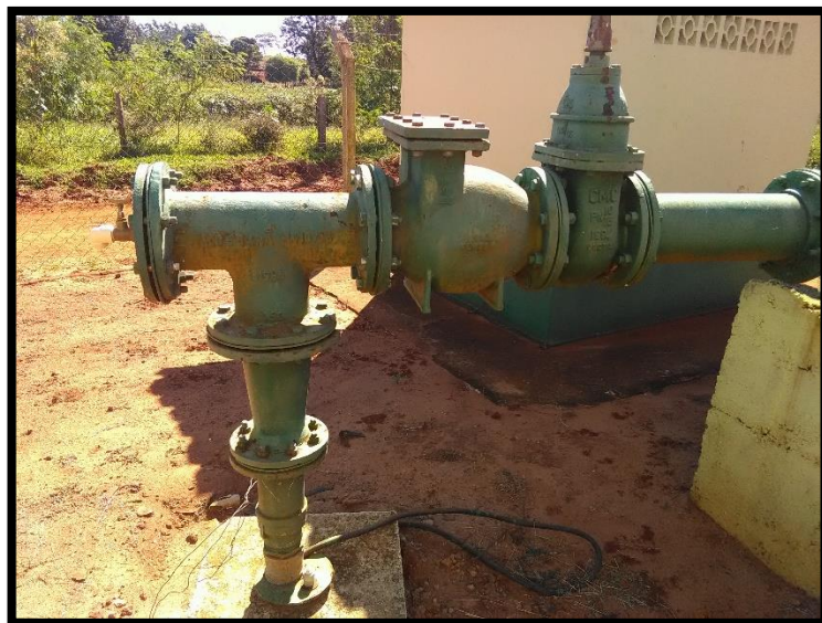
Imagem 5: Poço 01 – instalação hidráulica
