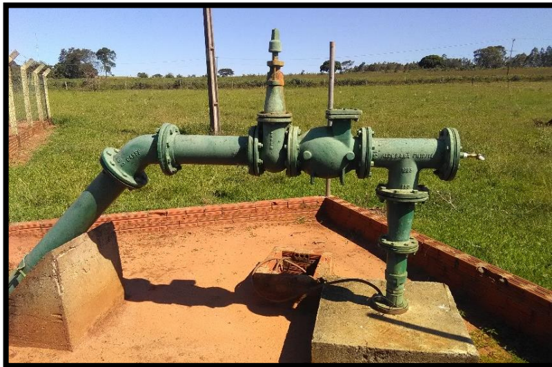
Imagem 7: Poço 02 – instalação hidráulica
