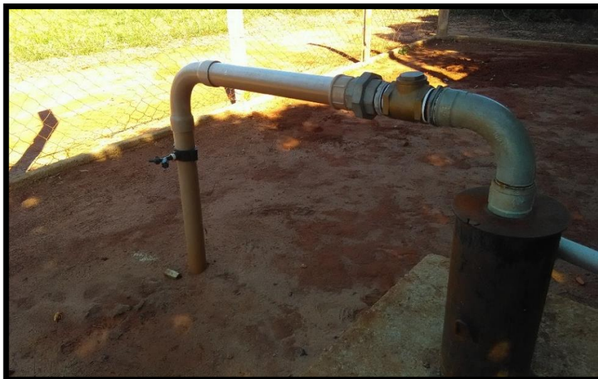
Imagem 14: Poço 09 - instalação hidráulica
