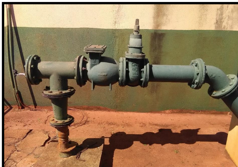
Imagem 8: Poço 03 – Instalação hidráulica
