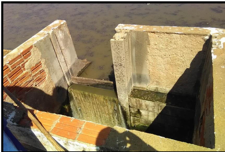
Imagem 32: ETE – Dispositivo de Saída da lagoa facultativa
