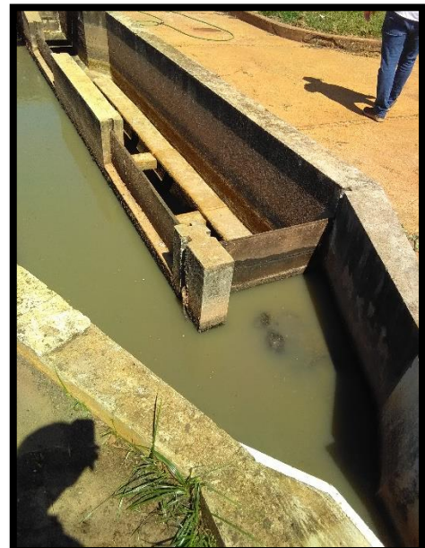
Imagem28: ETE – Caixa de areia
