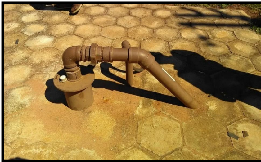
Imagem 13: Poço 08 - instalação hidráulica
