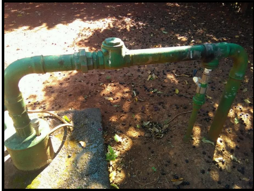
Imagem 12: Poço 07 - instalação hidráulica
