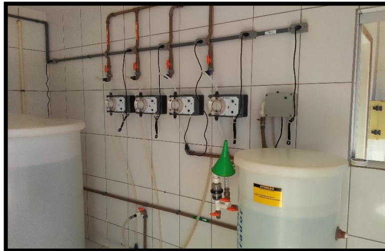
Imagem 15: Estação de tratamento simplificado – Dosadoras e reservatórios de cloro e flúor
