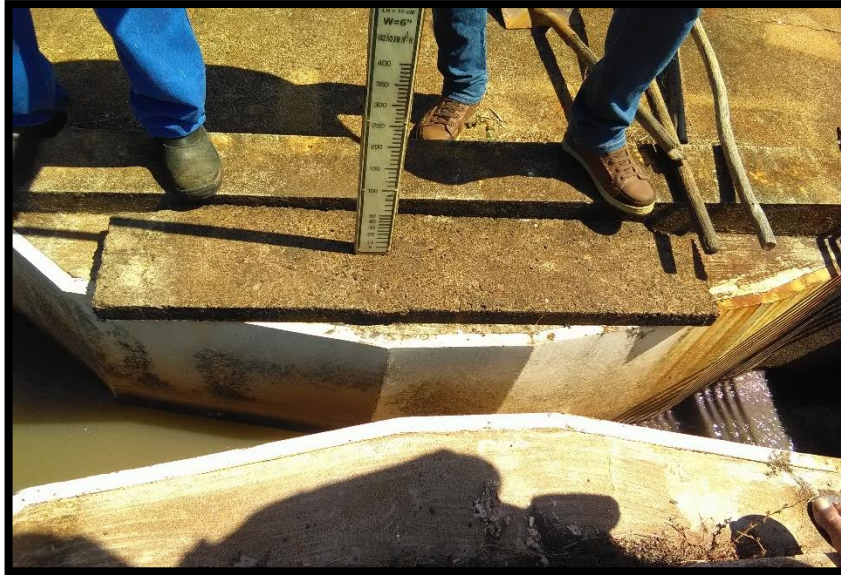
Imagem 29: ETE – Calha Parshall
