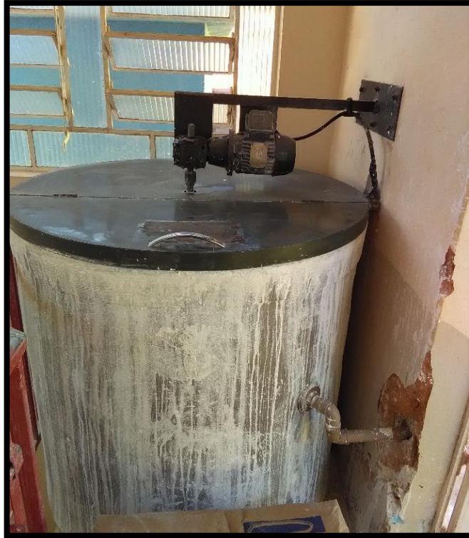
Imagem 17: Estação de tratamento Simplificado – reservatório de solução de cal
