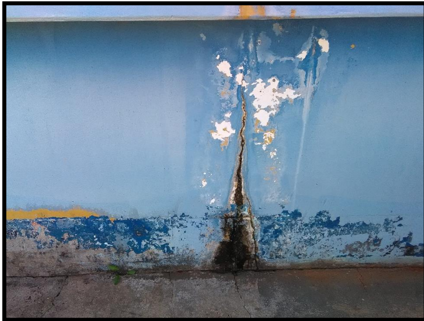
Imagem 23: RSE 02 – indicio de fim de vida útil de impermeabilização interna
