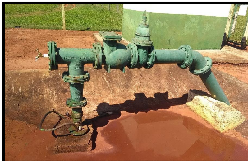
Imagem 11: Poço 04 - instalação hidráulica
