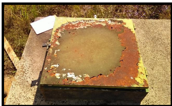
Imagem 24: Reservatório semienterrado – Sede
