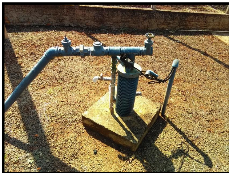
Imagem 11: Poço VIII – Bairro Caratua
