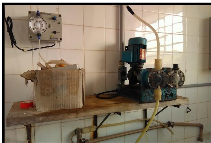
Imagem 15: Sede – bomba dosadora de flúor
