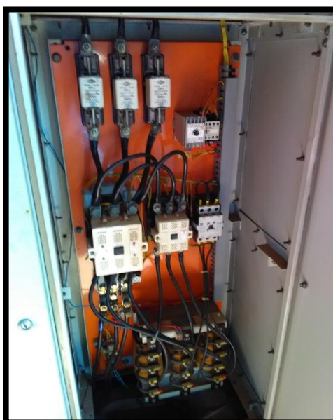
Imagem 39: Quadro de comando – Bombas Reservatório semienterrado
