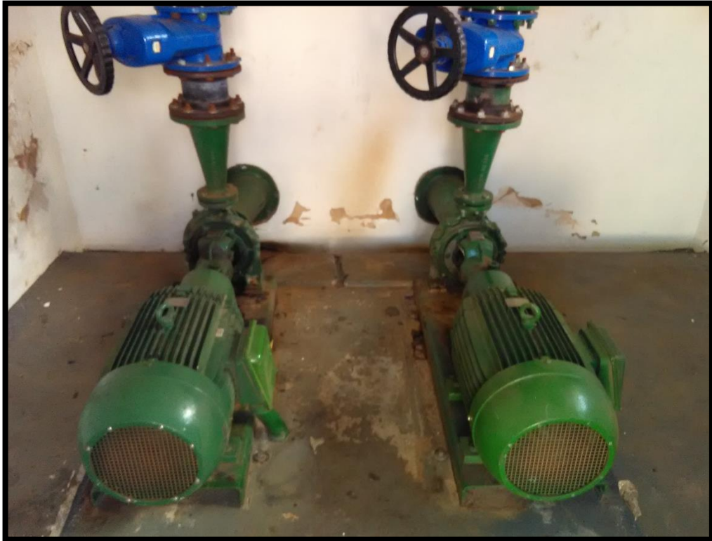
Imagem 36: Conjunto motobombas – Sede
