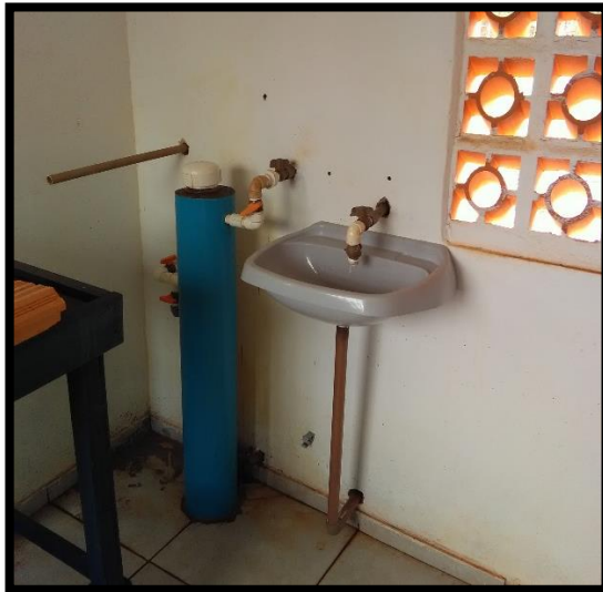
Imagem 20: Assentamento Paulo Freire – Clorador
