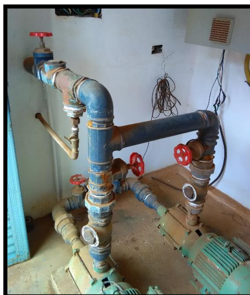
Imagem 40: Conjunto motobombas – distrito Terra nova
