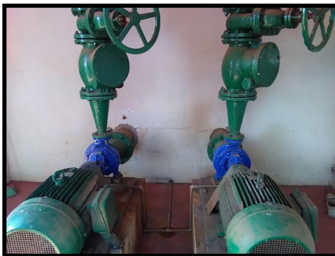
Imagem 38: Conjunto motobombas – Reservatório semienterrado
