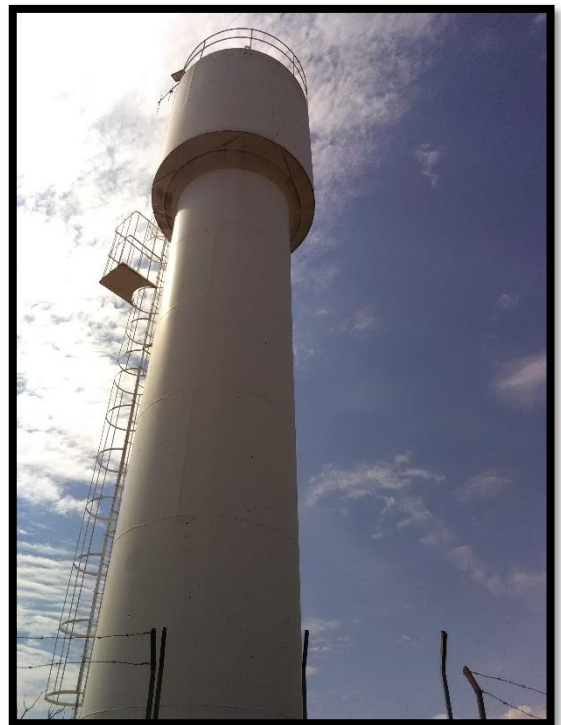
Imagem 33: Reservatório elevado – Bairro Caratua
