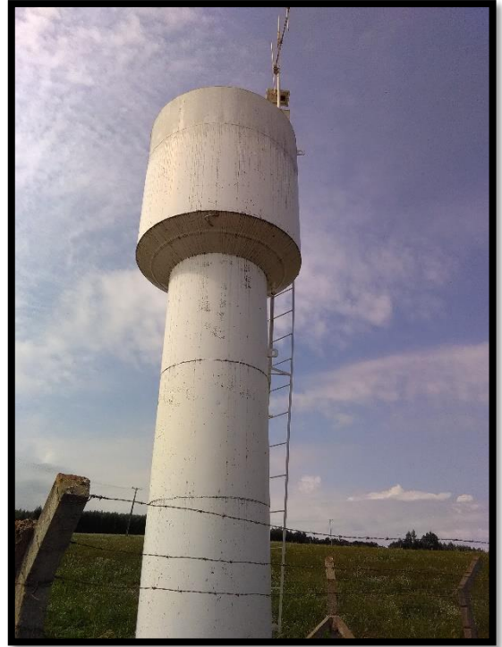
Imagem 35: Reservatório elevado – Assentamento Paulo Freire 2
