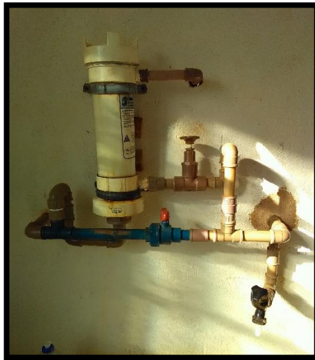
Imagem 17: Distrito São João do Pinhal – Clorador
