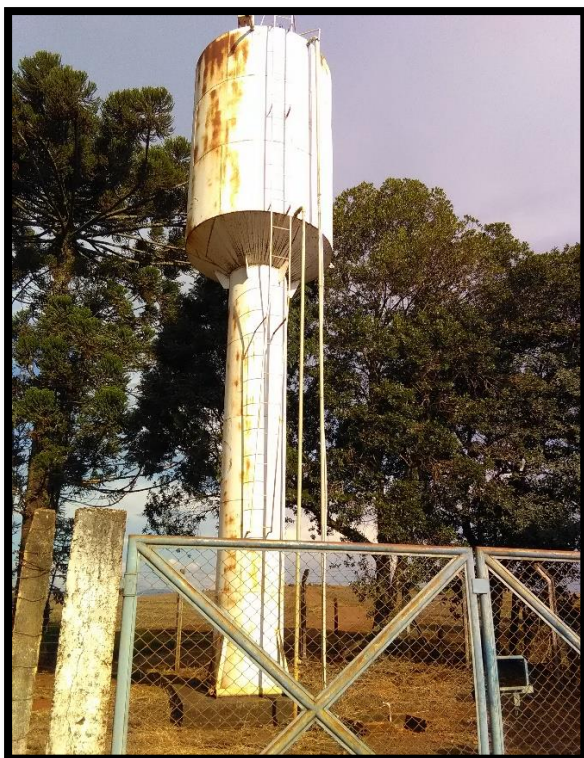
Imagem 26: Reservatório elevado – Vila Rural
