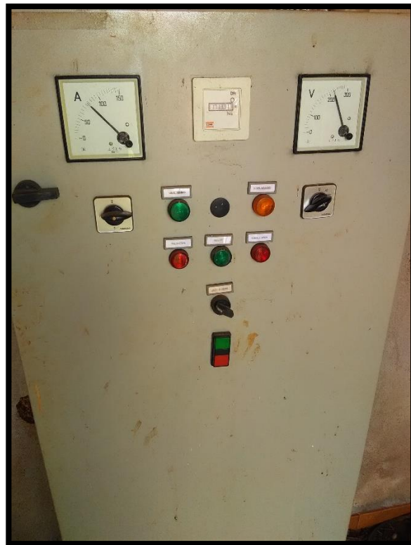
Imagem 6: Quadro de comando do Poço
