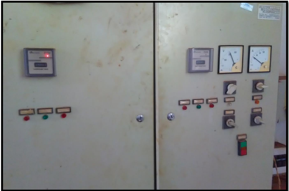
Imagem 17: Estação Elevatória 01 (EAT 01) – quadro de comando
