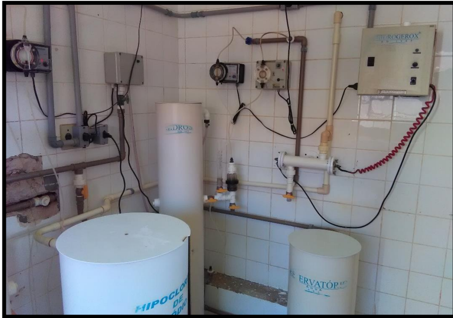
Imagem 7: Estação de tratamento simplificado – Dosadoras e reservatórios
