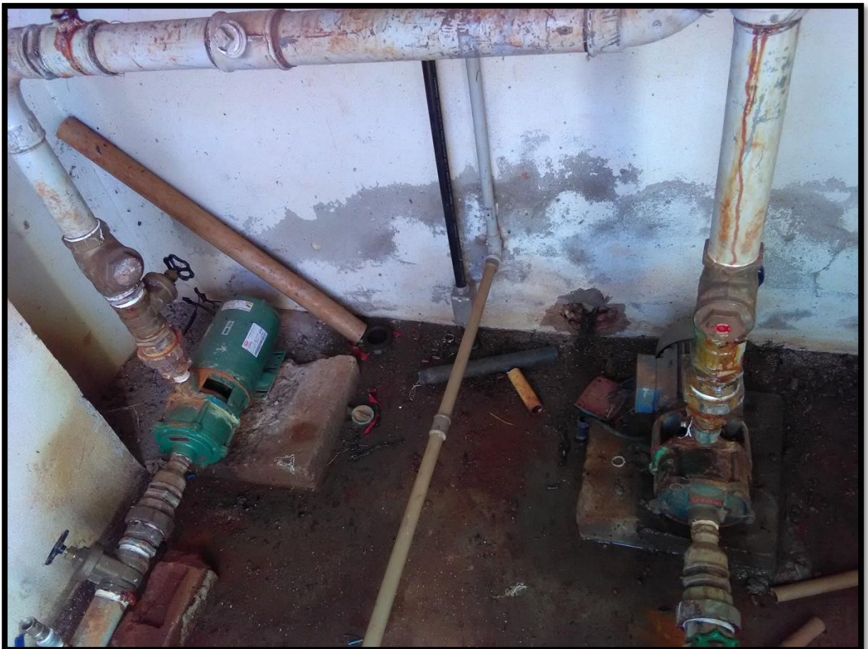
Imagem 18: Estação Elevatória 02 (EAT 02)
