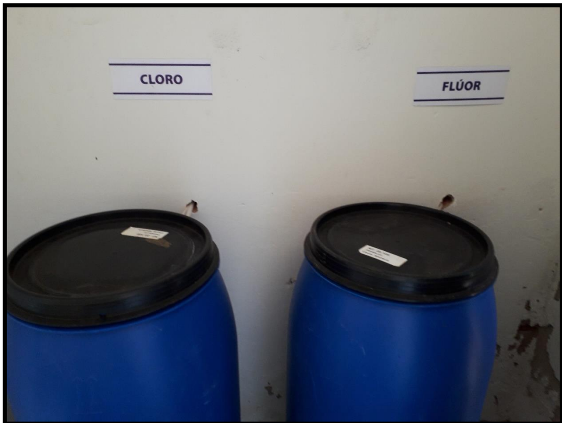
Imagem 27: Tanques de dosagem do distrito Copacabana
