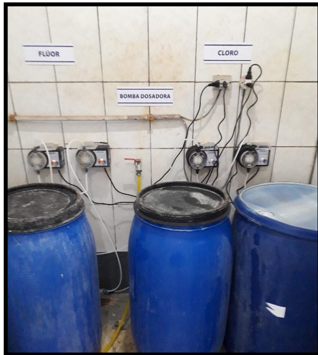
Imagem 24: Sistema de dosagem de cloro e flúor do reservatório enterrado
