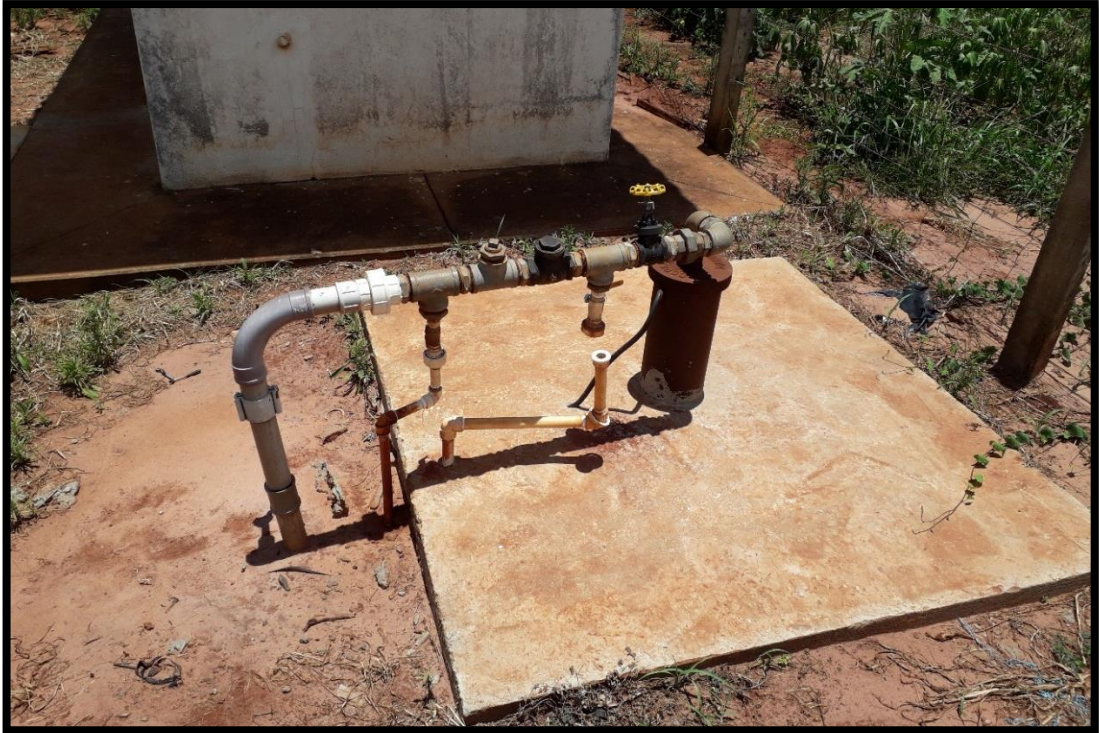
Imagem 15: Poço do distrito Km 14
