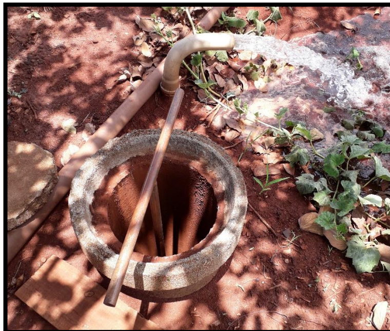
Imagem 28: Registro de descarga aberto
