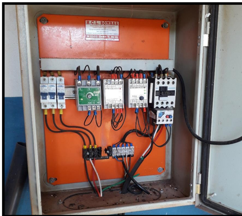
Imagem 8: Quadro de comando Poço 01
