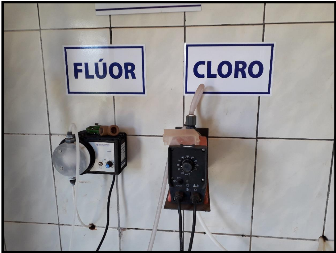
Imagem 26: Sistema de dosagem do distrito Copacabana
