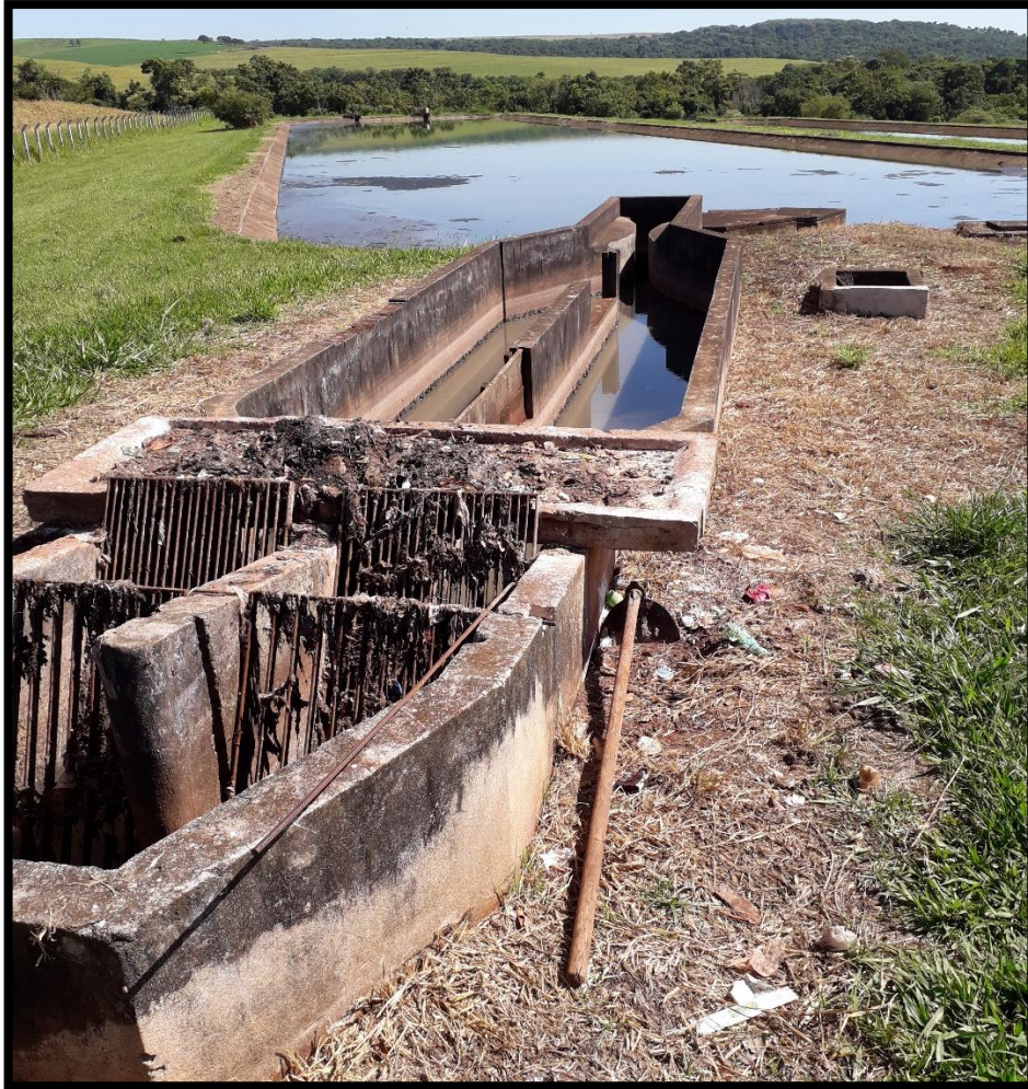
Imagem 30: ETE - Gradeamento e caixa de areia
