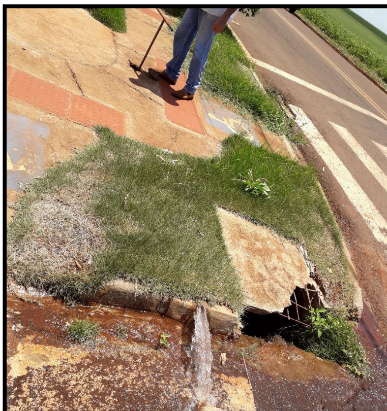
Imagem 29: Registro de descarga aberto
