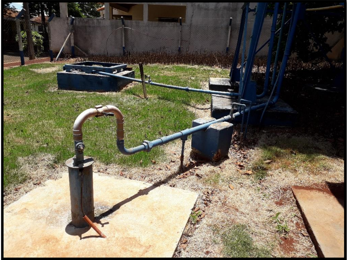
Imagem 13: Poço do distrito Copacabana
