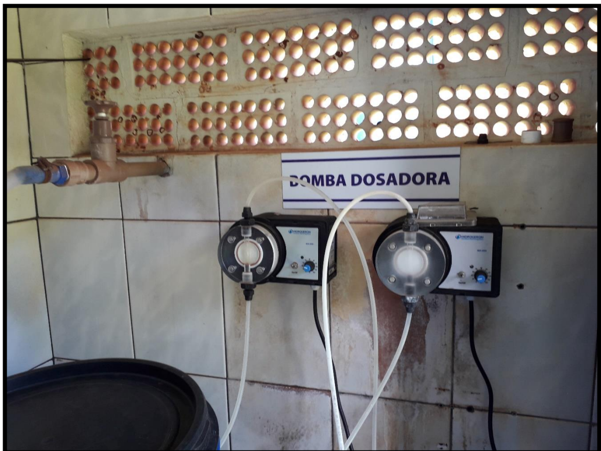
Imagem 30: Sistema de dosagem do distrito Km 14
