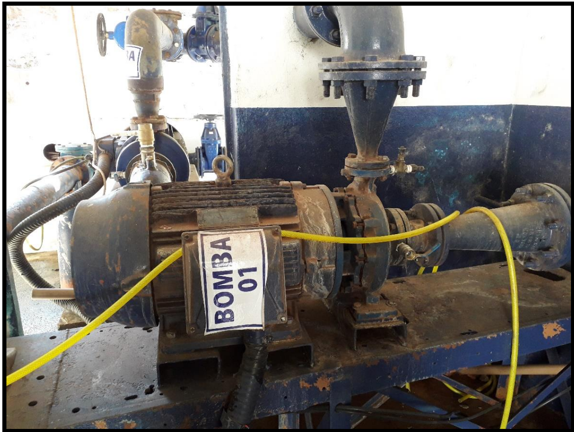
Imagem 12: Estação elevatória do Reservatório enterrado ao lado da mina
