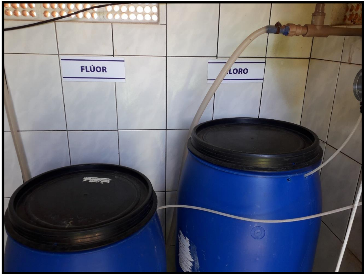
Imagem 29: Tanques de dosagem do distrito Km 14
