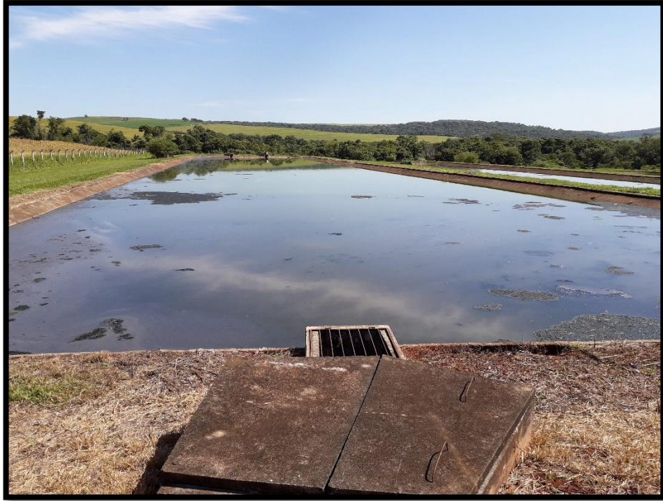
Imagem 32: ETE - Lagoa anaeróbia
