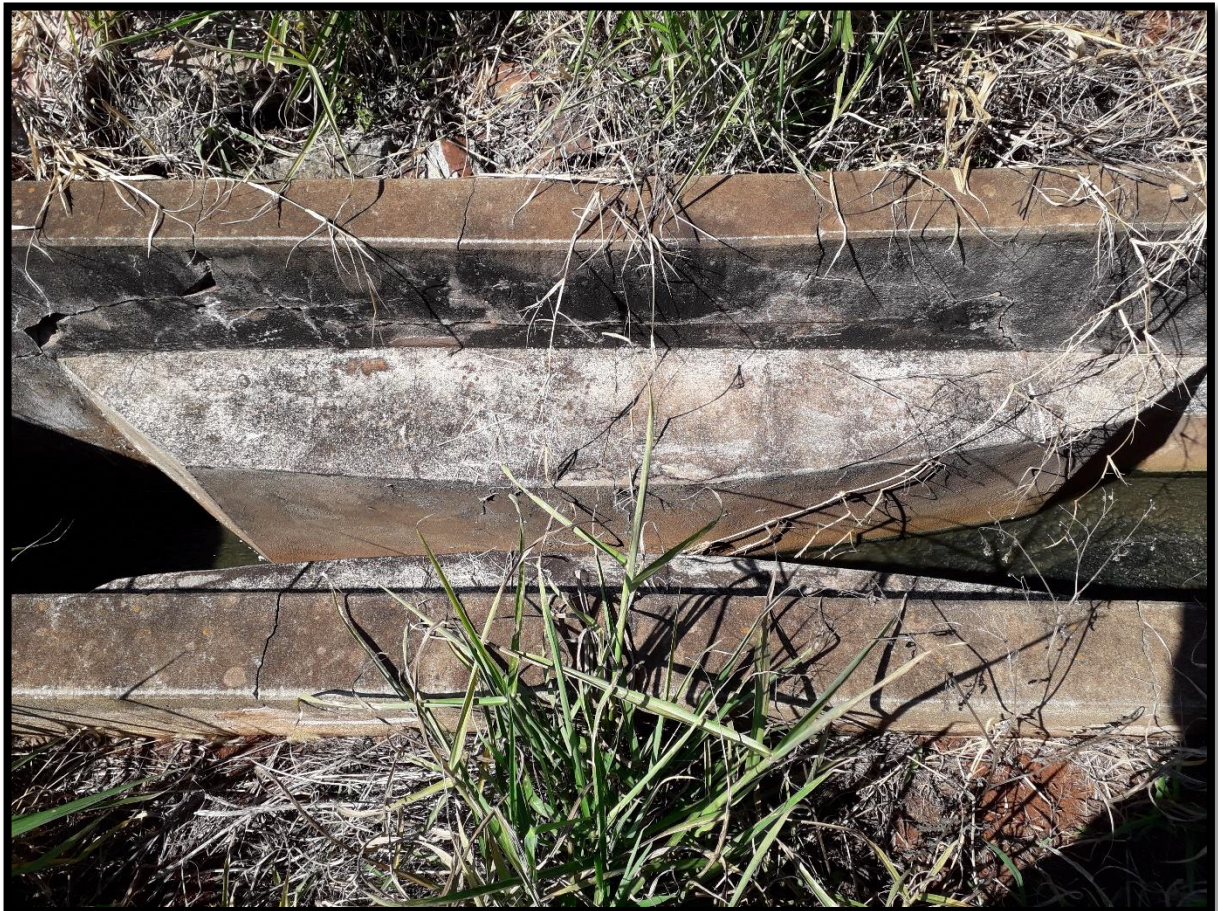
Imagem 35: ETE – Calha parshall de saída em concreto
