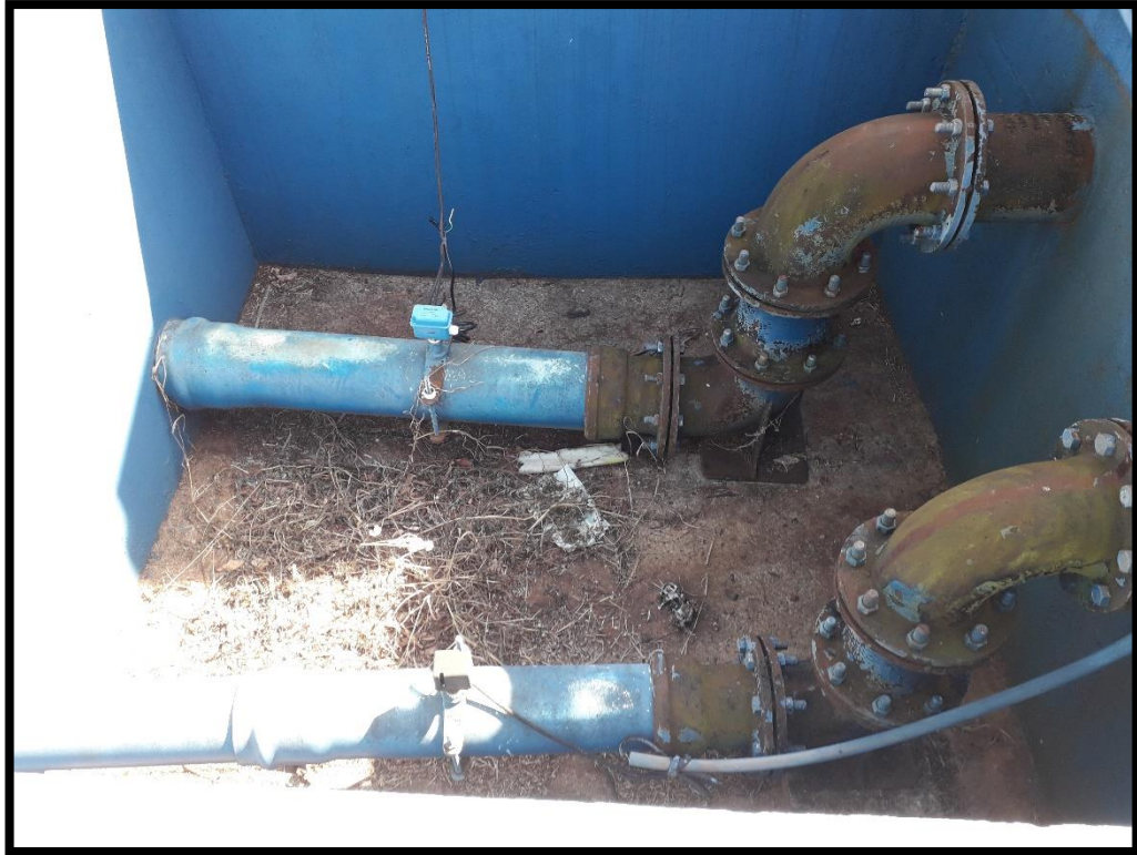
Imagem 18: Adutoras na entrada do reservatório enterrado de 650m 3
