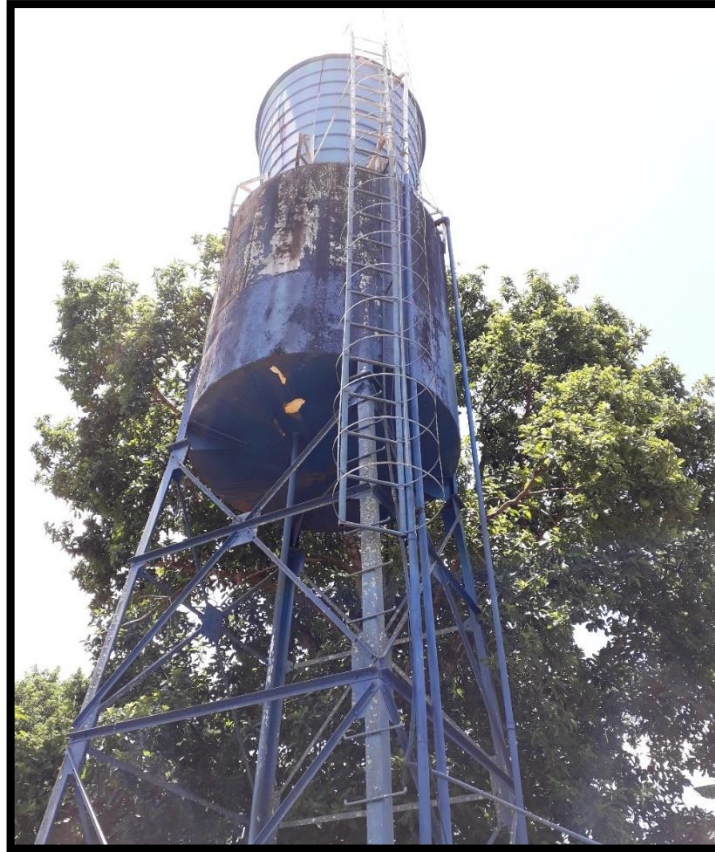
Imagem 22: Reservatório elevado de 10m 3 do distrito Copacabana
