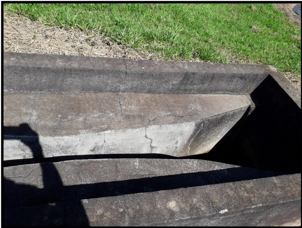
Imagem 31: ETE - Calha parshall de entrada em concreto
