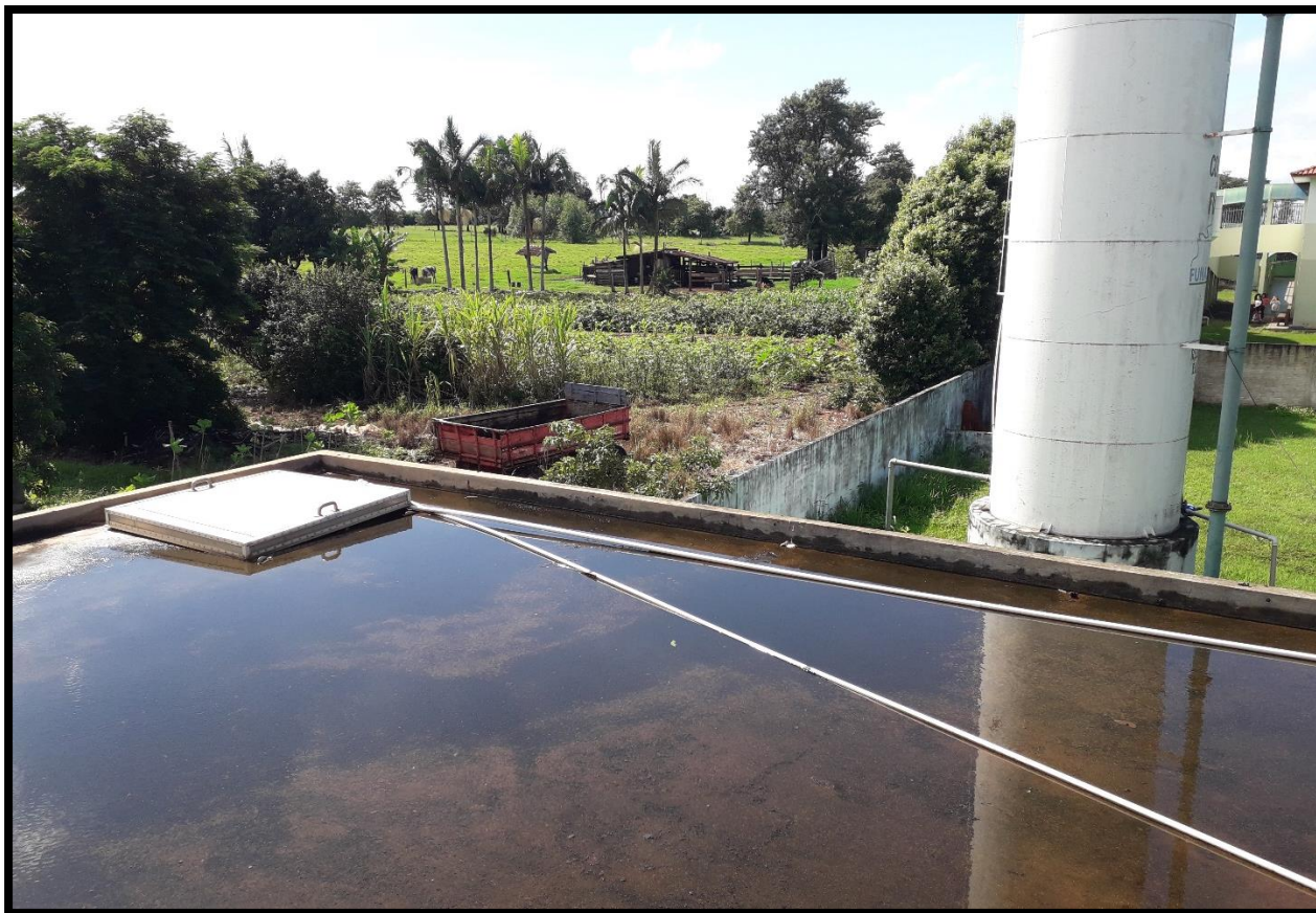
Imagem 30: Reservatório apoiado – laje acumulando água pluvial
