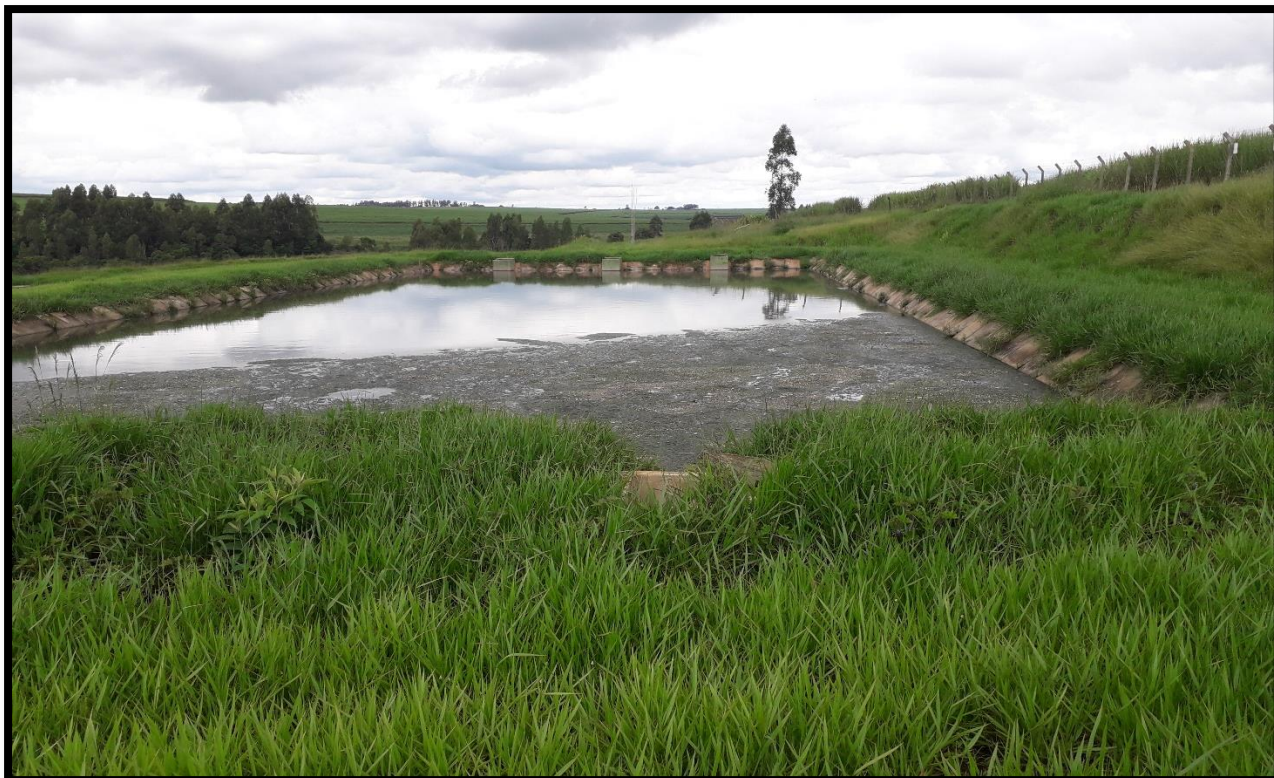
Imagem 47: ETE – lagoa anaeróbia
