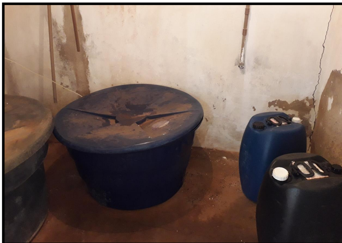
Imagem 23: Estação de tratamento do sistema Horizonte – Reservatórios e recipientes de produtos químicos
