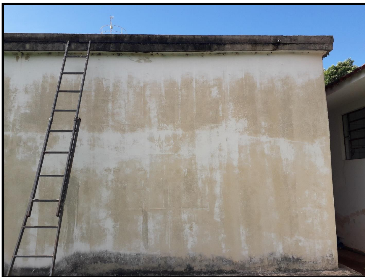
Imagem 29: Reservatório apoiado – sistema sede
