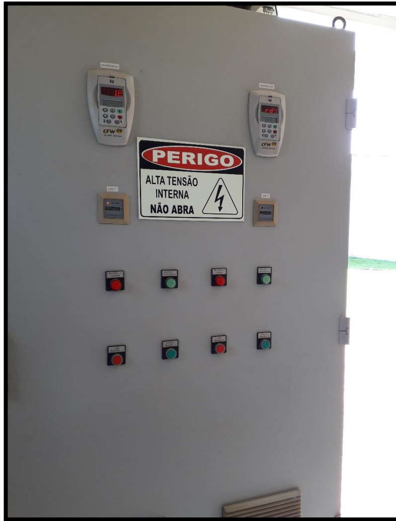
Imagem 44: EAT – 002 – Quadro de comando
