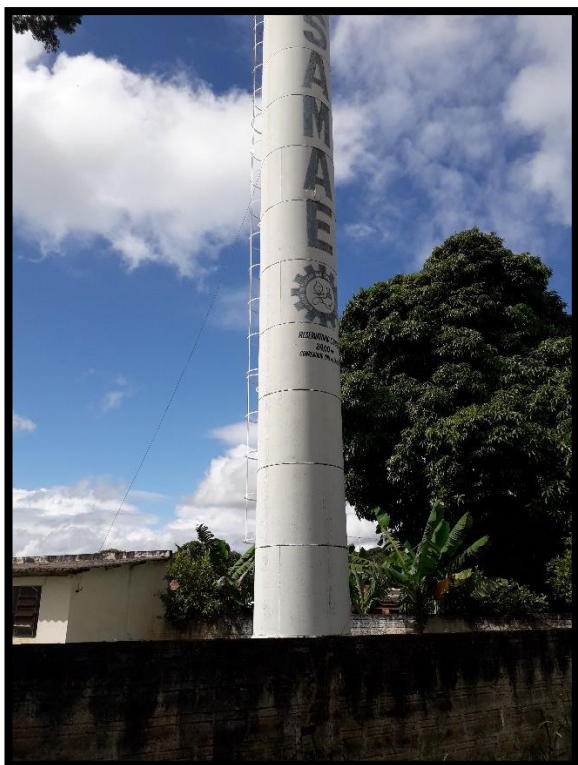
Imagem 33: Reservatório elevado – sistema Horizonte
