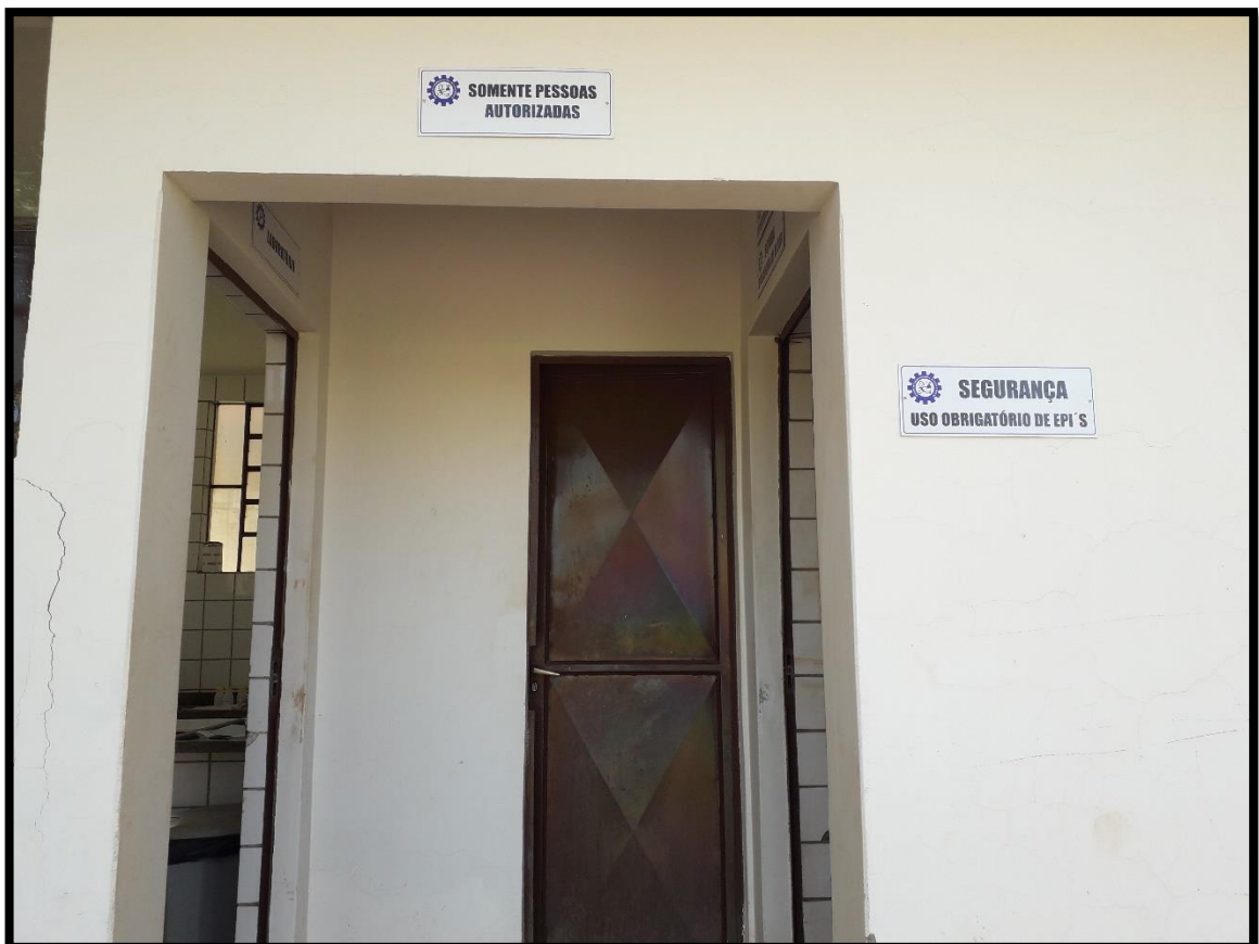
Imagem 21: Estação de tratamento junto a área comercial – entrada com placas de identificação e restrição
