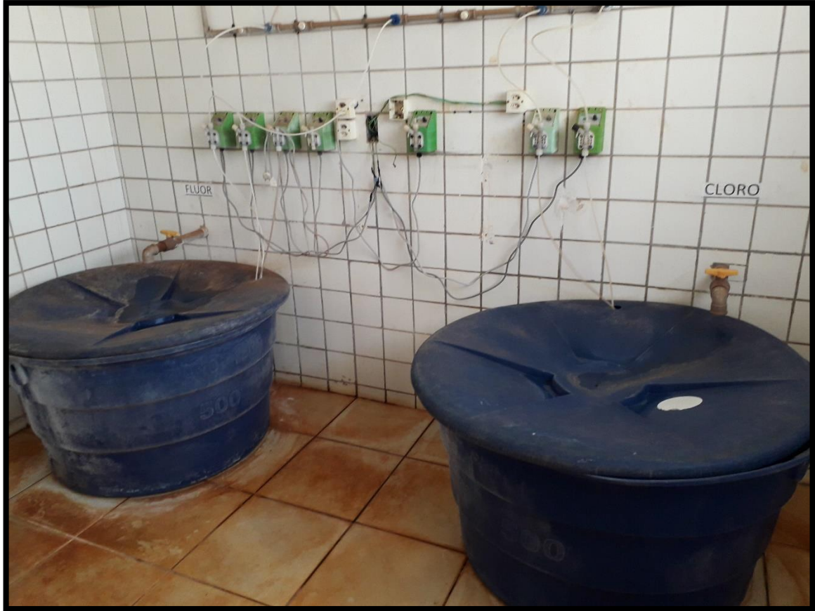
Imagem 20: Estação de tratamento junto a área comercial – Bombas dosadoras e reservatórios
