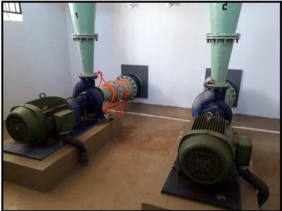
Imagem 43: EAT – 002 – Conjunto motobombas
