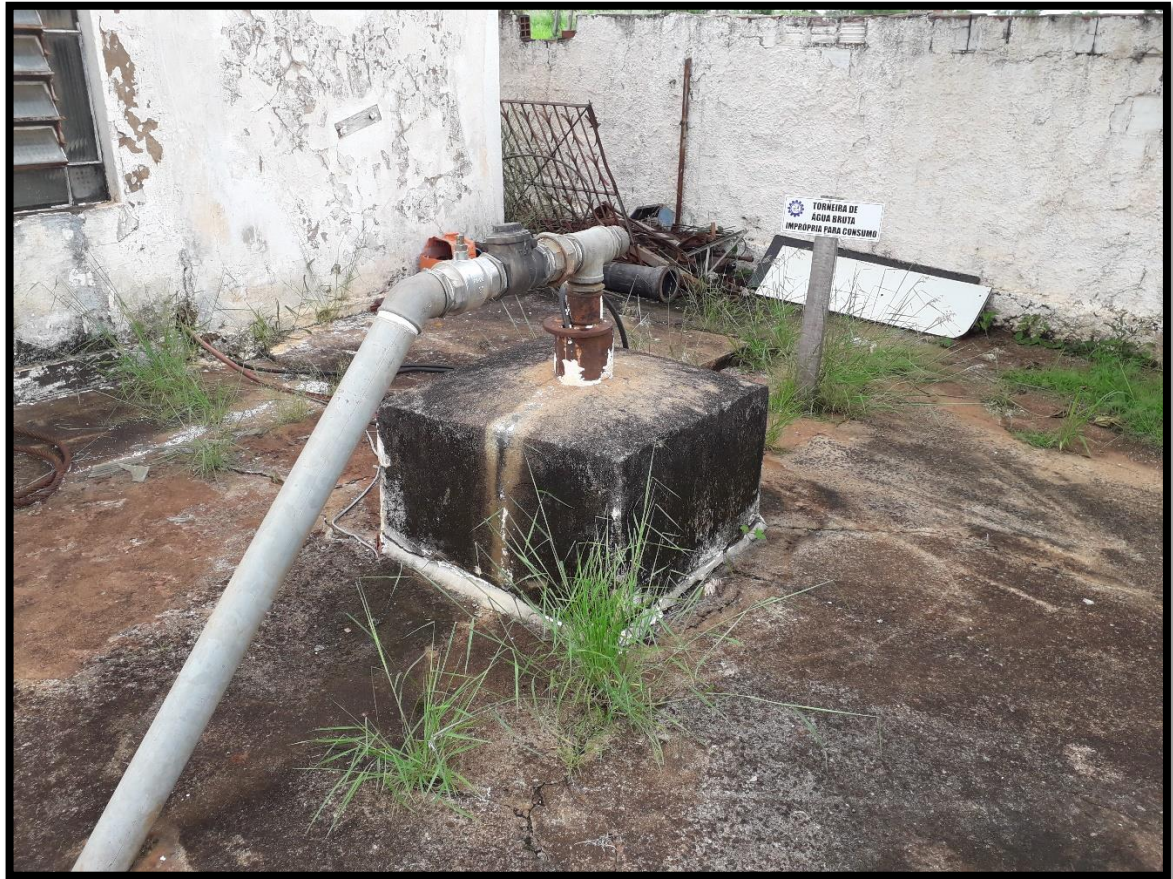
Imagem 9: Poço Caixa Velha – Instalação hidráulica
