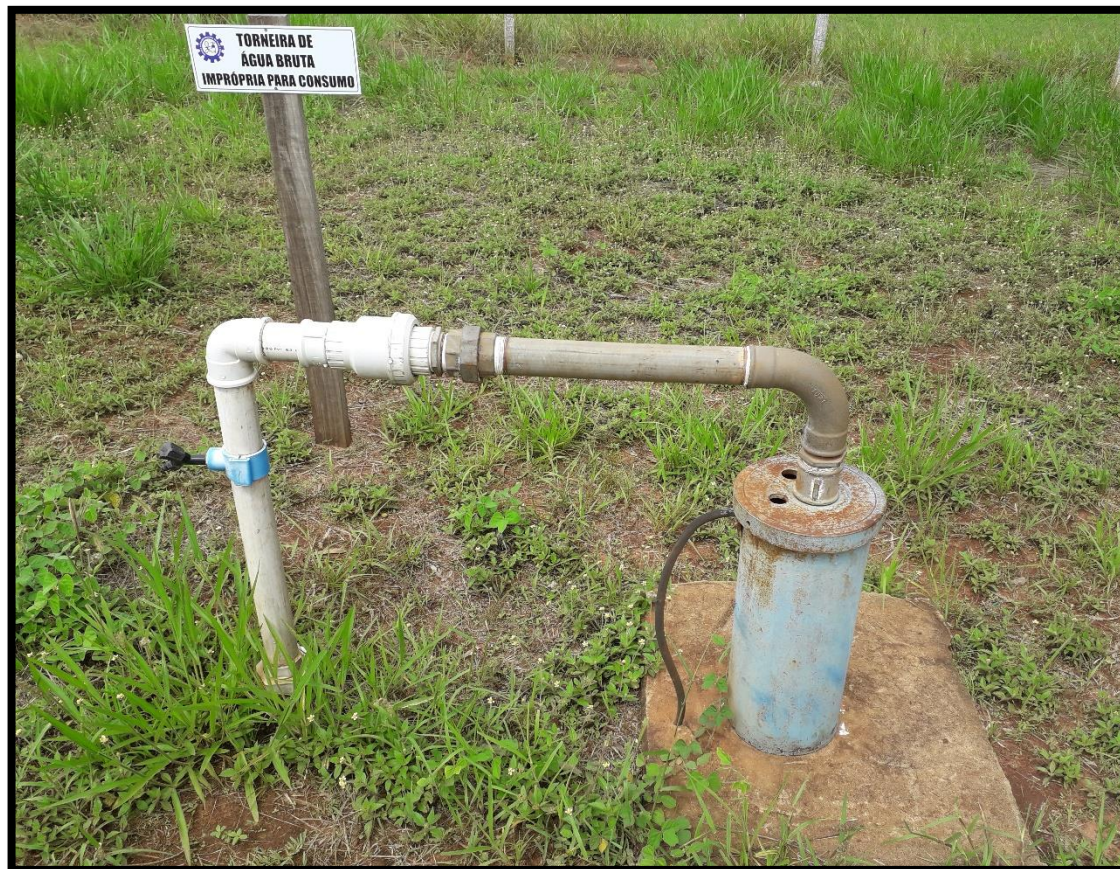
Imagem 17: Poço de captação do Sistema de abastecimento Vila Rural Avanci
