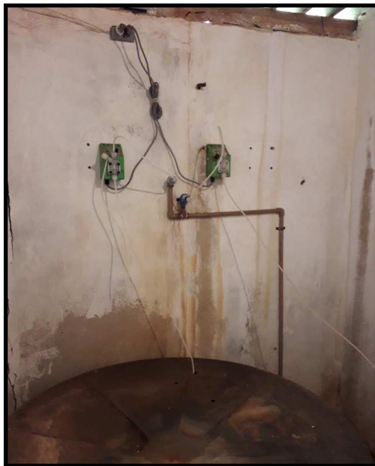
Imagem 22: Estação de tratamento do sistema Horizonte – bombas dosadoras e reservatório
