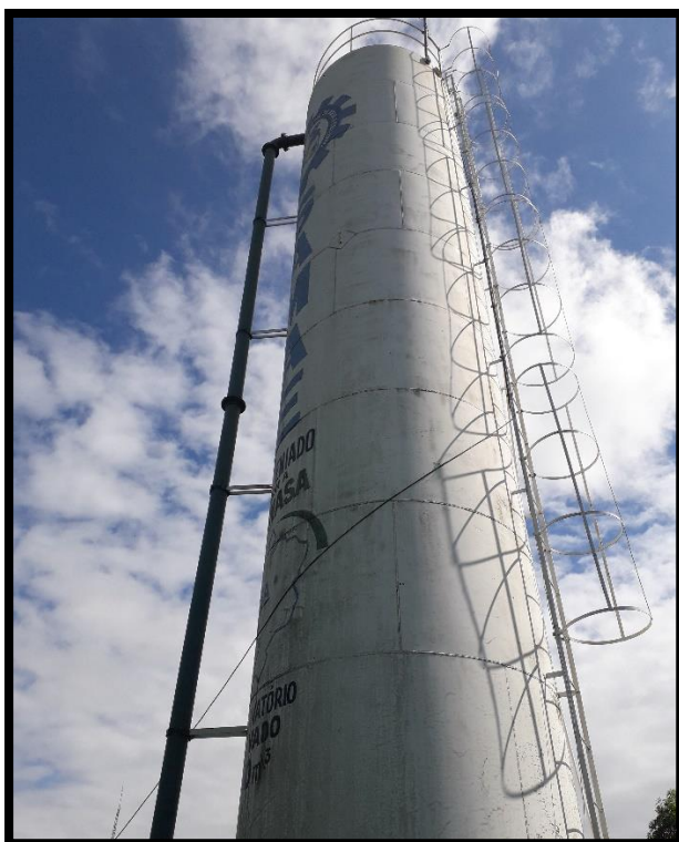
Imagem 31: Reservatório elevado – sistema sede
