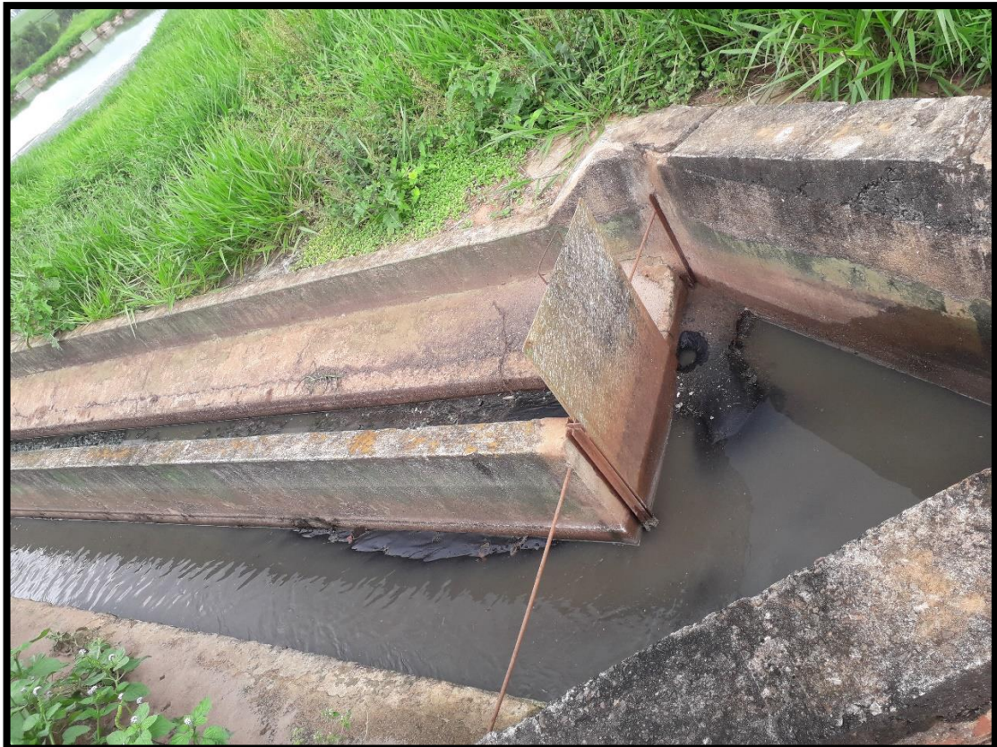
Imagem 46: ETE – Caixa de areia
