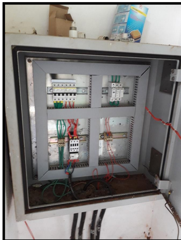
Imagem 16: Quadro de comando do Sistema de abastecimento Vila Rural Avanci
