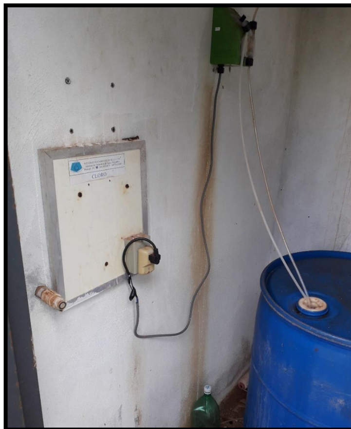
Imagem 26: Estação de tratamento da vila Silvio Faccin – Reservatório de cloro e bomba dosadora
