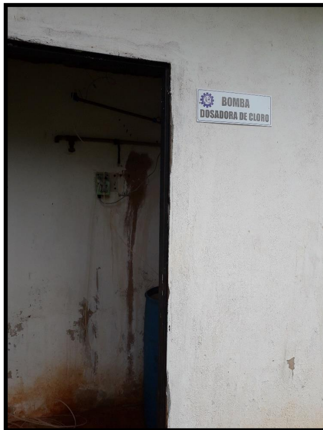
Imagem 25: Estação de tratamento da vila Avanci – Placa de identificação
