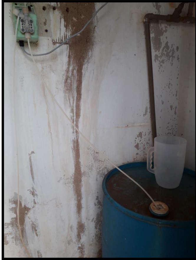
Imagem 24: Estação de tratamento da vila Avanci – Reservatório de cloro e bomba dosadora
