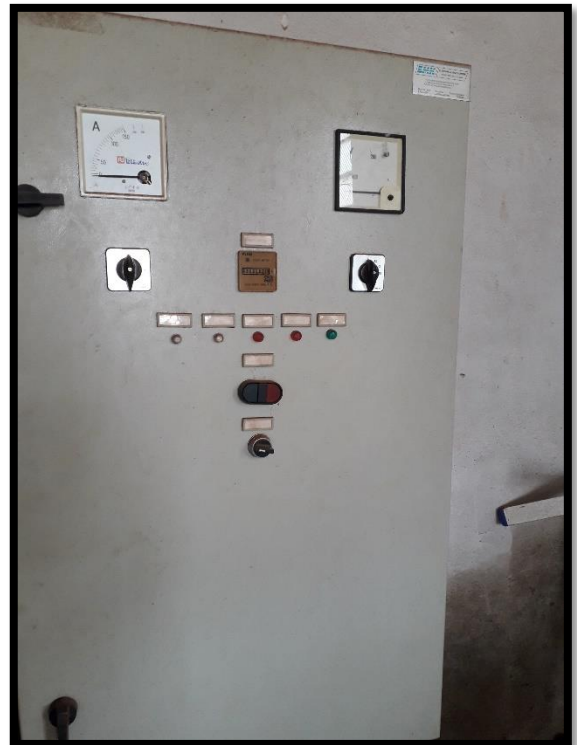
Imagem 11: Poço Caixa Velha – Quadro de comando
