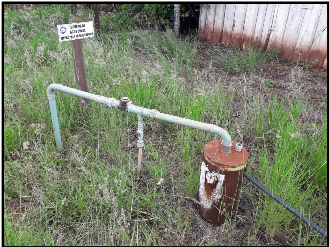
Imagem 19: Poço de captação do Sistema de abastecimento Vila Silvio Faccin
