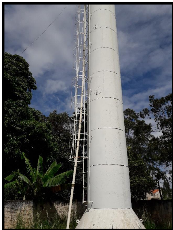
Imagem 34: Reservatório elevado – sistema Horizonte
