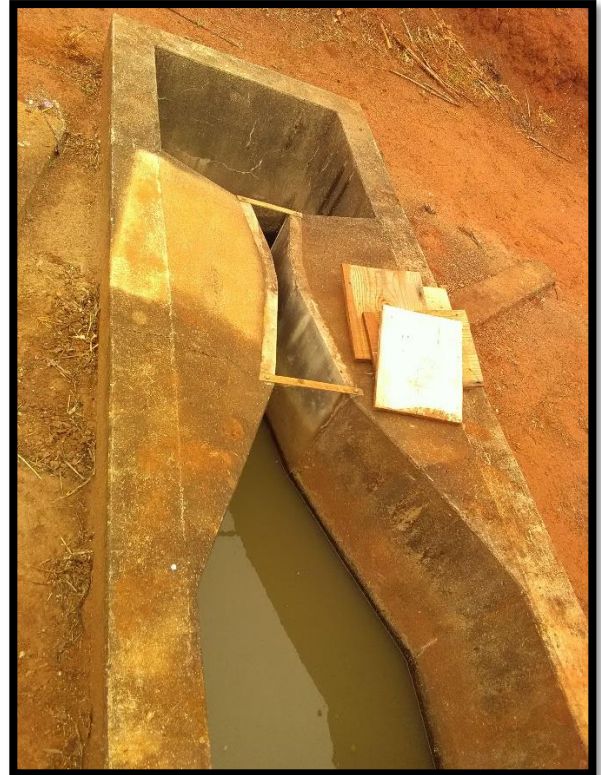
Imagem 22: Medidor de vazão de entrada
