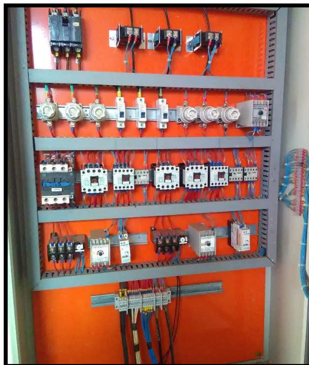
Imagem 17: Quadro de Comando da Estação Elevatória
