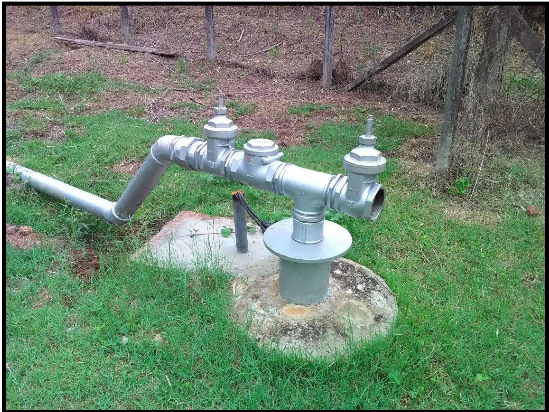
Imagem 7: Poço da fazenda Água do fuga
