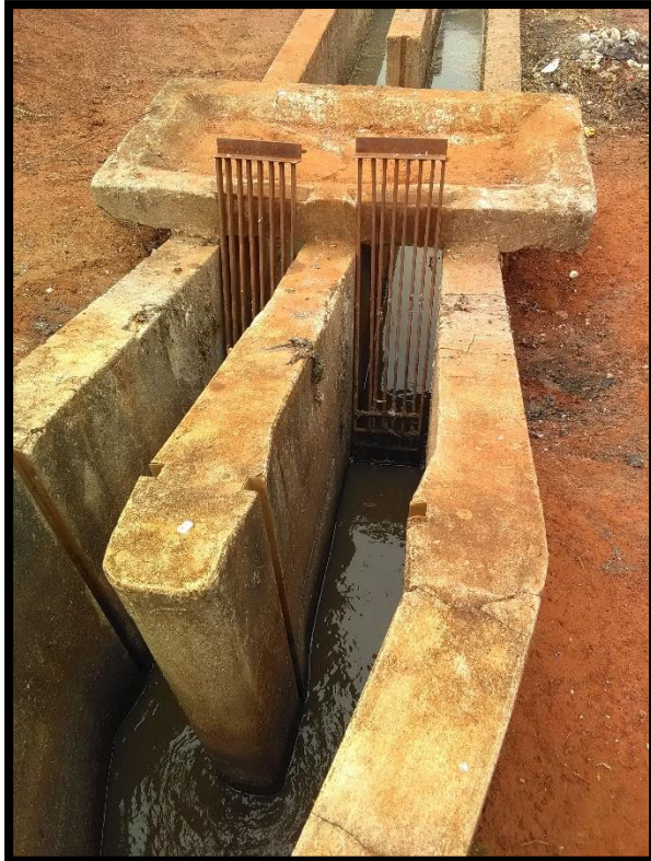
Imagem 21: Gradeamento e Caixa de areia
