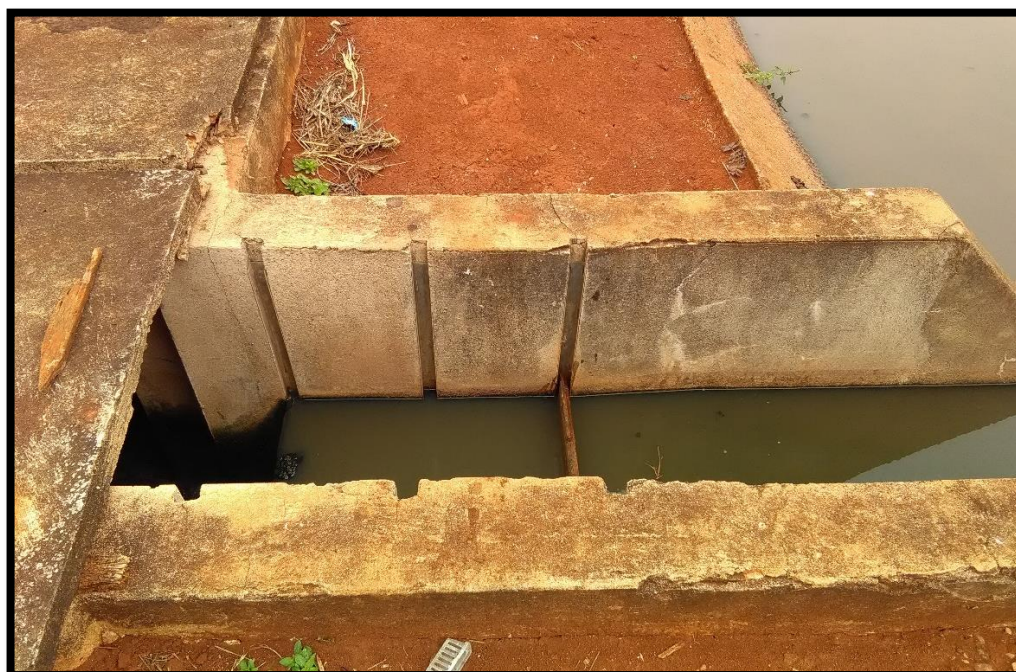
Imagem 25: Dispositivo de saída da lagoa facultativa
