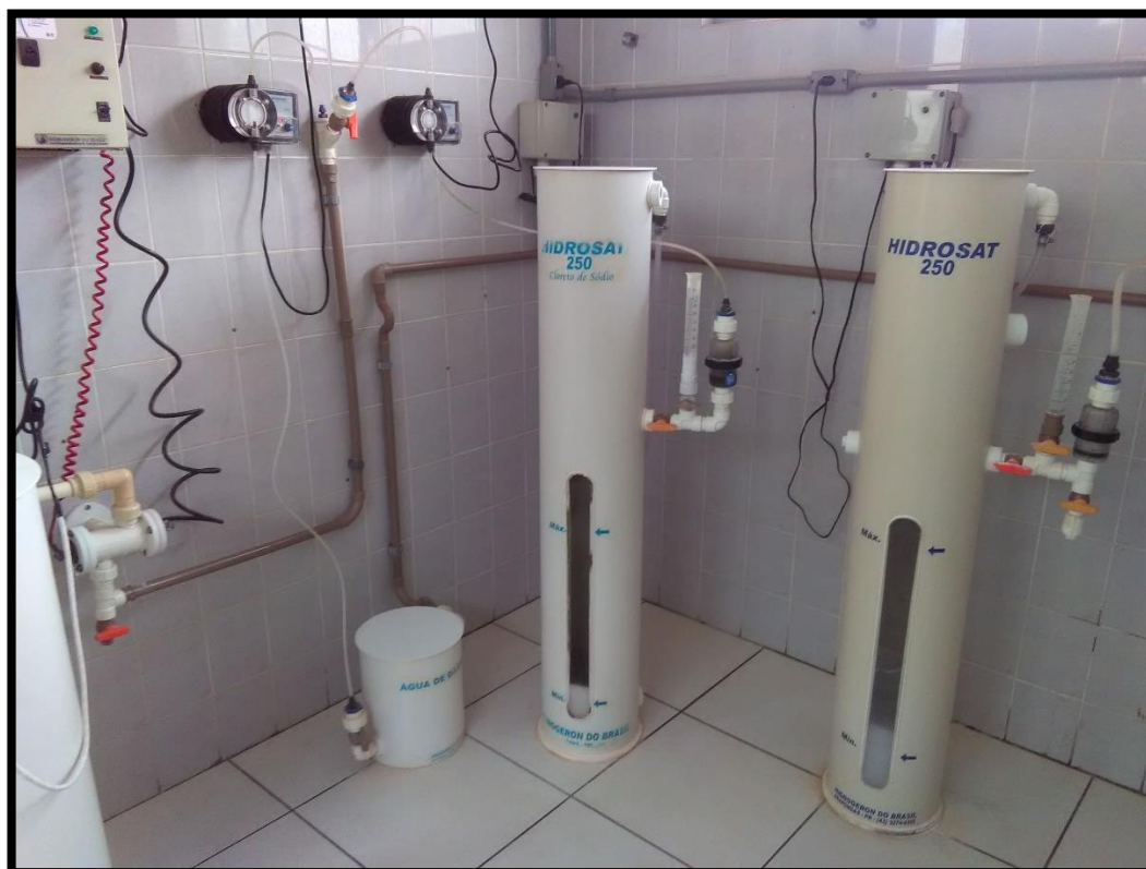
Imagem 9: Unidade de tratamento de água
