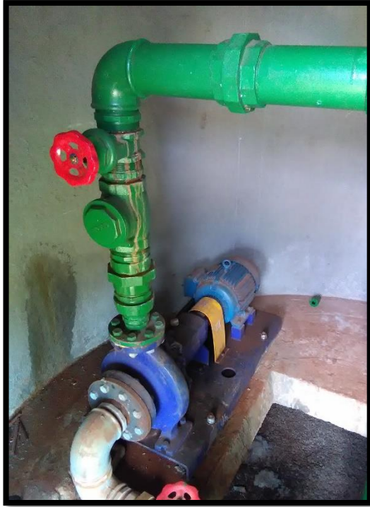
Imagem 14: EAB – conjunto moto-bombas
