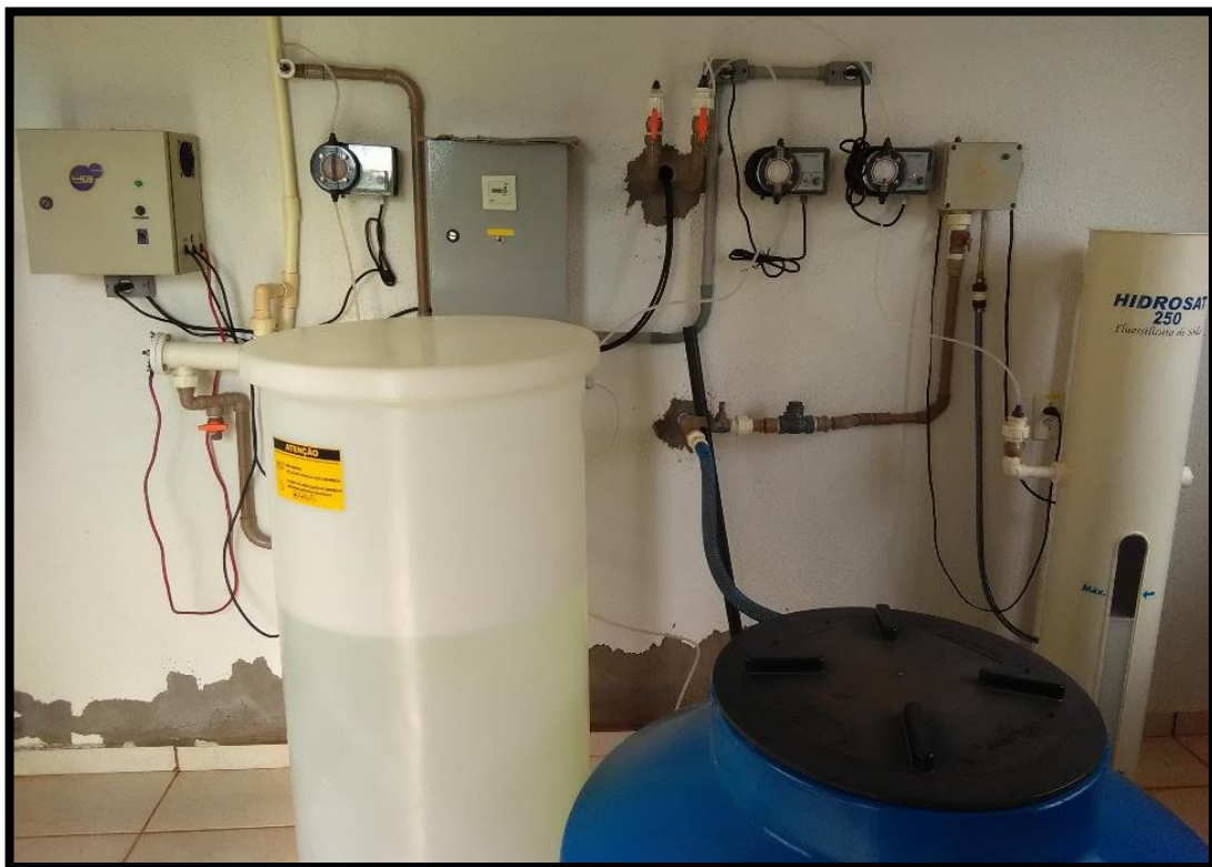
Imagem 5: Estação de tratamento simplificado – bombas dosadoras e reservatórios
