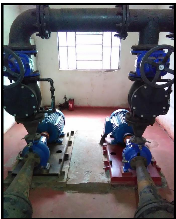
Imagem 14: EAB – conjunto moto-bombas
