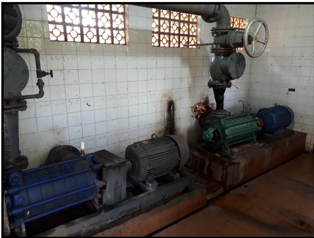
Imagem 13: Estação elevatória junto ao reservatório enterrado – conjuntos motobombas
