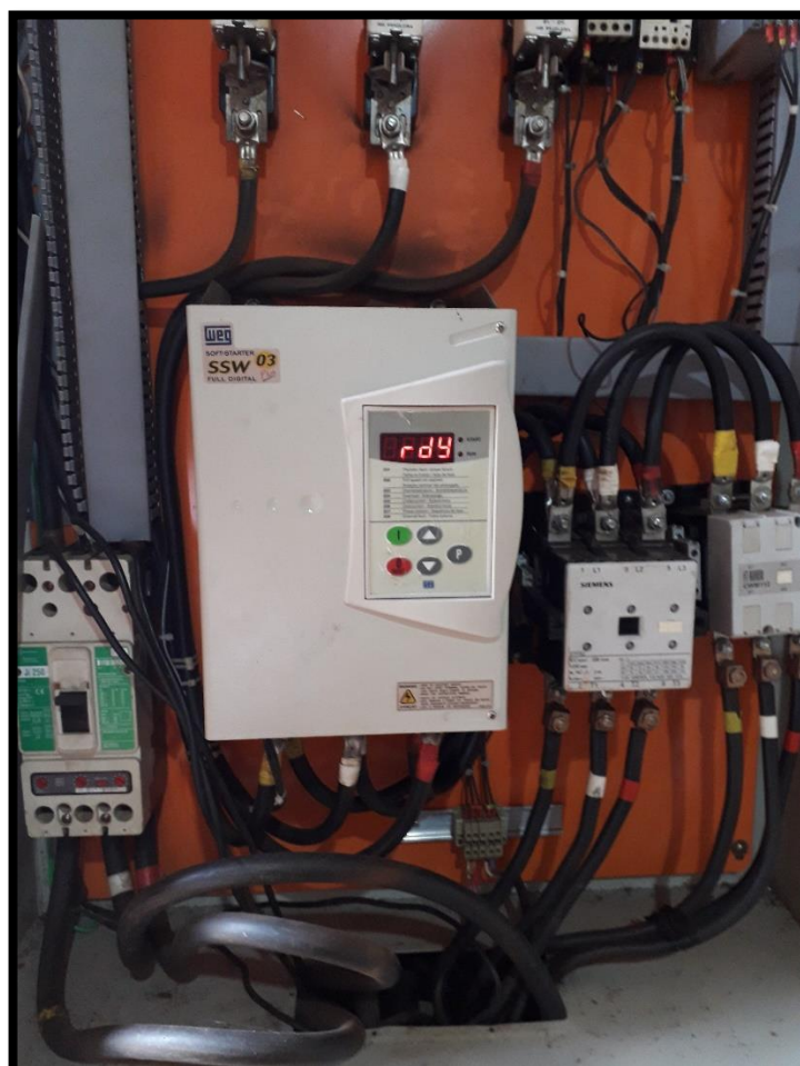
Imagem 14: Estação elevatória junto ao reservatório enterrado – quadro de comando
