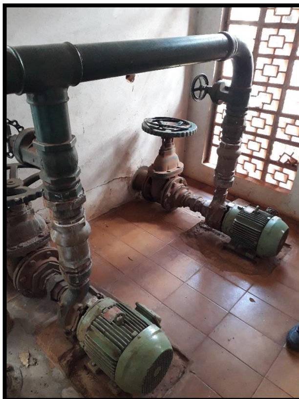
Imagem 15: Estação elevatória junto ao reservatório apoiado – conjuntos motobombas
