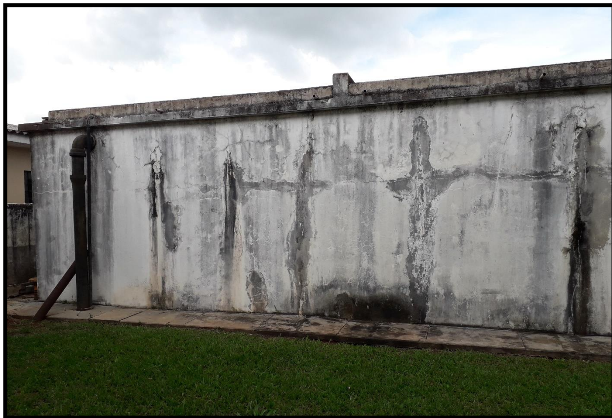
Imagem 10: Reservatório apoiado – Aparentes infiltrações e desgaste do revestimento externo
