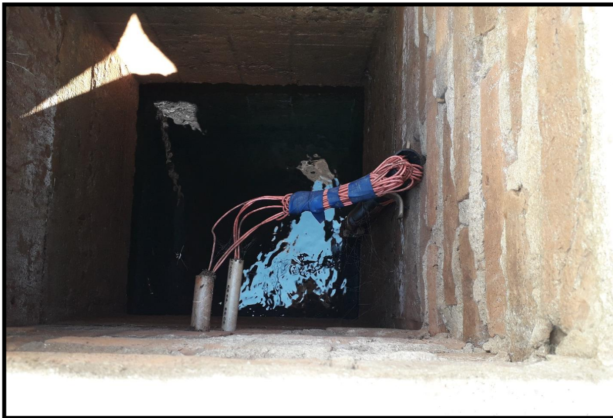
Imagem 9: Reservatório enterrado - Aberturas de inspeção e instalação de medição de nível
