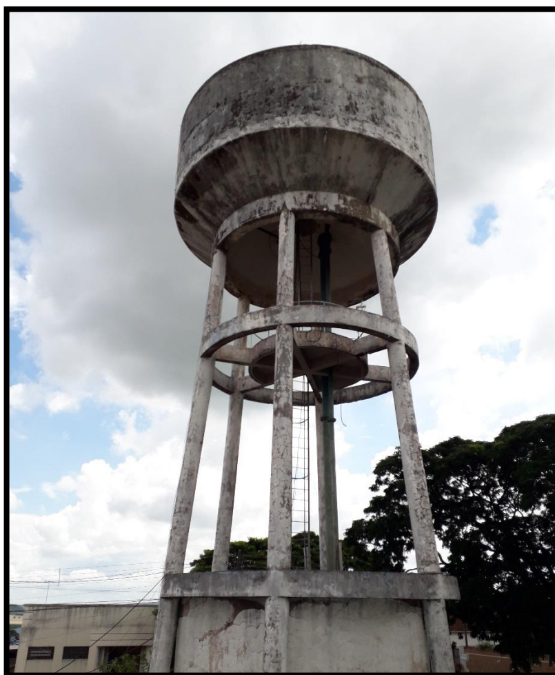
Imagem 12: Reservatório elevado – Revestimento externo em más condições
