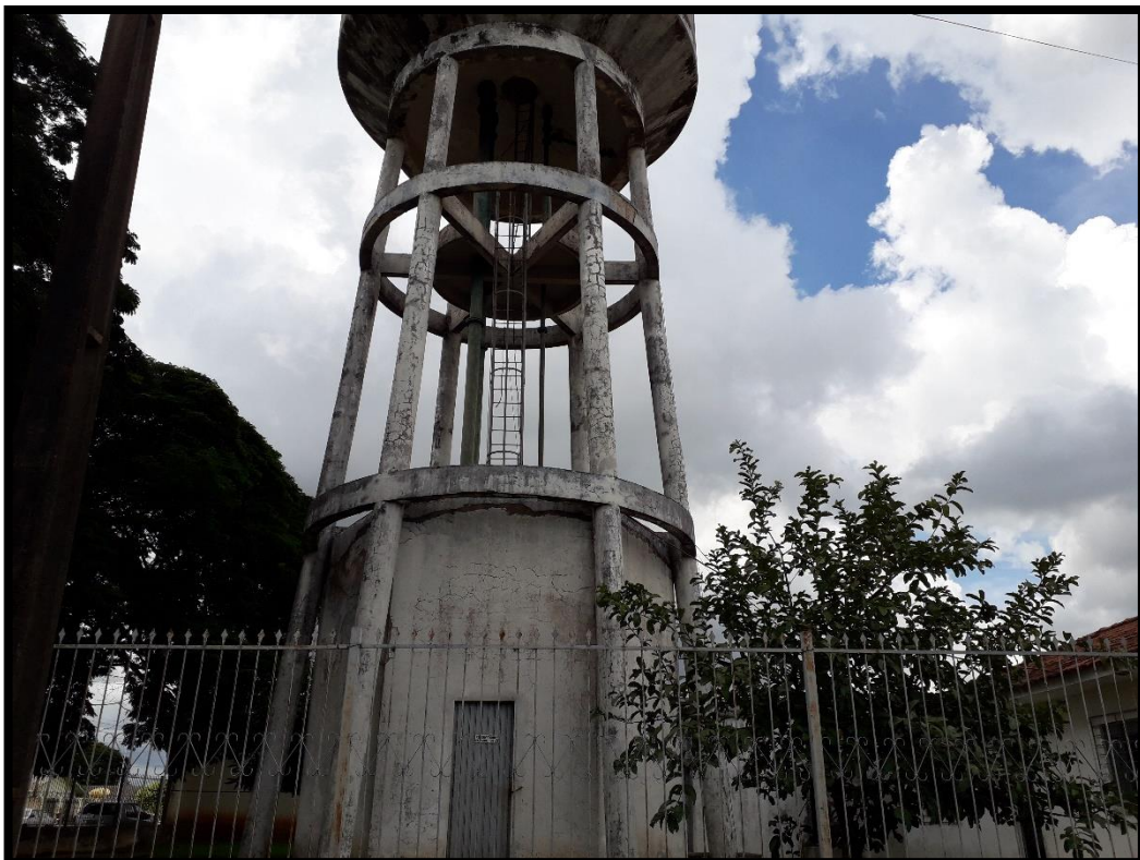
Imagem 3: SAAE – Reservatório elevado
