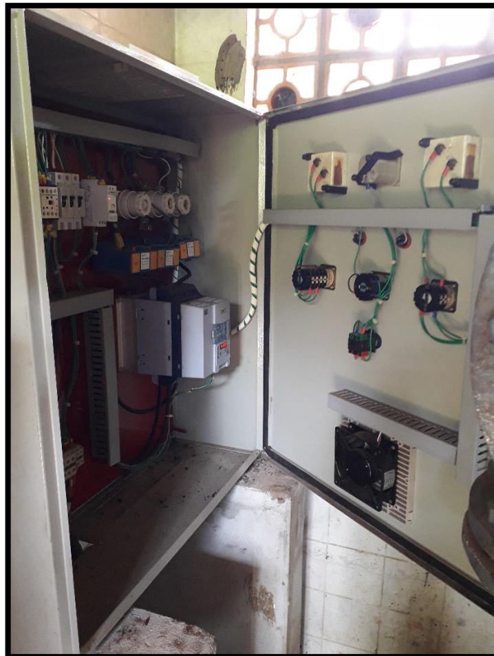
Imagem 7: Quadro de comando do poço tubular profundo
