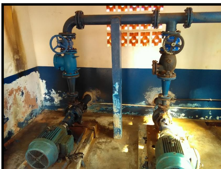
Imagem 18: Elevatória que recalca água tratada do reservatório enterrado para o elevado
