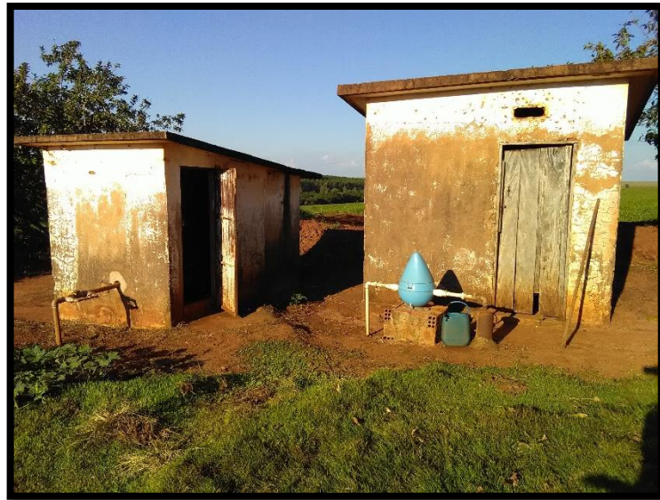
Imagem 20: Poço tubular profundo e sistema de cloração e fluoretação por pastilhas
