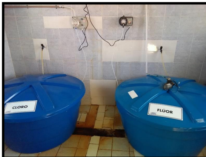
Imagem 11: Estação de tratamento simplificado 2 – bombas dosadoras e reservatórios de sal e água
