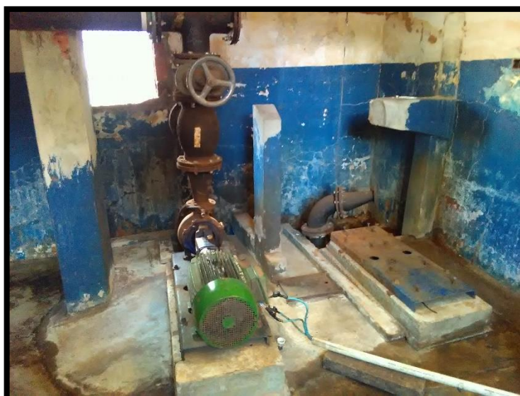
Imagem 19: Elevatória que recalca água bruta da mina para o reservatório enterrado
