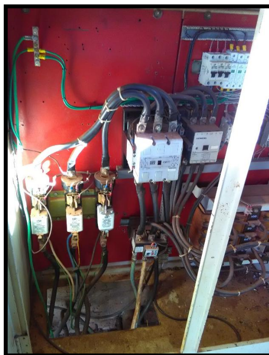
Imagem 9: Poço 01 – quadro de comando
