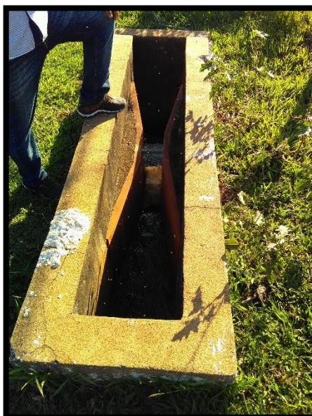
Imagem 25: Medidor de Vazão de Saída
