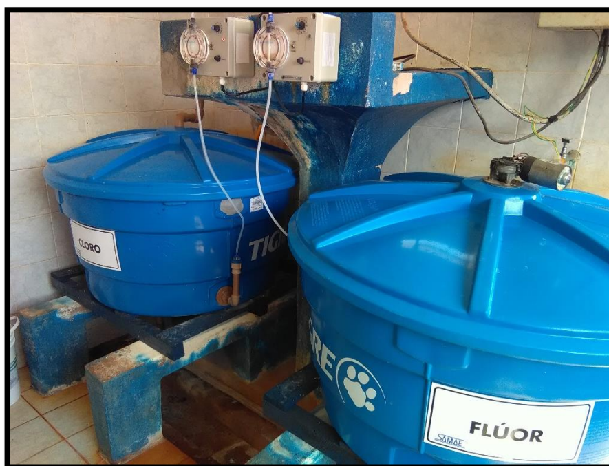
Imagem 10: Estação de tratamento simplificado 1 – Dosadoras e reservatórios de cloro e flúor
