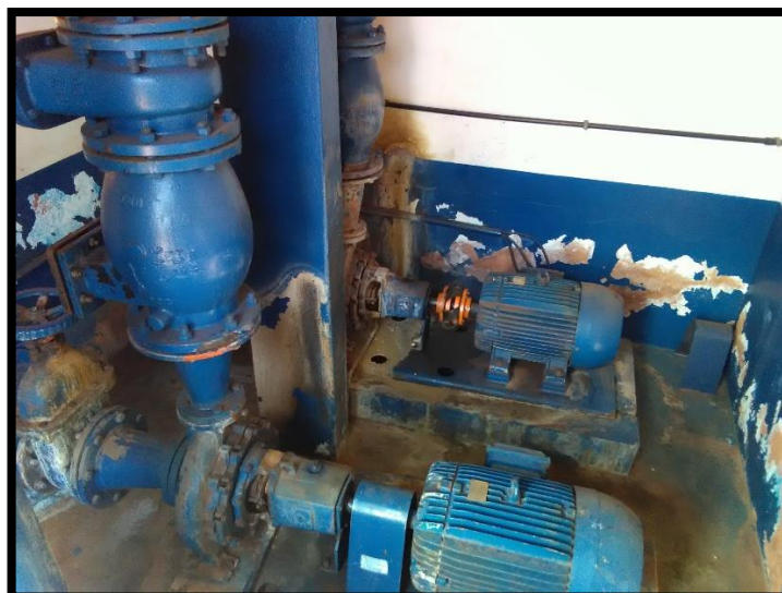
Imagem 17: Elevatória que recalca água tratada do reservatório semienterrado para o enterrado
