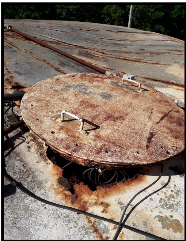
Imagem 25: RAP – 001 - Abertura de inspeção oxidada e quebrada
