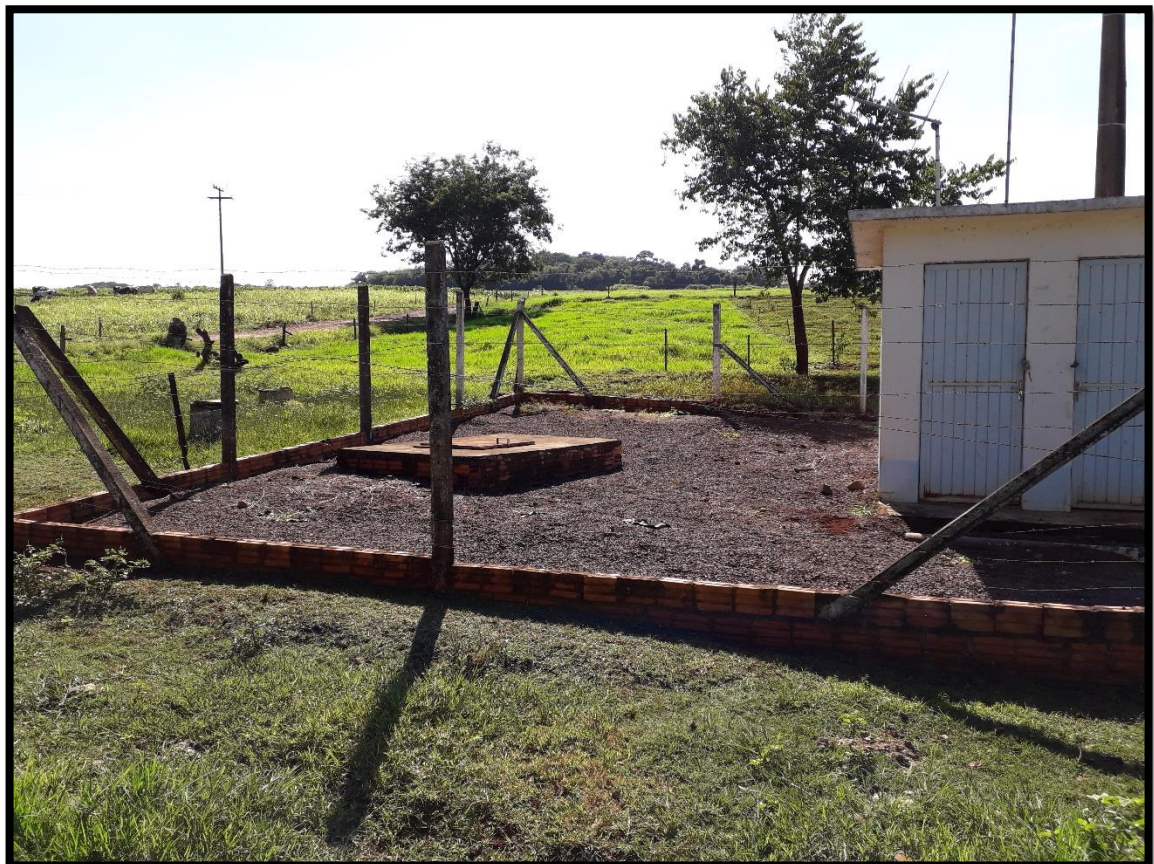
Imagem 6: PTP – 002 (Gaúcha III) – Isolamento do perímetro precisa de manutenção
