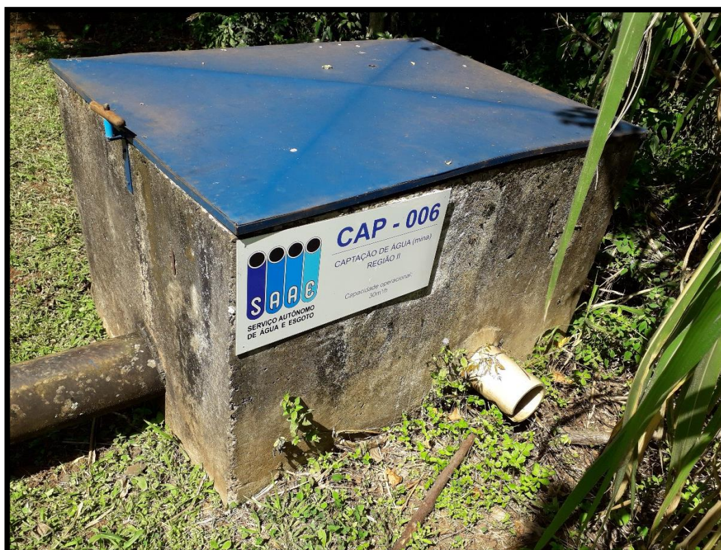
Imagem 15: CAP 006 – Caixa de alvenaria e tampa de inspeção
