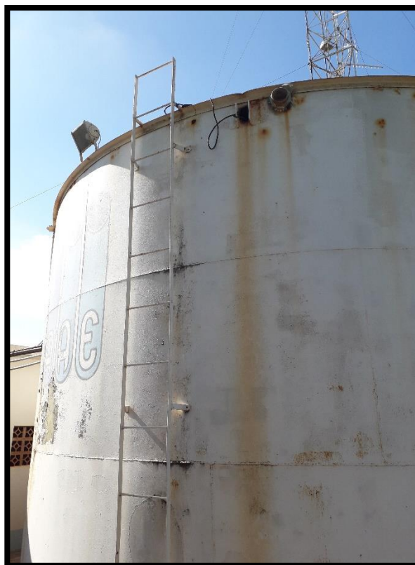
Imagem 24: RAP – 001 - Escada de acesso sem gaiola de proteção
