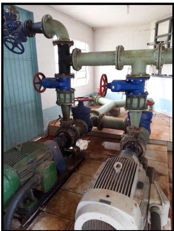
Imagem 47: EAB – 003 – Conjunto motobombas
