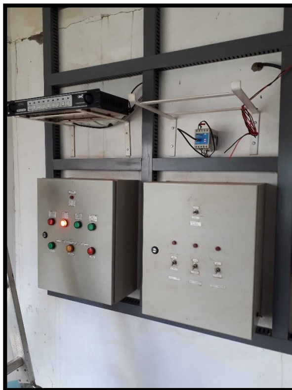
Imagem 48: EAB – 003 – Quadro de comando
