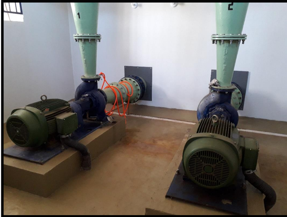
Imagem 43: EAT – 002 – Conjunto motobombas
