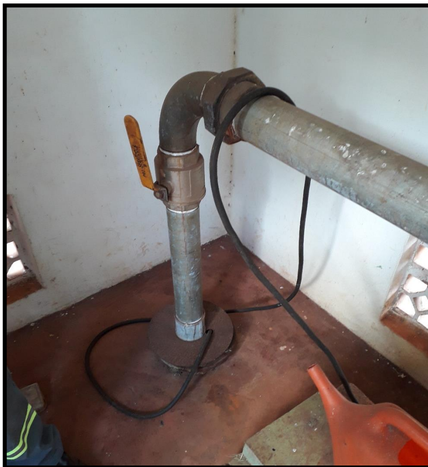
Imagem 14: CAP 005 – Instalação hidráulica
