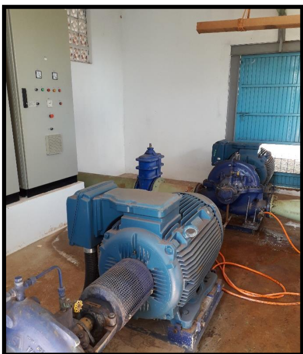
Imagem 51: EAB – 006 – Conjunto motobombas
