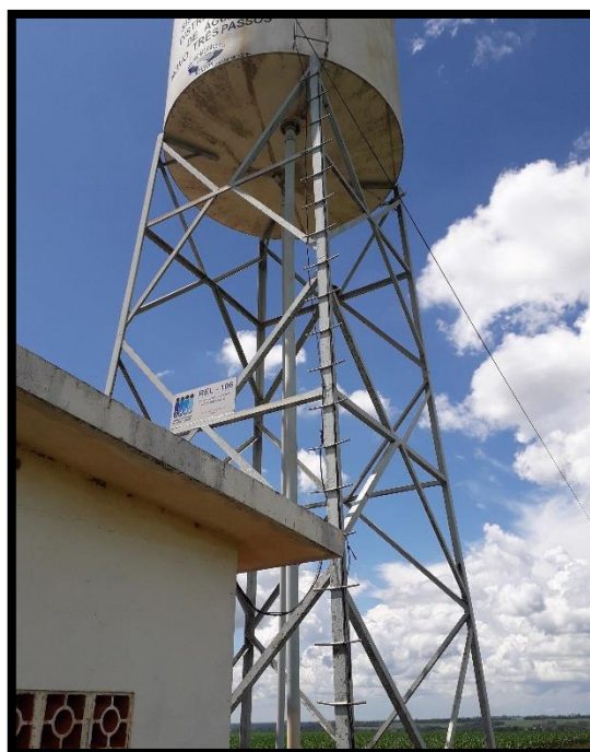
Imagem 55: REL – 106 – Escada de acesso sem gaiola de proteção
