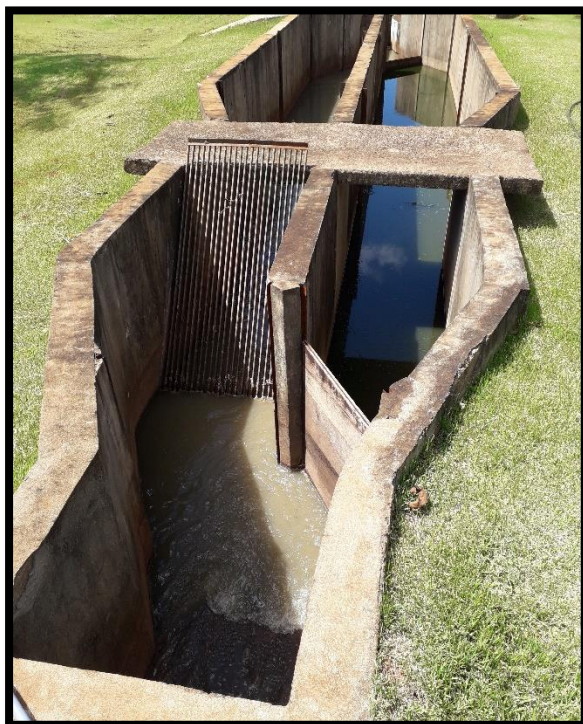
Imagem 62: Gradeamento e caixa de areia
