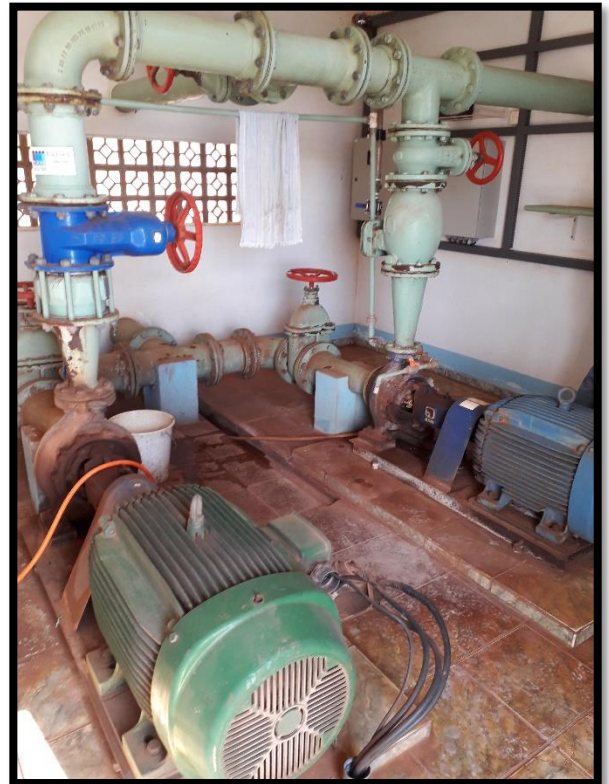
Imagem 40: EAT - 003 - Conjunto motobombas
