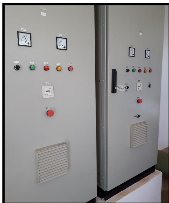
Imagem 52: EAB – 006 – Quadros de comando
