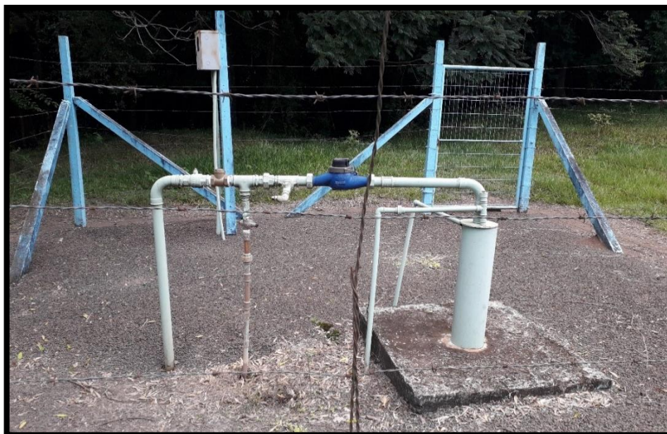
Imagem 53: PTP – 106 – Poço tubular com macromedidor e tomada d'água
