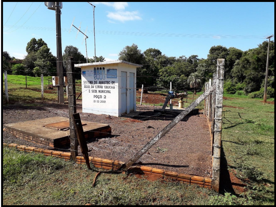
Imagem 5: PTP – 002 (Gaúcha III) – Isolamento do perímetro precisa de manutenção
