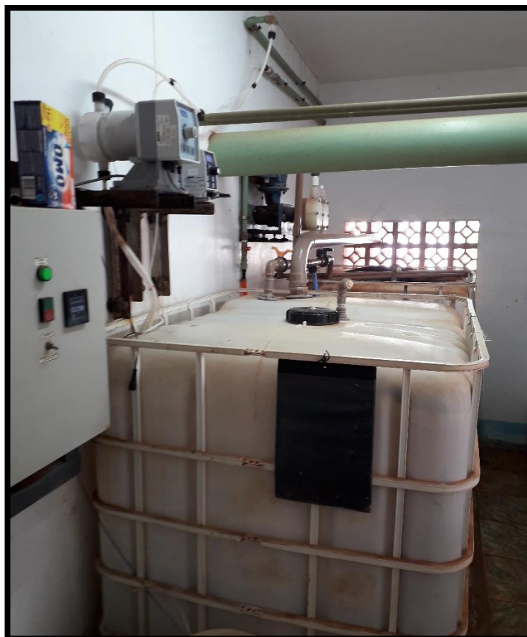
Imagem 18: Estação de tratamento simplificado junto ao RAP - 001
