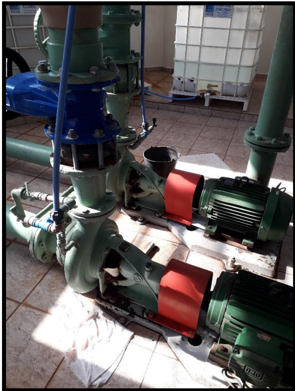
Imagem 39: EAT - 001 - Conjunto motobombas
