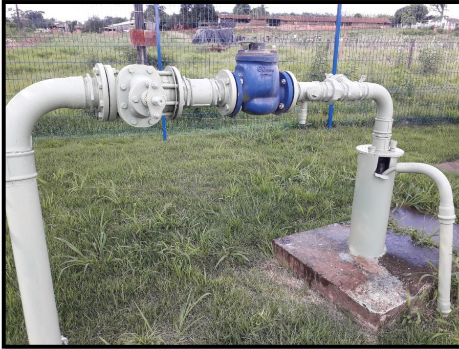
Imagem 7: PTP – 005 (Feiden) - Instalação hidráulica com macromedição e tomada d'água para coleta
