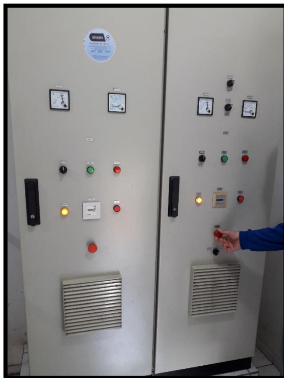
Imagem 50: EAB – 001 – Quadros de comando
