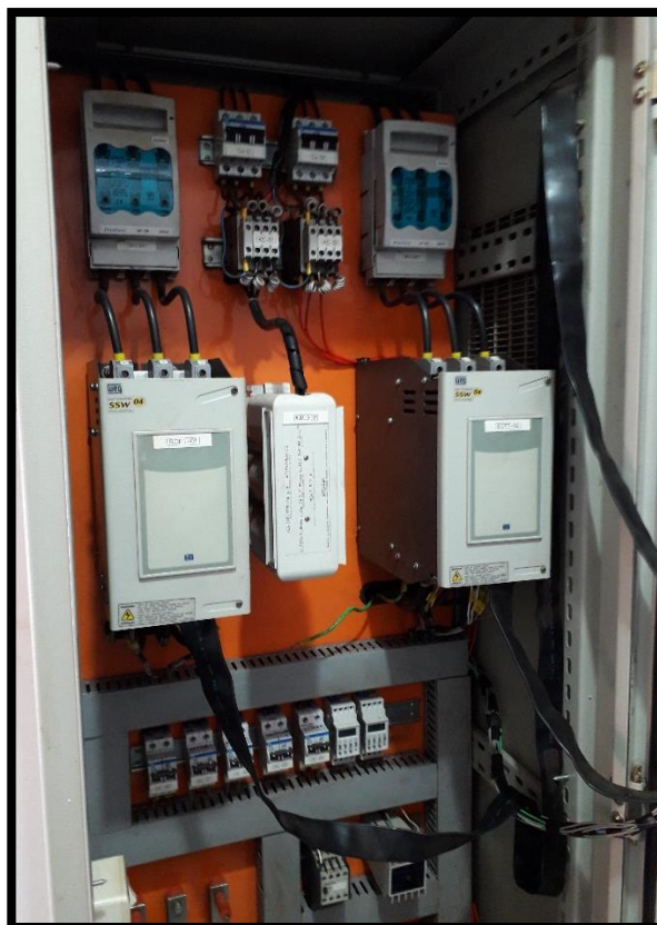
Imagem 46: EAB – 002 – Quadro de comando com dispositivos soft Starter
