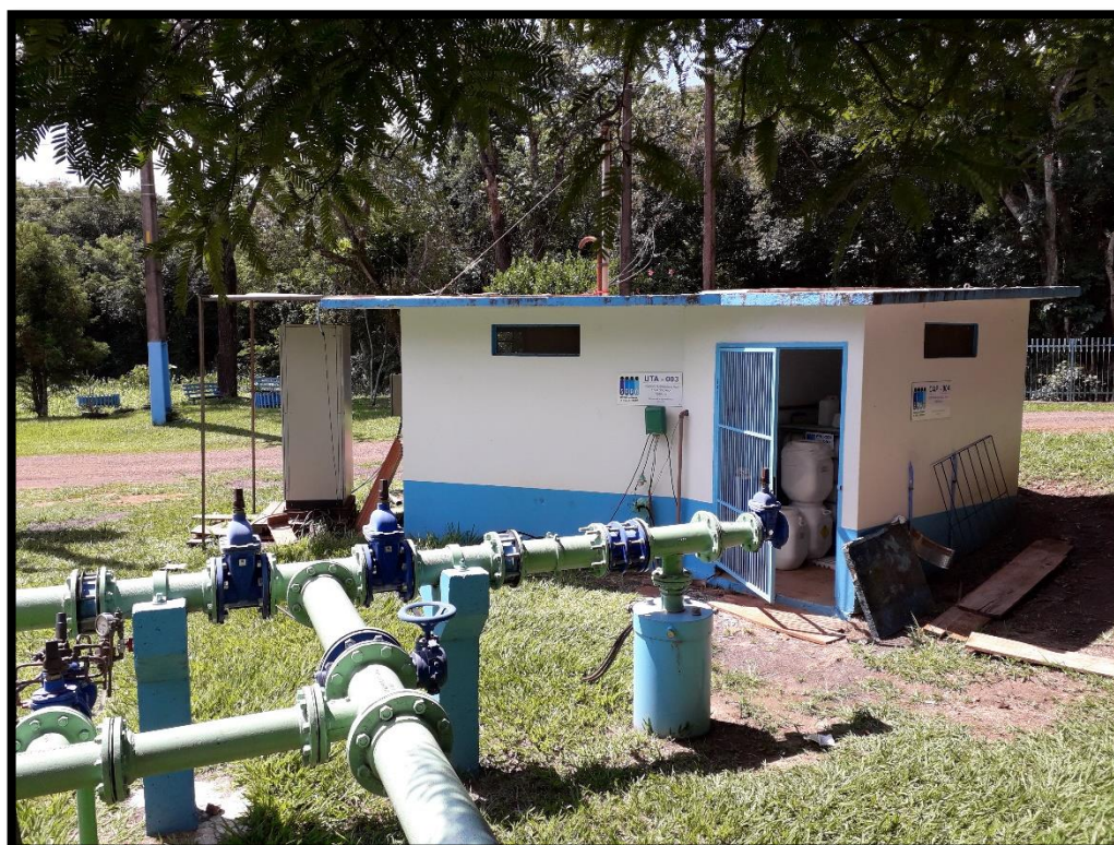
Imagem 13: CAP 004 – Instalação hidráulica
