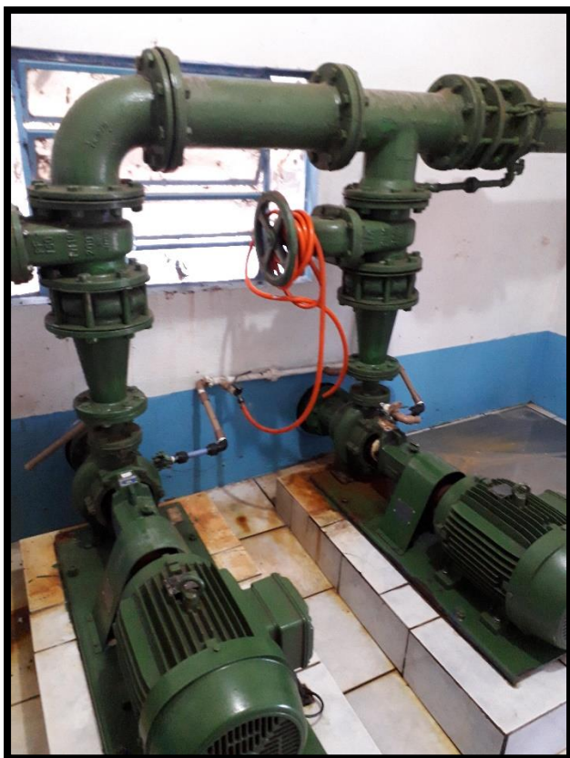
Imagem 45: EAB – 002 – Conjunto motobombas
