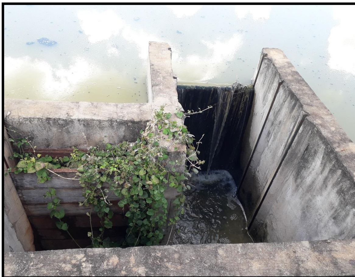
Imagem 65: ETE Guavirá – Anteparo de saída da Lagoa Facultativa
