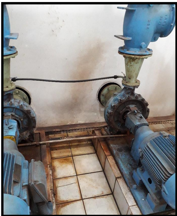
Imagem 49: EAB – 001 – Conjunto motobombas
