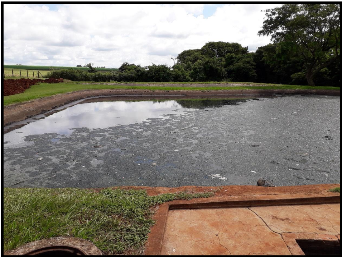
Imagem 60: ETE Augusto – Lagoa anaeróbia
