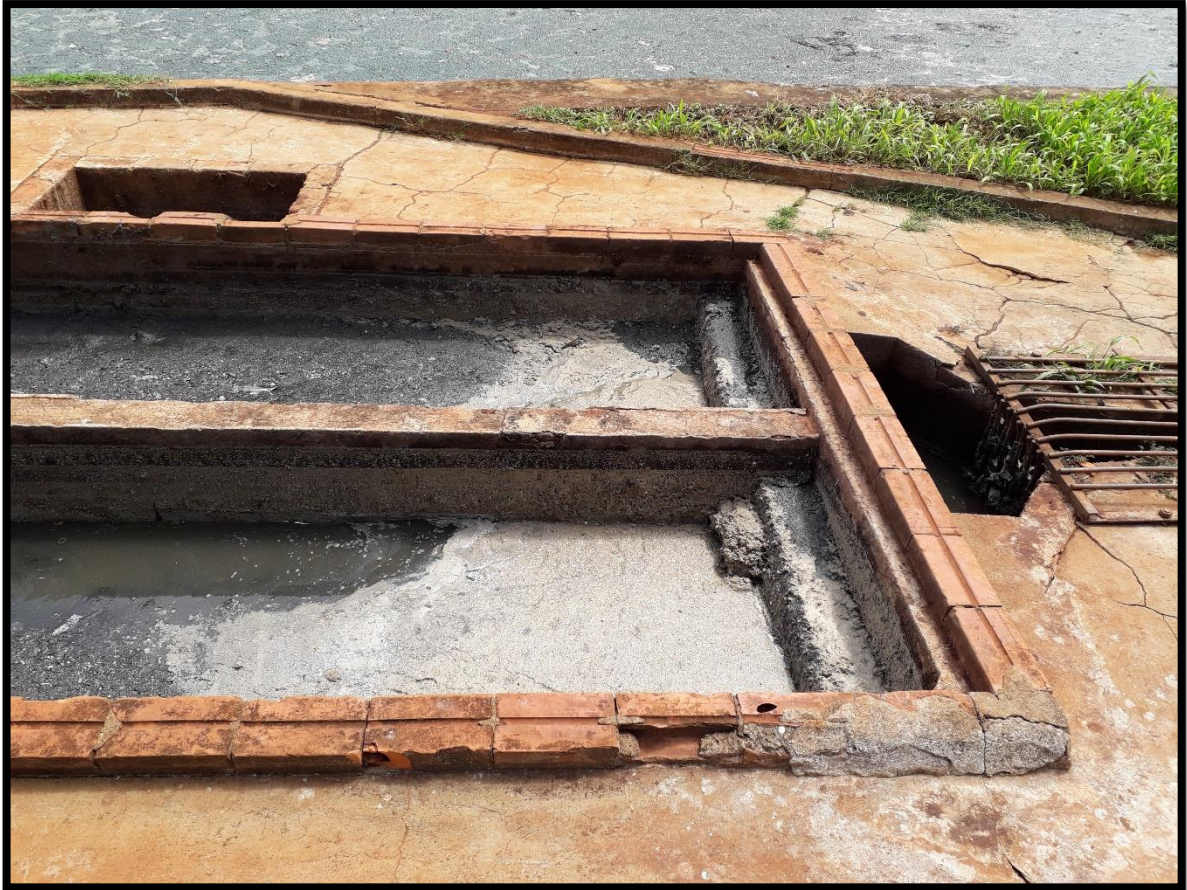
Imagem 59: ETE Augusto - caixa de areia
