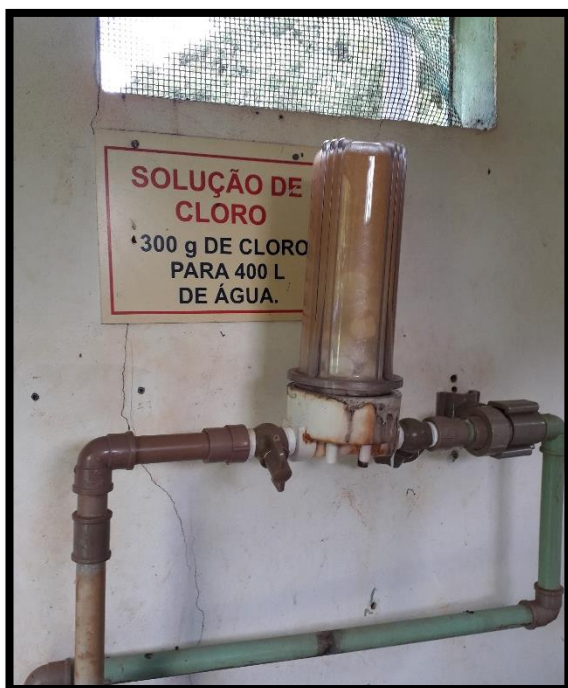
Imagem 54: Estação de tratamento simplificado
