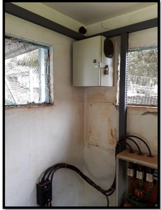
Imagem 10: PTP – 008 (Líder) – Aberturas fechadas apenas com telas
