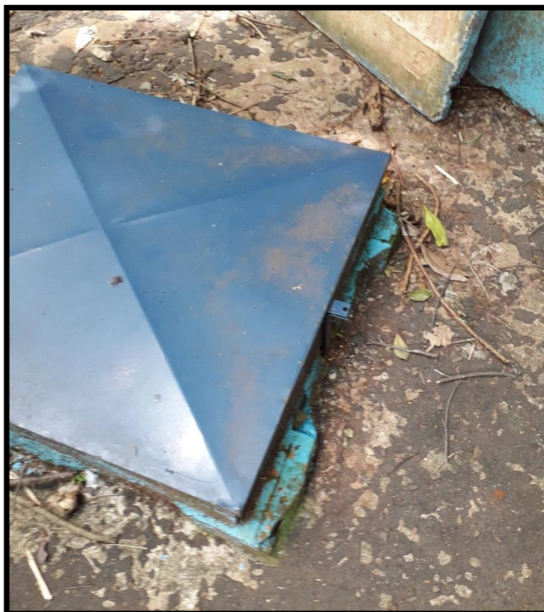
Imagem 29: REN – 002 – Abertura de inspeção sem cadeado
