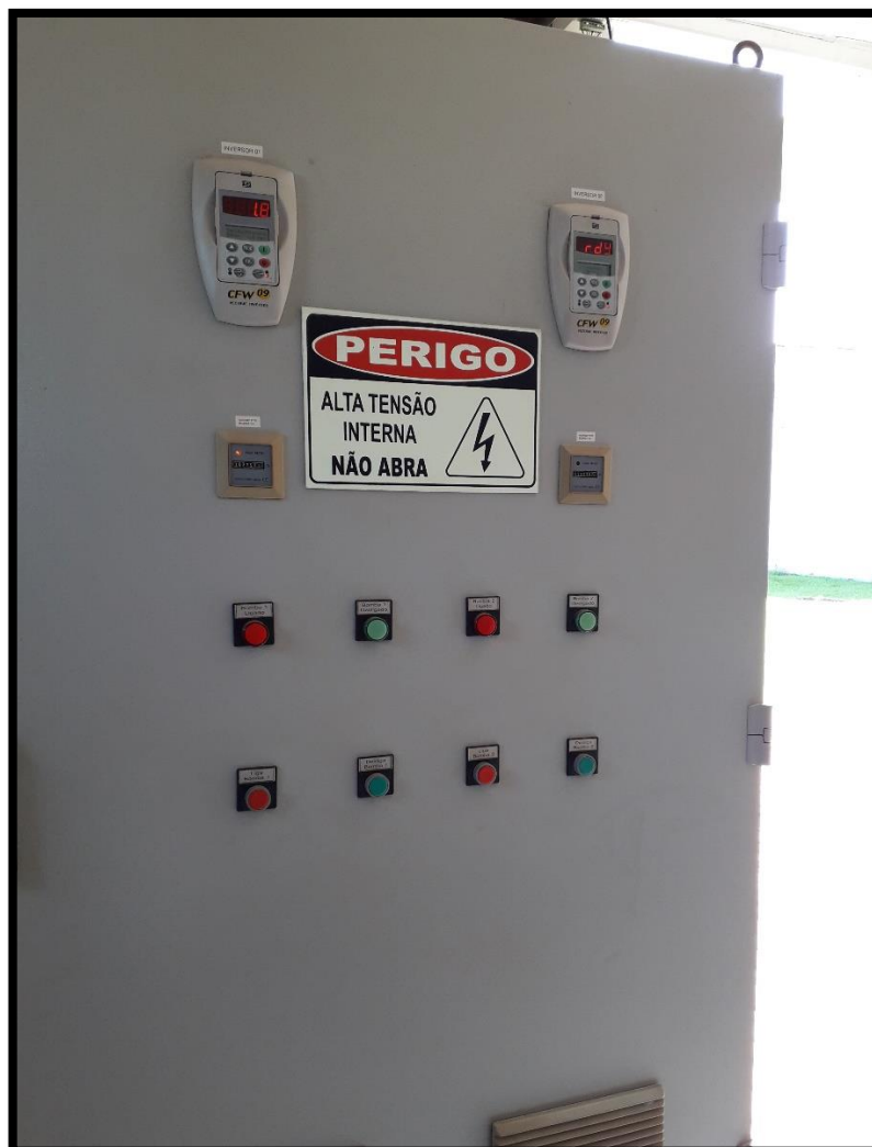
Imagem 44: EAT – 002 – Quadro de comando
