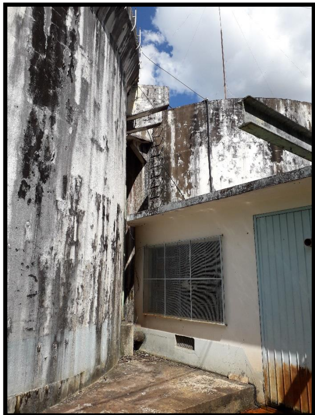
Imagem 36: RAP – 004 e RAP 005 – Escadas de acesso sem gaiola de proteção
