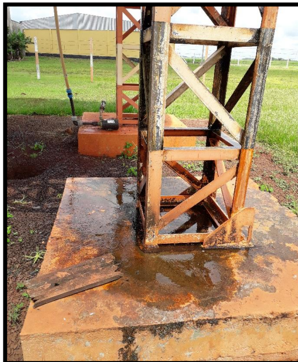
Imagem 32: REL – 003 – Vazamento no fundo do reservatório
