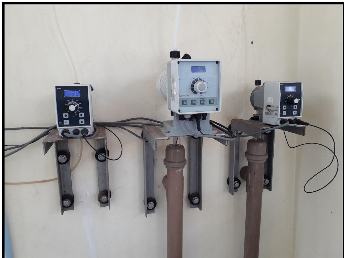
Imagem 17: Dosadoras na Estação de tratamento simplificado aplicado no REN - 001
