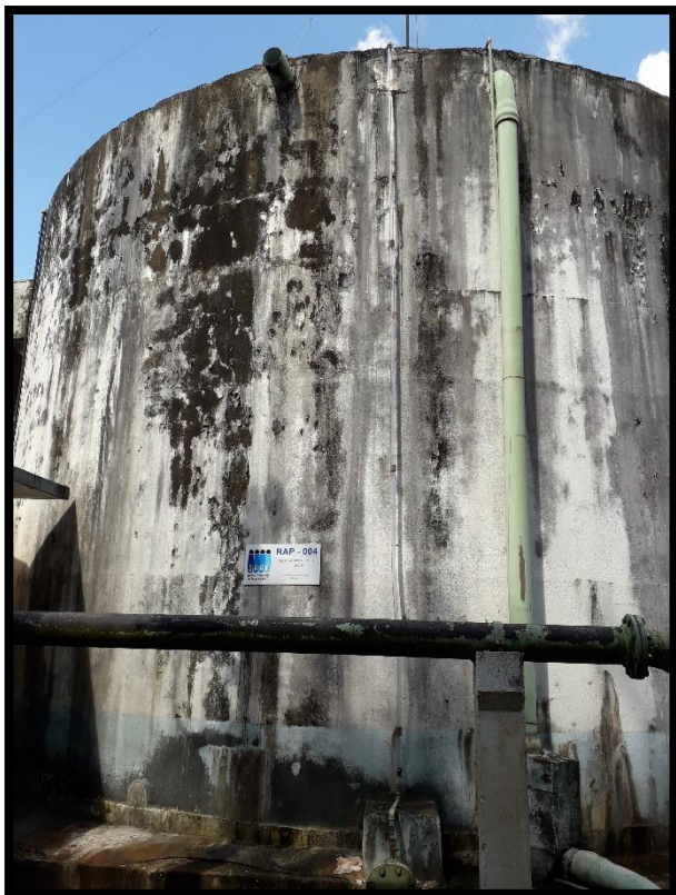
Imagem 35: RAP – 004 – Apresenta infiltrações e revestimento externo deteriorados
