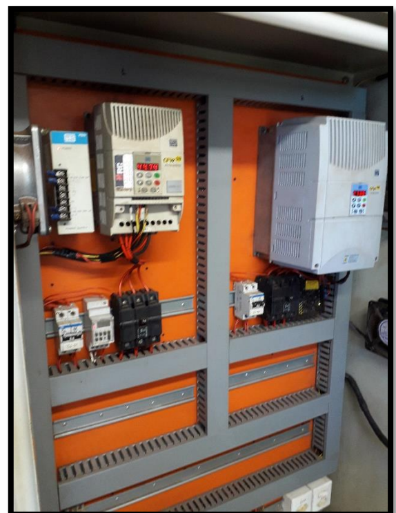
Imagem 42: EAT - 005 - Quadro de comando com dispositivo Soft Starter
