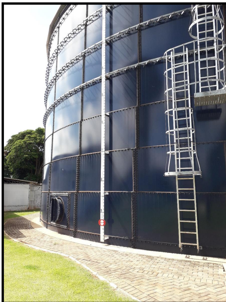
Imagem 28: RAP – 002 – Escada de acesso, medidor de nível e escotilha de limpeza
