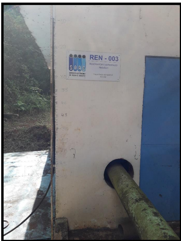
Imagem 37: REN – 003 – Identificação e Medidor de nível
