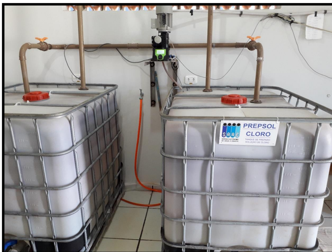
Imagem 19: Estação de tratamento simplificado junto ao RAP - 002
