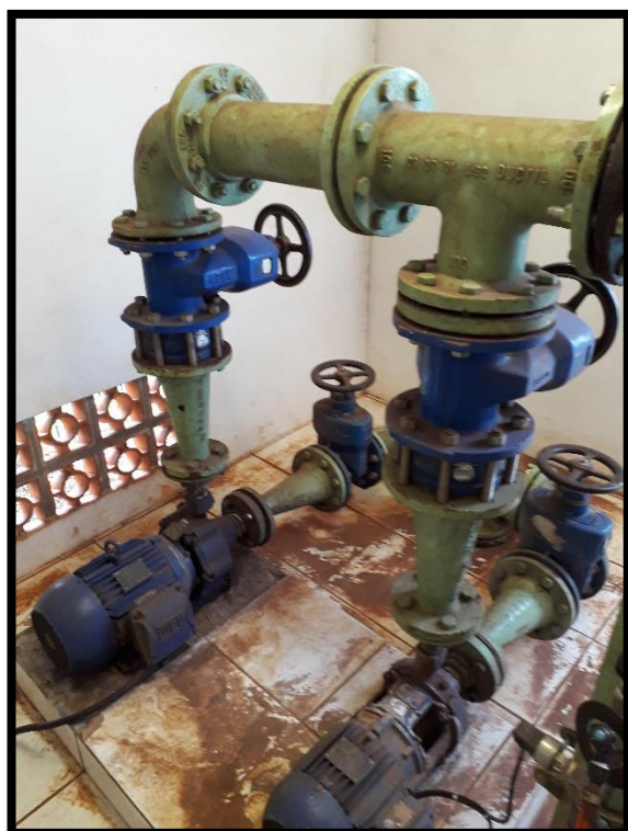
Imagem 41: EAT - 005 - Conjunto motobombas
