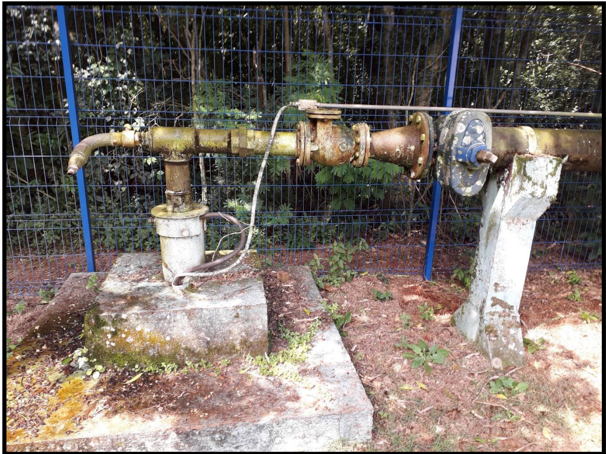
Imagem 11: PTP – 011 (Dierings) – Instalação hidráulica com tomada d'água
