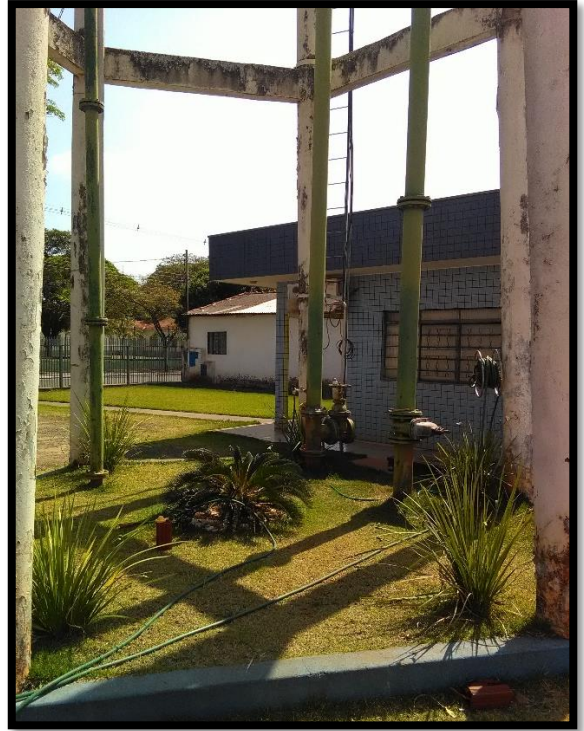
Imagem 21: REL 01 – instalação hidráulica
