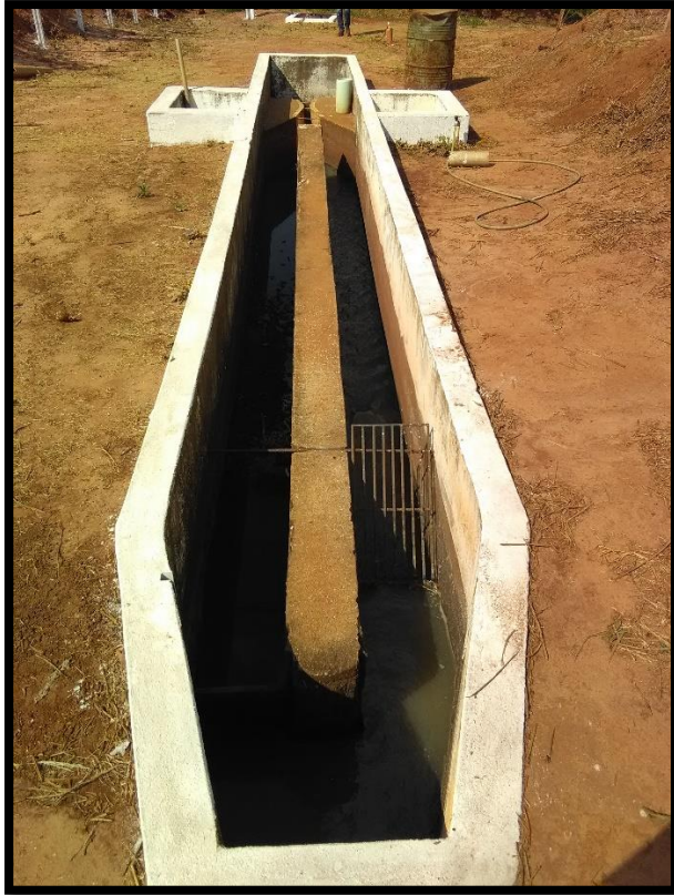
Imagem 27: ETE – Gradeamento, Desarenador e Calha Parshall
