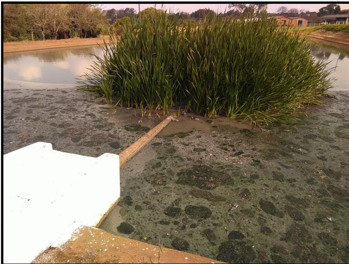
Imagem 30: ETE – Lagoa Anaeróbia 2
