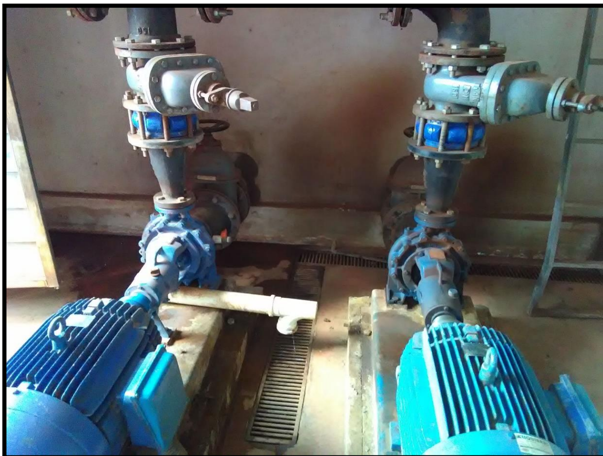
Imagem 10: EAB 01 – conjunto motobombas
