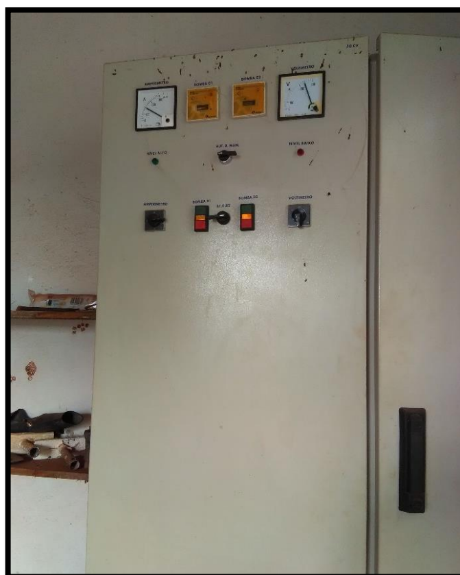
Imagem 11: EAB 01 – quadros de comando
