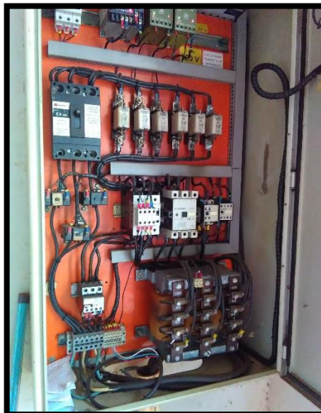
Imagem 9: Poço 07 – Quadro de Comando
