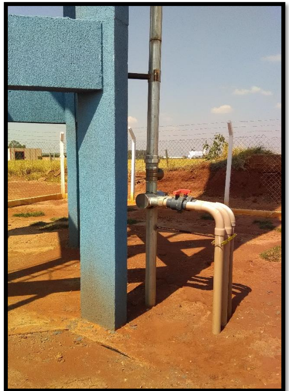
Imagem 23: REL 03 – instalação hidráulica
