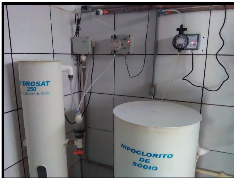
Imagem 14: Unidade de tratamento de água – Dosadoras e reservatórios
