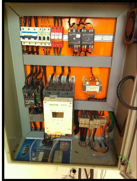
Imagem 7: Poço 06 – Quadro de Comando
