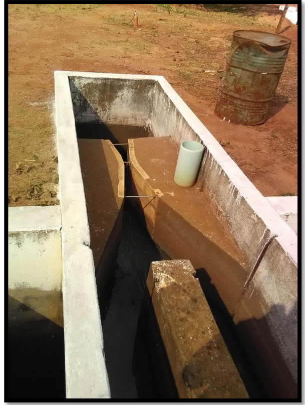
Imagem 28: ETE – Calha Parshall
