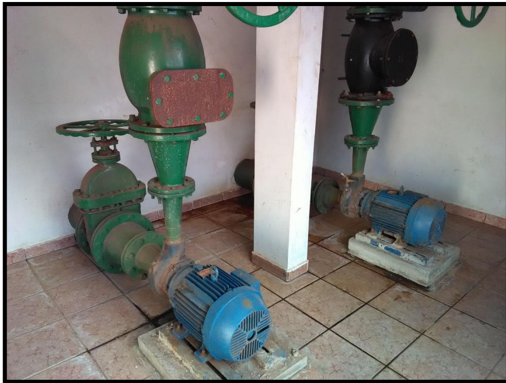
Imagem 20: Conjunto motobombas da EET 1
