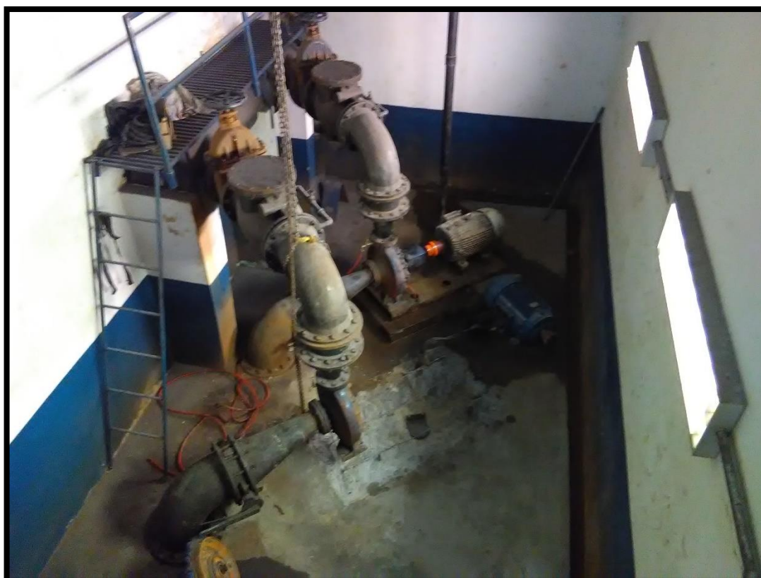
Imagem 6: Estação Elevatória de Água Bruta
