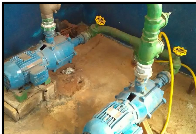
Imagem 24: Conjunto motobombas da EET 3
