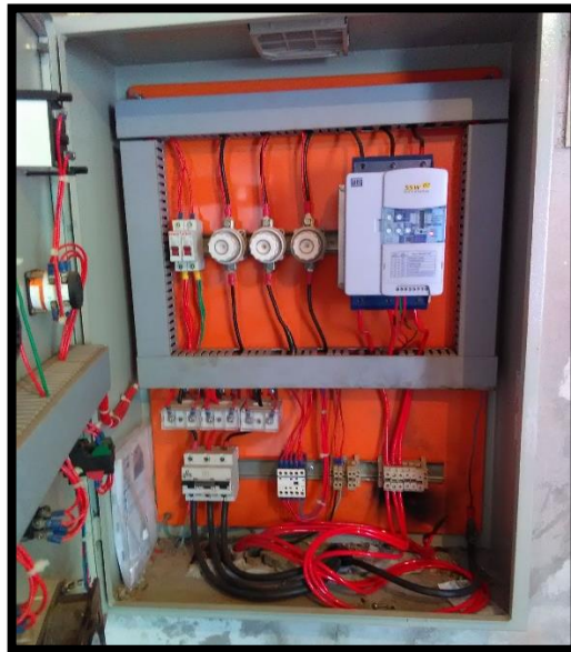
Imagem 23: Quadro de Comando da EET 2
