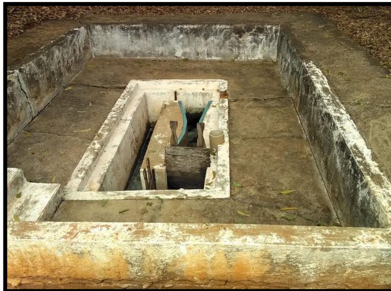
Imagem 42: ETE – Calha parshall de saída
