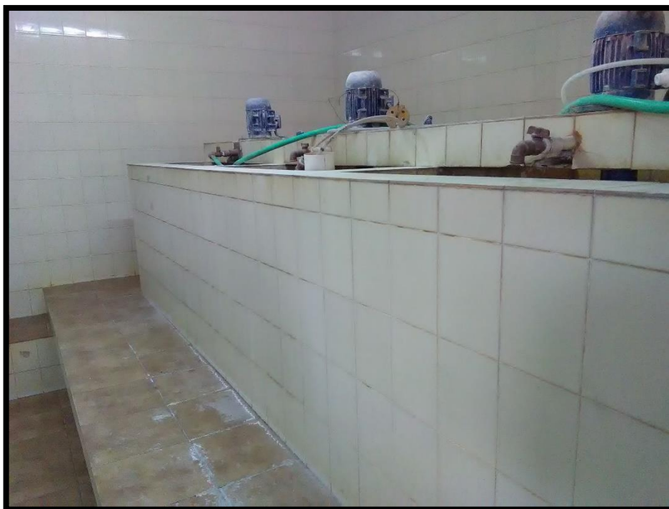
Imagem 12: Tanques de sulfato de alumínio, flúor e cal
