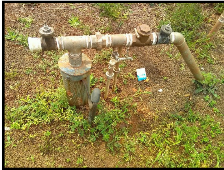
Imagem 26: Poço tubular profundo
