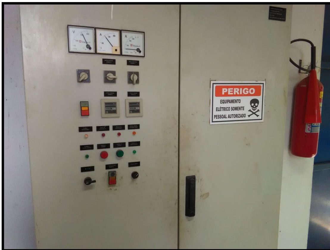
Imagem 7: Estação Elevatória de Água Bruta – Quadro de Comando
