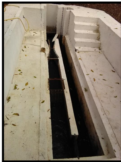
Imagem 39: ETE – Gradeamento e Calha Parshall
