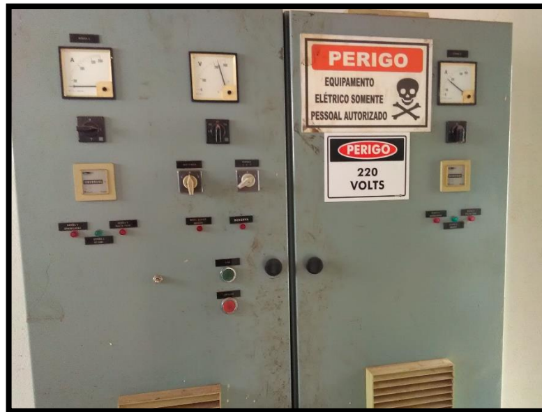
Imagem 35: Quadro de comandos da estação elevatória
