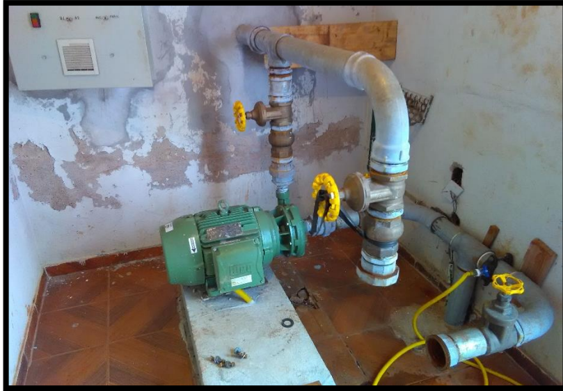
Imagem 22: Conjunto motobombas da EET 2
