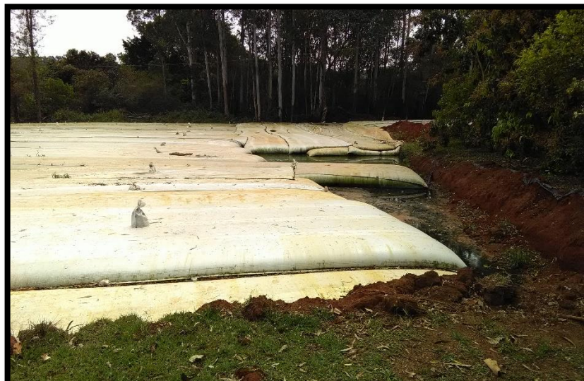
Imagem 43: ETE – Bags de desidratção do lodo
