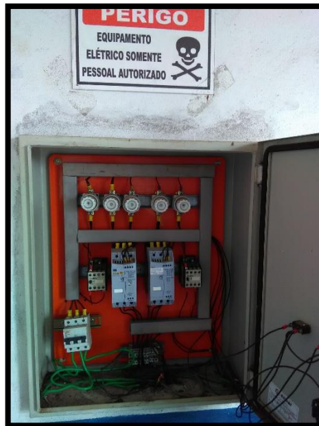
Imagem 25: Quadro de Comando da EET 3
