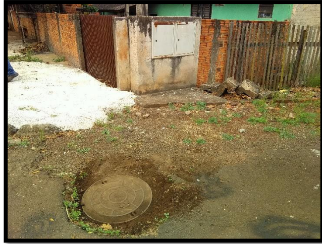
Imagem 38: uma das Mini estação elevatória de esgoto tampada
