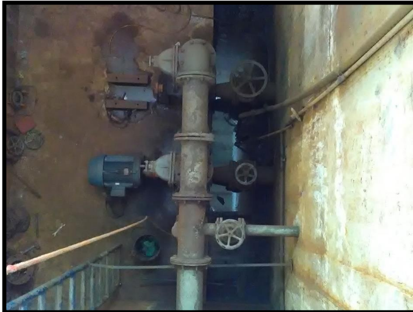
Imagem 34: Conjunto Motobombas da estação elevatória
