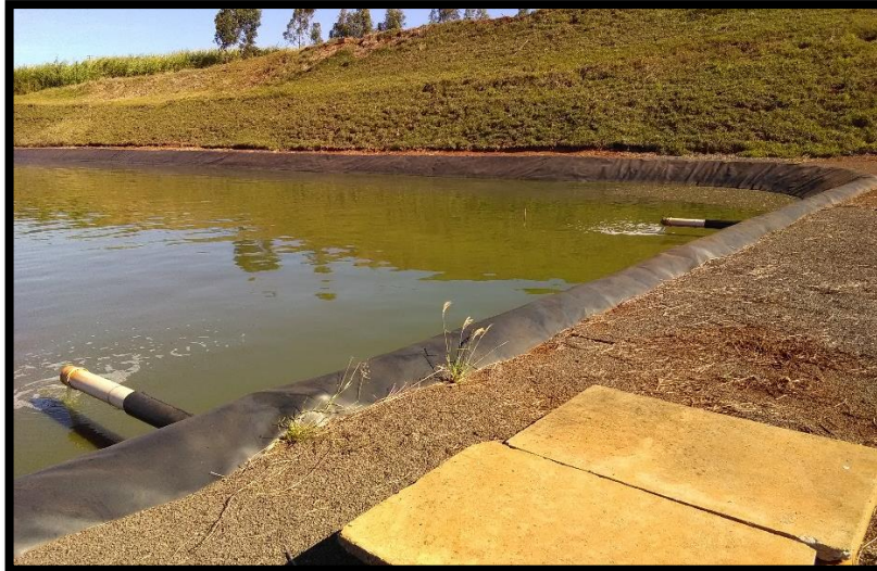
Imagem 29: Estação de Tratamento de Esgoto – Lagoa Anaeróbia
