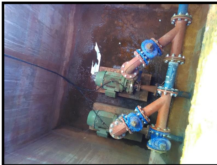
Imagem 27: Estação elevatória de esgoto - Lagoa anaeróbia
