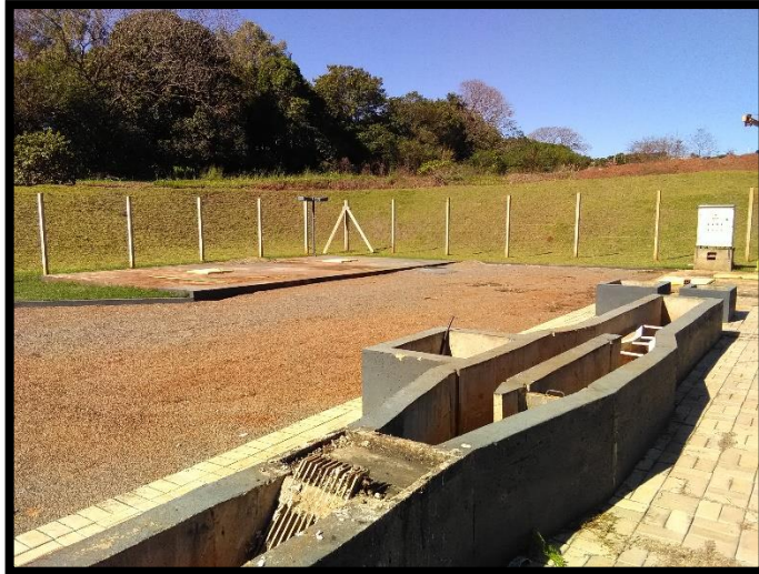
Imagem 26: Estação elevatória de esgoto - Gradeamento, caixa de areia e medidor de vazão
