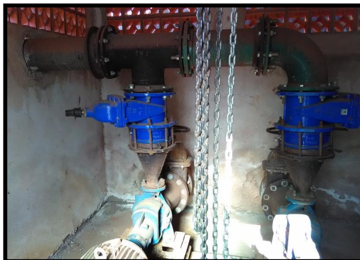
Imagem 20: Estação Elevatória da Sede
