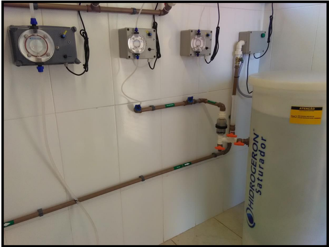
Imagem 11: Estação de tratamento simplificada – bombas dosadoras de cloro e reservatório
