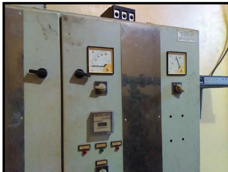
Imagem 19: Estação Elevatória da mina Japurá – quadro de comando
