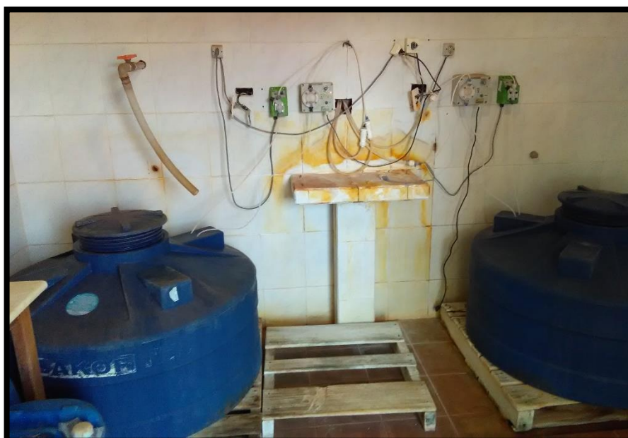
Imagem 10: Estação de tratamento simplificado – Dosadora e reservatório de flúor
