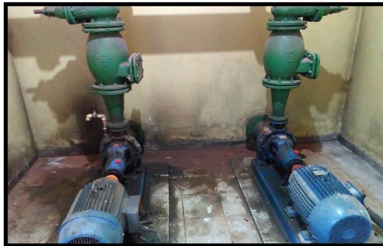
Imagem 18: Estação Elevatória da mina Japurá
