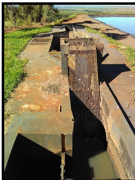
Imagem 28: Estação de Tratamento de Esgoto – Gradeamento, Desarenador e Calha Parshall
