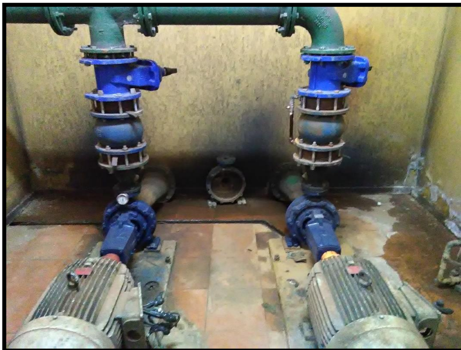
Imagem 16: Estação Elevatória da mina Aguapeí
