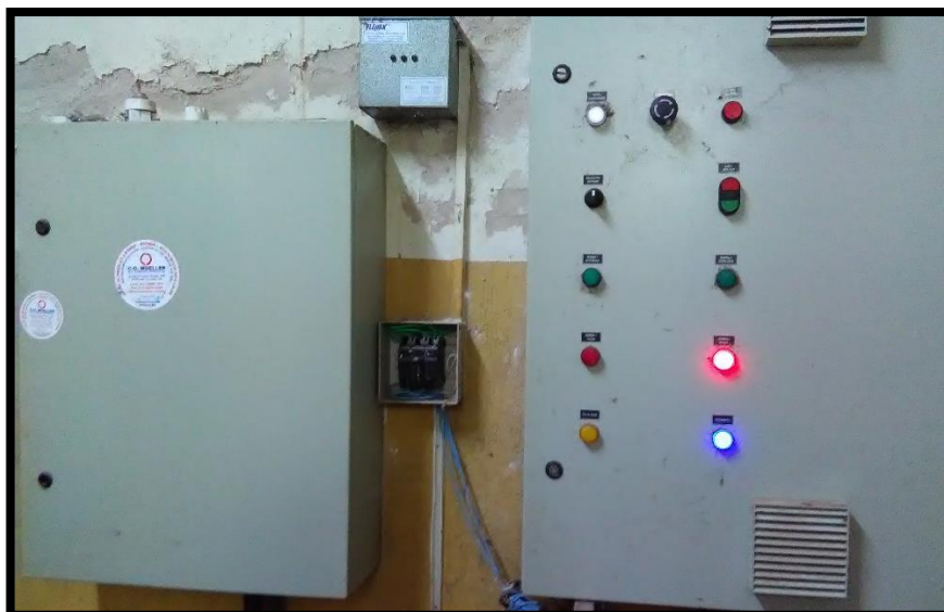
Imagem 6: Quadros de comando do Poço e Mina Aguapeí
