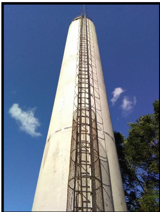
Imagem 23: Reservatório elevado - Sistema Novo Horizonte
