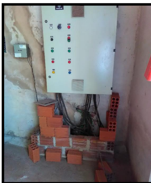
Imagem 21: Estação Elevatória da Sede – quadro de comando
