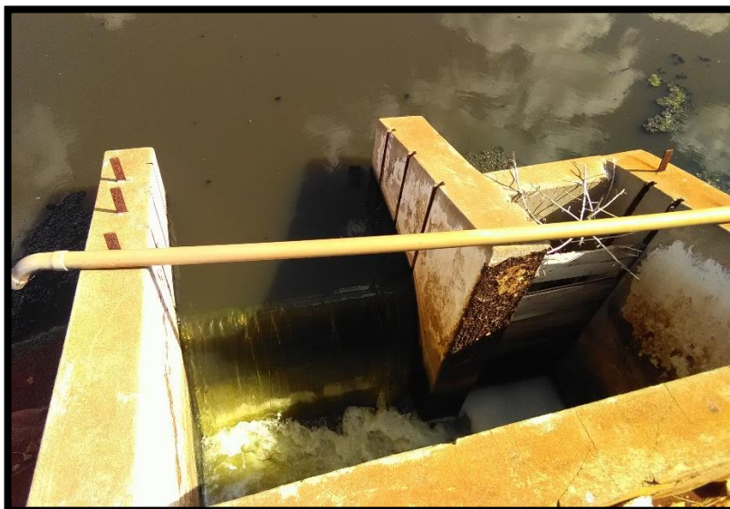
Imagem 37: Dispositivo de saída da lagoa facultativa
