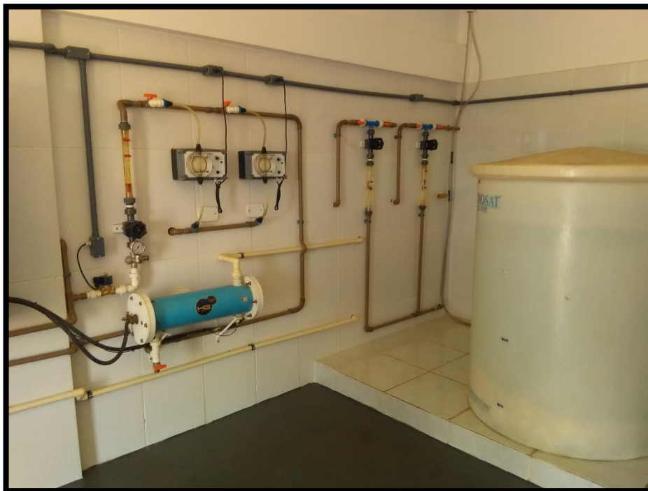
Imagem 21: Bombas dosadoras sistema Hidrogeron
