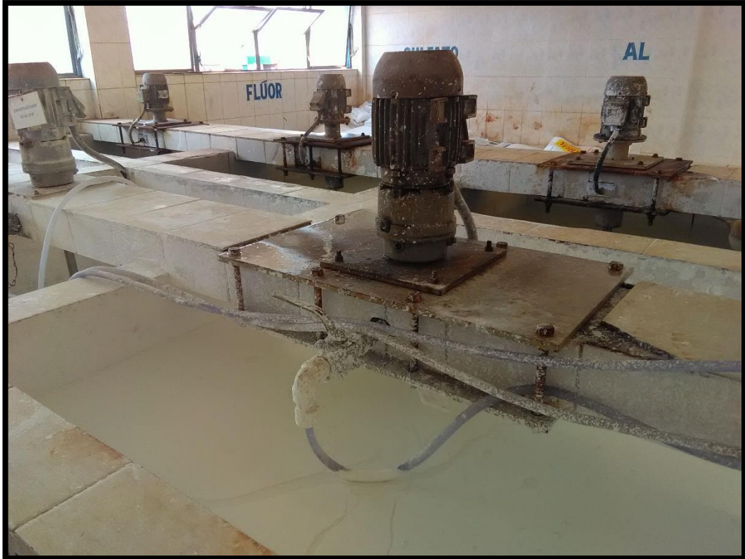
Imagem 20: Tanques de sulfato de alumínio e cal hidratada
