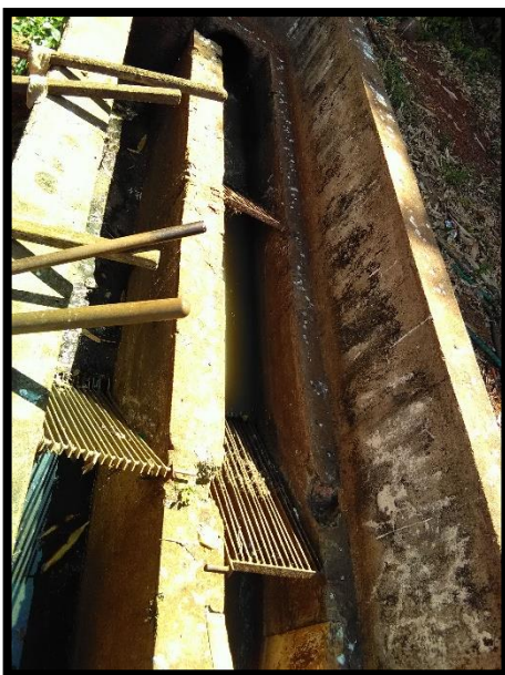
Imagem 40: Gradeamento e medidor de vazão de entrada
