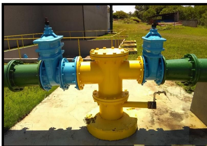
Imagem 7: Barrilete do Poço 2 com válvulas de manobra e tomada de água para coleta de amostras
