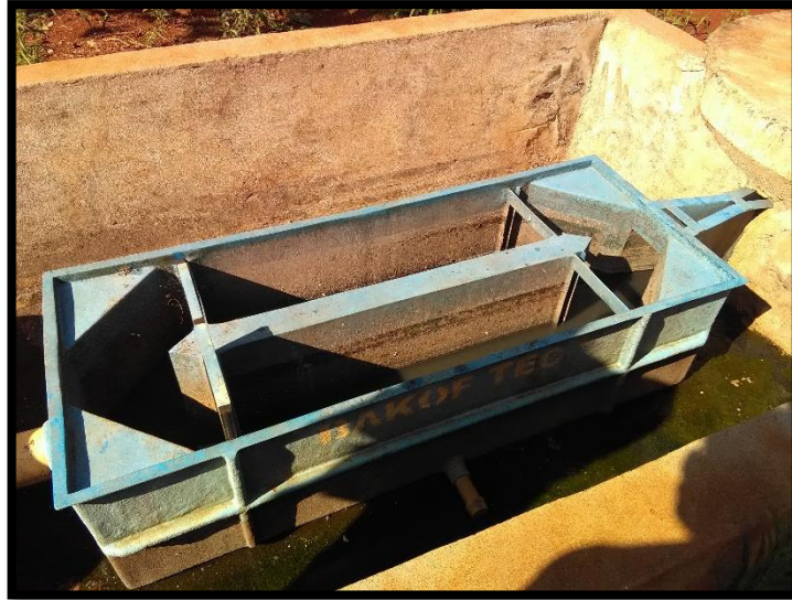
Imagem 52: Desarenador e medidor de vazão
