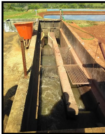
Imagem 33: Gradeamento e medidor de vazão de entrada
