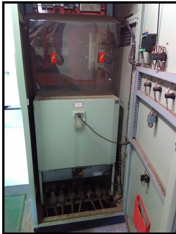
Imagem 26: Quadro de Comando da elevatória
