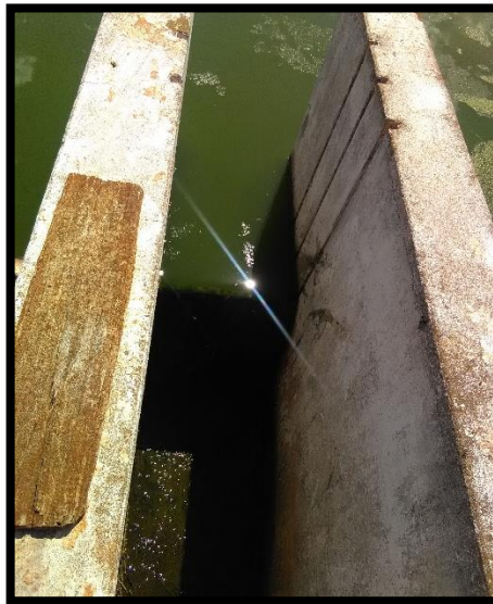
Imagem 49: Dispositivo de saída da lagoa facultativa
