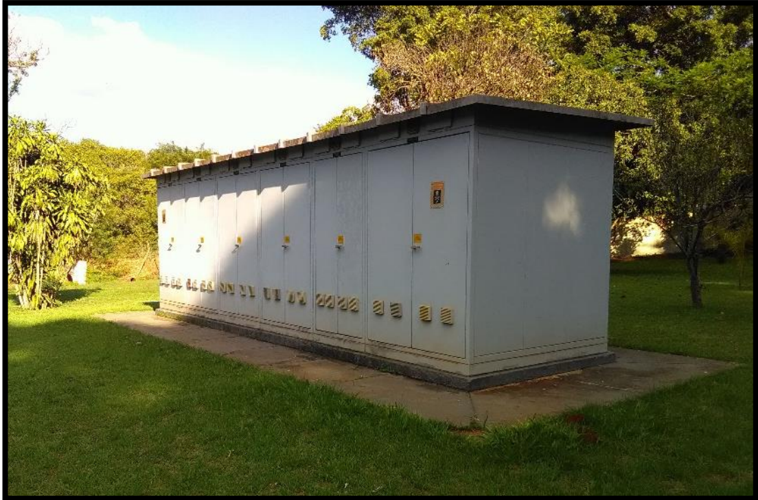
Imagem 11: Subestação de energia elétrica da Estação elevatória do Ribeirão Jacutinga
