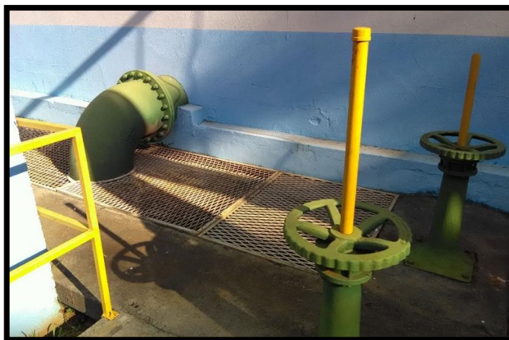
Imagem 6: Poço e tubulação de sucção da elevatória de água bruta
