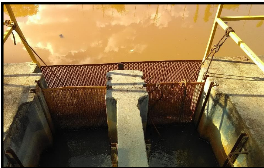
Imagem 5: Gradeamento de retenção de sólidos da Captação superficial
