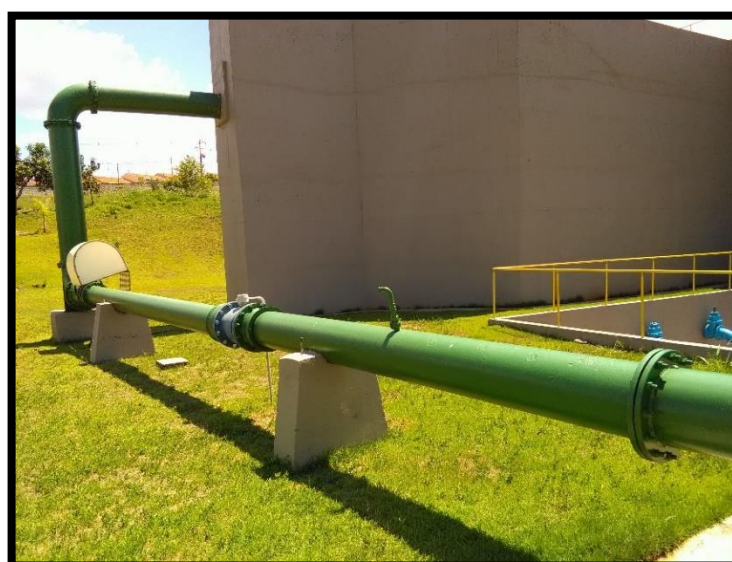
Imagem 8: Barrilete do Poço 2 com macromedidor e ancorado por bases de concreto
