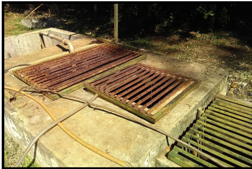
Imagem 46: Estação elevatória e gradeamento
