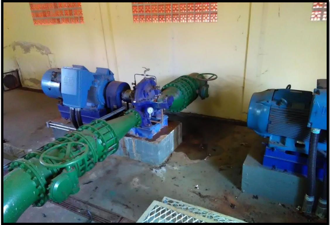
Imagem 13: Conjunto Motobombas da Estação elevatória do Poço 2
