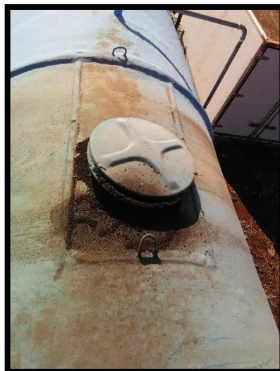
Imagem 54: Abertura de inspeção do reator aerado
