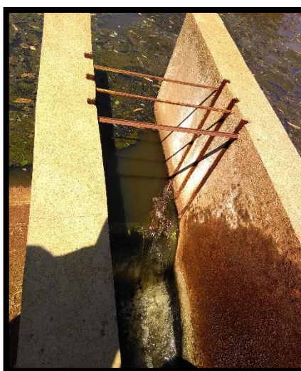
Imagem 44: Dispositivo de saída da lagoa facultativa
