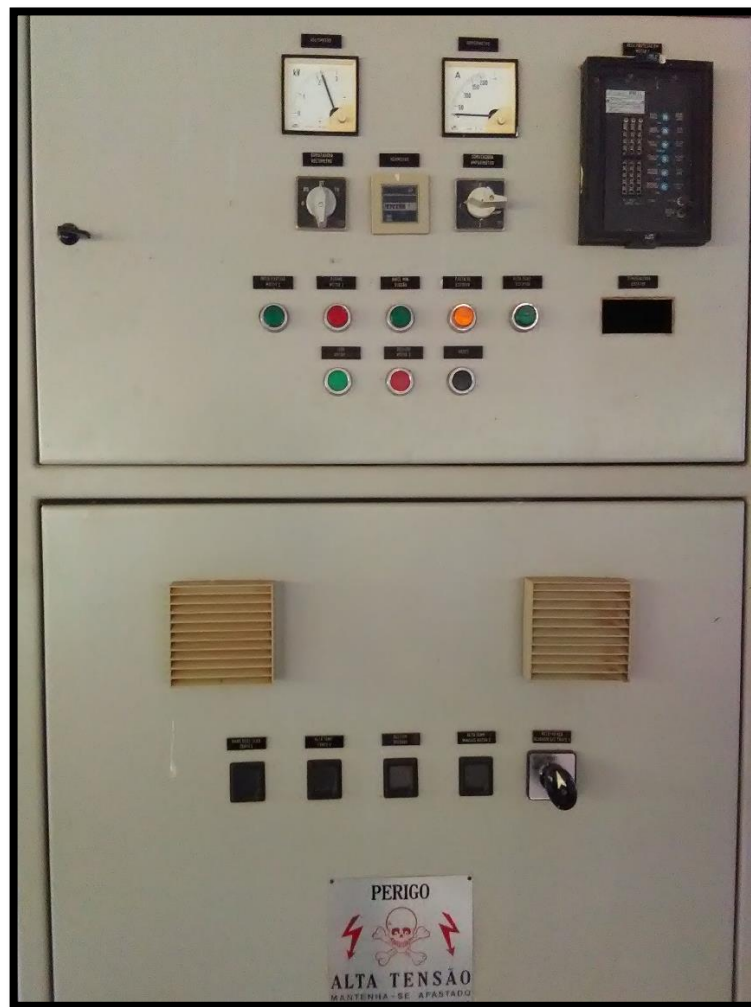
Imagem 10: Quadro de Comando da Estação Elevatória do Ribeirão Jacutinga
