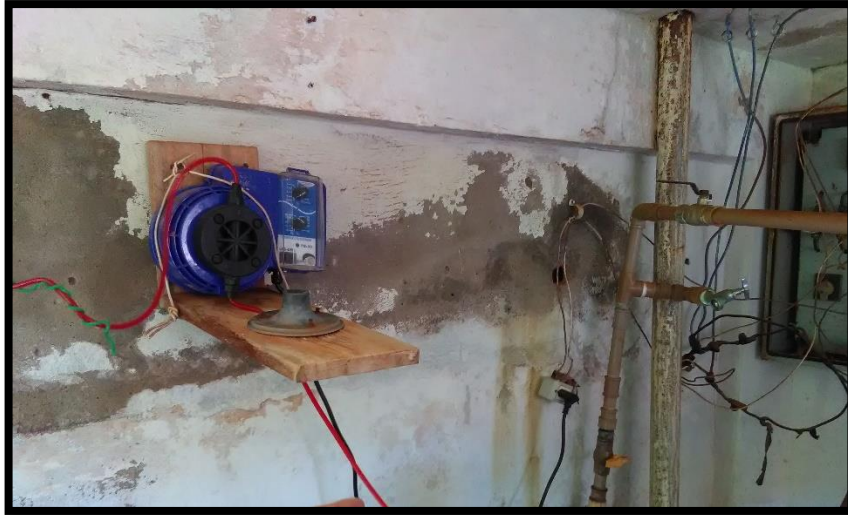
Imagem 12: Unidade de tratamento dos poços 1, 2 e 4
