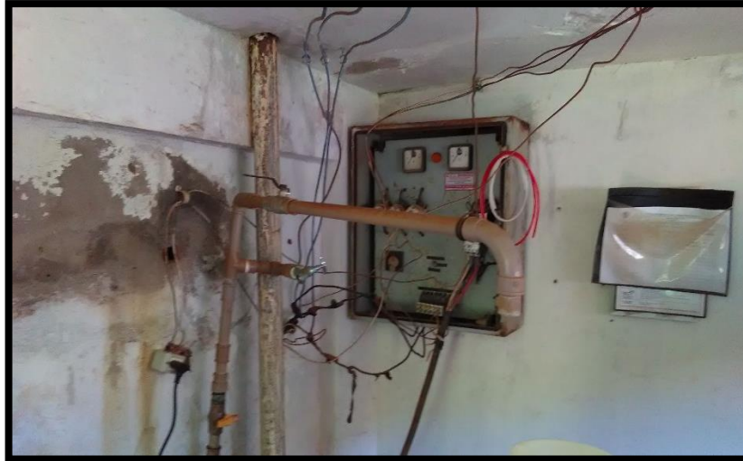
Imagem 5: Quadro de comando do Poço 1
