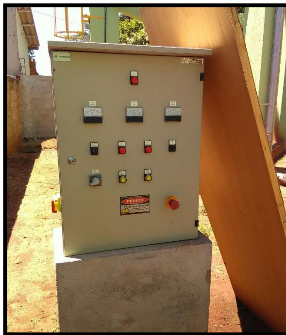
Imagem 20: Quadro de Comando da Estação Elevatória
