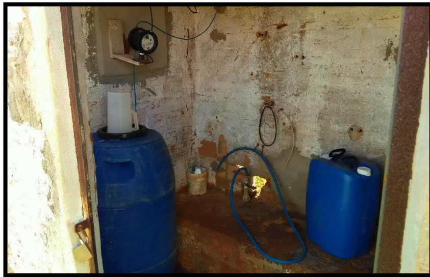
Imagem 13: Unidade de tratamento do Poço 3
