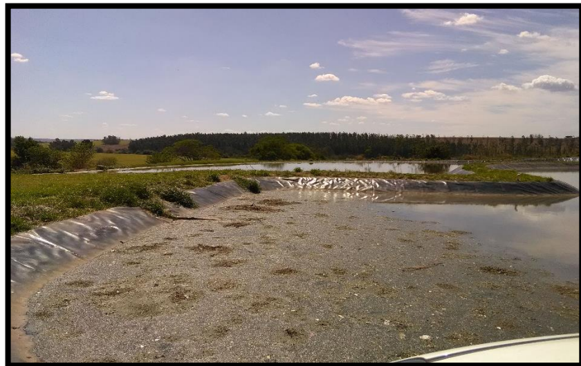
Imagem 25: Dispositivo de saída da lagoa facultativa
