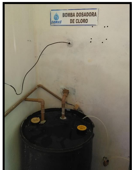
Imagem 23: Unidade de tratamento de água
