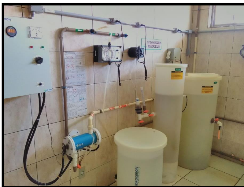
Imagem 16: Unidade de tratamento simplificado – Dosadoras e reservatórios
