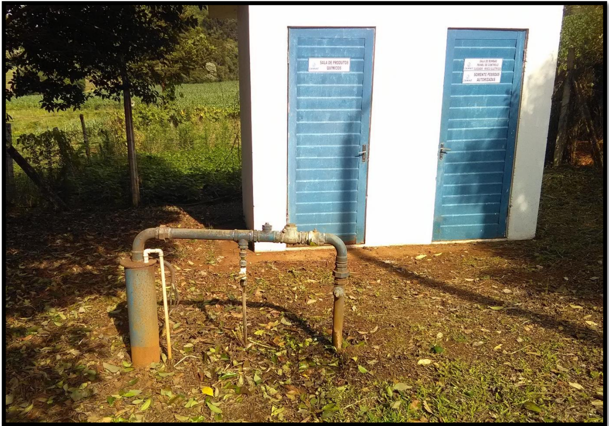
Imagem 29: Poço e unidade de tratamento
