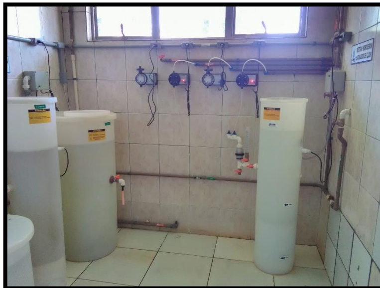
Imagem 17: Unidade de tratamento simplificado – Dosadoras e reservatórios
