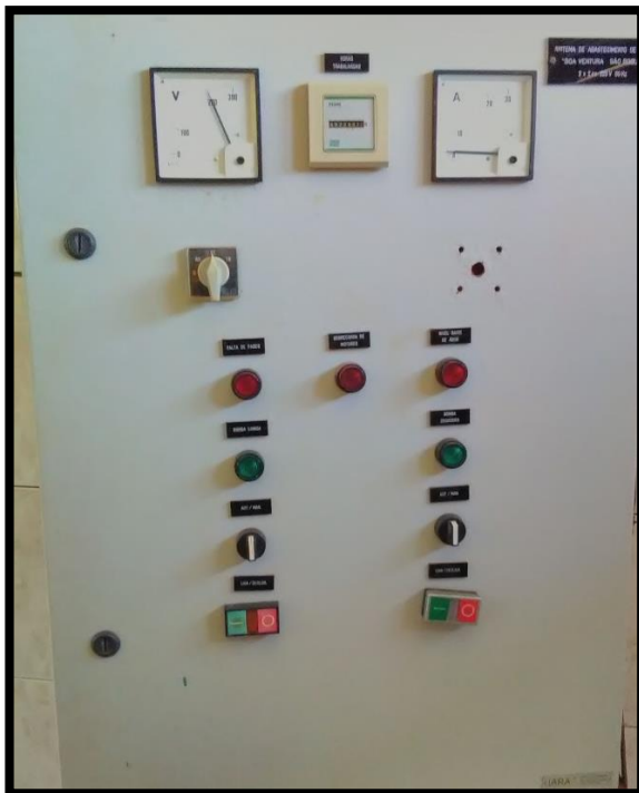
Imagem 14: Quadro de comando da estação elevatória
