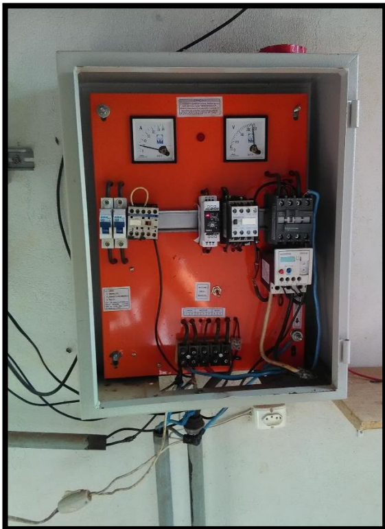
Imagem 30: Quadro de comando do poço
