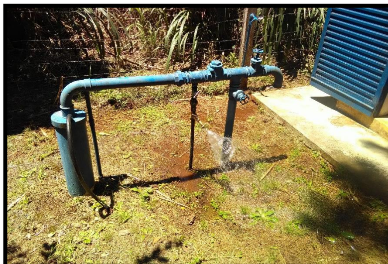
Imagem 18: Poço e unidade de tratamento
