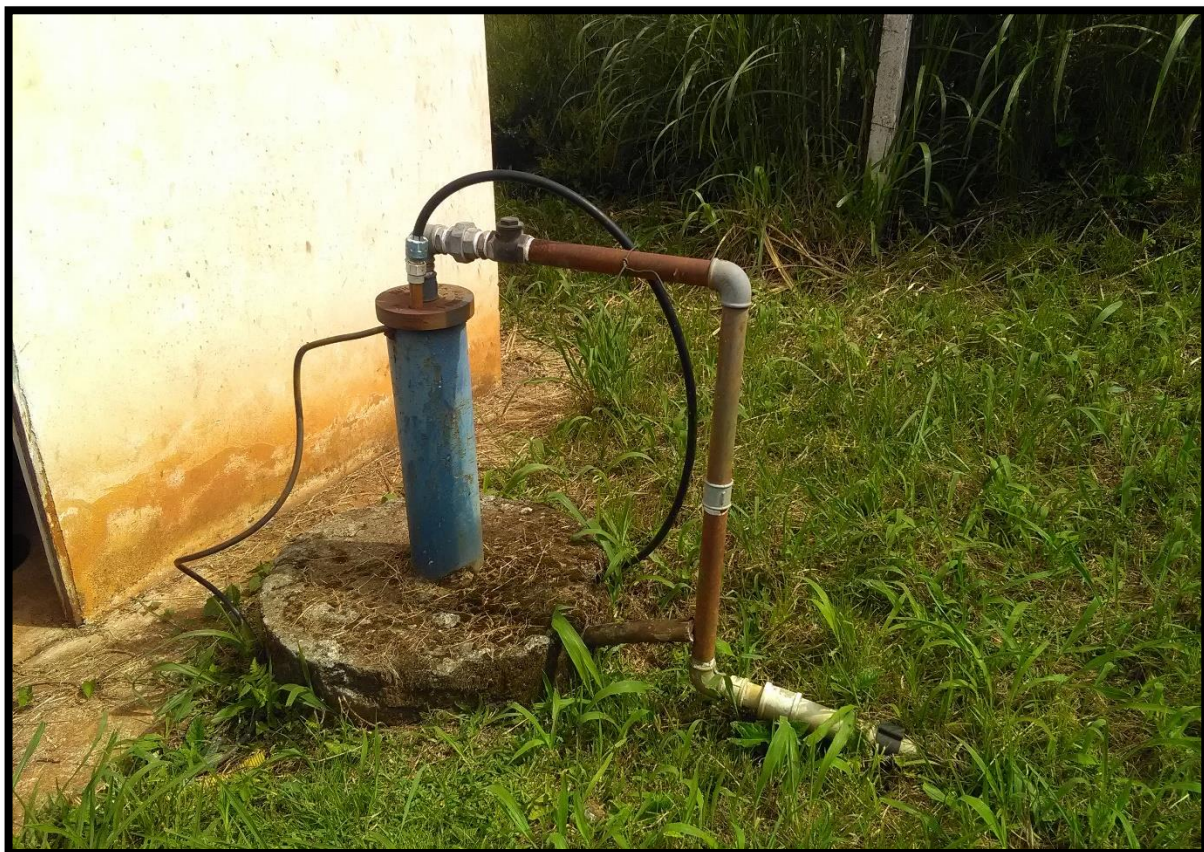
Imagem 33: Poço e unidade de tratamento
