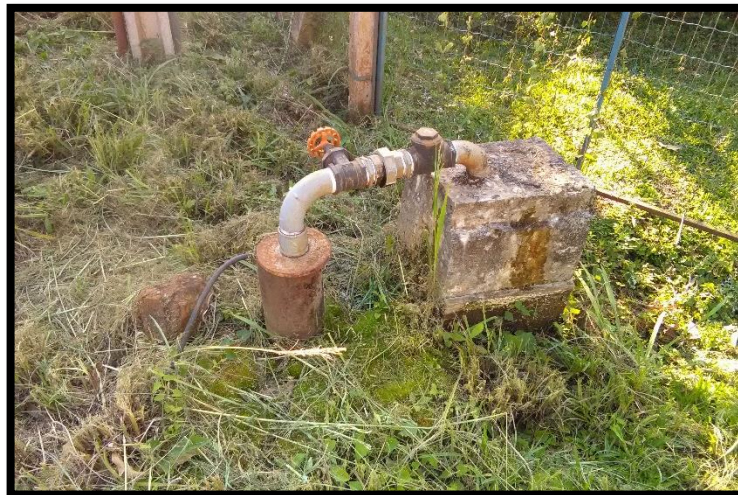
Imagem 8: Barrilete do Poço 2
