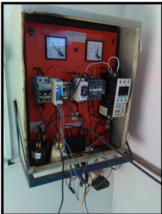
Imagem 22: Quadro de comando
