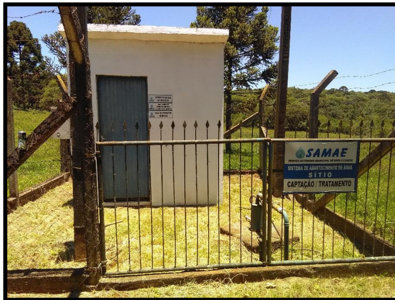
Imagem 21: Poço e unidade de tratamento
