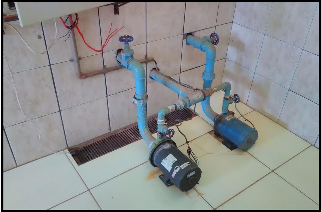
Imagem 13: Conjunto Motobombas da estação elevatória
