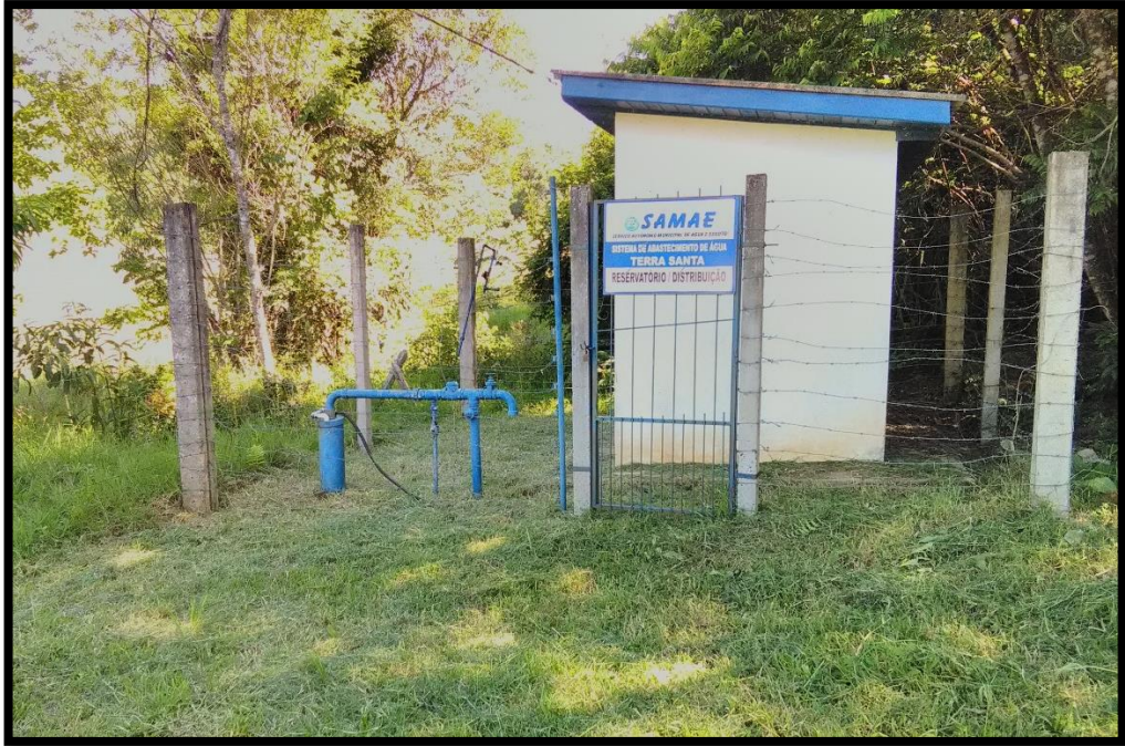
Imagem 25: Poço e unidade de tratamento
