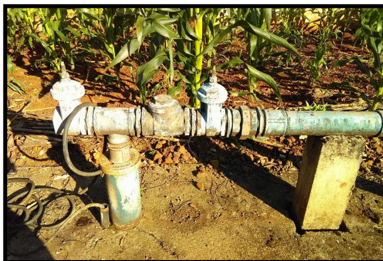
Imagem 5: Barrilete do Poço 1
