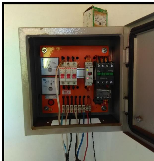
Imagem 9: Quadro de comando do Poço 2
