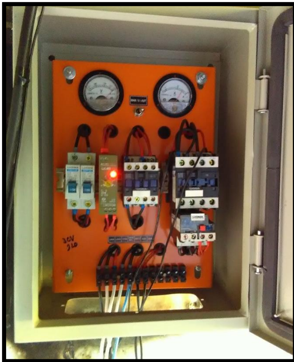
Imagem 26: Quadro de comando do poço
