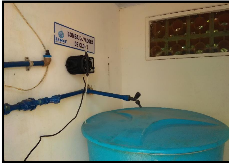
Imagem 19: Unidade de tratamento de água
